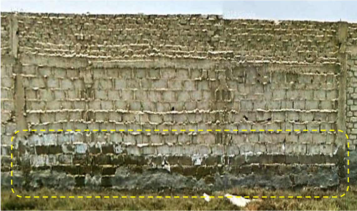
Fotografía 10: Presencia de manchas blanquecinas (eflorescencias) que afectan al muro de albañilería, columnas de confinamiento y sobrecimiento en la Unidad Muestral 11.
