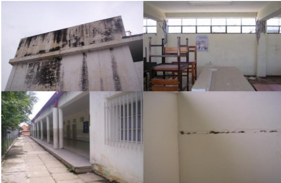
Figura 25: Detalle de Patologías en Edificaciones.
