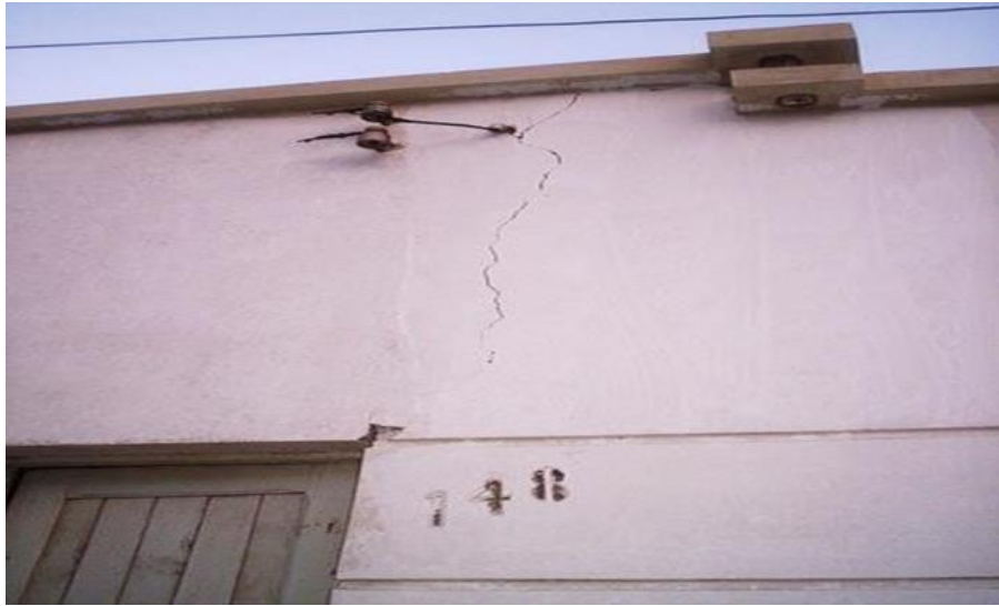
Figura 28: Detalle de fisura longitudinal en el acabado del muro (Fachada frontal).
