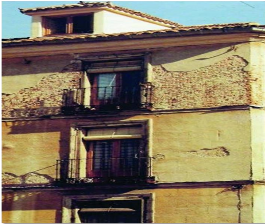
Figura 29: Detalle de desprendimiento del revestimiento de la fachada, el cual los ladrillos quedan a la vista y expuestos a la humedad y erosiones atmosféricas.
