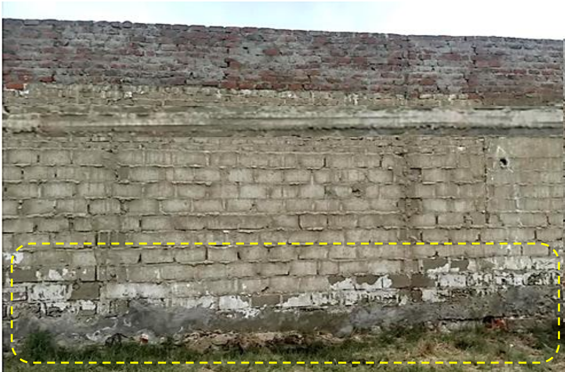
Fotografía 11: Presencia de manchas blanquecinas (eflorescencias) que afectan al muro de albañilería y sobrecimiento en la Unidad Muestral 14.
