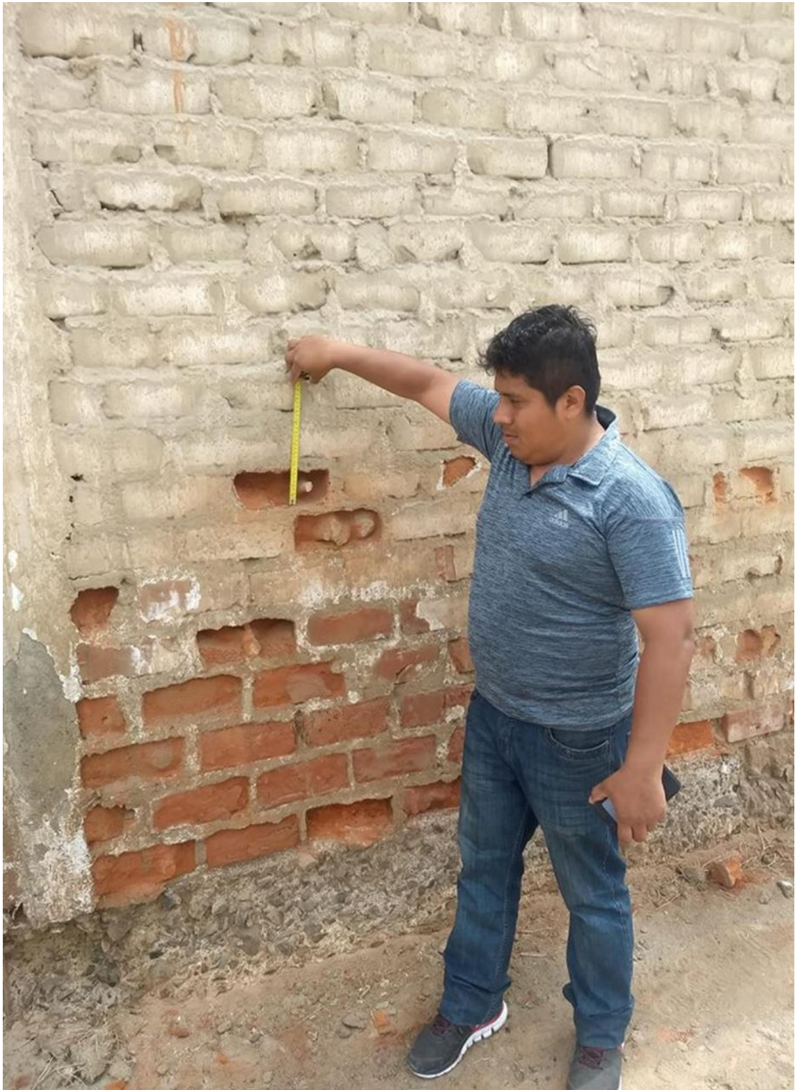
Fotografía 17: Detalle de la medición del área de la unidad de albañilería afectado por la erosión en la Unidad Muestral 19.
