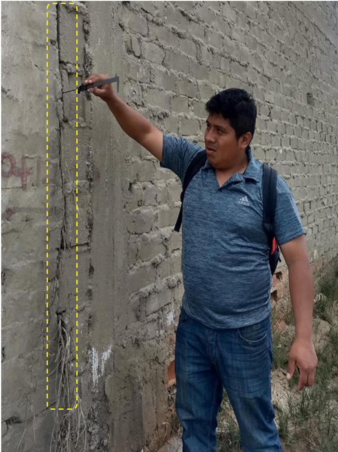
Fotografía 9: Muro de albañilería afectado por la grieta en la Unidad Muestral 13. Mediciones de la grieta longitudinal vertical: h = 2.40 m, ancho de abertura = 3.00 mm, profundidad = 6.00 mm.
