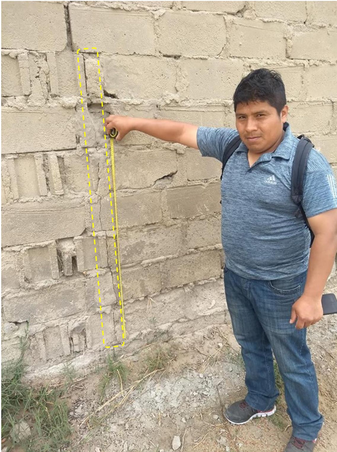
Fotografía 8: Muro de albañilería afectada por la grieta en la Unidad Muestral 12. Mediciones de la grieta longitudinal vertical: h= 1.35 m, ancho de abertura= 2.00 mm, profundidad= 5.00 mm.
