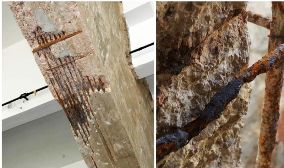
Figura 30: Detalle de la corrosión de los estribos y varillas longitudinales de la viga (Izquierda) y columna (Derecha).
