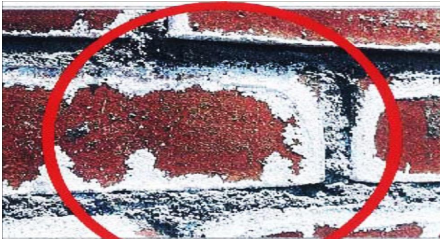
Figura 31: Detalle de manchas blancas (eflorescencias) que aparecen en los ladrillos.
