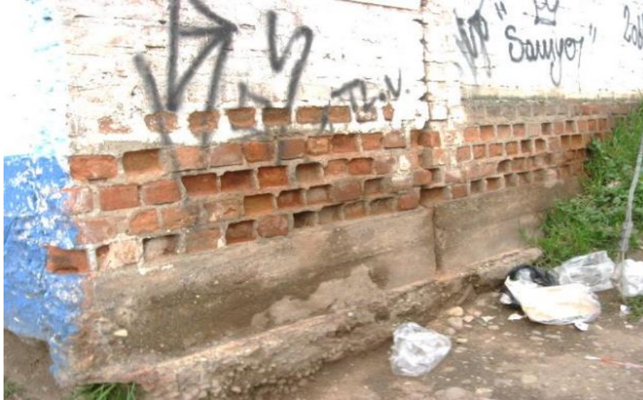
Figura 23: Detalle de Erosión del ladrillo en muro de albañilería confinada.
