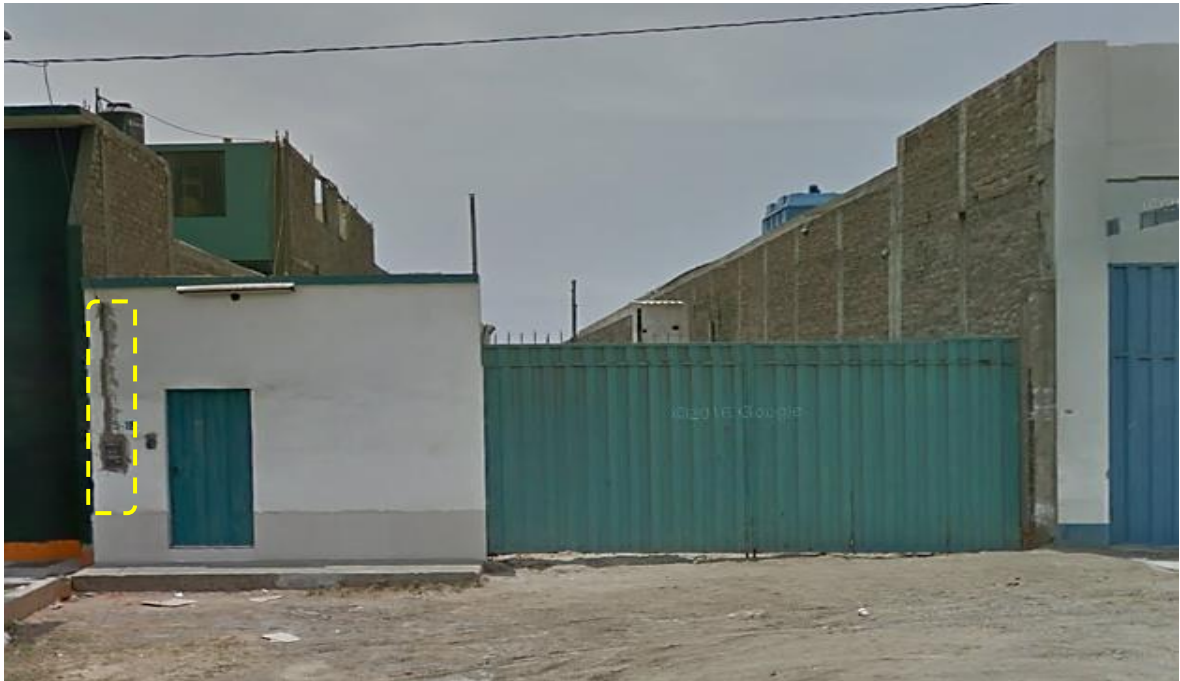
Fotografía 12: Presencia de desprendimiento del mortero (tarrajeo) que afectan al muro de albañilería en la Unidad Muestral 1.
