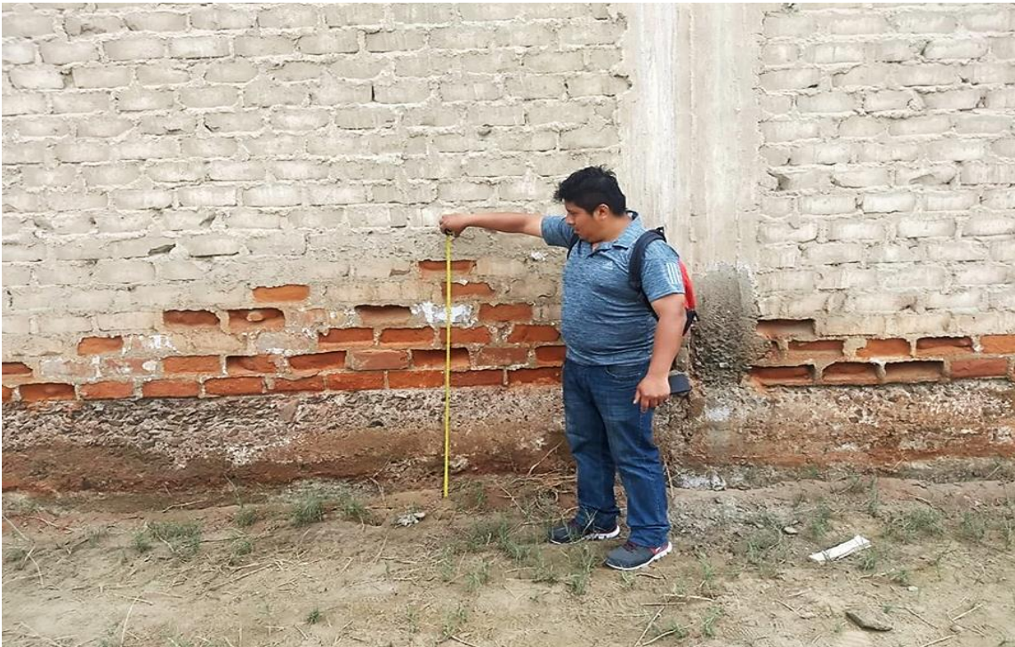
Fotografía 15: Medición del área del muro de albañilería, sobrecimiento y columnas de confinamiento afectados por la erosión en la Unidad Muestral 23.
