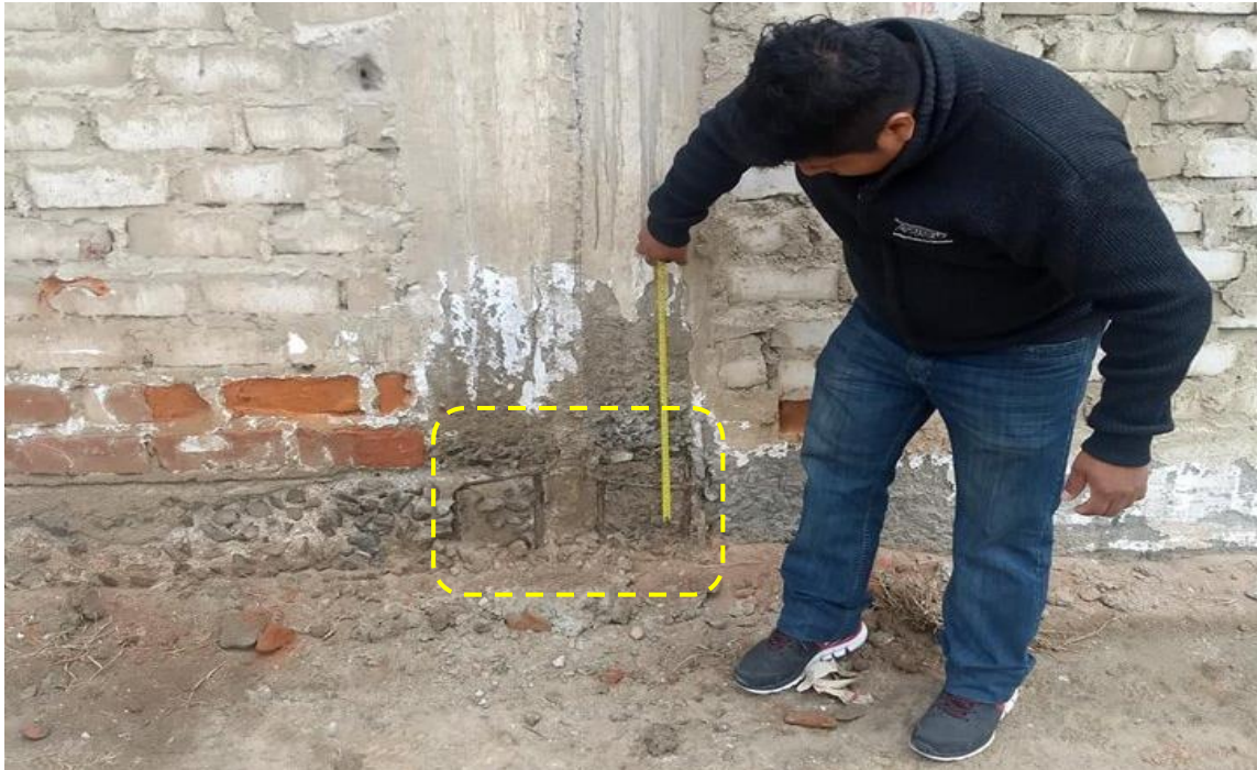
Fotografía 6: Detalle del acero de refuerzo (estribos \text{Ø}1/4'' y varillas longitudinales \text{Ø}1/2'' ) de la parte inferior de las columnas de confinamiento afectadas por la corrosión en la Unidad Muestral 6.
