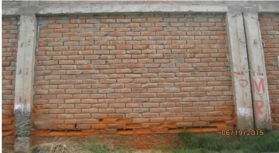
Figura 2: Pared ubicada en la prolongación Francisco Bolognesi, lado interior, muestra 2. Se aprecia la patología de erosión y eflorescencia.
