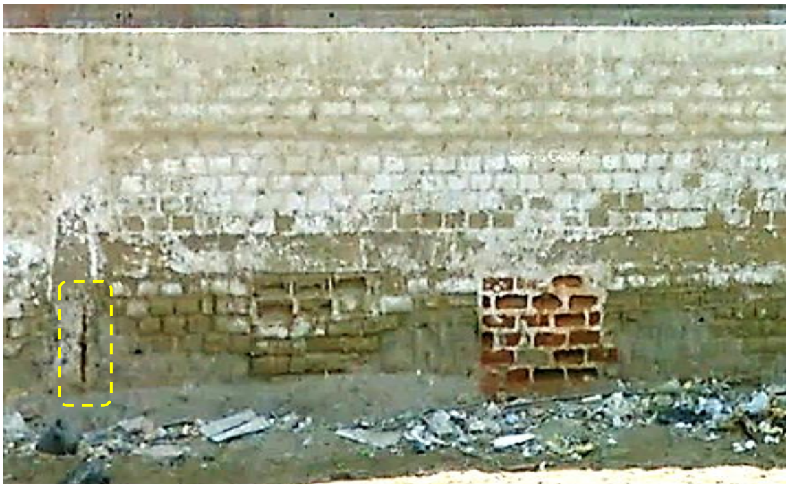
Fotografía 7: Detalle de la varilla longitudinal ( \text{Ø}1/2'' ) de la columna de confinamiento afectada por la corrosión en la Unidad Muestral 7.
