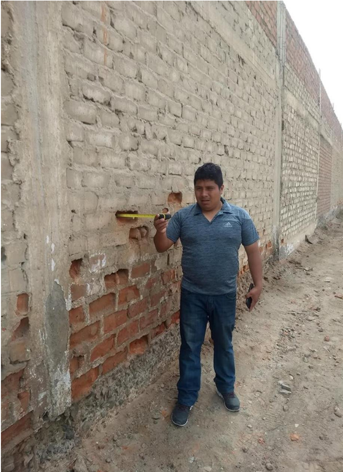
Fotografía 16: Medición de la profundidad de la parte erosionada del muro de albañilería, columnas de confinamiento y sobrecimiento en la Unidad Muestral 17.
