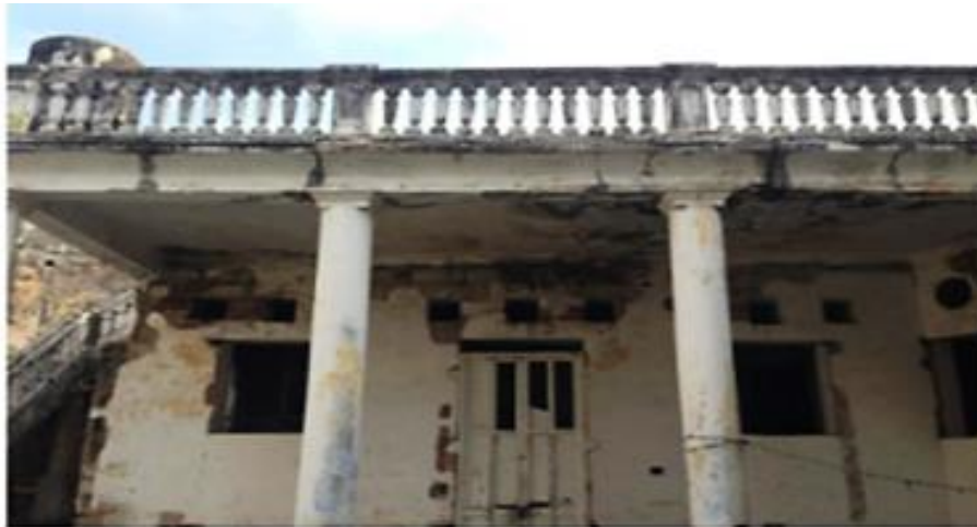
Figura 1: Vista panorámica del patio del Antiguo Club Cartagena, en la cual presenta deformaciones, grietas, desprendimientos en vigas y filtración de humedad.
