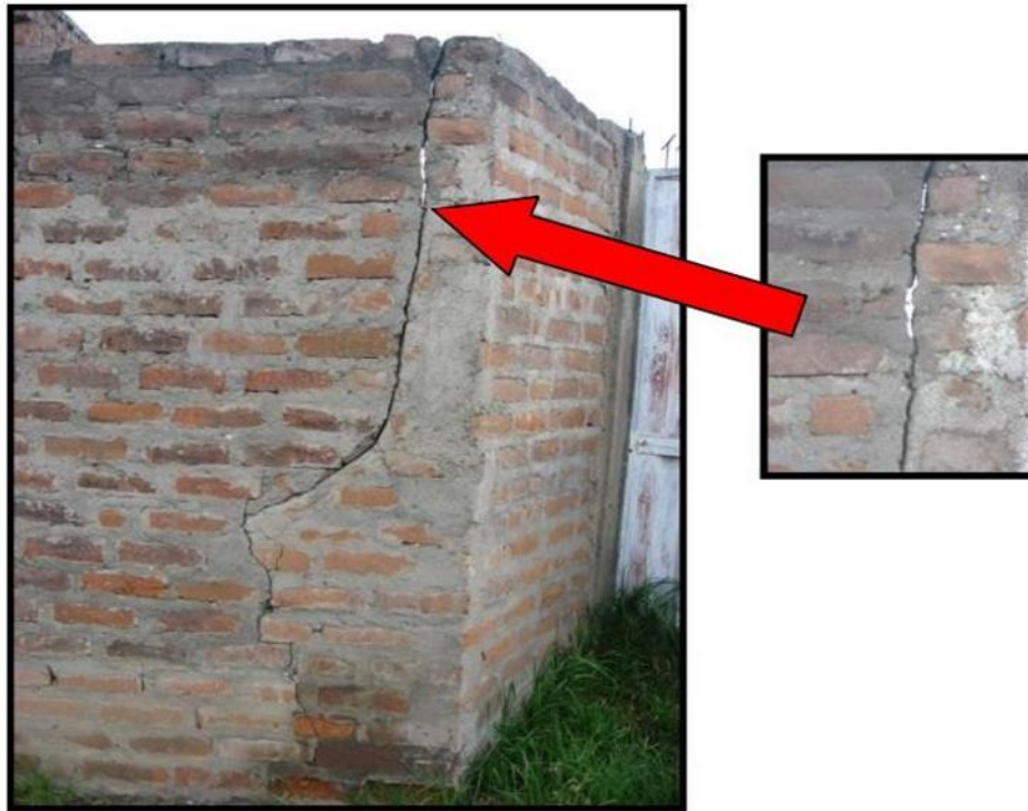
Figura 27: Detalle de grieta por dilatación en el muro.
