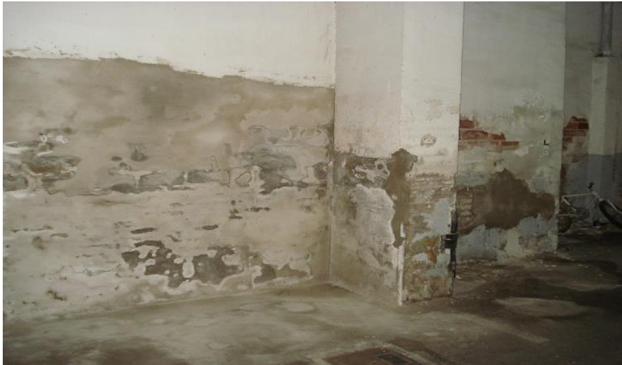
Figura 22: Detalle de Patología del concreto.
