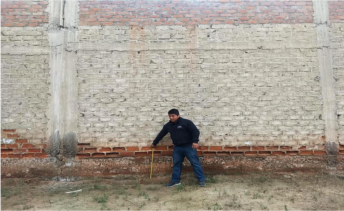
Fotografía 14: Medición del área del muro de albañilería, sobrecimiento y columnas de confinamiento afectados por la erosión en la Unidad Muestral 17.
