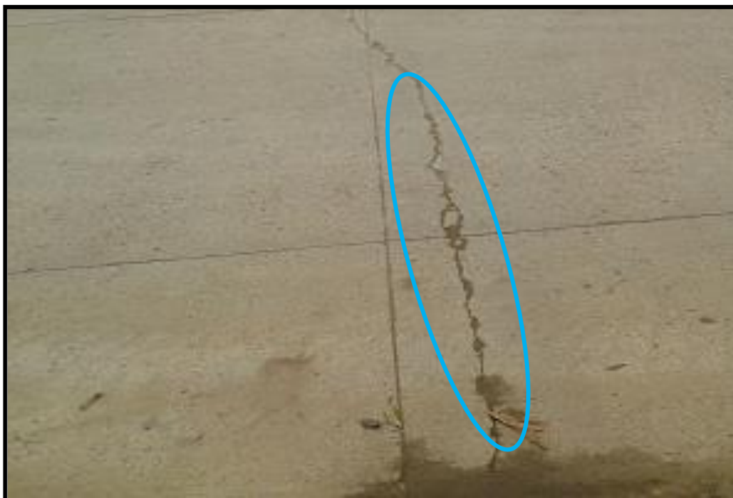
Fotografía 9. Es una Patología de Grieta Lineal unidad de muestra N°02.
