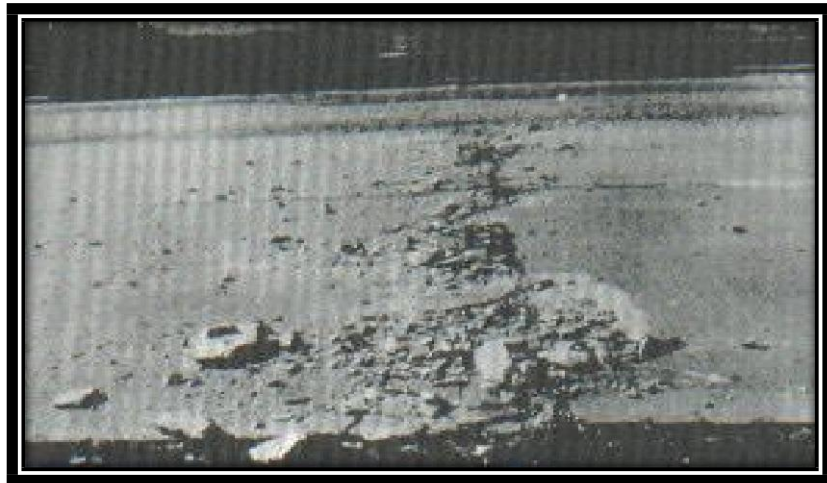
Figura N°04. (Buckling de Media Severidad)-Blowup.
