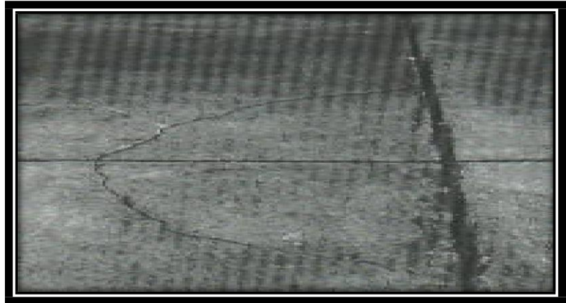
Figura N°05. (Baja Severidad)-Grieta de Esquina.
