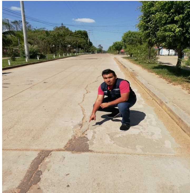
Figura 108: Patología – Grieta Lineal – Severidad Alto.
