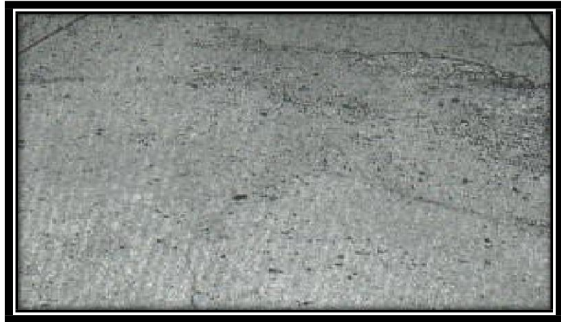
Figura N°13. (Alta Severidad)-Grieta de Durabilidad "D".
