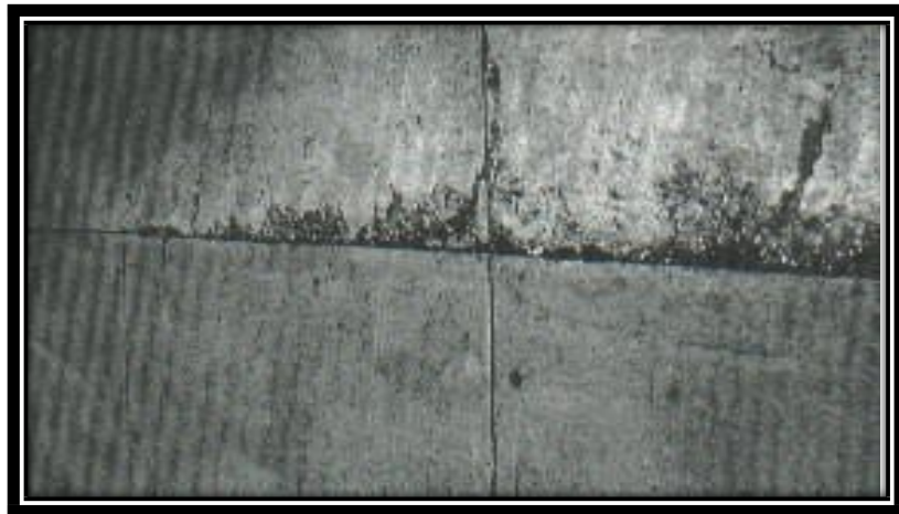
Figura N°47. (Media Severidad)-Descascaramiento de Junta.
