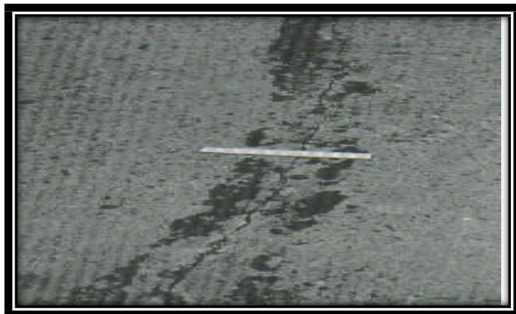
Figura N°23. (Baja Severidad)-Grietas Lineales.
