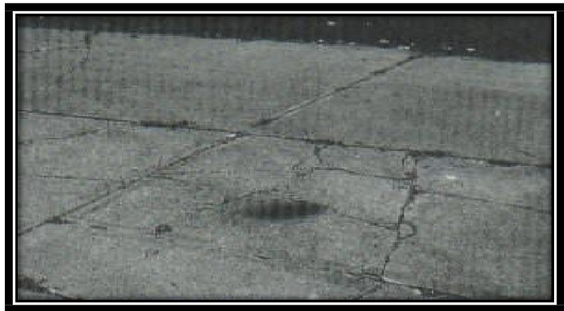
Figura N°10. (Alta Severidad)-Losa Dividida.
