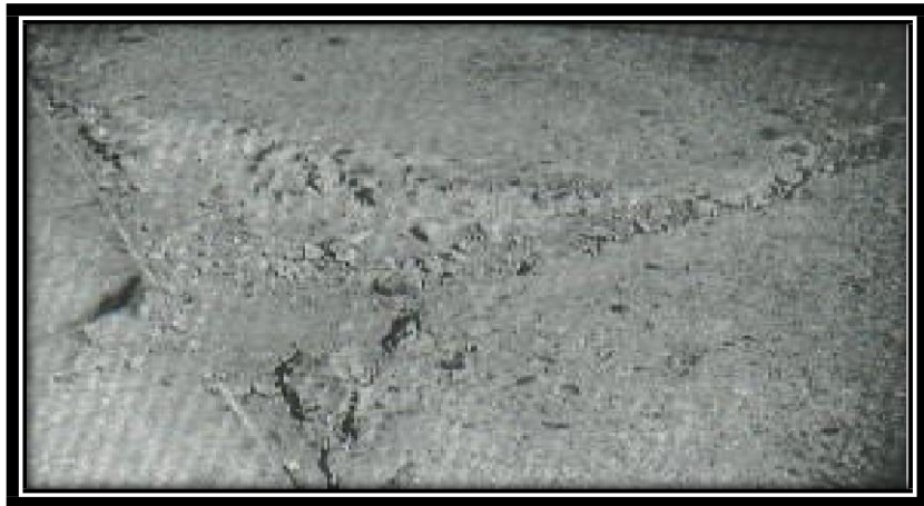
Figura N°45. (Alta Severidad)-Descaramiento de Esquina.
