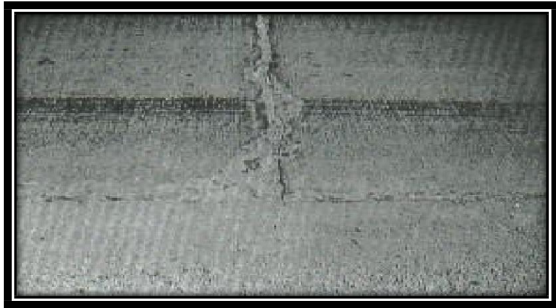
Figura N°44. (Media Severidad)-Descaramiento de Esquina.
