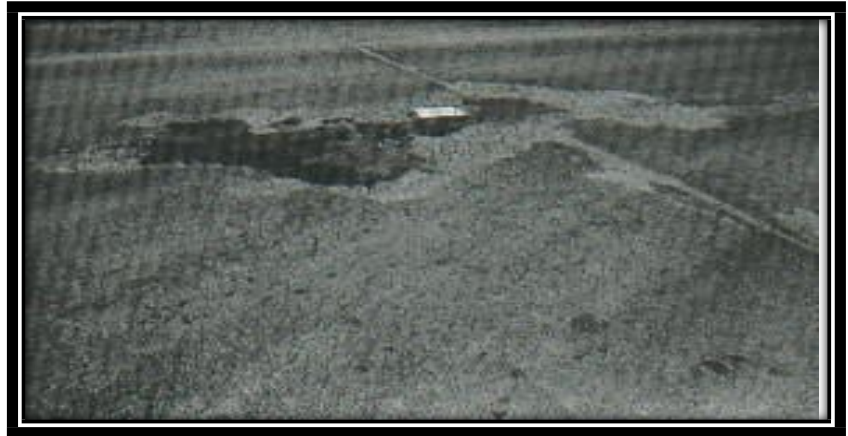
Figura N°41. (Alta Severidad)- Desconchamiento / mapa de grietas / craquelado.
