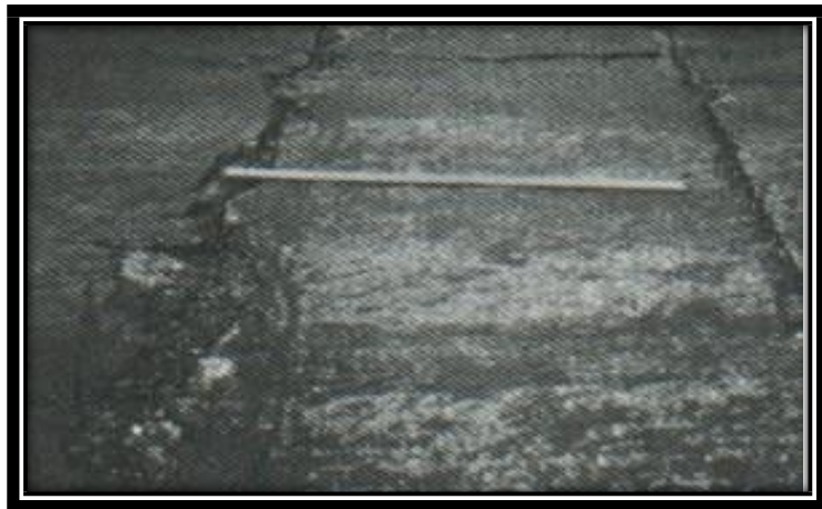
Figura N°27. (Media Severidad)-Parche Grande.
