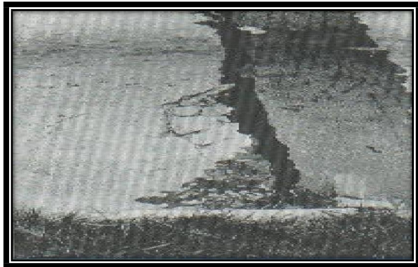
Figura N°03. (Buckling de Baja Severidad)-Blowup.
