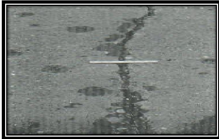
Figura N°24. (Media Severidad)-Grietas Lineales.
