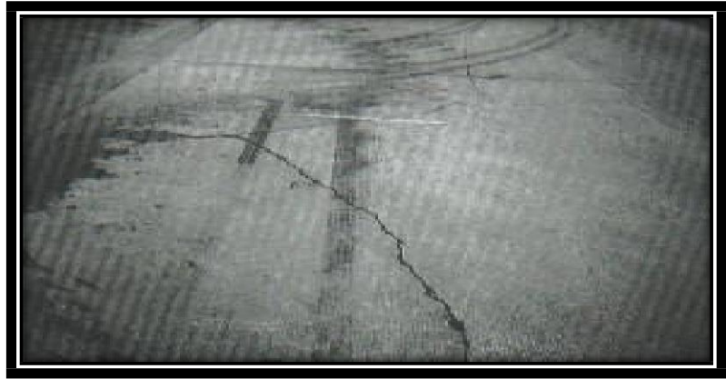
Figura N°08. (Baja Severidad)-Losa Dividida.
