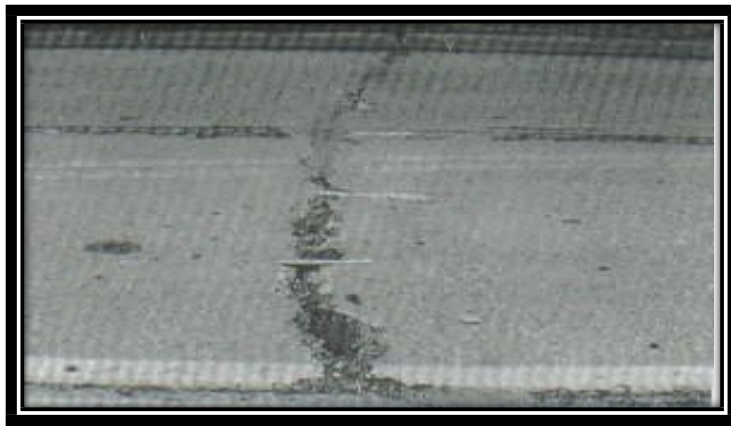
Figura N°25. (Alta Severidad)-Grietas Lineales.
