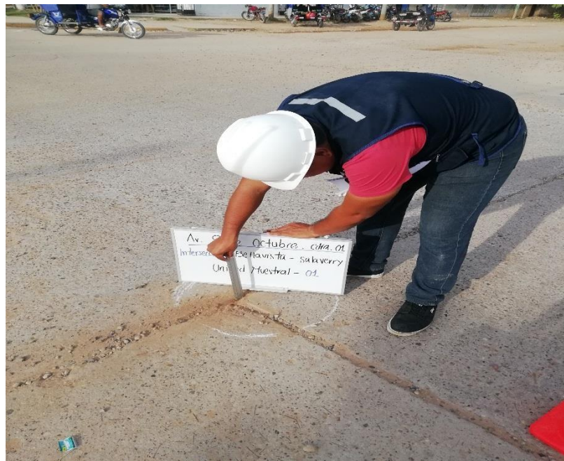
Figura 106: Daño- Sello de Juntas- Severidad Baja.
