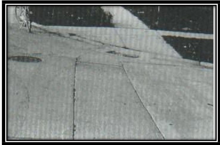
Figura N°26. (Baja Severidad)-Parche Grande.
