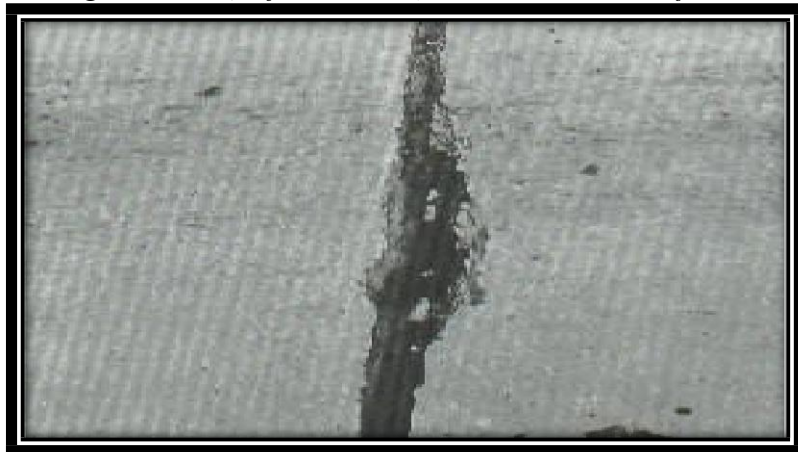
Figura N°18. (Media Severidad)-Daño del sello de la junta.
