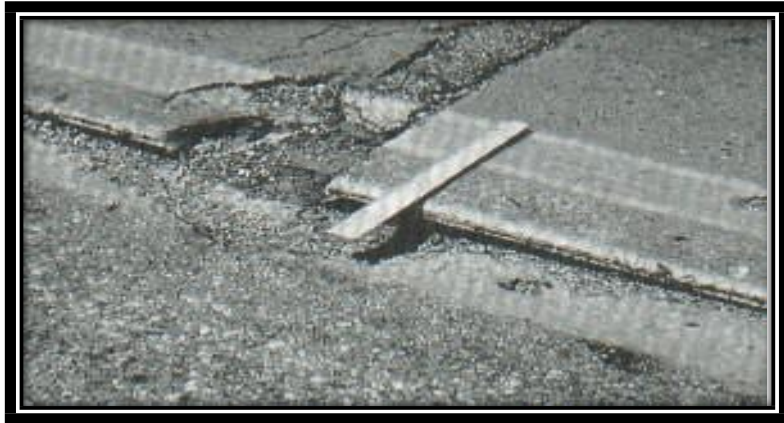
Figura N°20. (Baja Severidad)-Desnivel carril / Berma.
