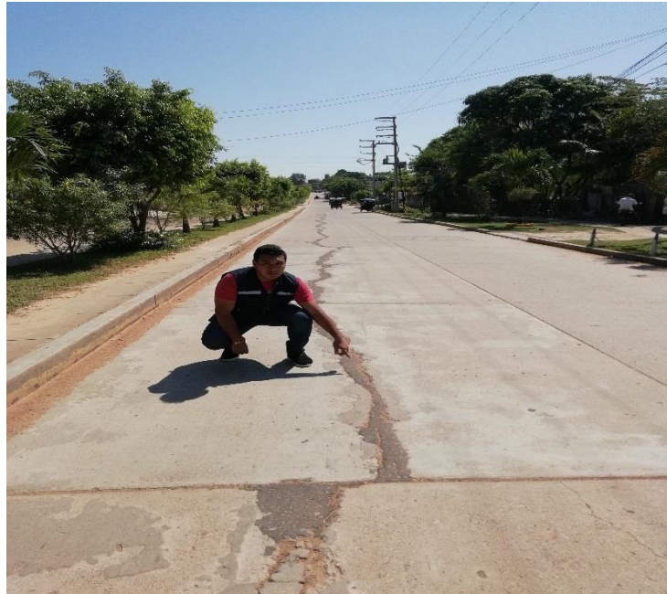
Figura 109: Patología – Grieta Lineal – Severidad Alto.
