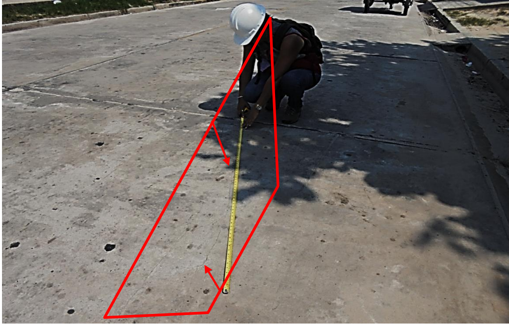
Ilustración 3.- (28L) En campo verificando la severidad de la Grieta Longitudinal, es de nivel bajo, en este caso se recomienda hacer el sellado si el ancho de la grieta es mayor a 3.00mm.
