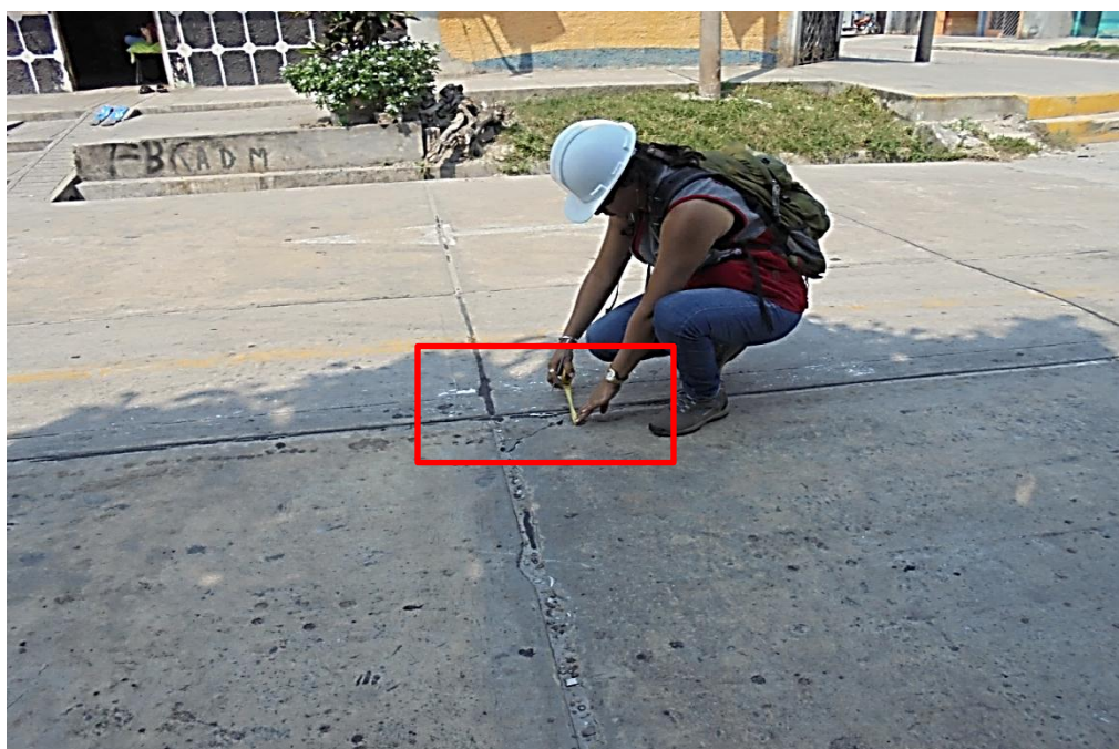
Ilustración 6.- (38L) Sacando las dimensiones de uno de los lados del Descascaramiento de Esquina de la losa, tiene un nivel de severidad bajo, en este nivel no se hace reparación.
