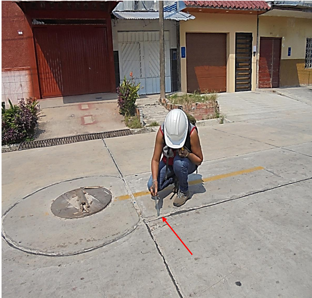
Ilustración 7.- (38L) Esta imagen muestra la rotura de los bordes de la losa de la junta, la severidad de este Descascaramiento de Junta es de nivel bajo, por este motivo no se puede reparar.
