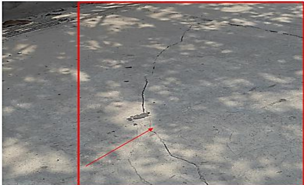
Ilustración 2.- (23L) Esta toma pertenece a una Losa Dividida, con un nivel de severidad de daño bajo, se hace sellado de las grietas si presente un ancho mayor de 3mm.
