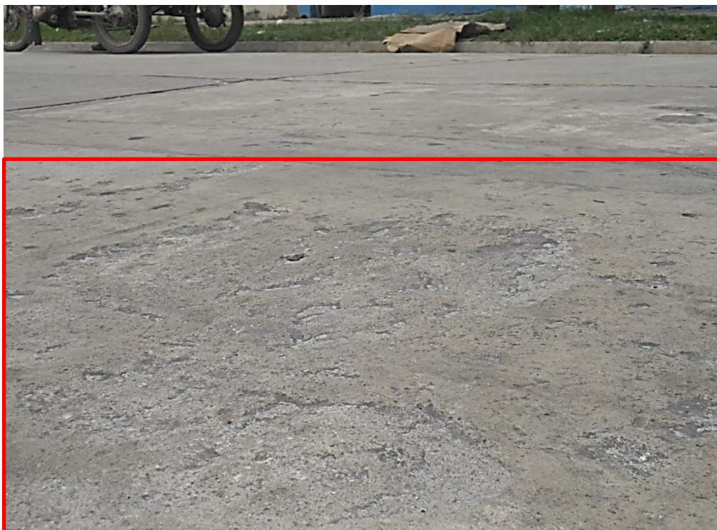
Ilustración 5.- (36L) Muestra de la falla que sufre este pavimento por agregados de mala calidad, cuando la severidad del desconchamiento es bajo no se hace ningún tipo de reparación.
