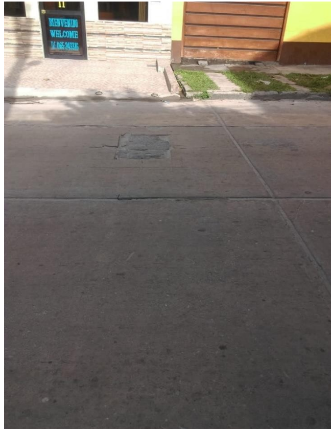
Fotografía 14: Parche grande de severidad alta en la UM - 07
