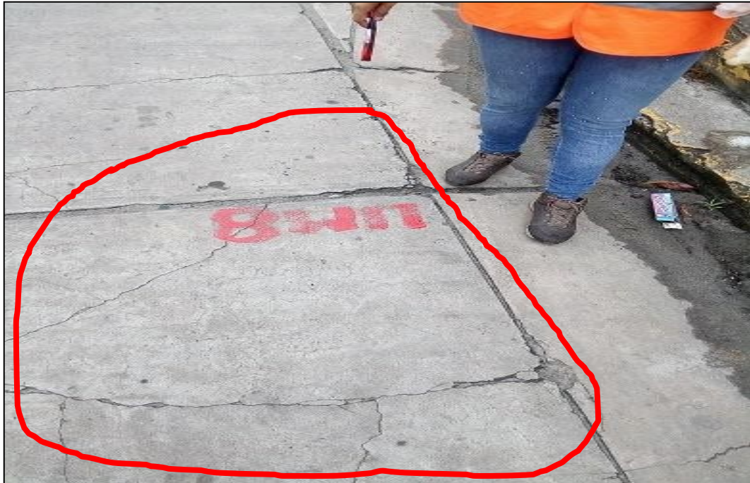
Fotografía 16: Unidad de muestra 8, se observa la losa dividida de severidad baja y el daño de sello de junta. Originados por el asentamiento diferencial de la base y subbase. La losa es dividida por las grietas en cuatro o más pedazos y se genera por el soporte inadecuado a las sobrecargas de tránsito y las deficiencias de la base de fundación.
