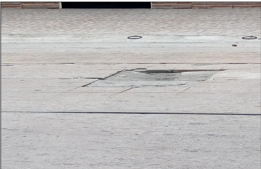
Fotografía 22: Parche grande de alta severidad. Originado por el mal trabajo de reparación del pavimento, UM - 11
