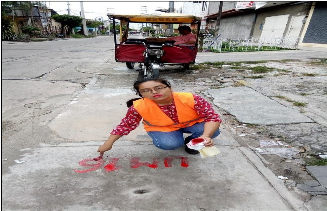
Fotografía 27: Unidad de muestra 16, se nota el panorama de la calle, al fondo el daño de losa dividida.
