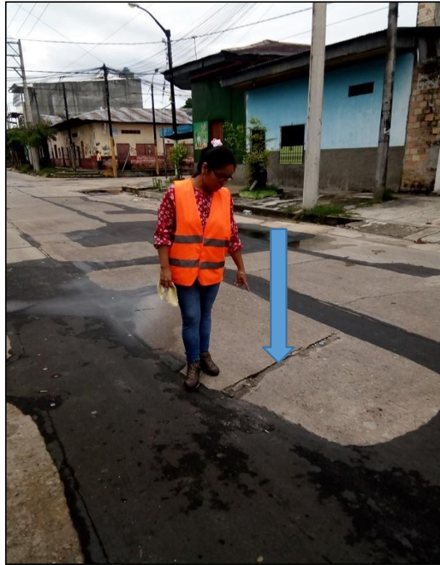
Fotografía 4: Descascaramiento de junta severidad alta en la UM - 01.
