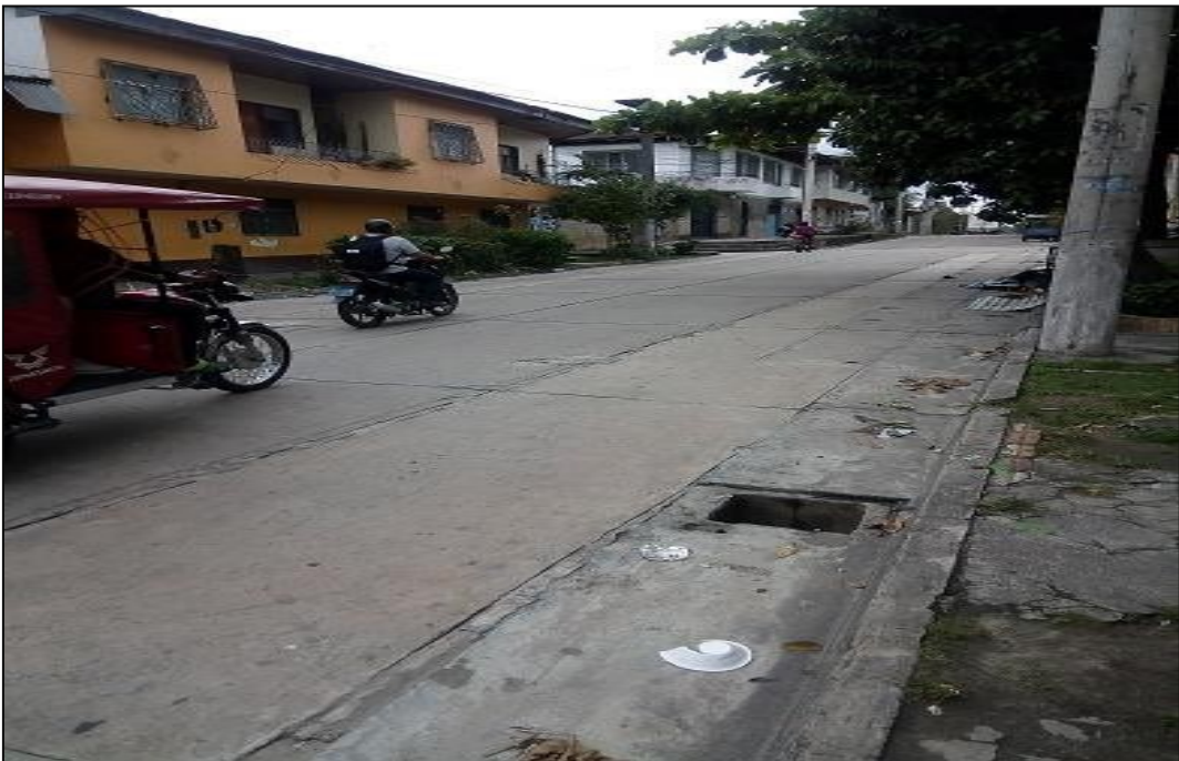
Fotografía 20: Vista panorámica de la calle Callao, se nota los parches realizados por el acople de las instalaciones sanitarias. UM - 10
