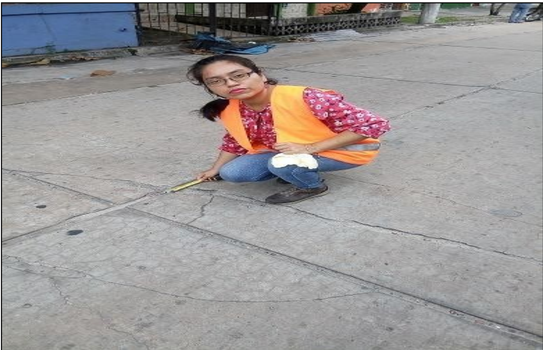
Fotografía 29: Haciendo la medición de las grietas, se nota las grietas de severidad media, el desconchamiento y la grieta de esquina de baja severidad
