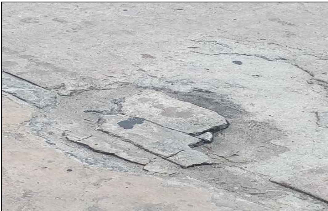
Fotografía 24: Parche grande de alta severidad. Originado por el mal trabajo de reparación del pavimento, UM - 13
