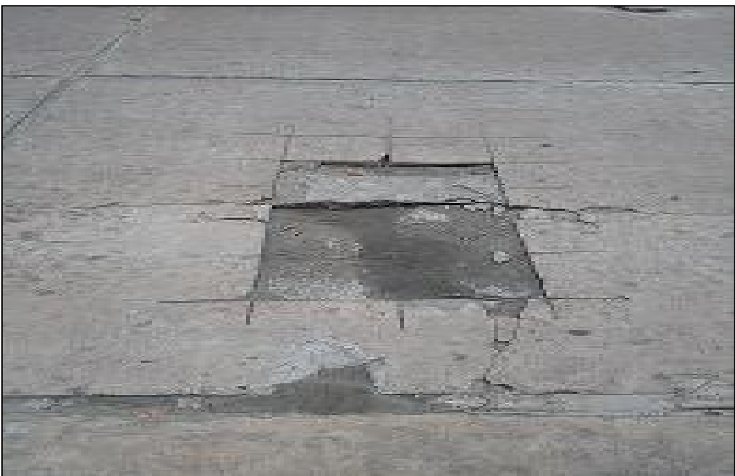
Fotografía 26: Parche grande se severidad alta, se nota el desconchamiento y las grietas lineales. UM - 14
