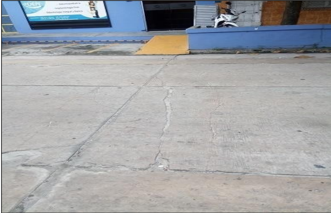
Fotografía 30: grieta lineal de alta severidad, descascaramiento de junta y de esquina de severidad alta. UM - 16
