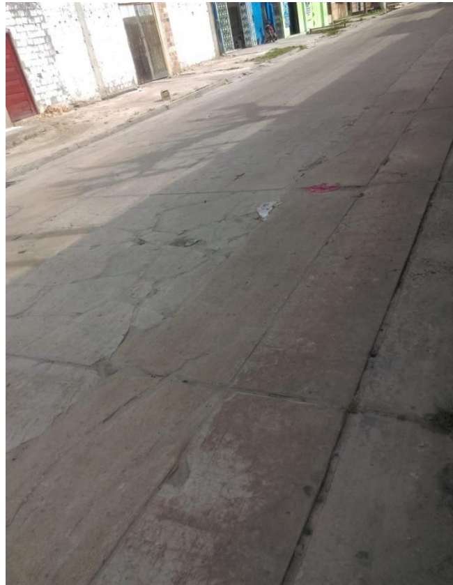
Fotografía 12: losa dividida de severidad alta en la UM – 05
