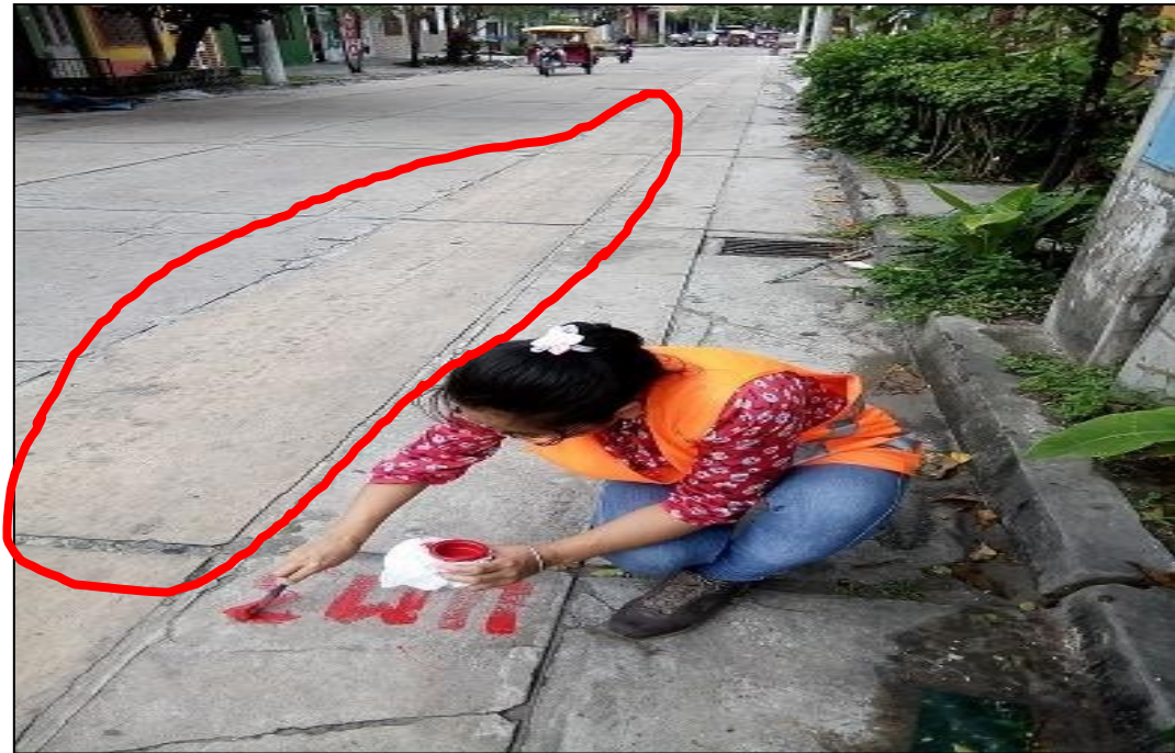
Fotografía 8: Escala de alta severidad, descascamiento de esquina de severidad alta, desconchamiento En la UM - 03. Originado por la mala calidad de concreto.
