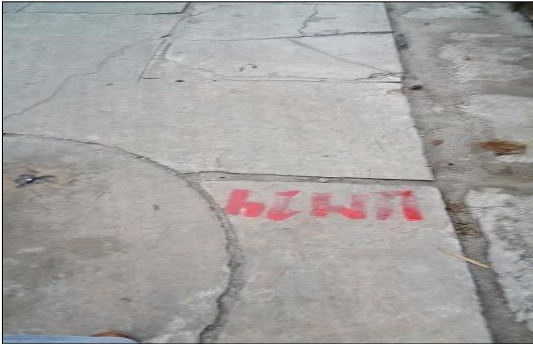
Fotografía 25: Unidad de muestra 14, se nota un conjunto de fallas, los parches, grietas lineales.
