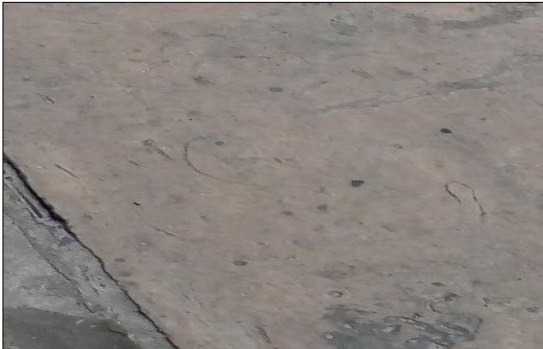
Fotografía 15: Desconchamiento de baja severidad. UM - 8
