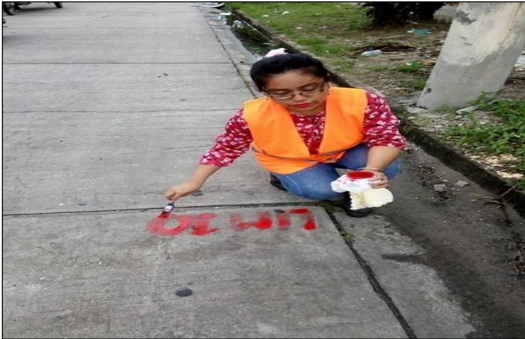
Fotografía 19: Unidad de muestra 10, se nota el desconchamiento de severidad baja
