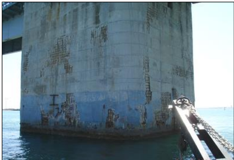
Imagen 31: Corrosión en la Armadura.
