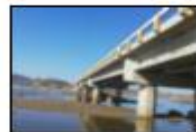
PILES TIPO PORTICO, CON PRESENCIA DE PATOLOGIAS
