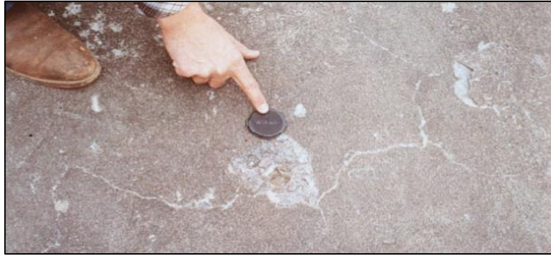
Imagen 17: Deterioro del Concreto - Popout.
