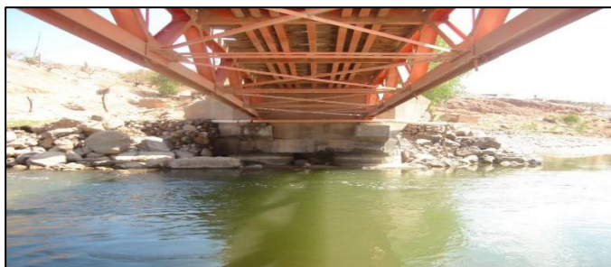
Imagen 15: Humedad en estribo
