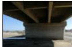
LOSA INFERIOR, CON PRESENCIA DE PATOLOGIAS
