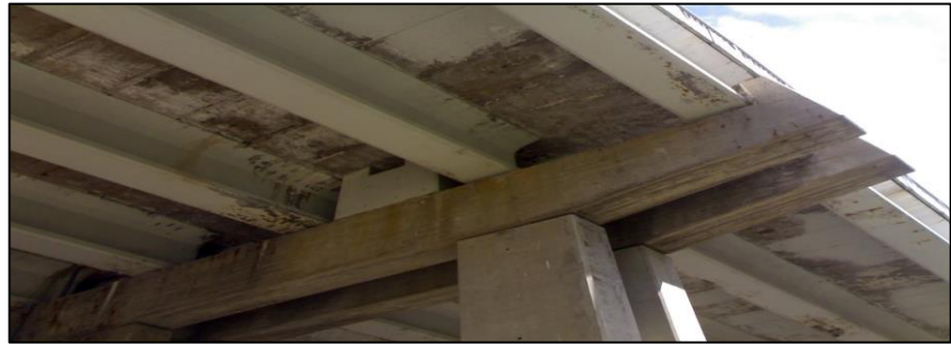
Imagen 14: Patologías en vigas pretensado - eflorescencia.
