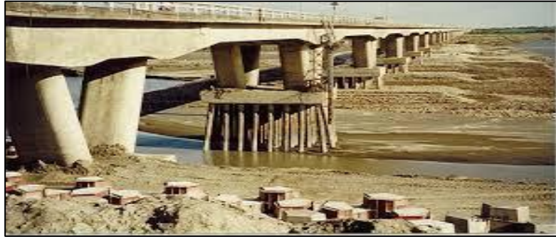
Imagen 16: Erosión de Puente.
