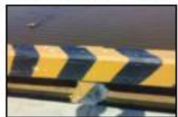
BARANDA DE C.A.* EN MAL ESTADO, EN TODA SU LONGITUD
