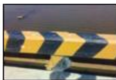
BARANDA DE C.A.* EN MAL ESTADO, EN TODA SU LONGITUD
