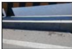
VEREDAS DE C.A.* EN MAL ESTADO, EN TODA SU LONGITUD
