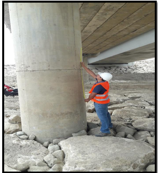
Socavación en el pilar
