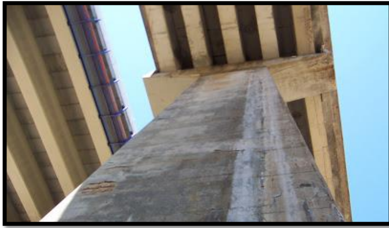
Figura 54. –observamos el área afectada por efectos del dióxido de carbono.
