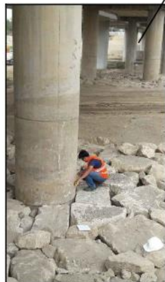
nótese manchas de pilar
