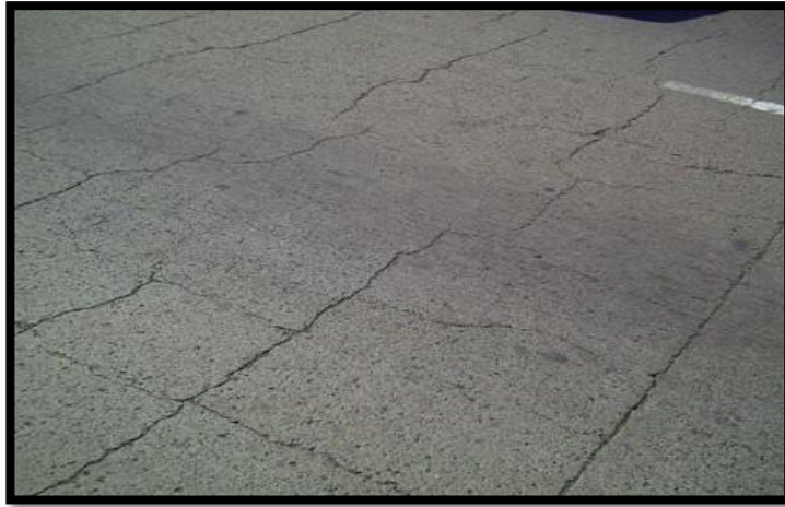
Figura 59. – plataforma con fisuras retraída.
