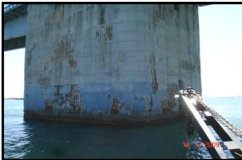
Figura 55. –se observa la corrosión en la base de la estructura del puente debido a factores químicos.
