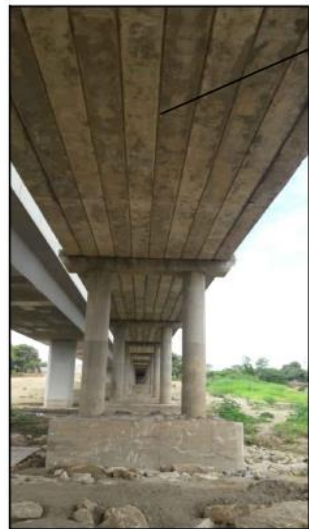
se presencia eflorescencia en la mayoria de la estructura
