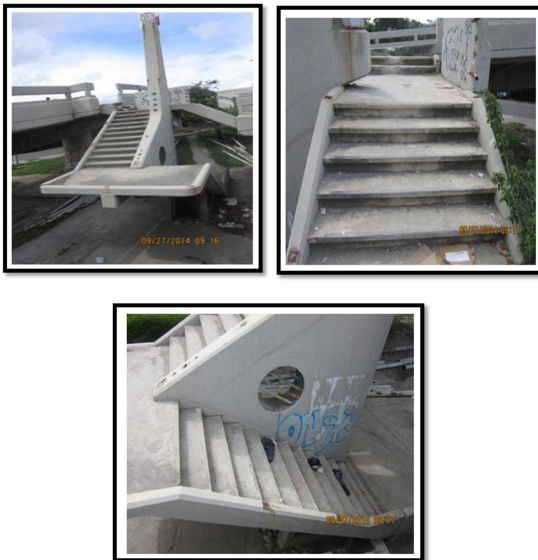
Figura 06.- Falta de barandas de protección en las escaleras.
