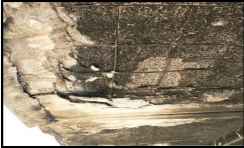
Figura 56. –nótese el acero descubierto debido al escaso recubrimiento De concreto.
