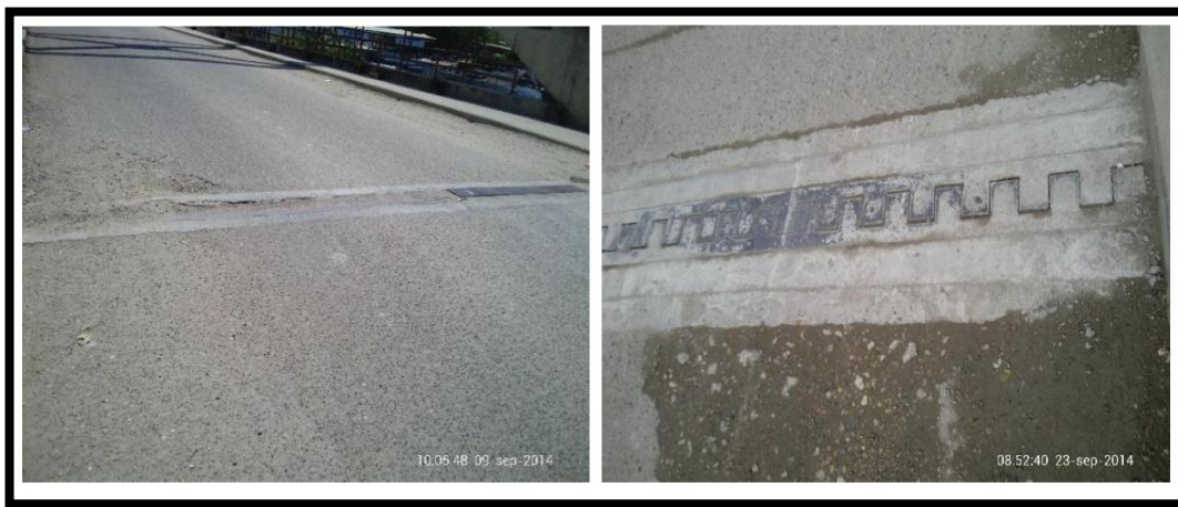
Figura 11.- A la Izquierda, Registro fotográfico de juntas de dilatación en mal estado.
