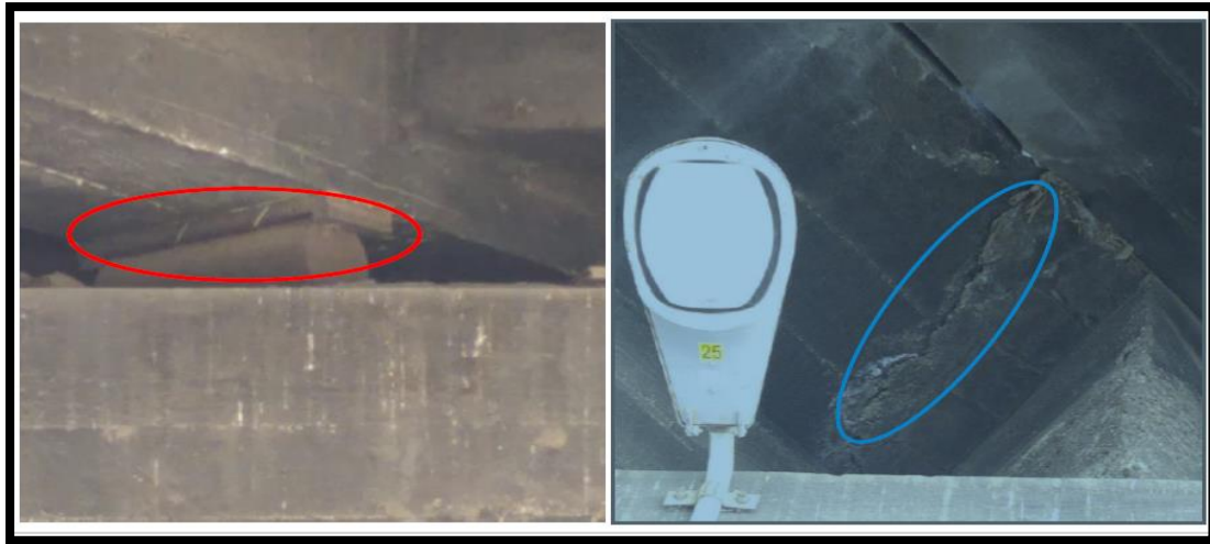
Figura 12.- Se observa que el Aparato de Apoyo de la viga central en la progresiva 0+78.90 presenta Inoperancia, toda vez que ha sido reemplazado por madera. También observamos la grieta Generada en la parte inferior del tablero.
