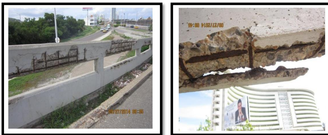
Figura 05.-Exposición de acero en barandas.
