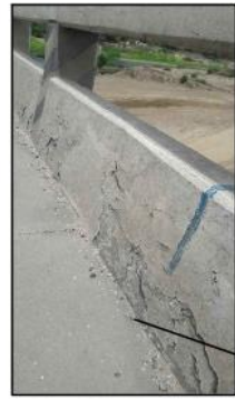
se observa fisuras en la vereda
