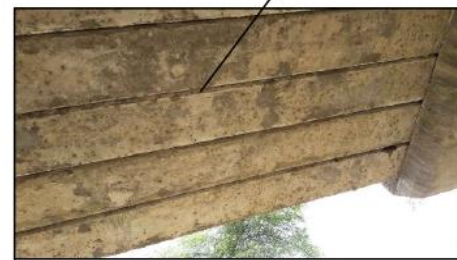
se observa corrosion en su estructura
