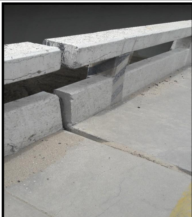
Desplazamiento de las barandas de concreto
