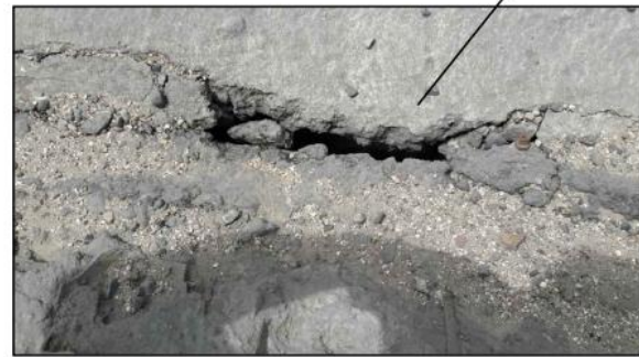
notese grieta considerable en la capa asfaltica
