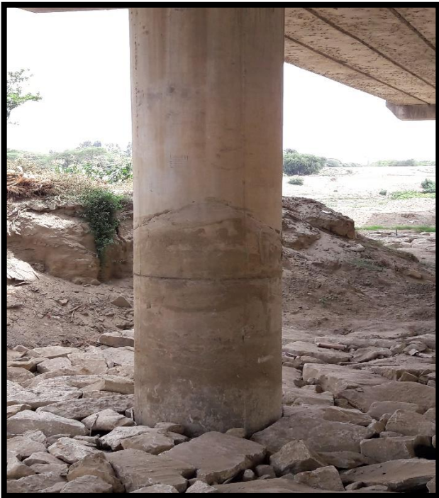
Eflorescencia en el pilar
