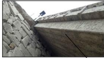
se distingue suciedad en la losa longitudinal cerca al estribo
