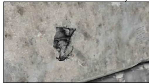
se distingue descascaramiento en la parte central de la losa
