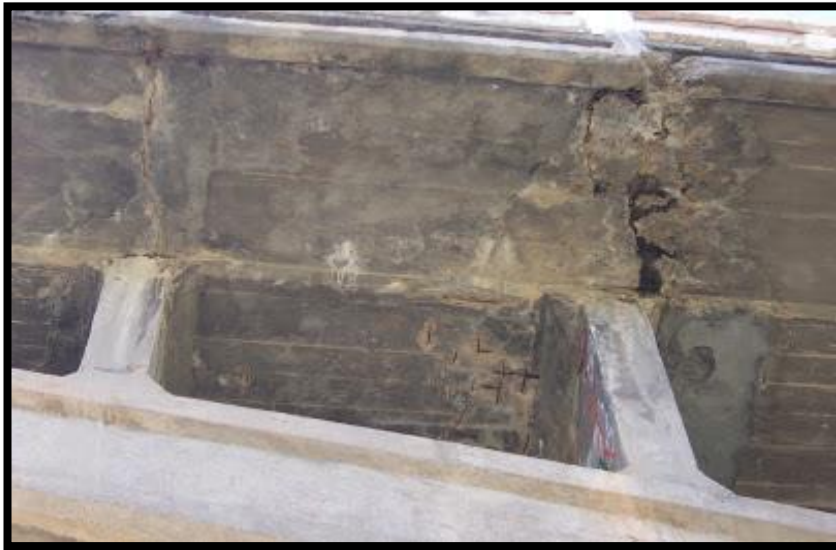
Figura 46. –fisuras en la superestructura del puente.
