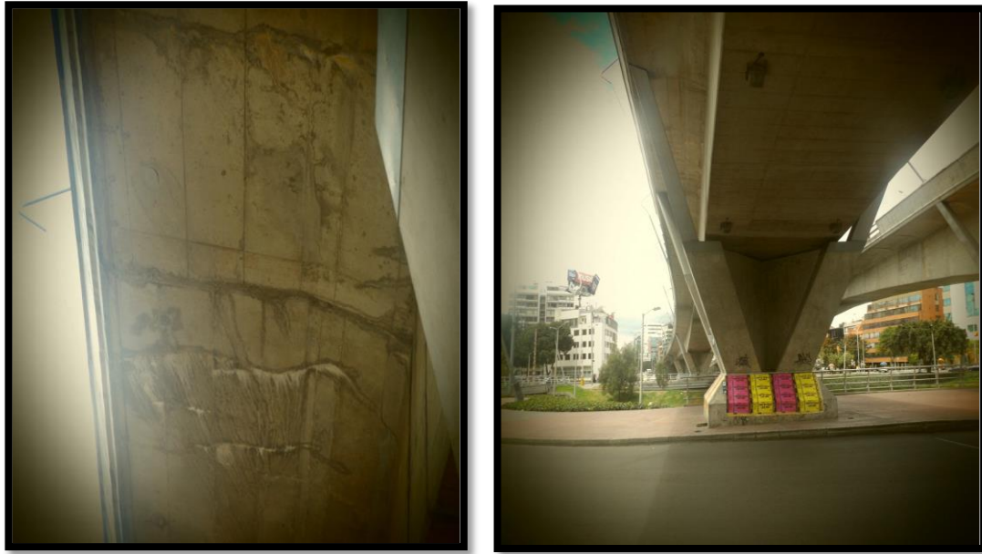
Figura 49. –se observa presencia de humedad debido a reacción externas.
