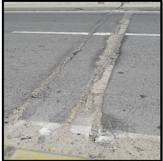
Grietas en juntas de dilatación
