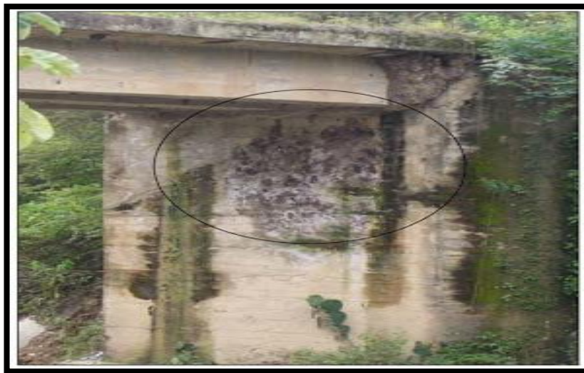
Figura 51. –se observa presencia de sales en la estructura
