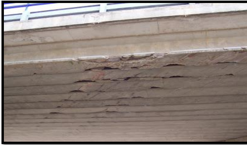
Figura 52. –Nótese deterioro de la estructura de hormigón pretensado.
