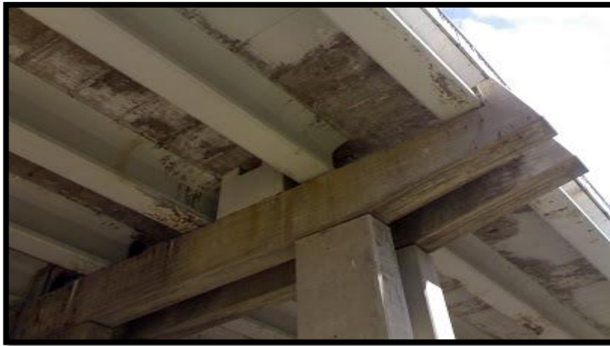
Figura 47. –corrosión en ambas vigas del puente
