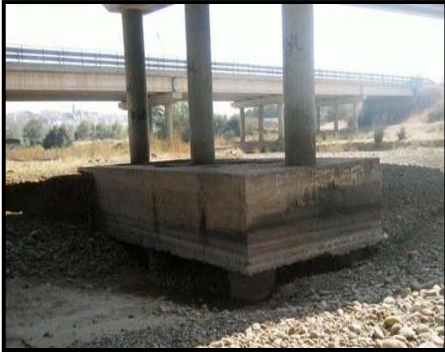
Figura 61. –nótese la erosión ocurrida en la base de las pilas
