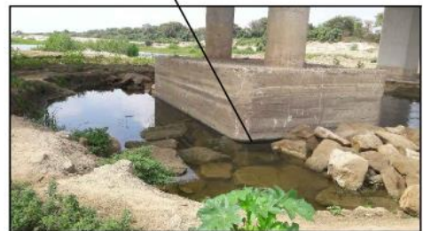
notese eflorescencia en la zapata del pilar
