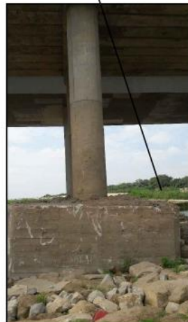
nótese socavación en el pilar
