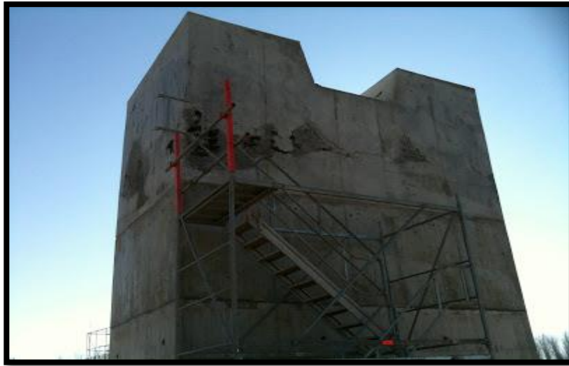
Figura 60. –coquetas generadas por falta de compactado de concreto
