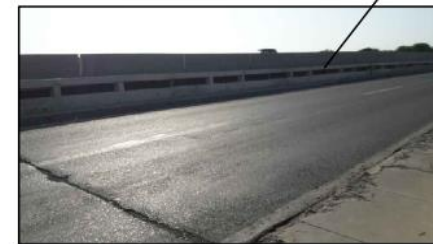
se observa pulimento en el lado extremo del puente
