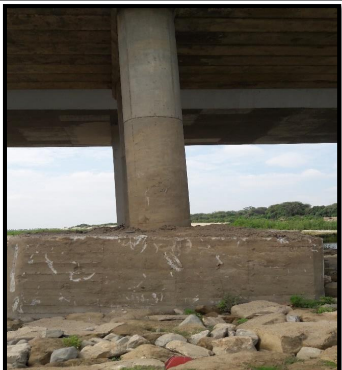
Socavación de zapata
