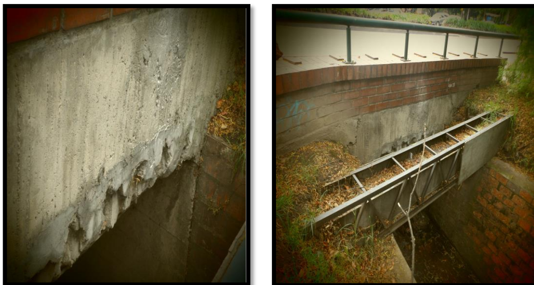
Figura 50. –se observa presencia de hormigqueo.
