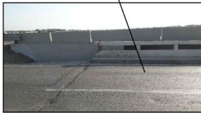
se observa pulimento en el pavimento
