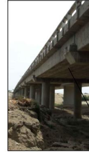
se distingue presencia de agentes corrosivos en el apoyo de C° A°
