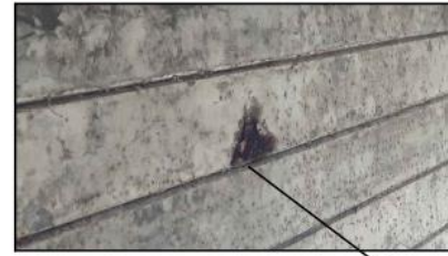
presencia oxidacion en la losa
