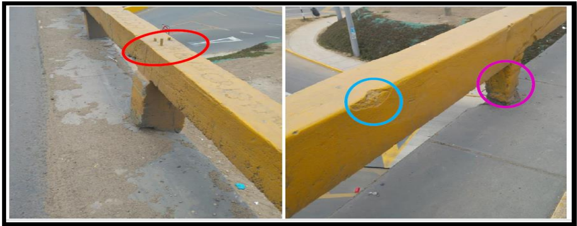
Figura 15.- Se observa sobre la losa de aproximación hacia el oeste, acero vertical expuesto. En la otra Toma se observa fisuras diagonales, despostilla miento y desgaste del concreto en las barandas De concreto sobre el puente.
