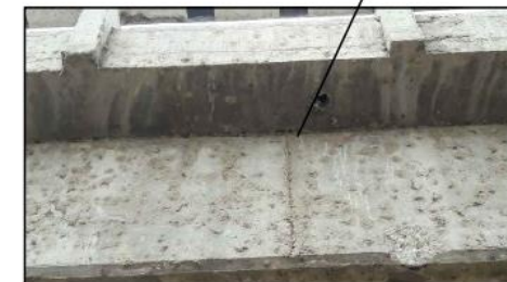
desprendimientos en la parte lateral de la viga del puente
