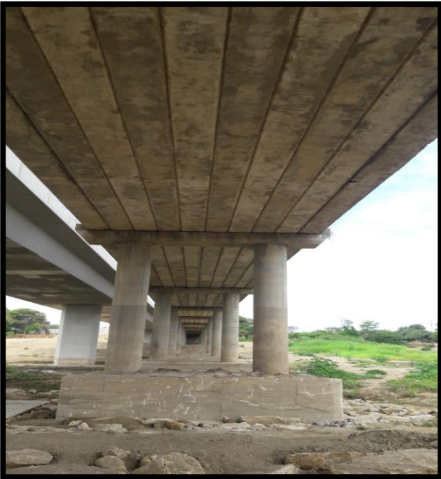
Manchas en la losa
