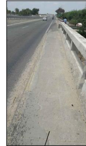
se observa fisuras en la parte central de la vereda
