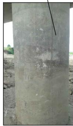
se observa presencia de decoloracion
