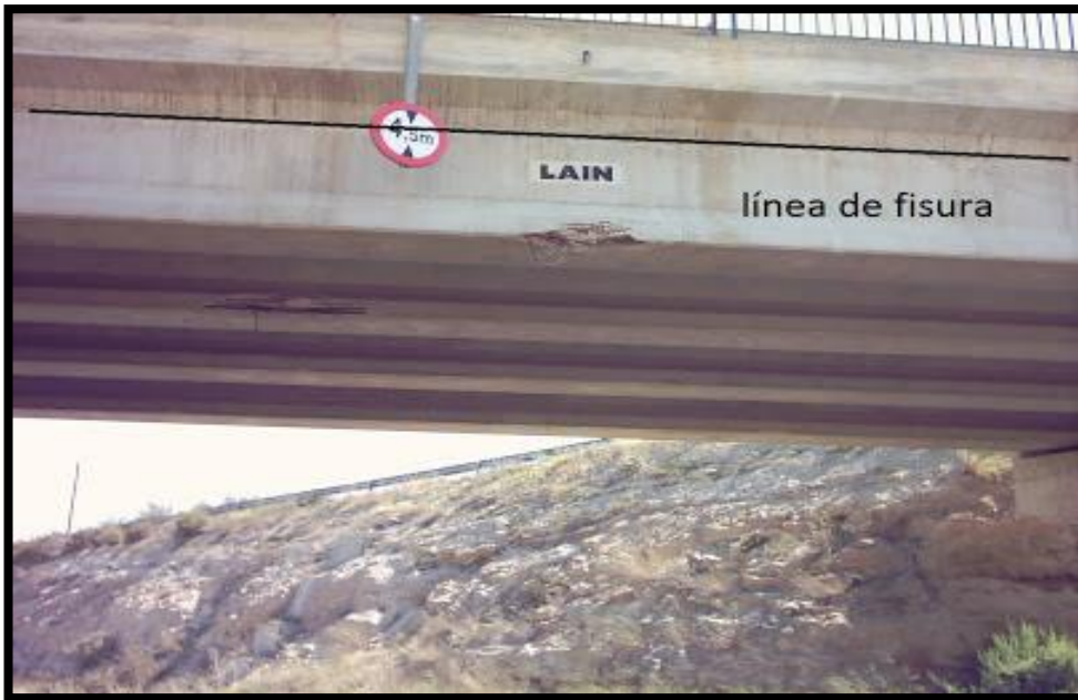
Figura 62. –se observa descascaramiento en la viga por efecto de la deformación de la Estructura
