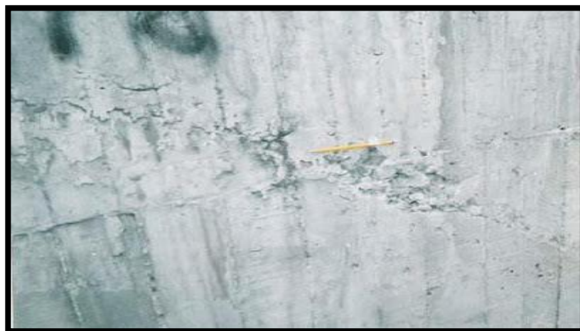
Figura 57. –se observa el deterioro de las juntas frías.
