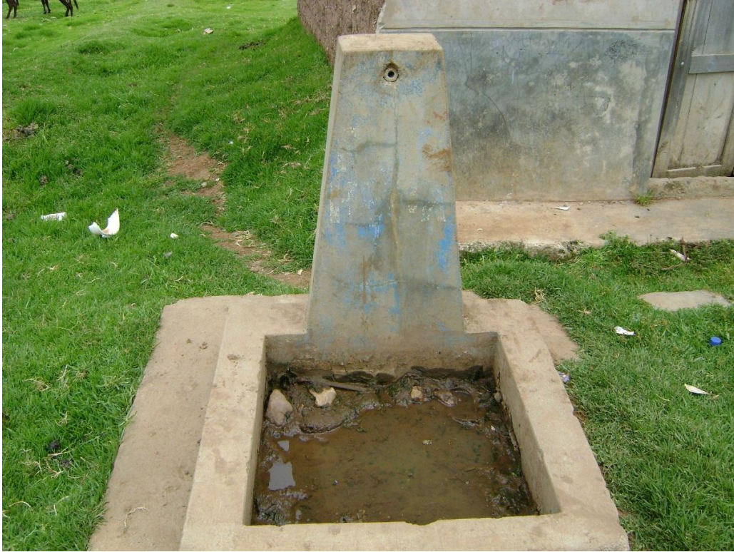
Foto 05: Posos en mal estado.
