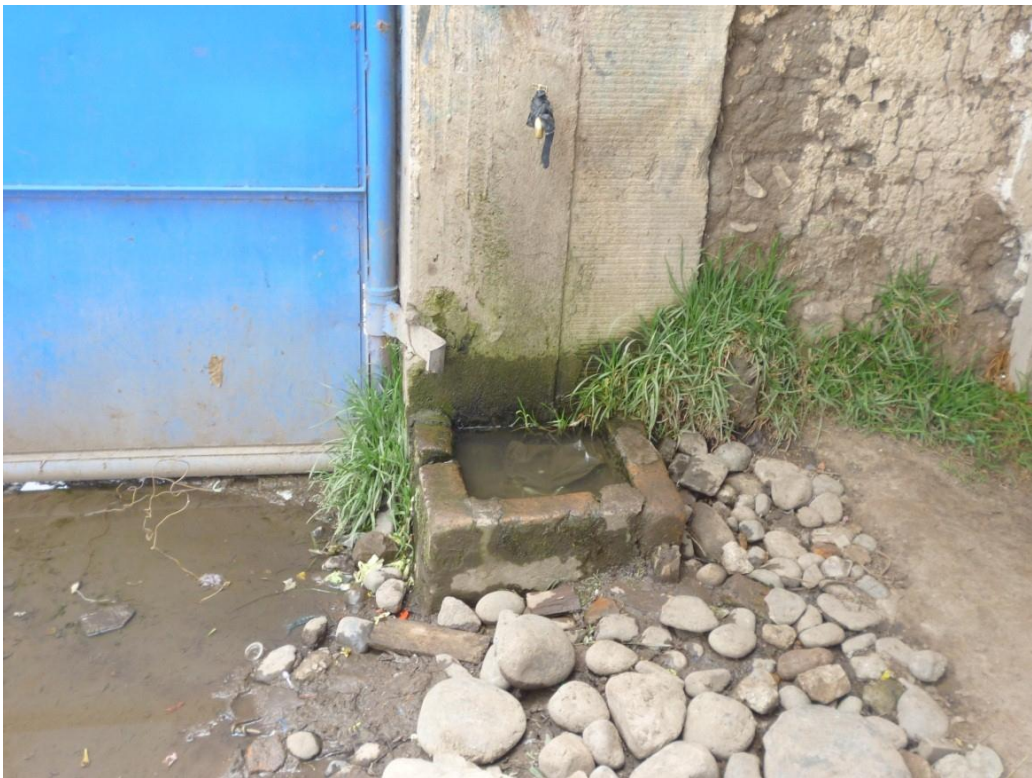
Foto 04: Posos en mal estado en las viviendas de los beneficiarios.
