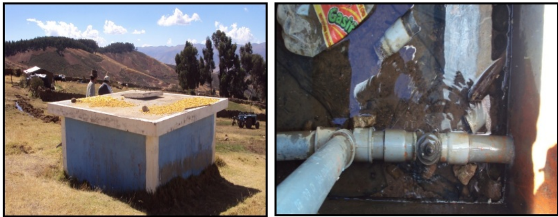
Figura 4.7: Vista del reservorio de almacenamiento de 10.0 m 3 de la comunidad de Virgen del Carmen y la caja de válvulas del reservorio en malas condiciones
