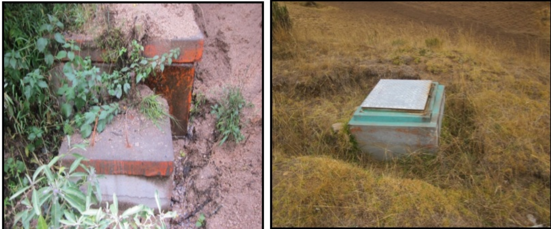
Figura 4.12: Vista de la captación de manantial tipo C-1 y cámara rompe presión tipo 6 del sistema de agua potable de la comunidad de Santa Bárbara de Uchuymarca en estado de deterioro.
