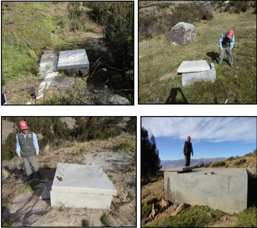
Figura 4.5: Vista de la cámara rompe presión tipo 6 y reservorio existentes respectivamente en regular estados de conservación
