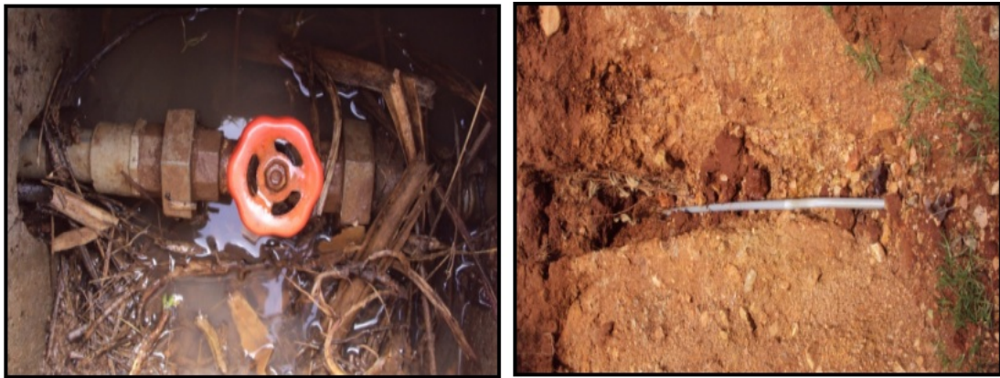
Figura 4.15: Vista de la caja de válvulas de control en malas condiciones y tubería a la intemperie producto de las excesivas lluvias en el lugar.
