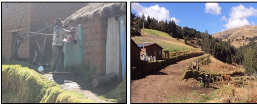
Figura 4.13: Vista de la captación de manantial tipo C-1 y cámara rompe presión tipo 6 del sistema de agua potable de la comunidad de Santa Bárbara de Uchuymarca en estado de deterioro.
