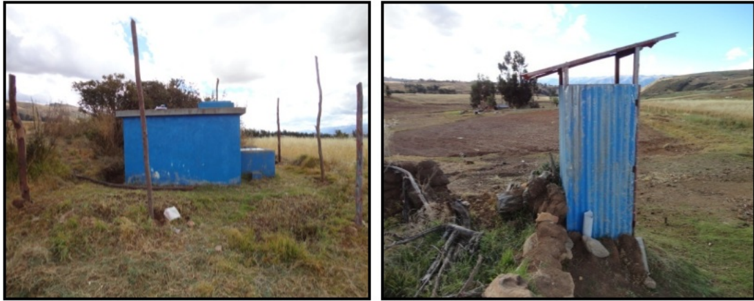
Figura 4.9: Vista del reservorio de almacenamiento de 7.0 m 3 de la comunidad de San Pedro de Quicato y de la existencia de letrinas de hoyo seco con antigüedad de más de 05 años totalmente colmatada.
