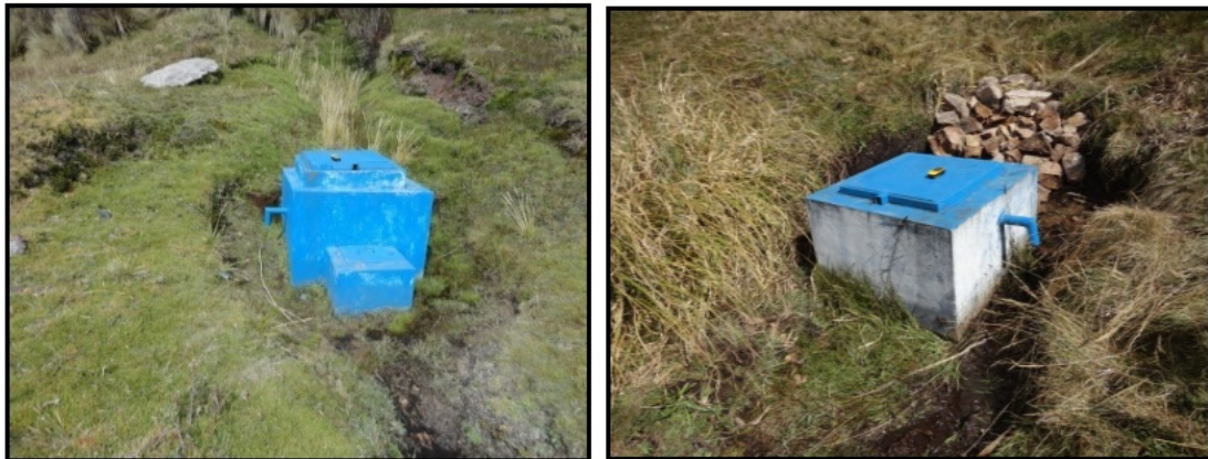
Figura 4.8: Vista de la captación tipo C-1 y cámara rompe presión tipo 6 respectivamente de la comunidad de San Pedro de Quicato
