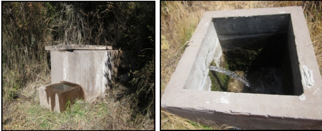
Figura 4.6: Vista de la captación y cámara rompe presión tipo 6 respectivamente
