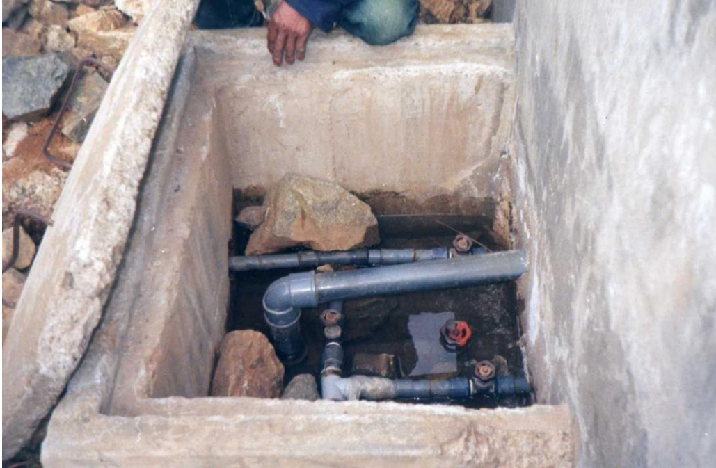
Foto 01: Vista de tubería del reservorio
