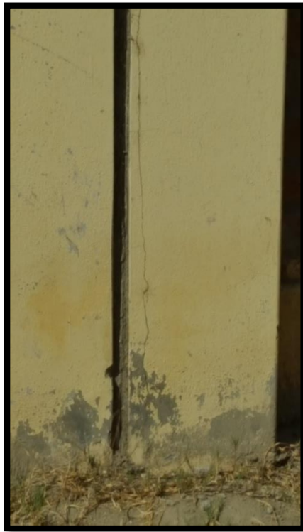
FIGURA 4: FISURACIÓN FUENTE: ELABORACIÓN PROPIA
