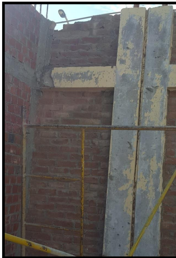
FIGURA 7: DESPRENDIMIENTO FUENTE: ELABORACIÓN PROPIA.
