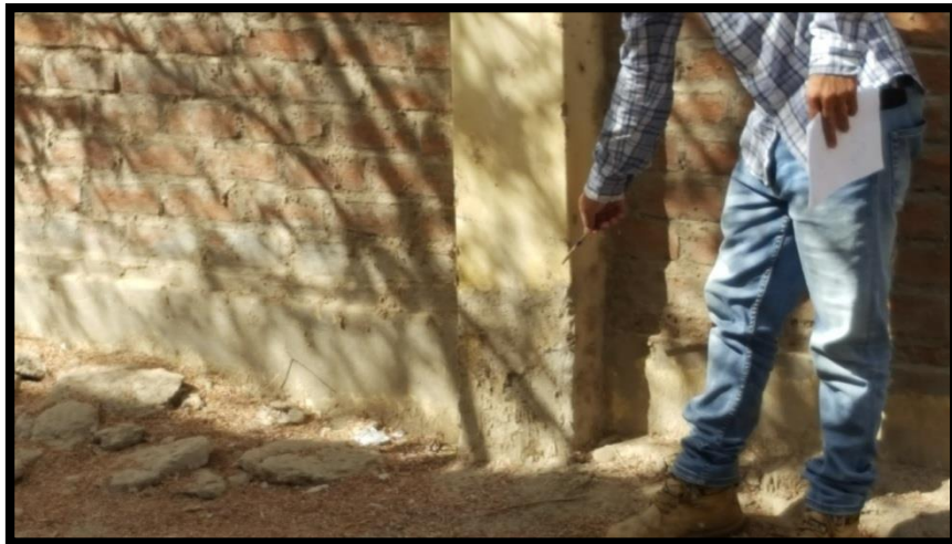
FIGURA 6: HUMEDAD (FILTRACIÓN) FUENTE: ELABORACIÓN PROPIA.
