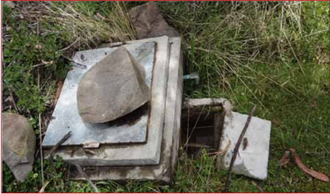
Figura 4.3: Se Muestra la Captación
