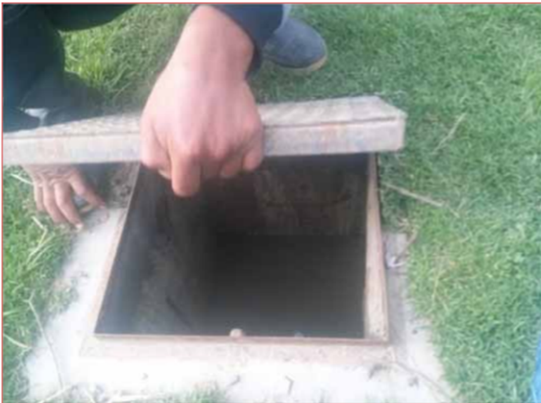
Figura 4.16: Se muestra una cámara en pésimas condiciones
