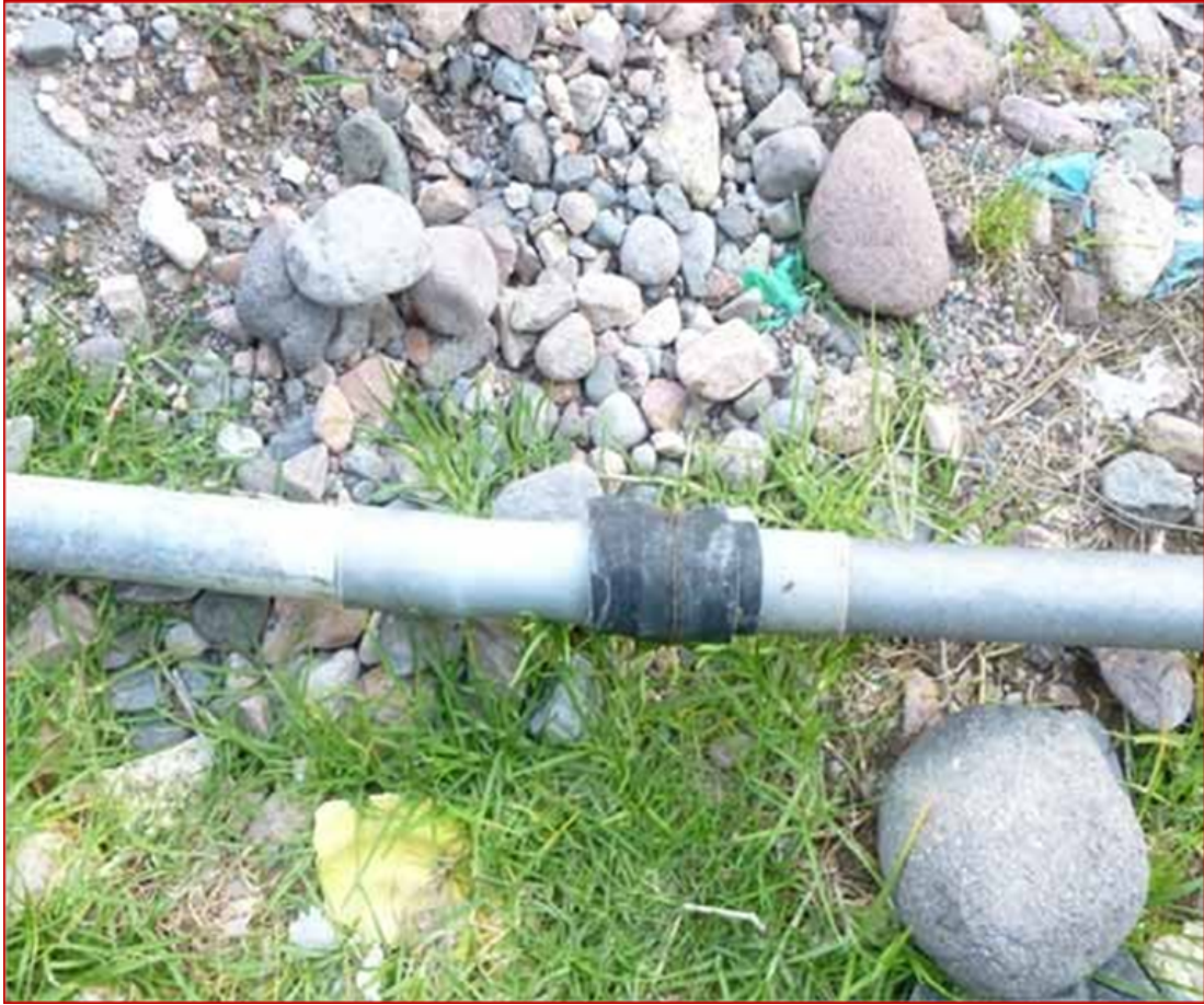
Figura 4.4: Tuberías descubiertas en la línea de conducción
