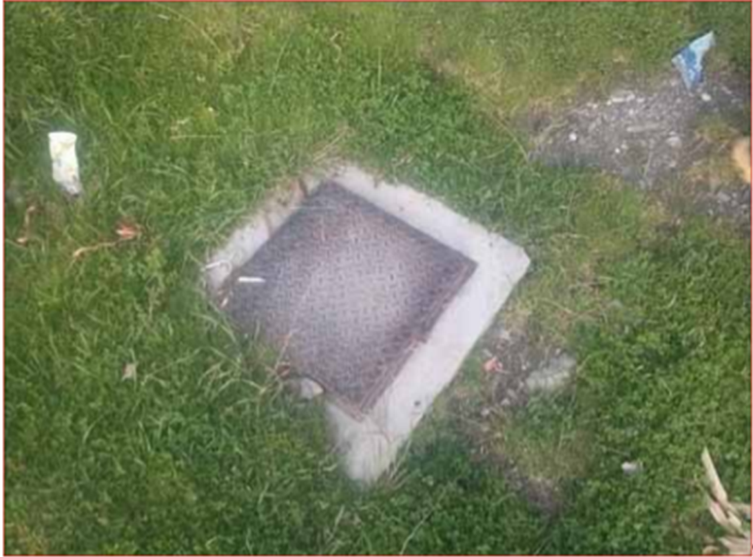
Figura 4.17: Una cámara en pésimas condiciones.
