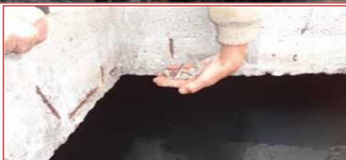
Figura 4.13: Se observa la caja de valvulas presenta fisuras
