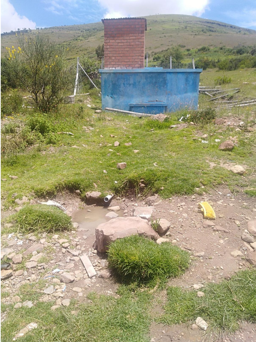
Foto 05: Vista panorámica del sistema de agua potable del lugar.
