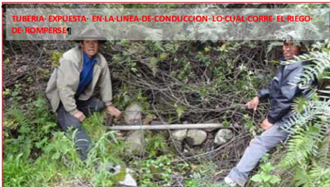
Figura 4.11: Tubería expuesta en la línea de conducción
