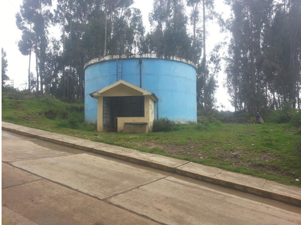
Foto 01: En esta toma fotografica podemos observar el reservorio y la caseta de valvulas de sistema instalado en la ciudad de Vilcashuamán.
