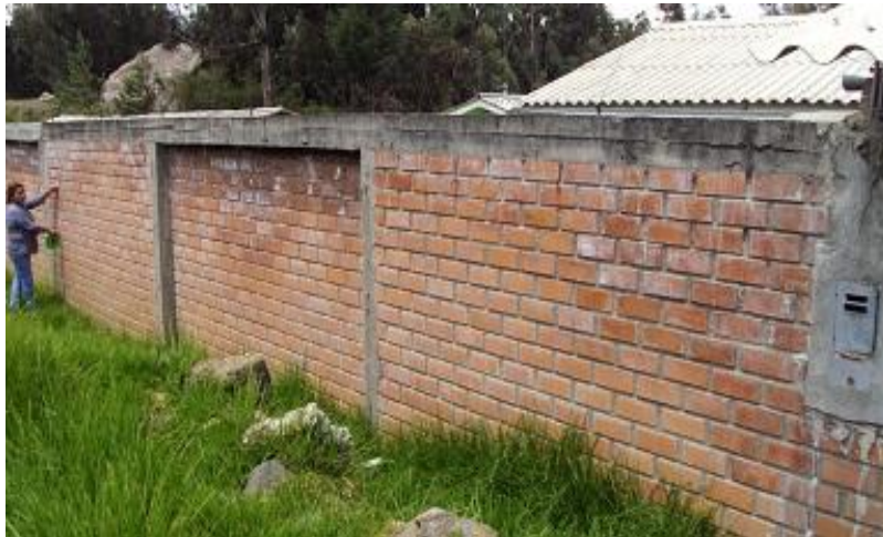
Vista: Eflorescencia en muro
