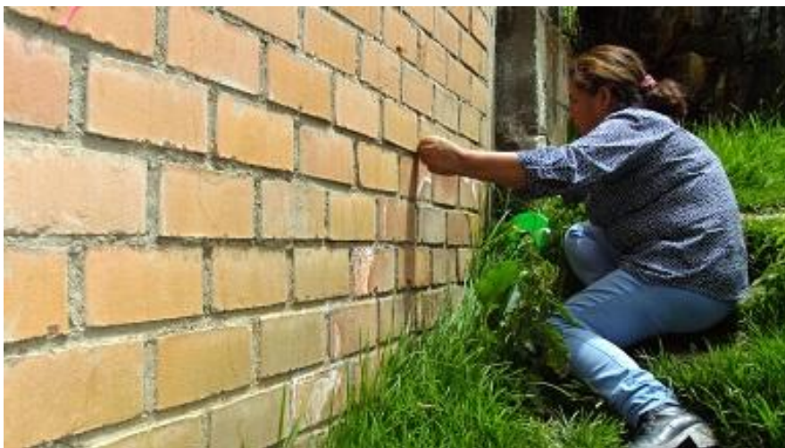
Vista de evaluación de la patología: Eflorescencia
