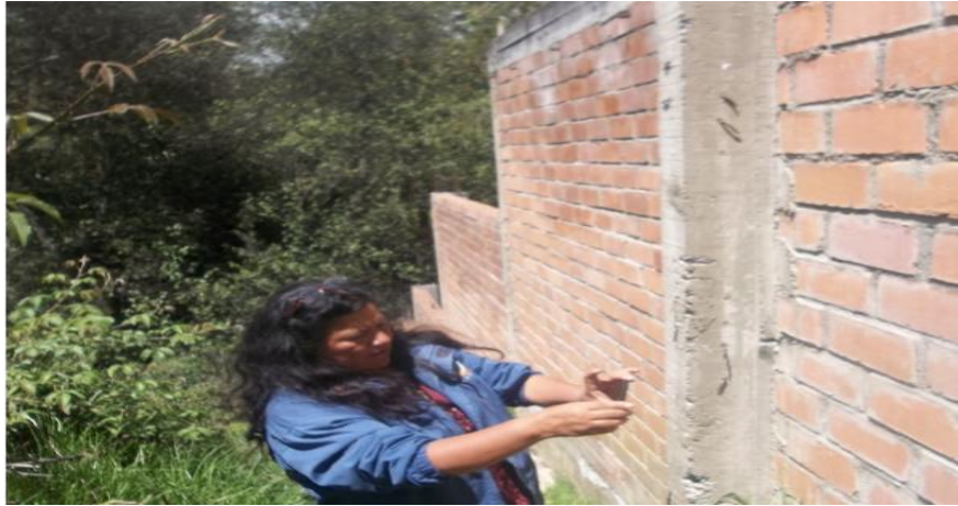
Vista de evaluación de la patología por tesista
