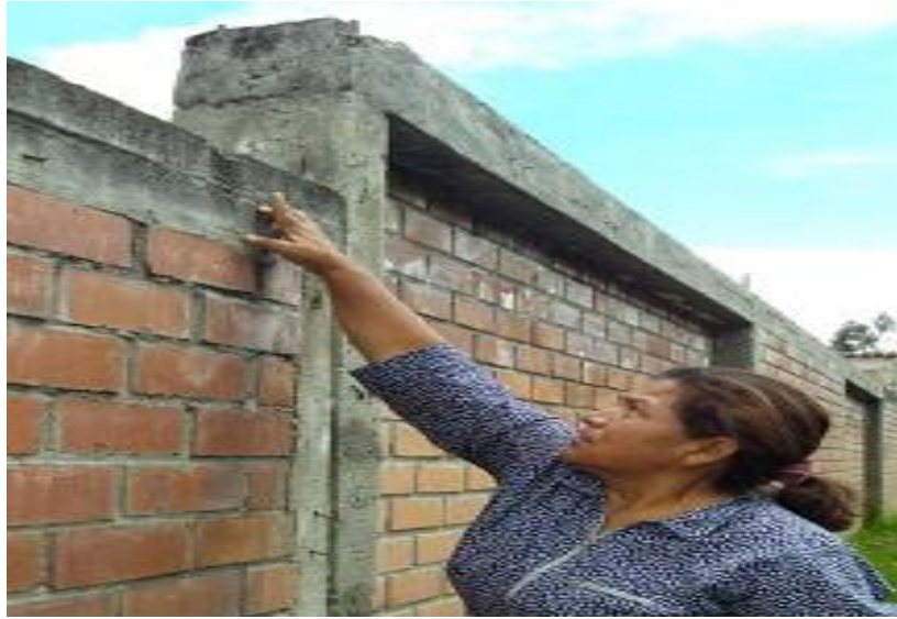
Vista: Erosión en viga
