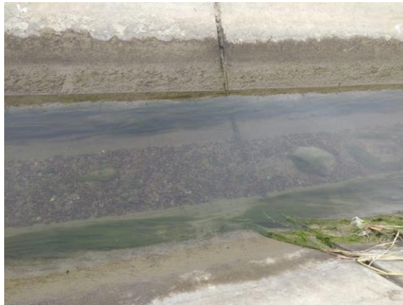
Imagen 6: Erosión en muros del canal.
