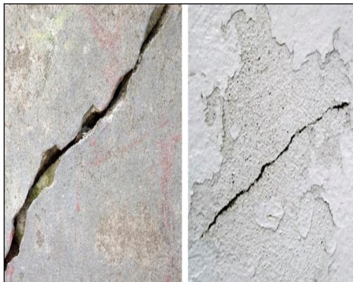
Imagen 8: Grieta y fisura en la estructura.
