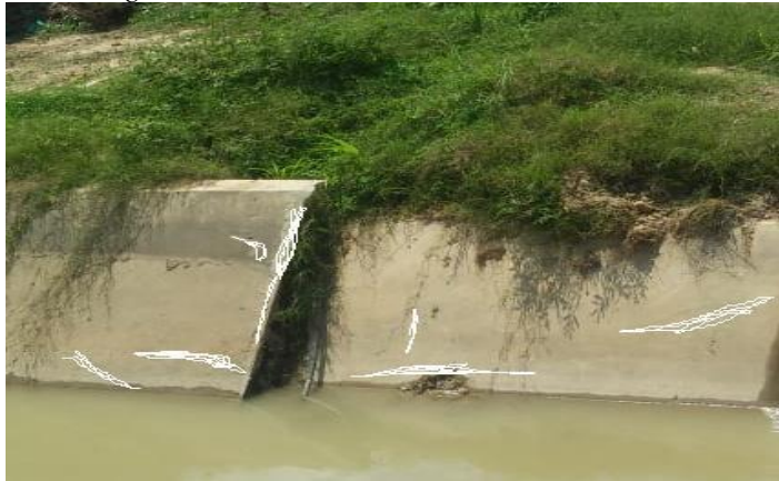
Imagen 10: Eflorescencia en losas del canal.
