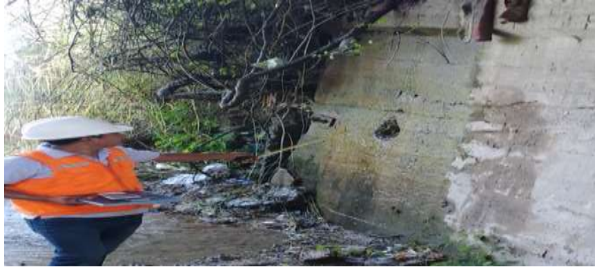
Imagen 14: Humedad en estribo
