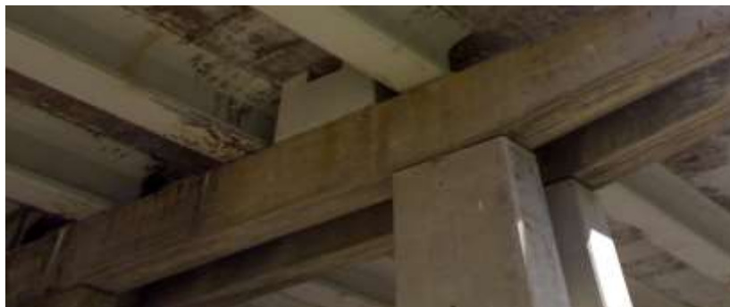
Imagen 13: Patologías en vigas pretensado - eflorescencia. Fuente: blog de hidrodem; 2013: seriada en línea Hidroden.com.
