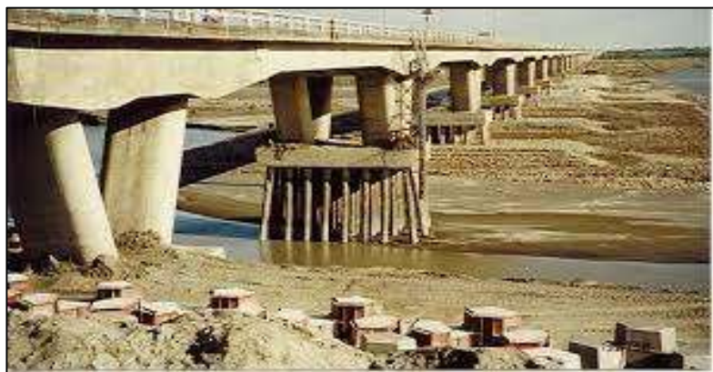
Imagen 16: Erosión de Puente.
