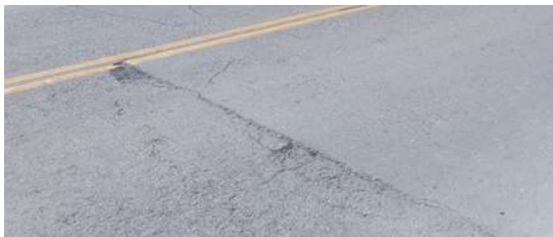
Imagen 17: Deterioro del Concreto - Popout.
