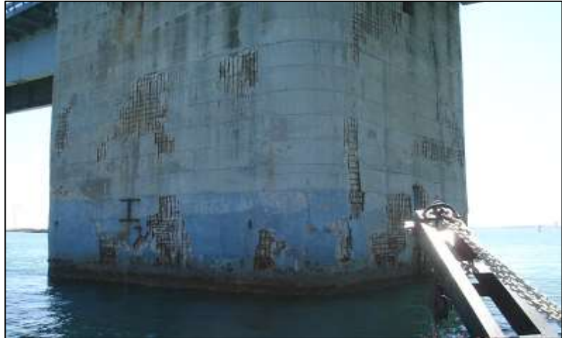
Imagen 28: Corrosión en la Armadura.
