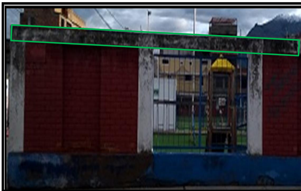
Patología Moho en Viga
