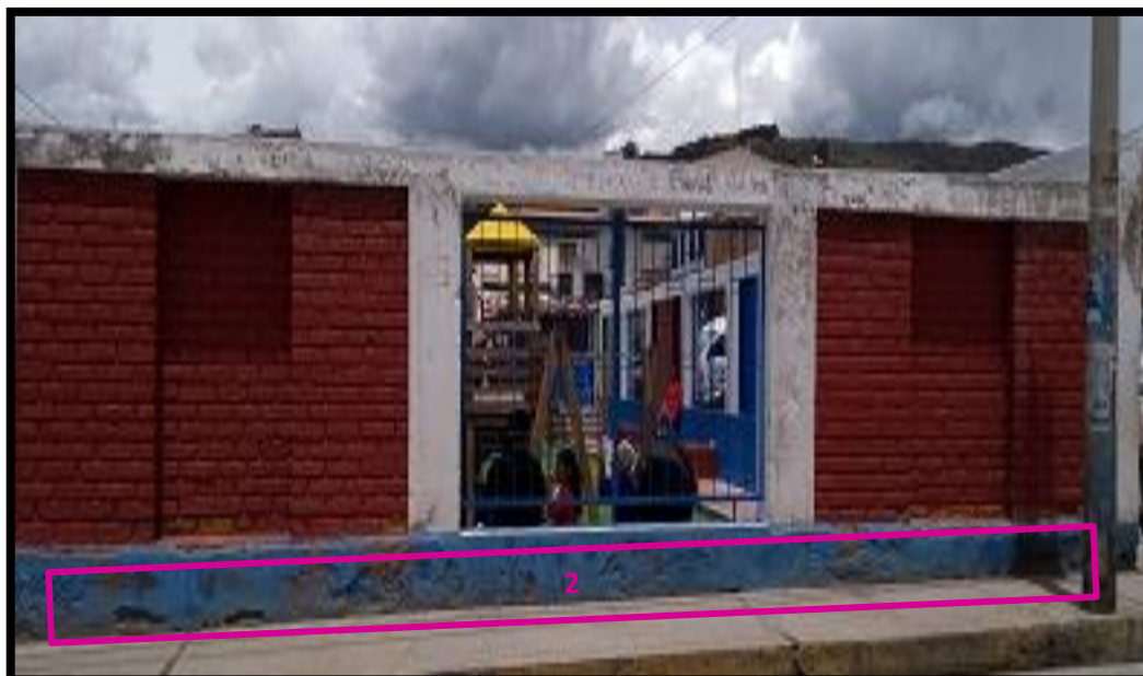
Patología Desprendimiento en Sobre Cimiento
