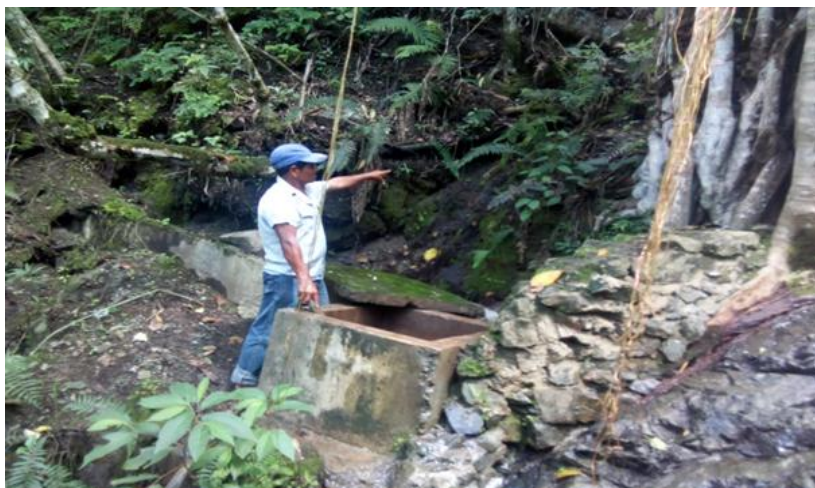
Fotografía 2: Captación la palta en mal estado
