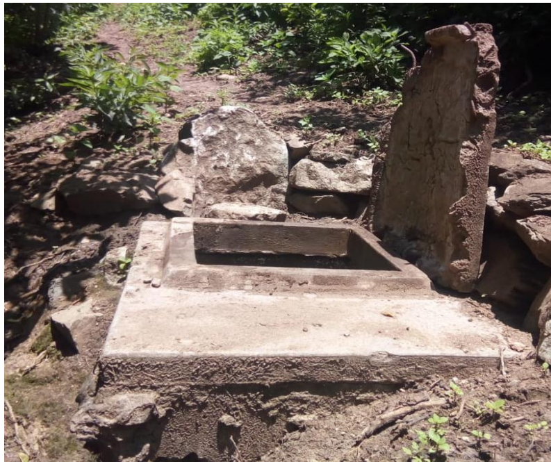
Fotografía 5: Cámara rompe presión en mal estado
