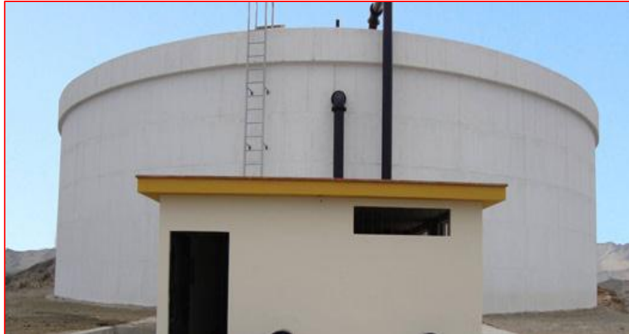
Figura 7: Reservorio Fuente: Grupo Ortiz.
