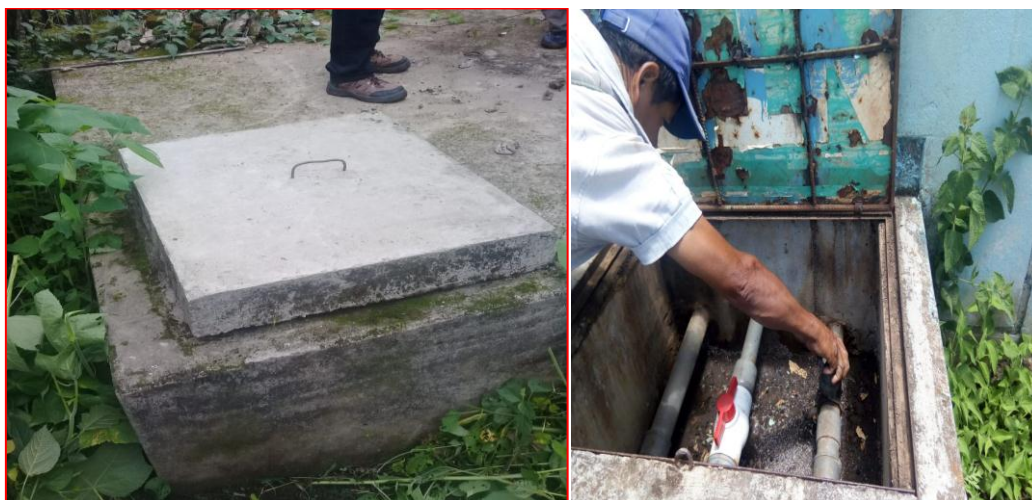
Fotografía 3: Reservorio existente caja de válvulas Fuente: Propia
