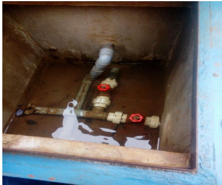
Fotografía 12 Caja de válvula del reservorio
