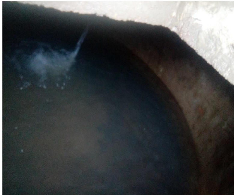
Se puede observar el estado de las paredes internas debido a la falta de mantenimiento del reservorio y un poco de turbiedad del agua
