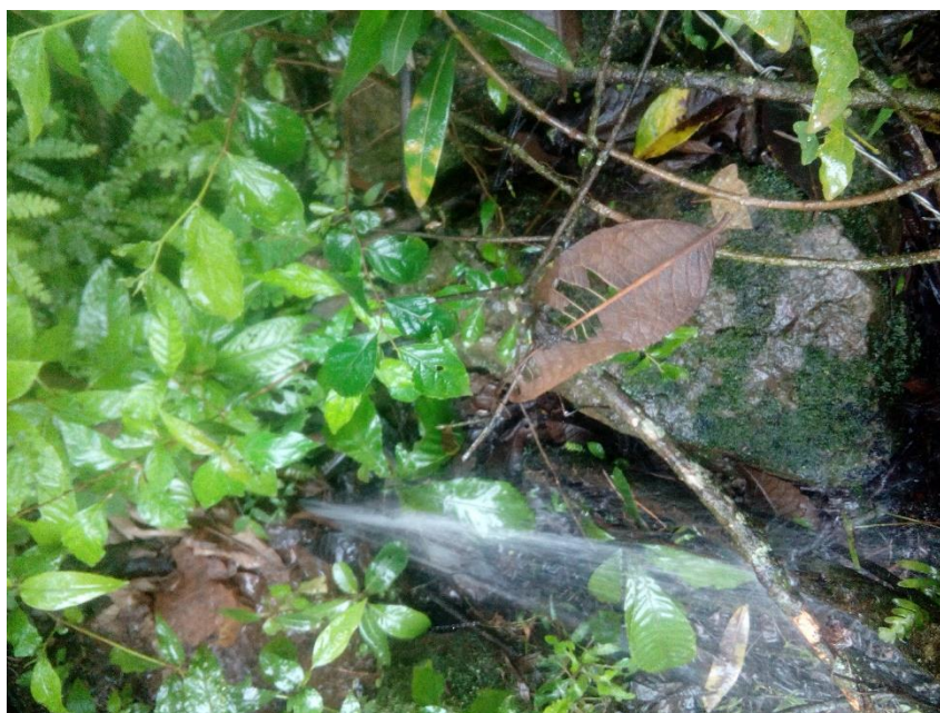
Fotografía 144. Tubería existente con fugas de agua
