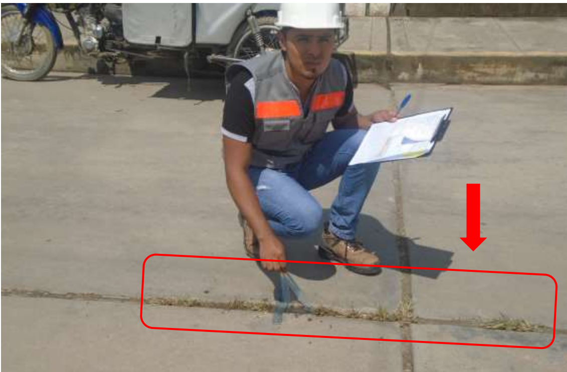
Figura 186. En la fotografía se observa la patología daño del sello de la junta, también se aprecia crecimiento de vegetación de la unidad de muestra 4.
