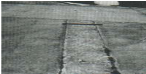
Figura 26. Parche Grande y Acometidas de Servicios Publicos de Severidad Media.
