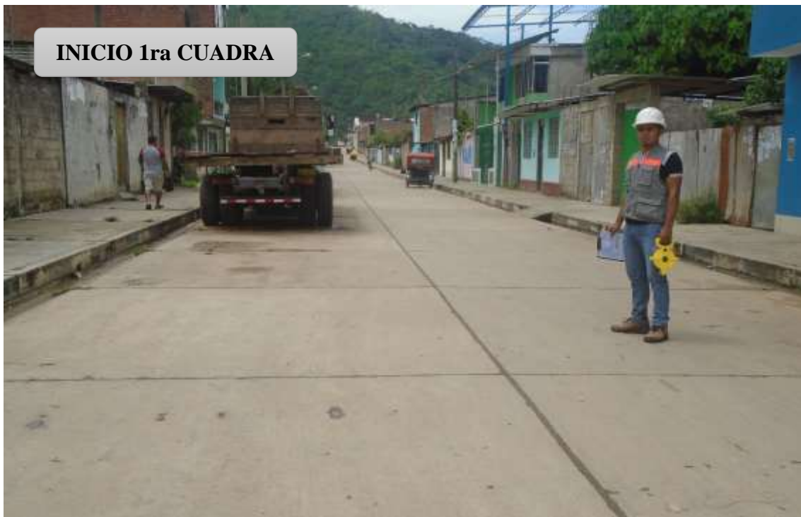
Figura 149. En la fotografía se observa el inicio de la 1ra cuadra del Jirón Rubén Callegari, seleccionada como unidad de muestra 1.
