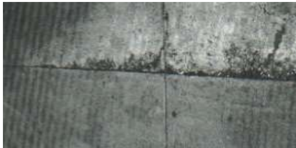
Figura 49. Descascaramiento de Junta de Severidad Media.
