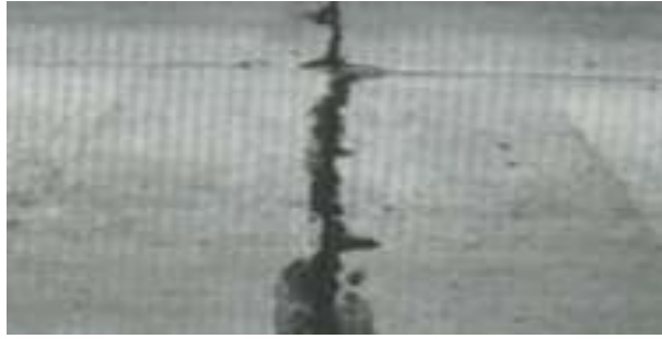
Figura 16. Daño del Sello de la Junta de Baja Severidad.
