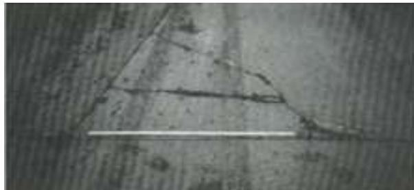
Figura 05. Grietas de Esquina de Severidad Media.
