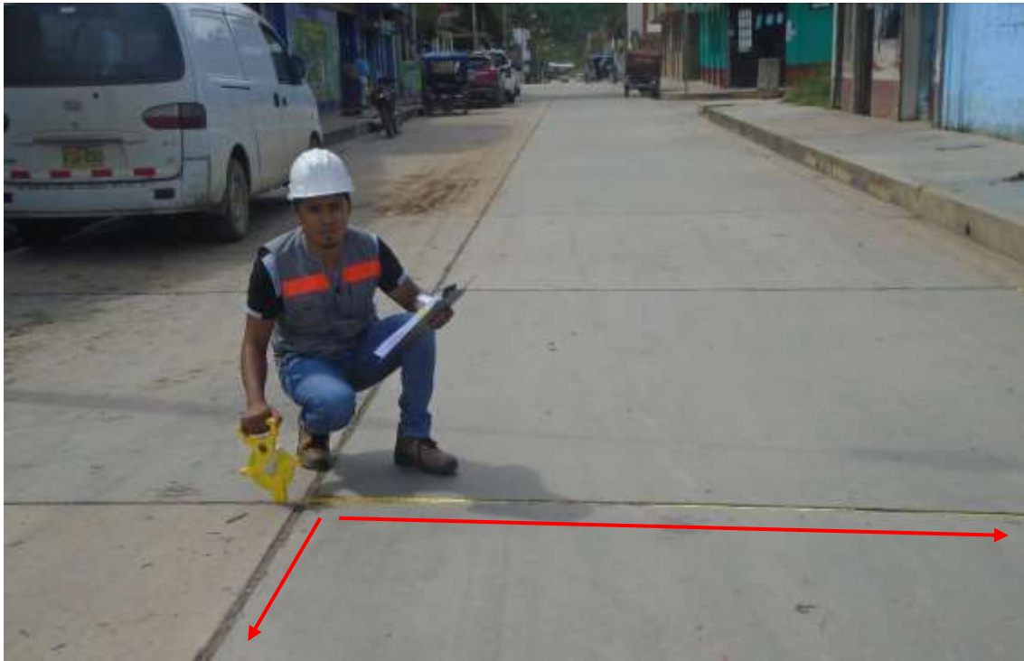
Figura 187. En la fotografía se observa la medición de la losa de la unidad de muestra 5.
