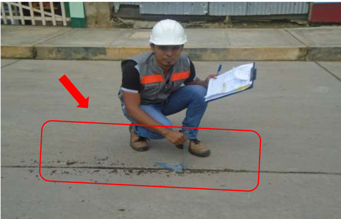
Figura 192. En la fotografía se observa la patología daño del sello de la junta de la unidad de muestra 6.
