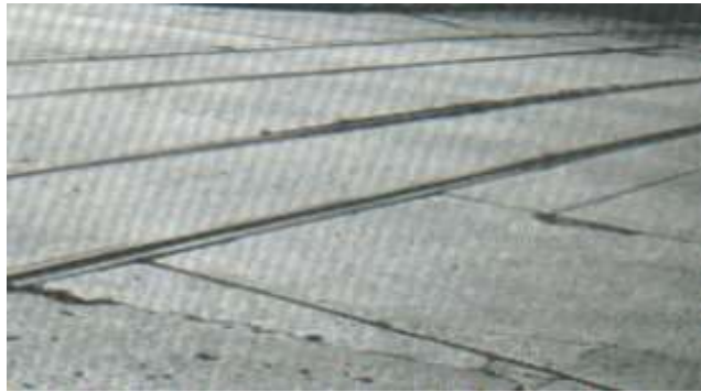
Figura 38. Cruce de Via Férrea de Baja Severidad.
