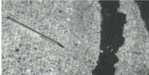
Figura 10. Grieta de Durabilidad de Baja Severidad.
