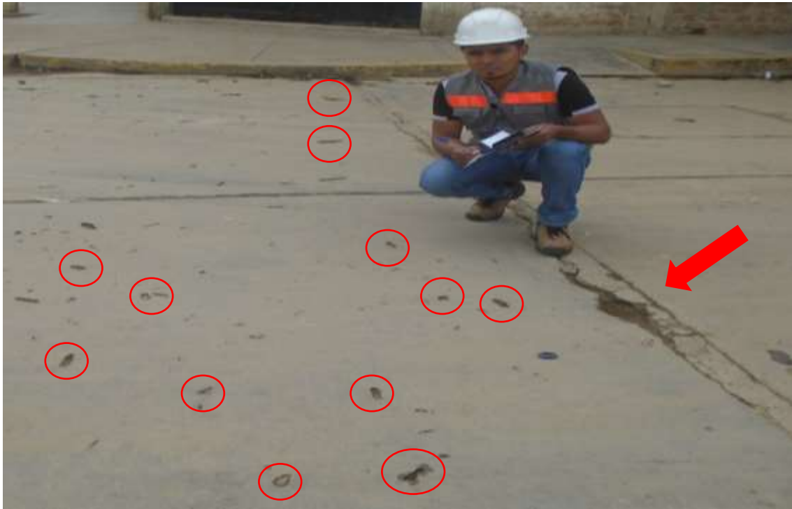
Figura 177. En la fotografía se observa la patología popouts de la unidad de muestra 2.
