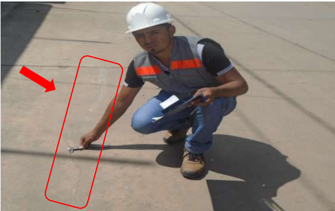
Figura 190. En la fotografía se observa la patología grieta lineales de la unidad de muestra 5.
