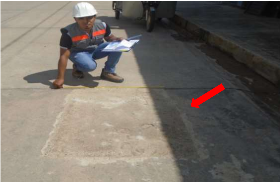
Figura 185. En la fotografía se observa la patología parche grande de la unidad de muestra 4.
