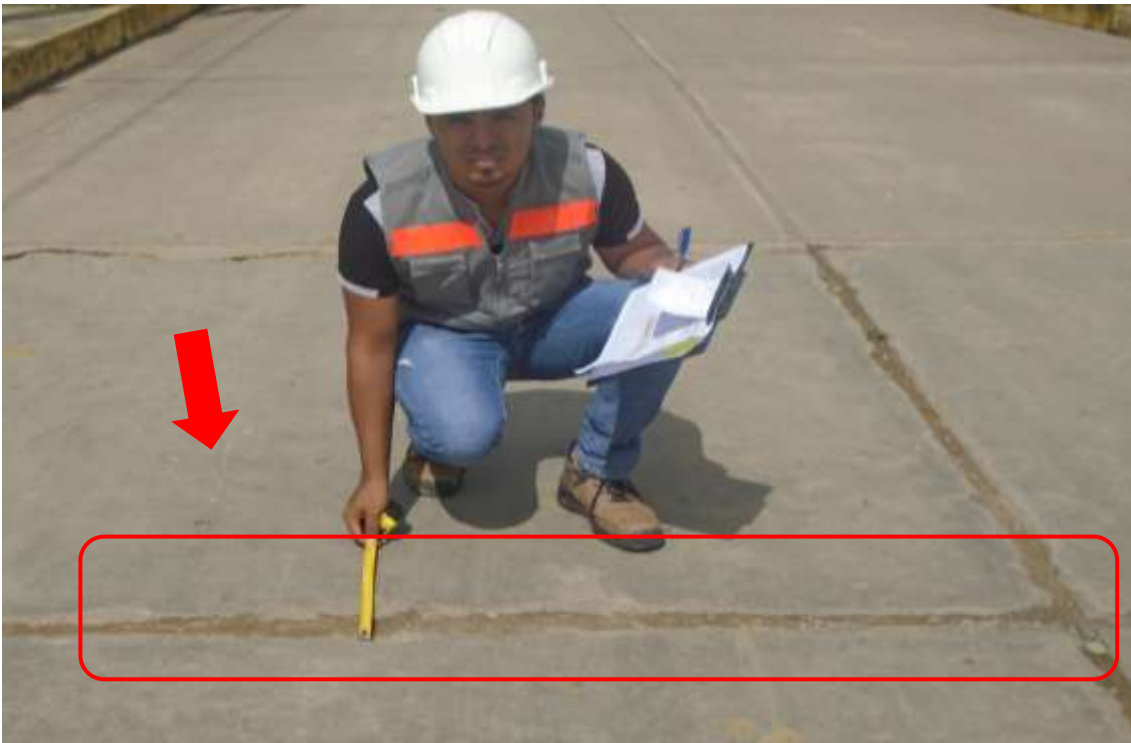
Figura 198. En la fotografía se observa la patología Descascaramiento de junta de la unidad de muestra 7.
