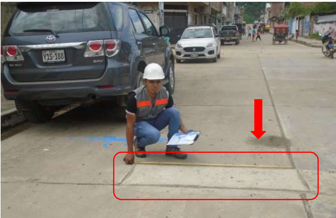
Figura 172. En la fotografía se observa la patología parche grande de la unidad de muestra 1.
