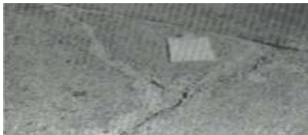
Figura 06. Grietas de Esquina de Alta Severidad.
