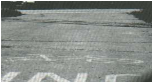
Figura 39. Cruce de Via Férrea de Severidad Media.
