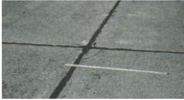
Figura 45. Descascaramiento de Esquina de Baja Severidad.
