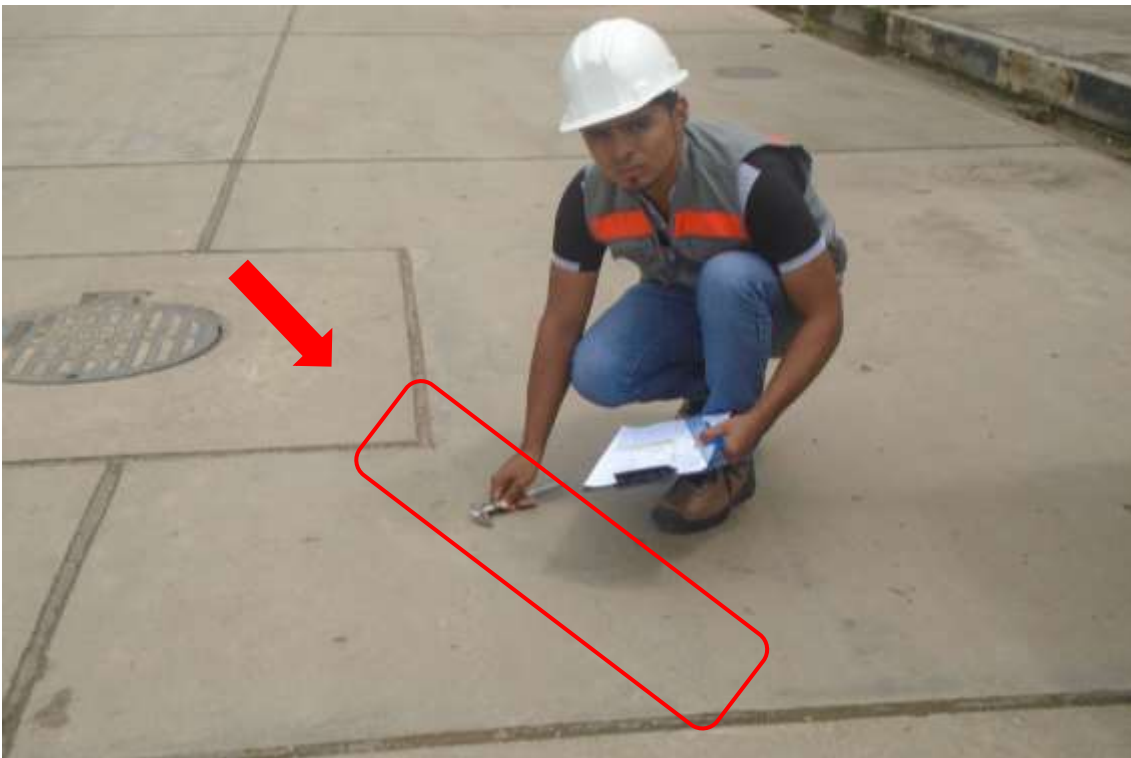
Figura 174. En la fotografía se observa la patología grieta de esquina de la unidad de muestra 1.
