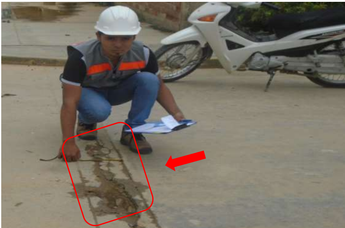
Figura 176. En la fotografía se observa la patología Descascaramiento de junta de la unidad de muestra 2.
