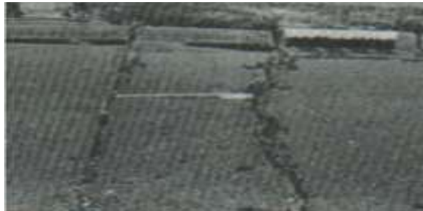
Figura 35. Punzonamiento de Baja Severidad.
