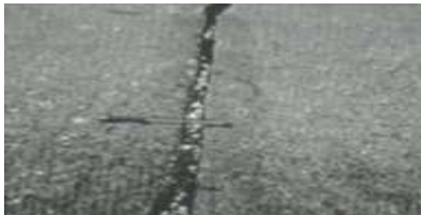
Figura 18. Daño del Sello de la Junta de Alta Severidad.
