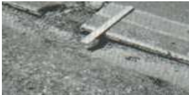
Figura 19. Desnivel/Carril de Baja Severidad.
