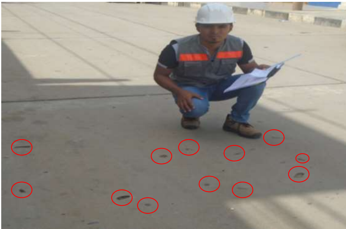
Figura 182. En la fotografía se observa la patología popouts de la unidad de muestra 3.
