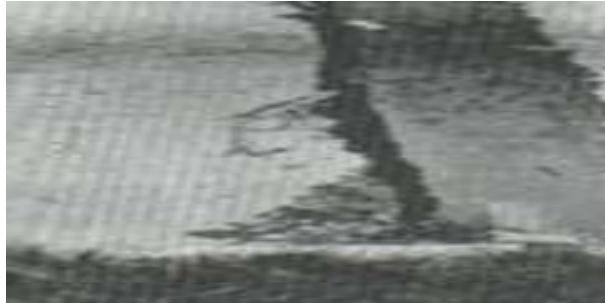
Figura 01. Blowup/Buckling de Baja severidad.
