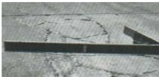
Figura 37. Punzonamiento de Alta Severidad.
