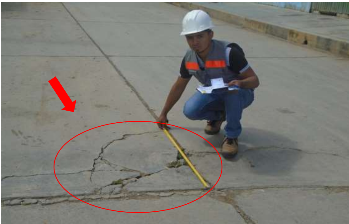
Figura 188. En la fotografía se observa la patología descascaramiento de junta y de esquina, grieta de esquina y lineales de la unidad de muestra 5.
