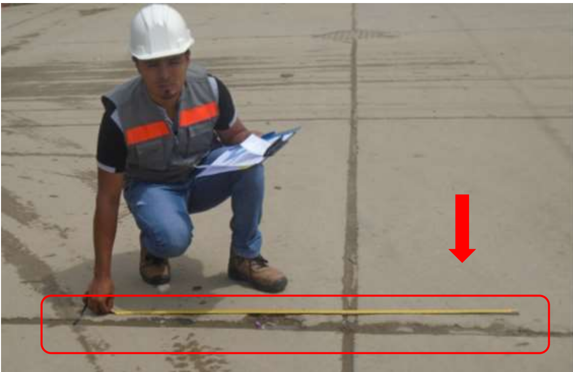
Figura 180. En la fotografía se observa la patología Descascaramiento de junta de la unidad de muestra 3.
