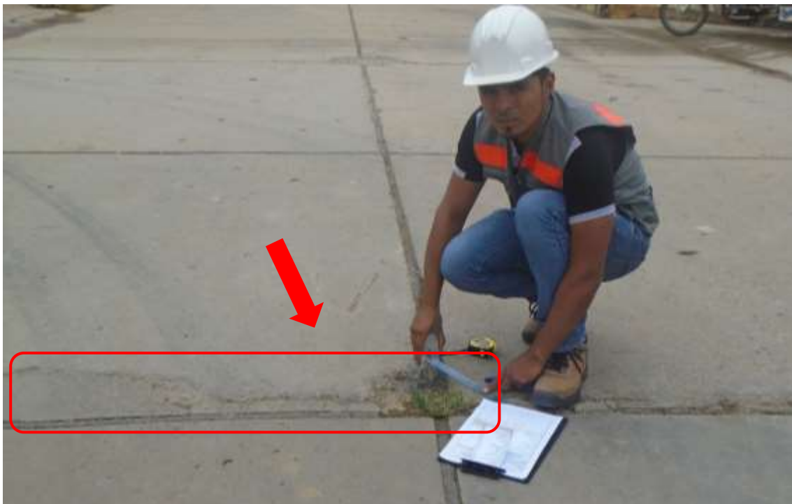
Figura 178. En la fotografía se observa la patología descascamiento de esquina y de junta, también se aprecia el crecimiento de vegetación de la unidad de muestra 2.
