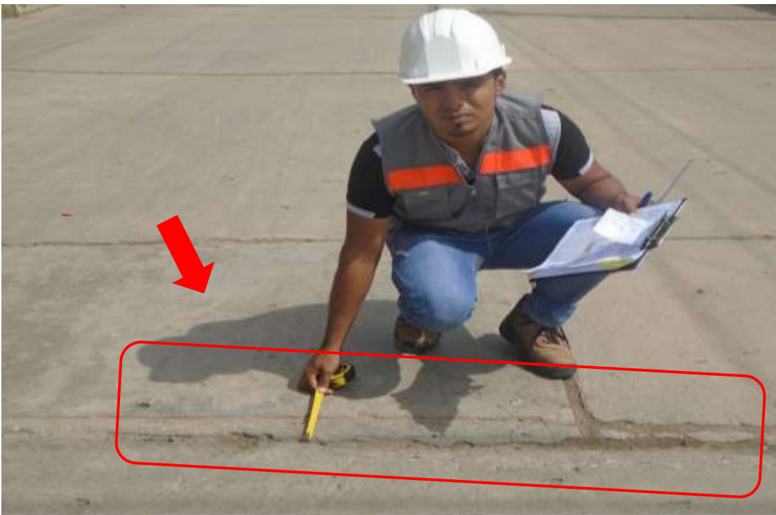
Figura 194. En la fotografía se observa la patología Descascaramiento de junta de la unidad de muestra 6.
