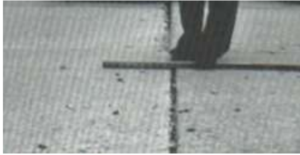
Figura 13. Escala de Baja Severidad.
