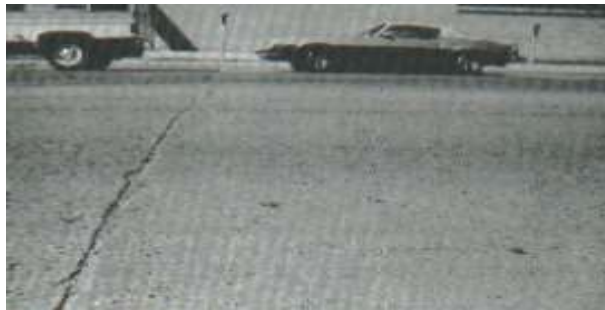
Figura 48. Descascaramiento de Junta de Baja Severidad.
