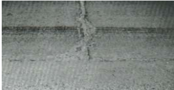
Figura 46. Descascaramiento de Esquina de Severidad Media.
