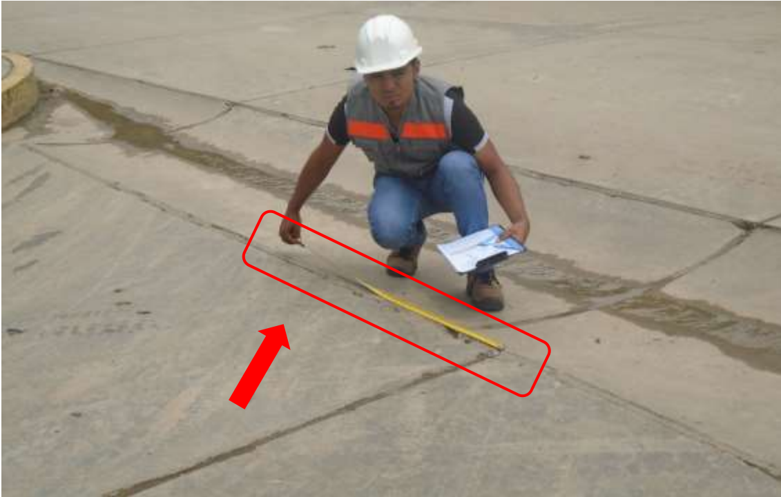
Figura 173. En la fotografía se observa la patología descascaramiento de junta de la unidad de muestra 1.
