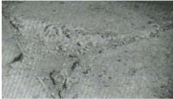
Figura 47. Descascaramiento de Esquina de Alta Severidad.
