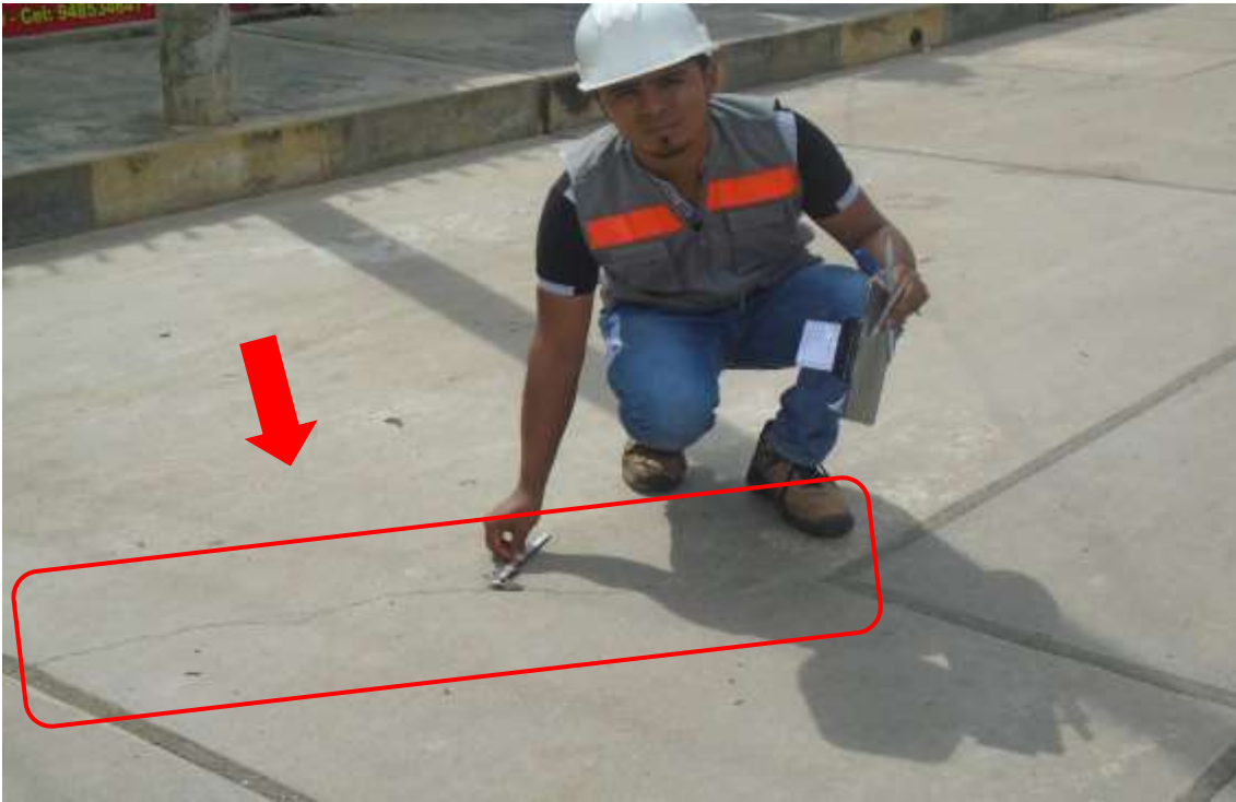
Figura 197. En la fotografía se observa la patología grieta de esquina de la unidad de muestra 7.
