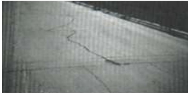
Figura 08. Losa Dividida de Severidad Media.
