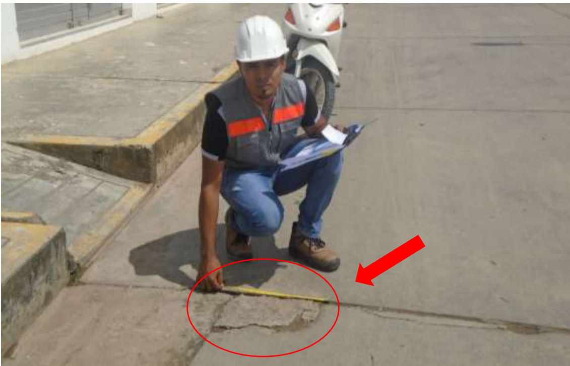
Figura 184. En la fotografía se observa la patología descascaramiento de esquina de la unidad de muestra 4.
