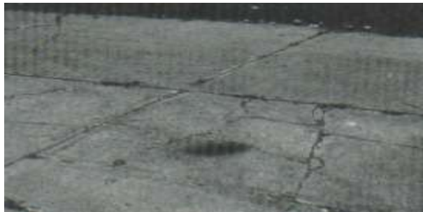
Figura 09. Losa Dividida de Alta Severidad.
