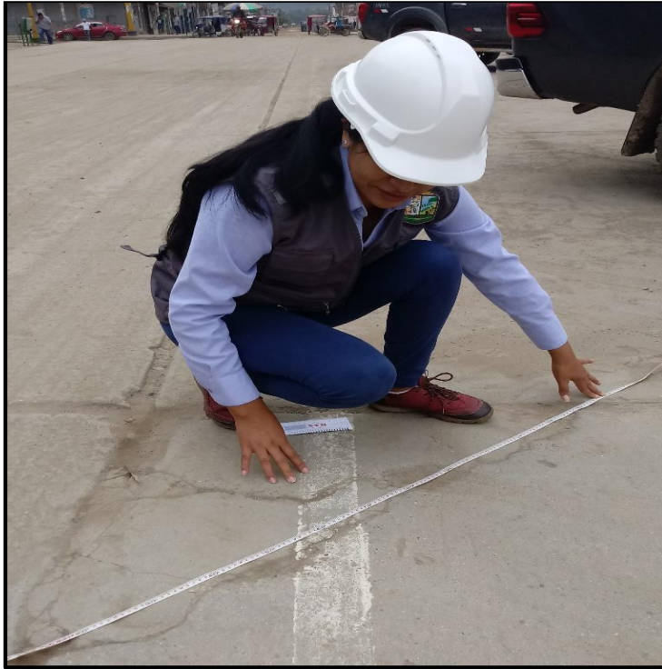
Figura 85: Grieta de esquina en la calle 7 de Junio para la UM-01.
