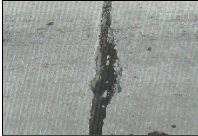
Figura 05: Daño del sello de junta de severidad media Según, Vásquez L. (21) (2012)
