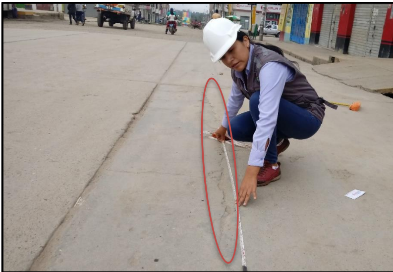
Figura 82: Grietas lineales en la calle 7 de Junio para la UM-01.
