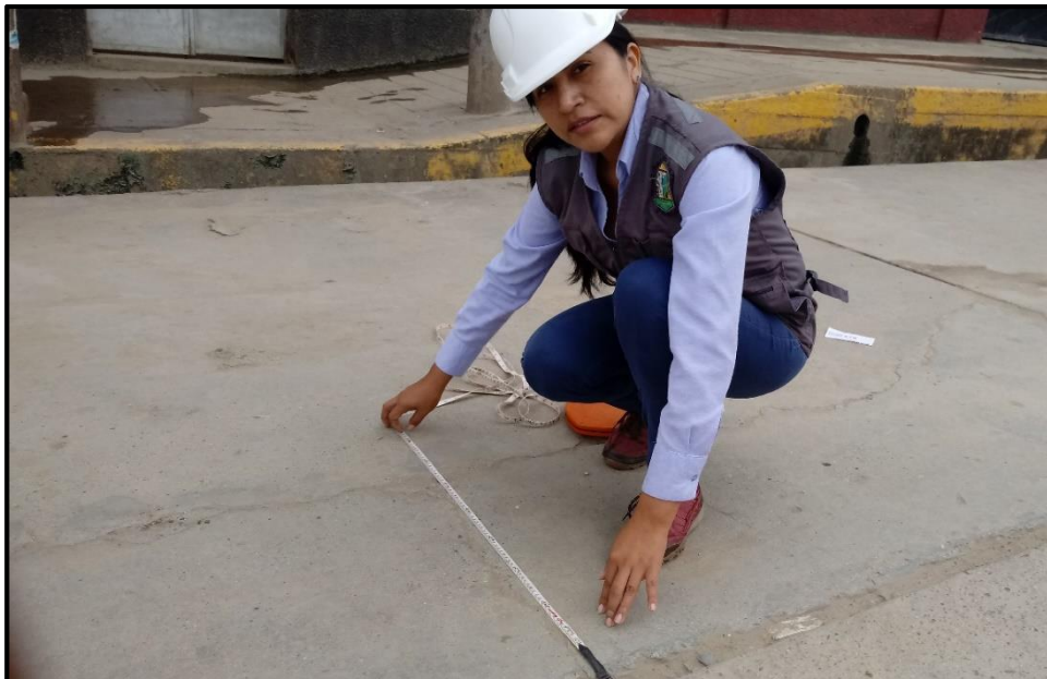
Figura 94: Grietas lineales en la calle 7 de Junio para la UM-04.
