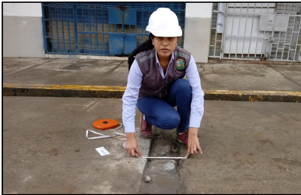
Figura 92: Daño de sello de junta en la calle 7 de Junio para la UM-03.
