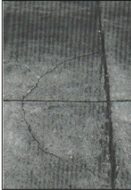
Figura 01: Grieta de esquina de baja severidad Según, Vásquez L. (21) (2012)
