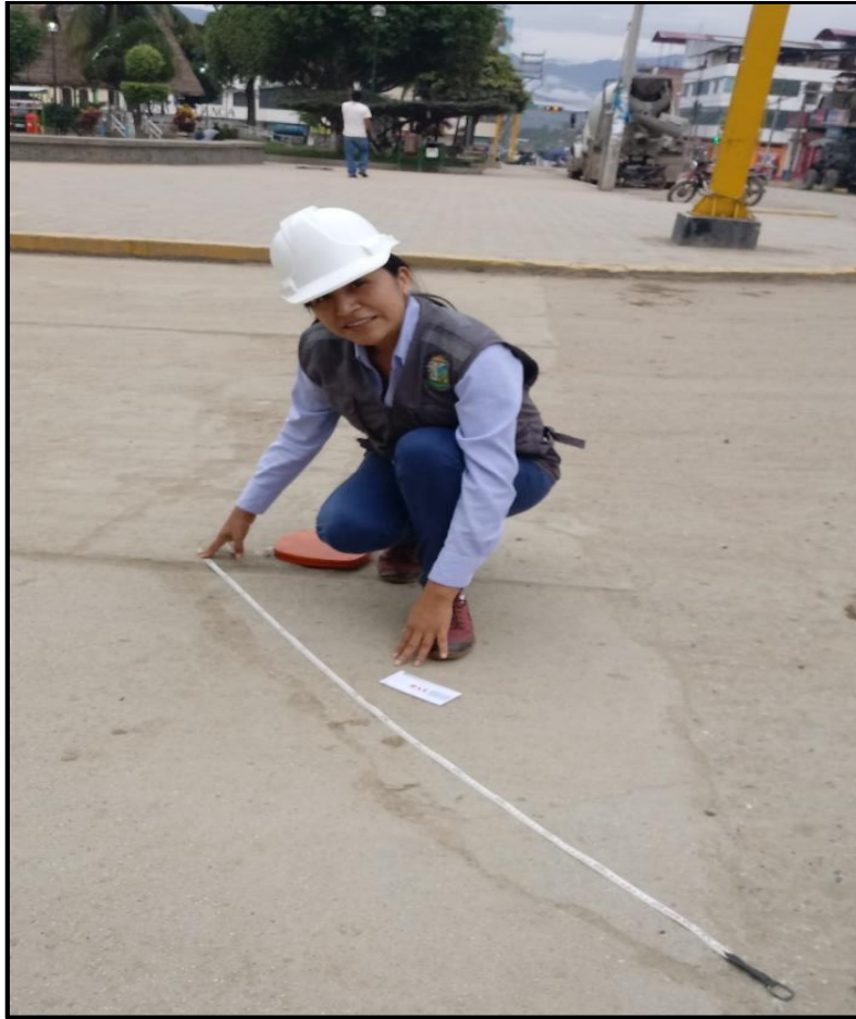
Figura 93: Grieta de esquina en la calle 7 de Junio para la UM-03.
