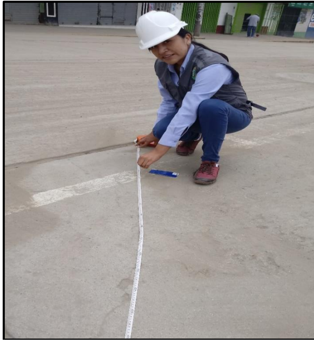
Figura 89: Grieta de esquina en la calle 7 de Junio para la UM-02.
