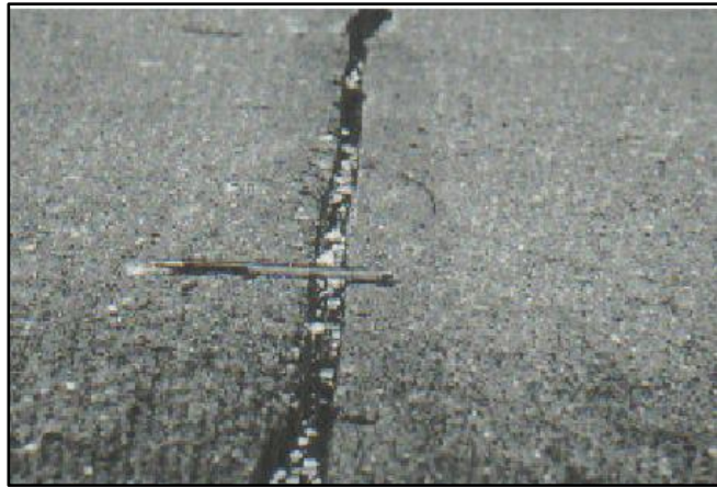
Figura 06: Daño del sello de junta de alta severidad Según, Vásquez L. (21) (2012)
