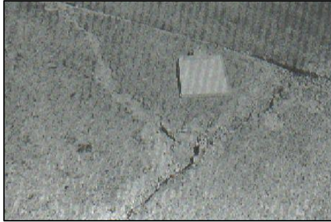
Figura 03: Grieta de esquina de alta severidad Según, Vásquez L. (21) (2012)
