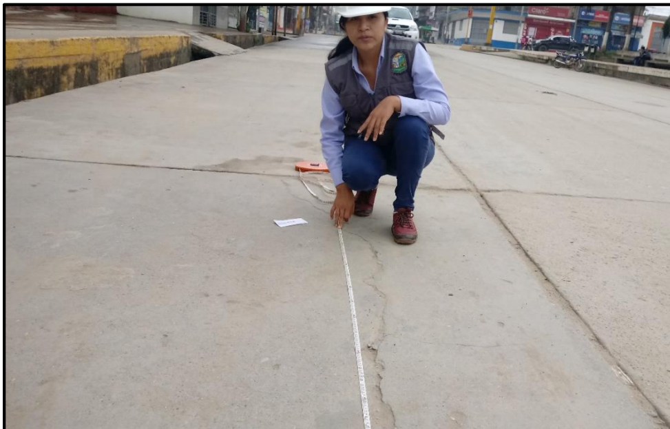
Figura 90: Grietas lineales en la calle 7 de Junio para la UM-03.
