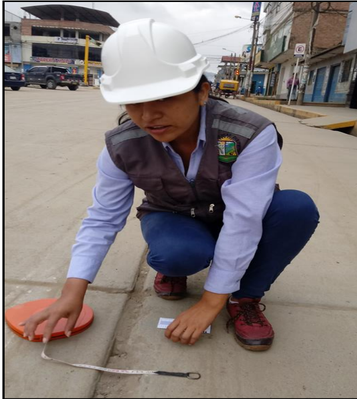
Figura 87: Daño de sello de junta en la calle 7 de Junio para la UM-02.
