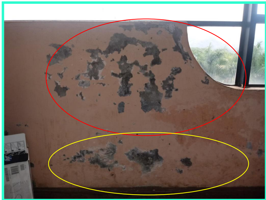
Figura 43. Se visualiza a las fallas patológicas en la oficina de la gerencia de desarrollo urbano y rural en el cuarto nivel de la Municipalidad Distrital de Rio Negro, la imagen pertenece a la UM2.
