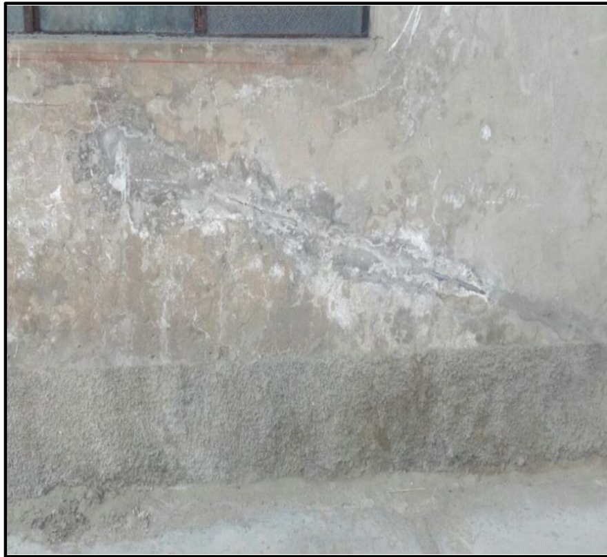
Figura 11. Presencia de la eflorescencia en muro de albañilería debido a daños de la tubería.
