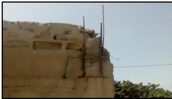
Figura 20. Corrosión en el acero de una columna debido a la falta de recubrimiento.
