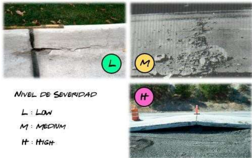
Figura 09: Blowup – Buckling de severidad baja, media y alta.
