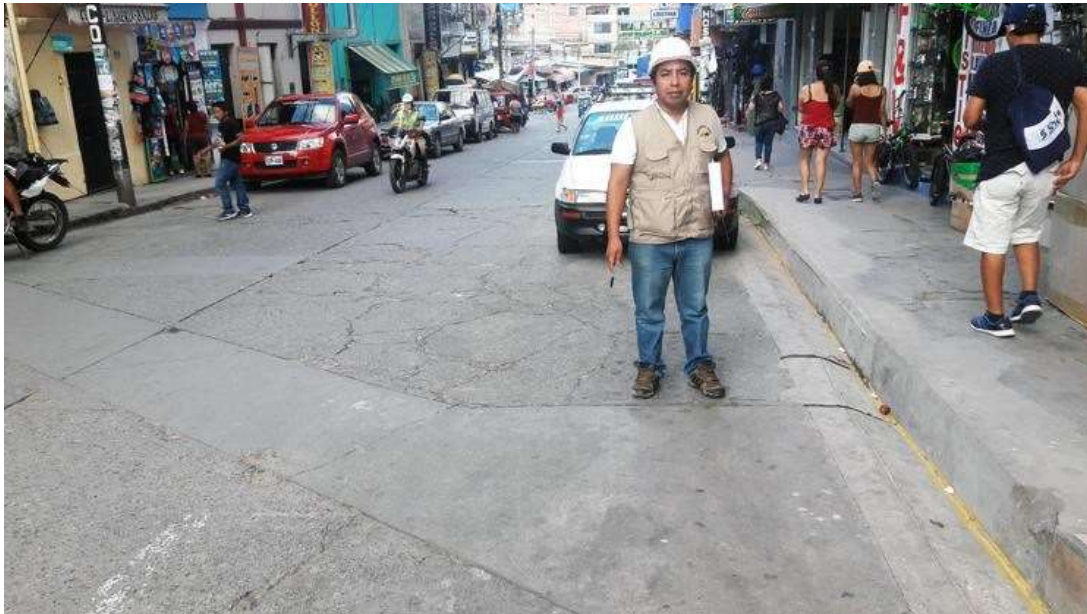
Fotografía , se observa patología de 17: Unidad de Muestra 05 del Jirón Tarma Parche Grande.
