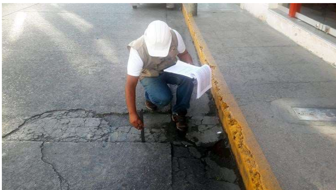
Fotografía 06: Unidad de Muestra 02 del Jirón Tarma, se observa patología de Descascamiento de esquina.
