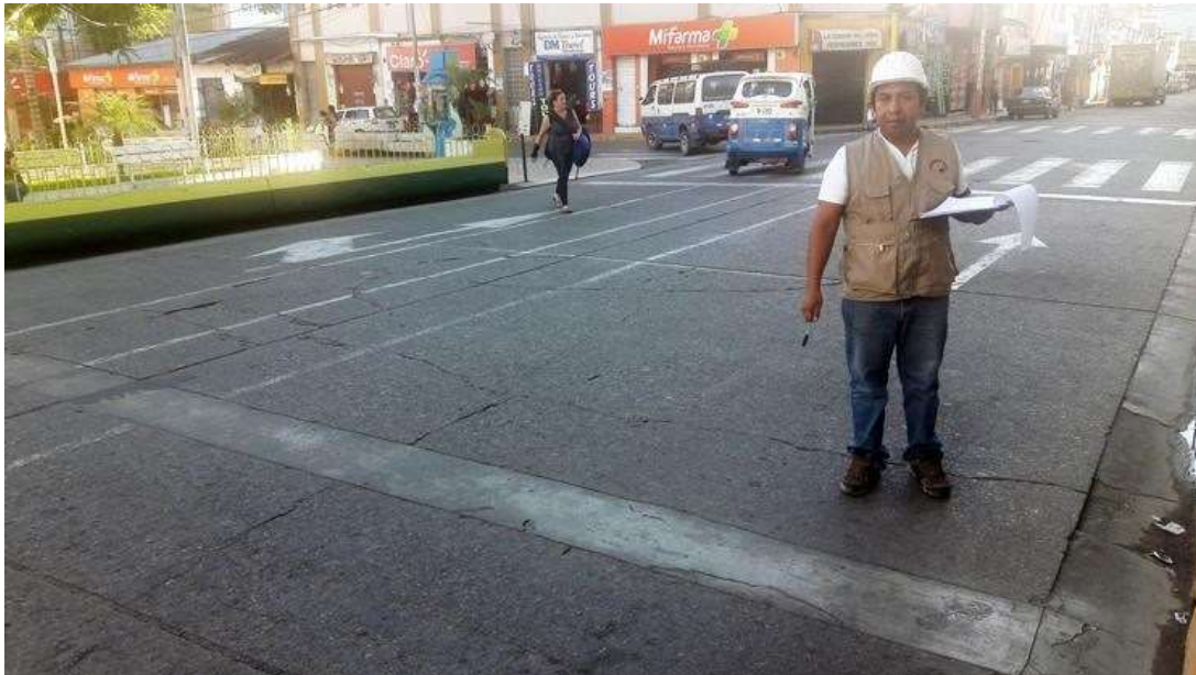
Fotografía , se observa patología de 11: Unidad de Muestra 03 del Jirón Tarma Parche Grande y losa dividida.
