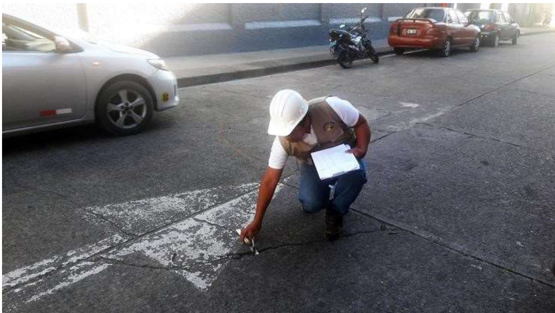
Fotografía 02: Unidad de Muestra 01 del Jirón Tarma, se observa patología de Grieta de Esquina.
