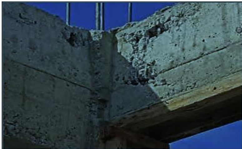
Imagen 16: Cangrejera en viga de concreto armado
