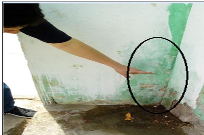
Imagen 7: Humedad en columna de tanque elevado Niño héroe.
