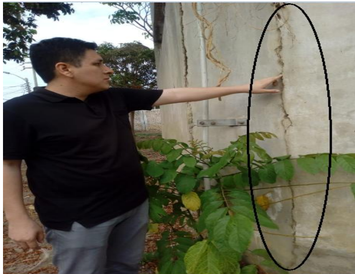
Imagen 9: Grieta en columna de tanque elevado N° 16 Catacaos - Piura
