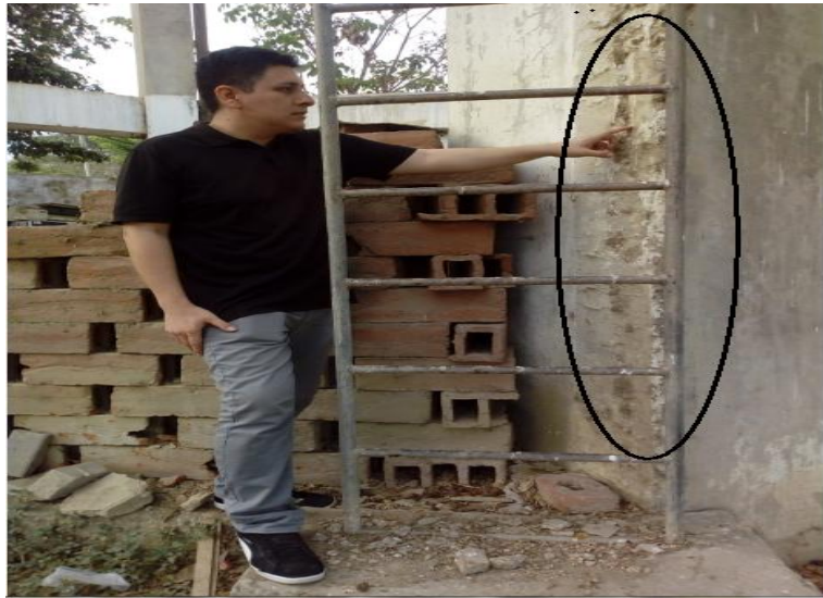
Imagen 12: Eflorescencia en columna de tanque elevado N° 16 Catacaos - Piura
