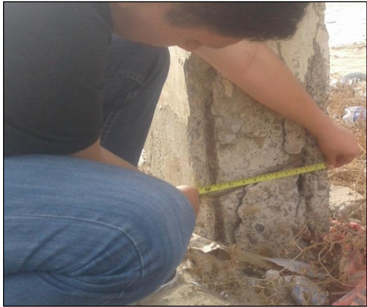
Imagen 14: Corrosión en parte inferior de columna de tanque elevado La Legua-Piura
