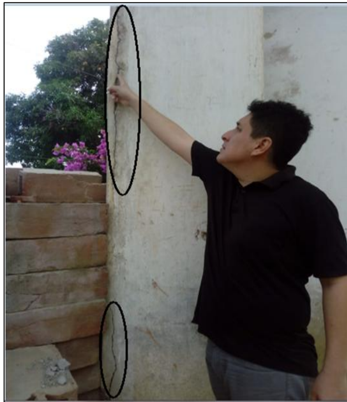
Imagen 10: Fisura en columna de tanque elevado N° 16 Catacaos - Piura
