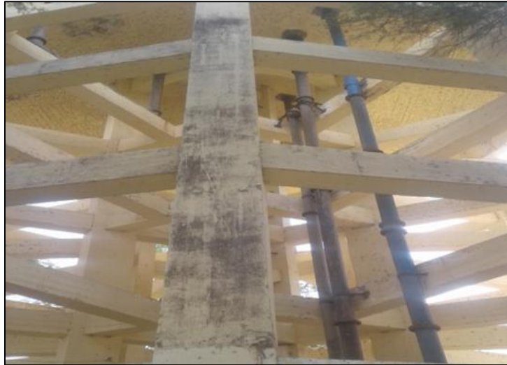
Imagen 6: Suciedad en tanque elevado parque Miguel Cortes
