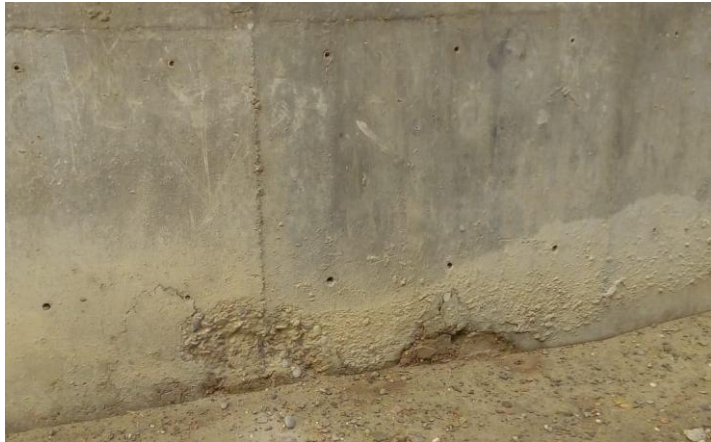
Imagen 8: Erosión en parte de tanque elevado N°17
