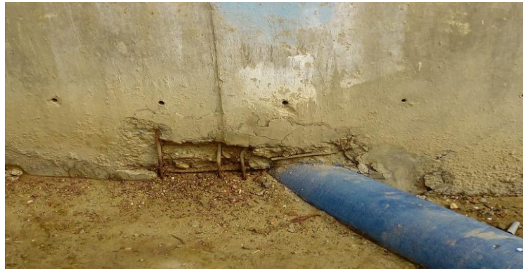
Imagen 13: Oxidación en fuste del tanque elevado N° 17 Catacaos - Piura
