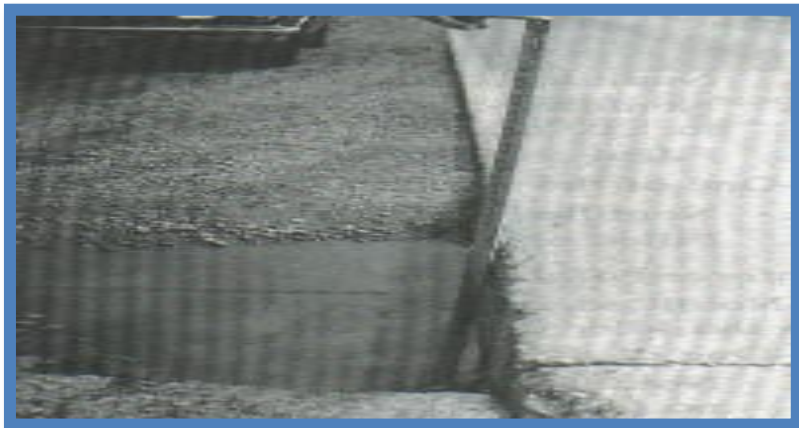
Figura 24: Desnivel carril / berma de alta severidad.
