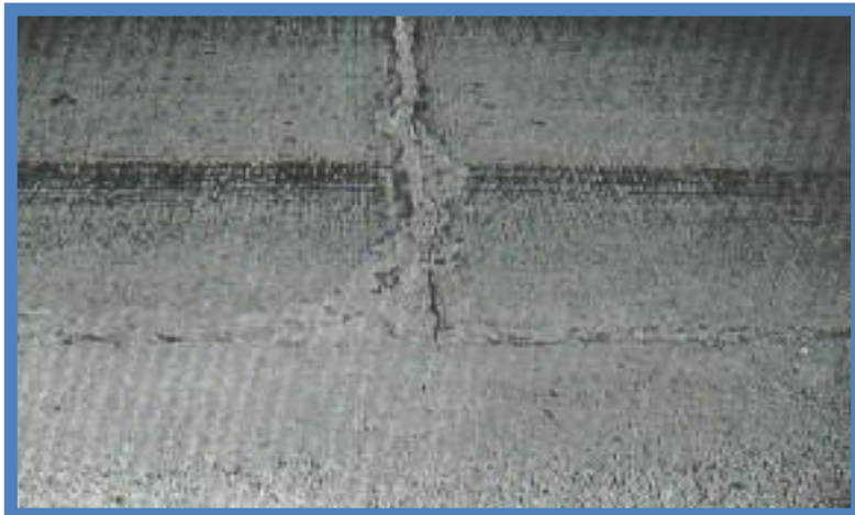
Figura 48: Descascaramiento de esquina de severidad media.
