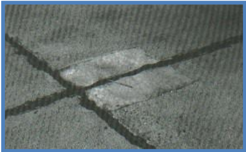
Figura 31: Parche pequeño de baja severidad.
