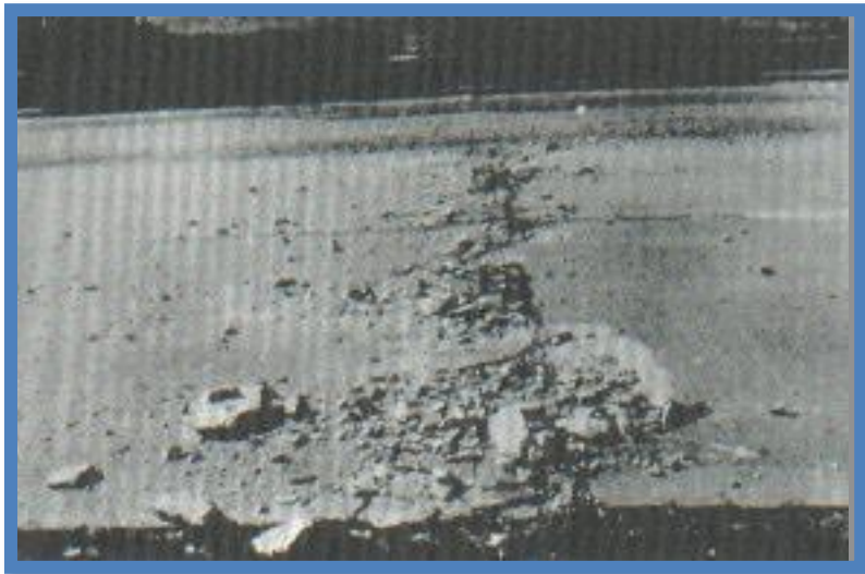
Figura 05: Blowup – Buckling de severidad media.
