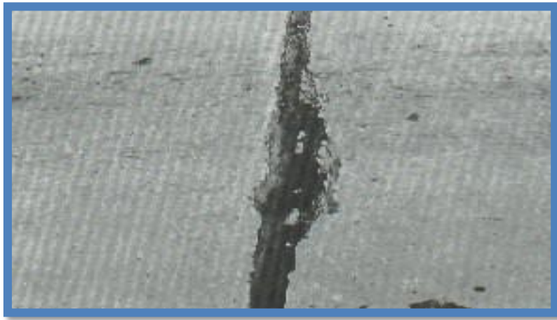
Figura 20: Daño del sello de la junta de severidad media.
