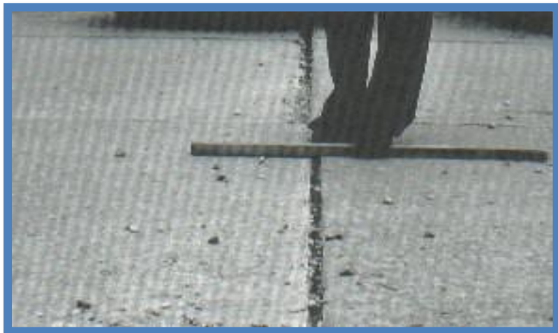
Figura 16: Escala de baja severidad.
