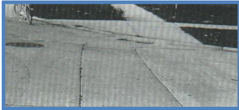
Figura 28: Parquetado grande y acometida de servicios públicos de baja severidad.
