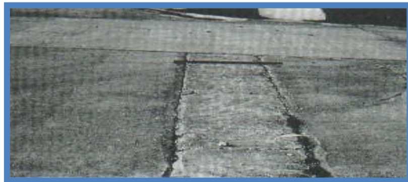
Figura 29: Parquetado grande y acometida de servicios públicos de severidad media.
