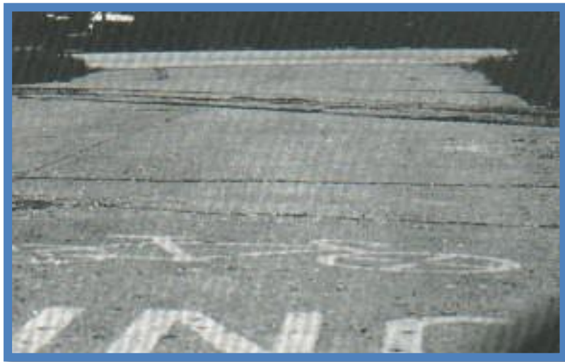
Figura 41: Cruce de vía férrea de severidad media.
