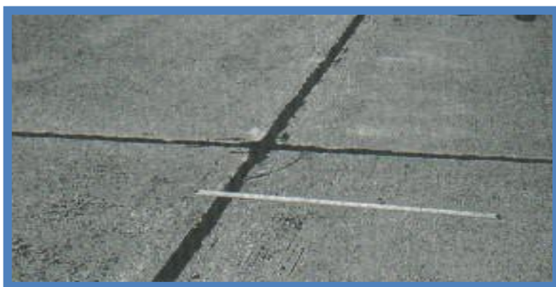
Figura 47: Descascaramiento de esquina de baja severidad.
