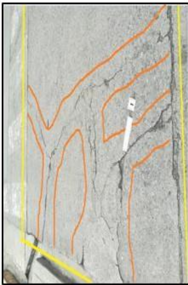
TIPOS DE DAÑOS IDENTIFICADOS Losa dividida M
