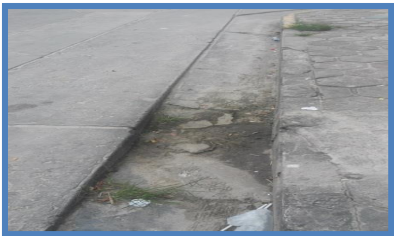
Figura 06: Blowup – Buckling de alta severidad.
