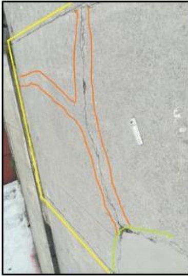
TIPOS DE DAÑOS IDENTIFICADOS Parche grande L Grieta lineal M Daño del sello de la junta M Pulimiento de agregados M
