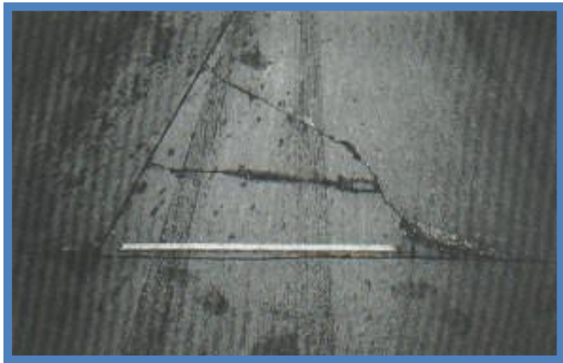
Figura 08: Grieta de esquina de severidad media.
