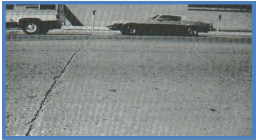
Figura 50: Descascaramiento de junta de baja severidad.
