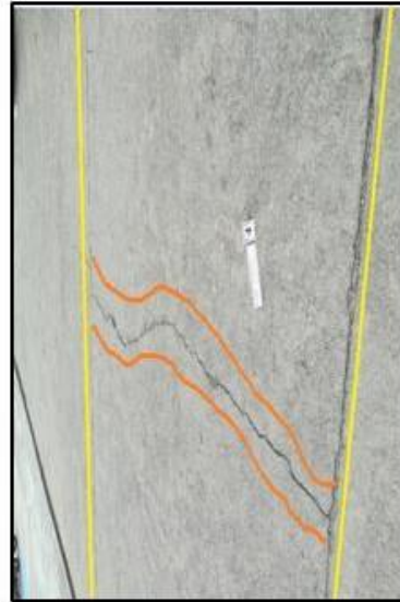
TIPOS DE DAÑOS IDENTIFICADOS Grieta lineal M Daño del sello de la junta M Pulimiento de agregados M
