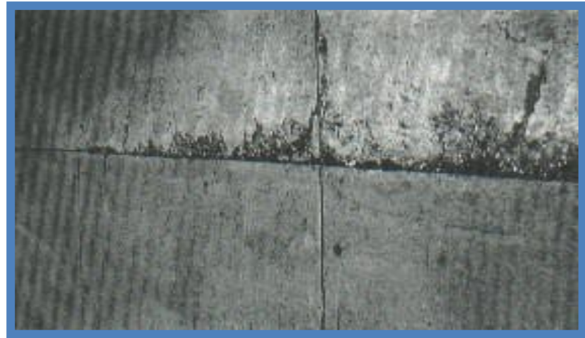
Figura 51: Descascaramiento de junta de severidad media.
