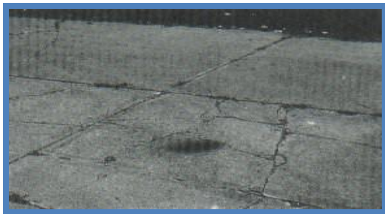
Figura 12: Losa dividida de alta severidad.
