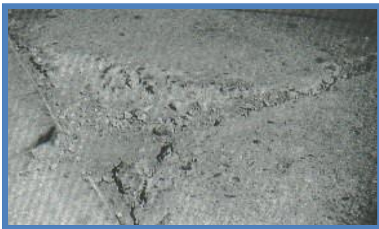
Figura 49: Descascaramiento de esquina de alta severidad.
