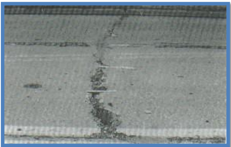
Figura 27: Grietas lineales de alta severidad.
