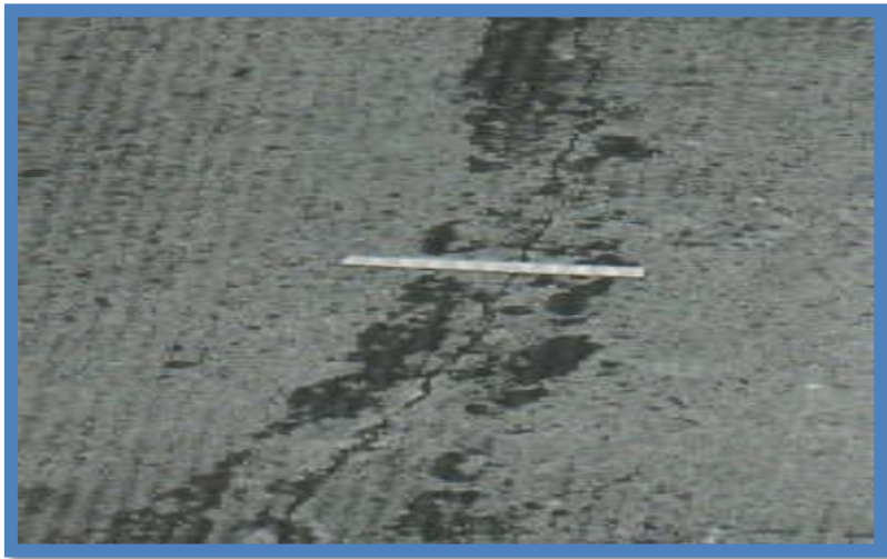
Figura 25: Grietas lineales de baja severidad.
