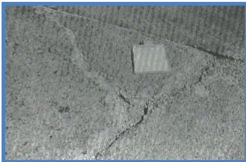
Figura 09: Grieta de esquina de alta severidad.
