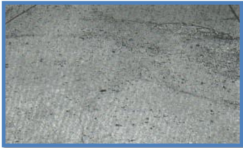
Figura 15: Grieta de durabilidad “D” de alta severidad.
