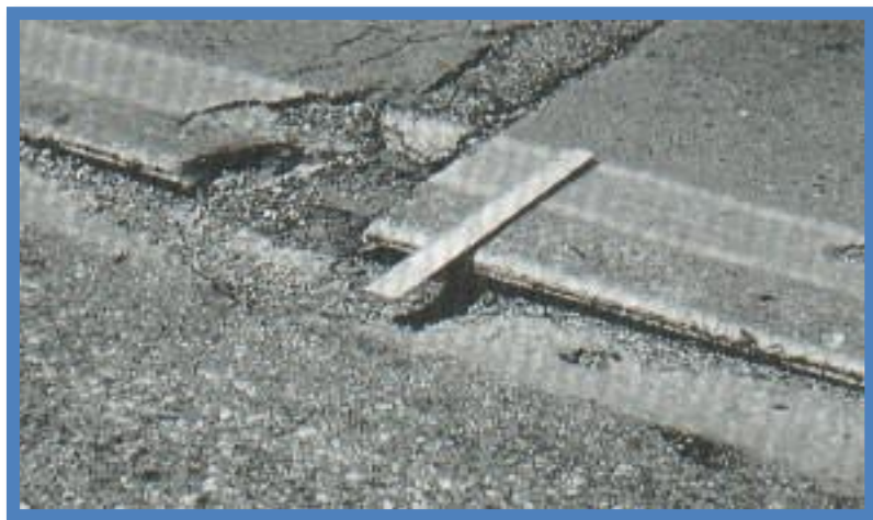
Figura 22: Desnivel carril / berma de baja severidad.
