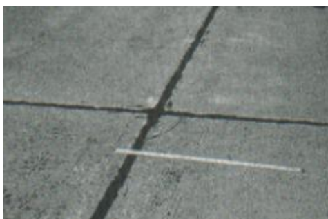
Figura 52: Descascaramiento de esquina de baja severidad.
