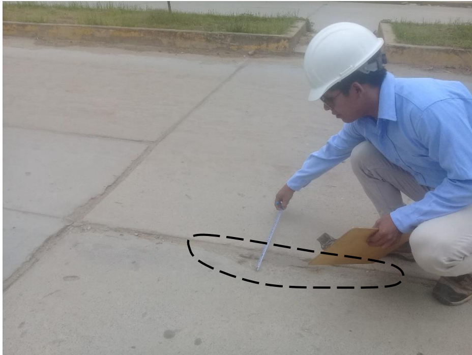
Figura251: Patología de descascaramiento de junta de severidad media.
