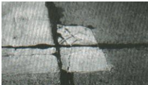
Figura 36: Parche pequeño de severidad media.
