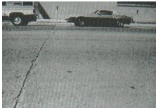
Figura 55: Descascaramiento de junta de baja severidad.
