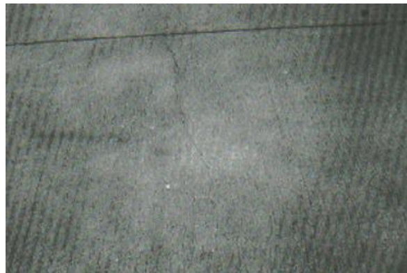
Figura 51: Grietas de contracción.
