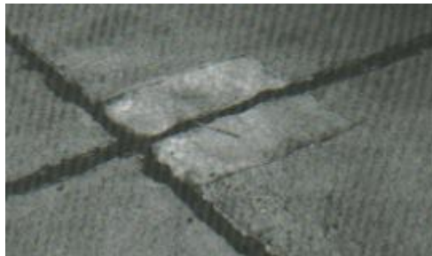
Figura 35: Parche pequeño de baja severidad.
