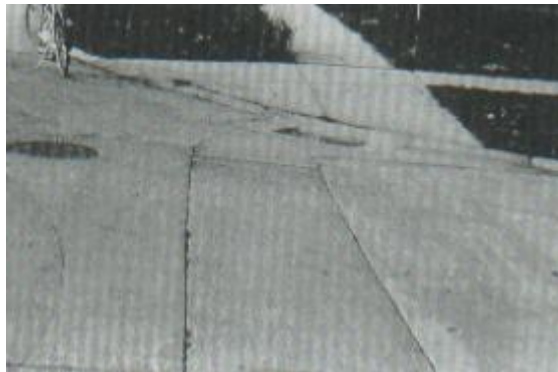
Figura 32: Parche grande y acometidas de servicios públicos de baja severidad.
