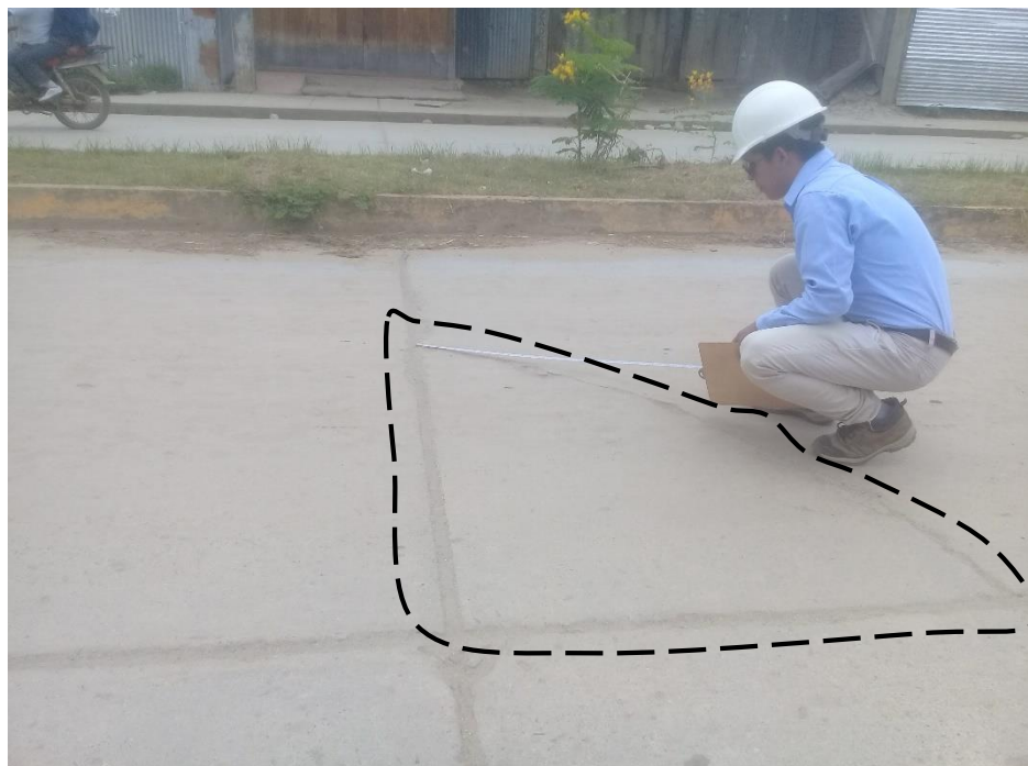
Figura234: Patología de grieta de esquina de severidad media.
