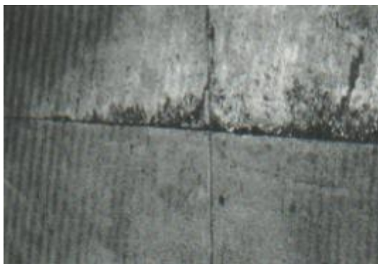
Figura 56: Descascaramiento de junta de severidad media.
