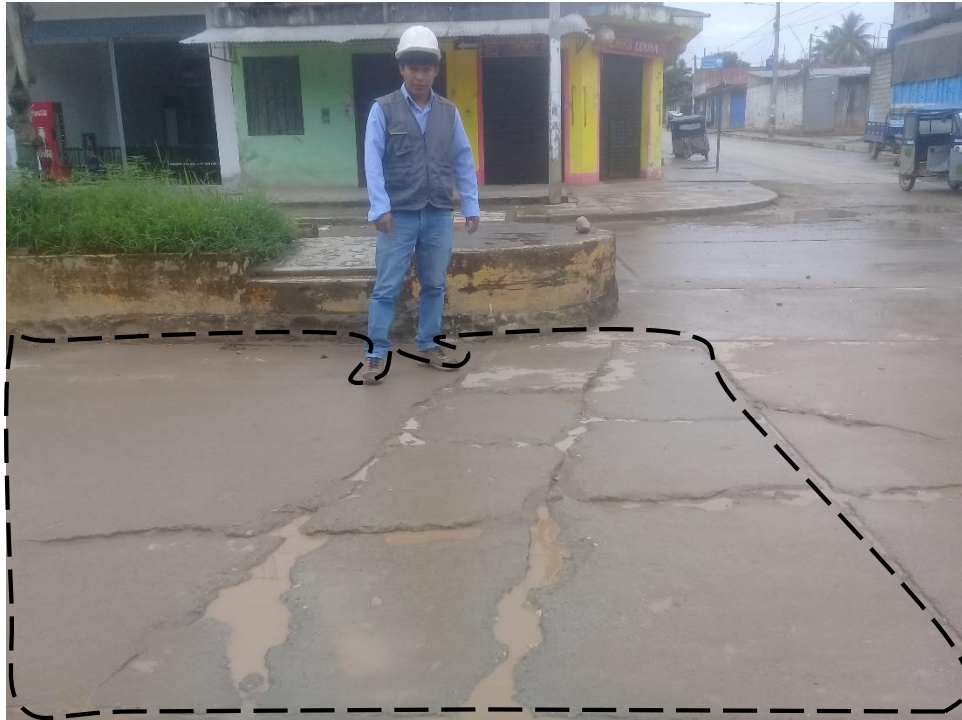
Figura 235: Patología de losa dividida de severidad alta.
