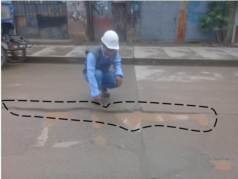
Figura237: Patología de escala de severidad alta.
