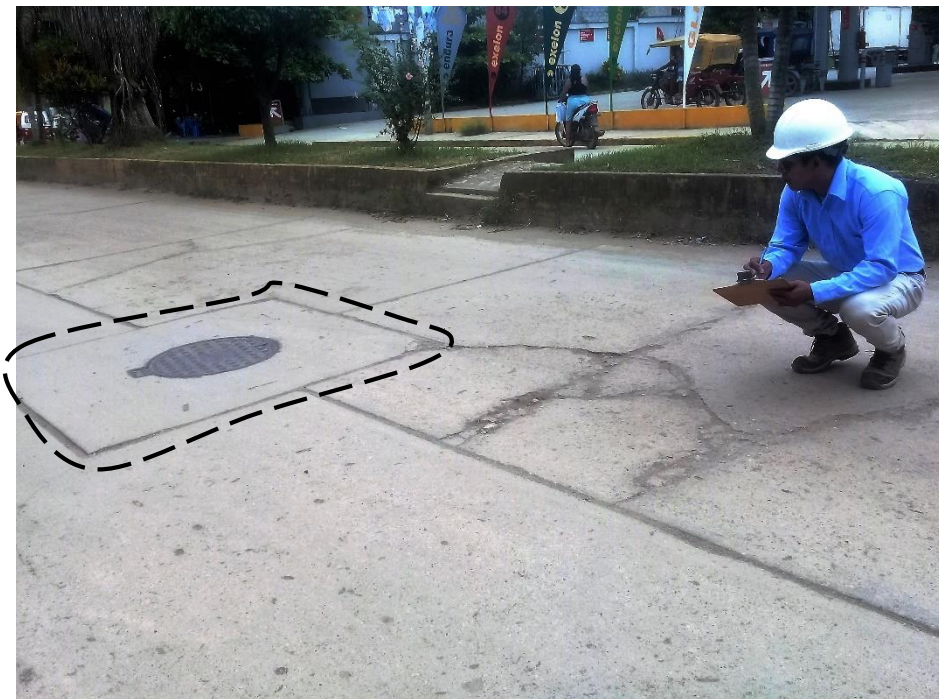
Figura242: Patología de parche grande de 0.45m 2 de severidad media.
