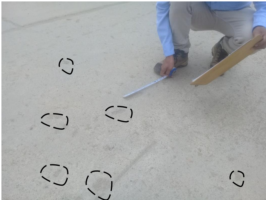
Figura 246: patología de Popouts.
