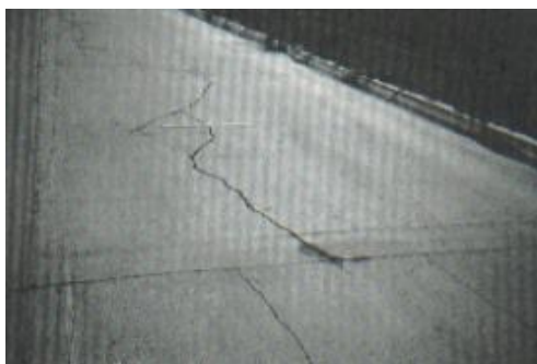
Figura 15: losa dividida de severidad media.
