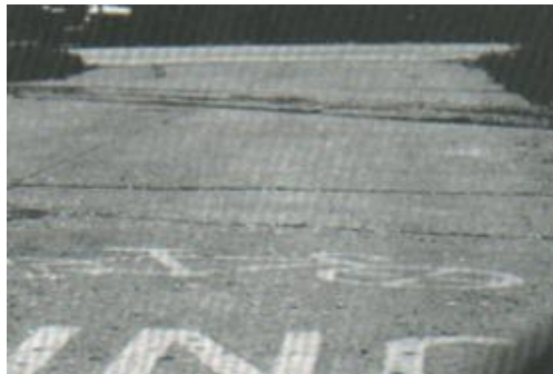
Figura 46: Cruce de vía férrea de severidad media.
