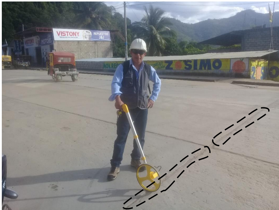
Figura252: Patología de descascaramiento de junta de severidad leve.
