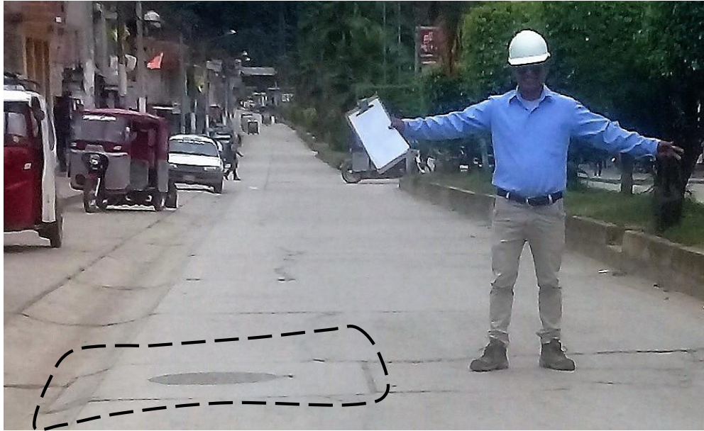
Figura241: Patología de parche grande que es mayor a 0.45 m 2 de severidad baja.
