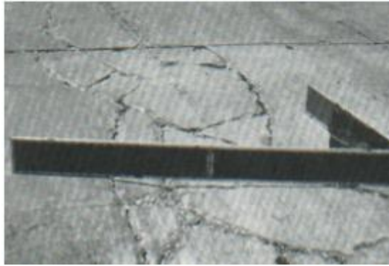
Figura 44: Punzonamiento de alta severidad.
