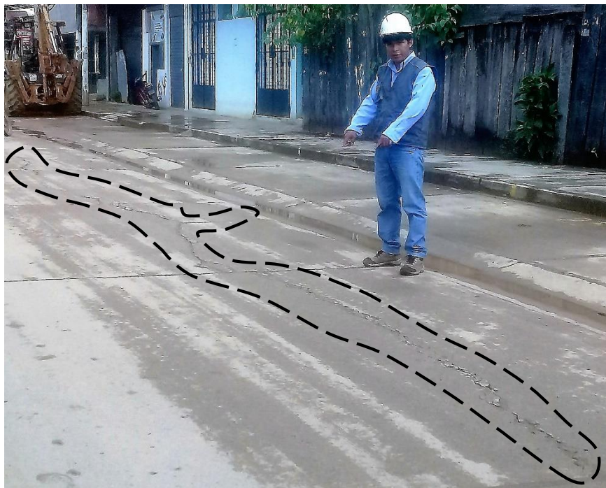
Figura240: Patología de grieta lineal de severidad media.
