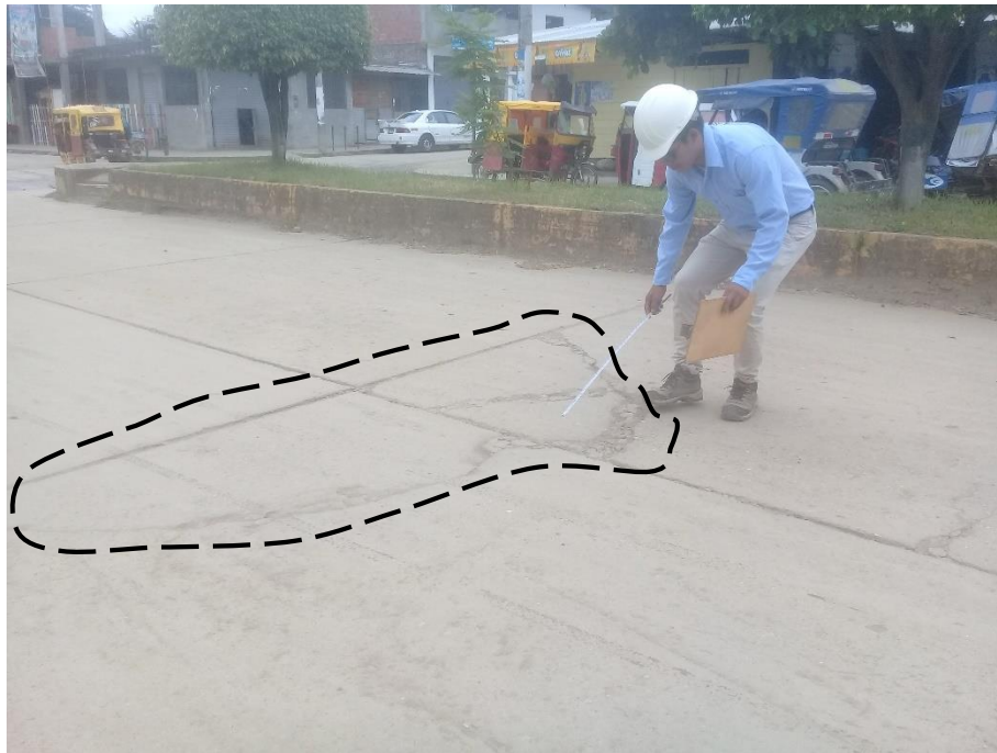
Figura233: Patología de grieta de esquina de severidad alta.
