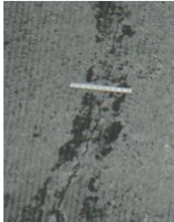
Figura 29: Grietas lineales de baja severidad en losa de concreto simple.
