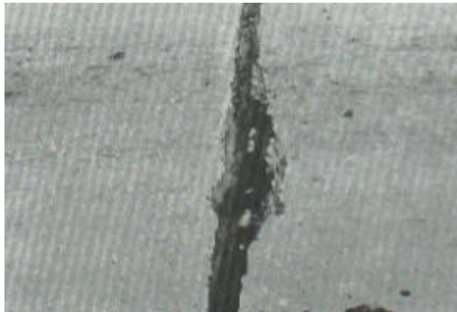
Figura 24: Daño del sello de junta de severidad media.
