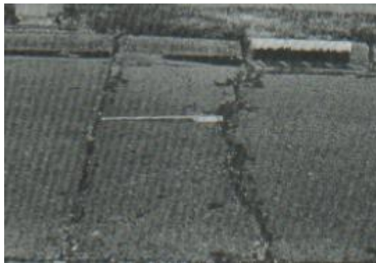
Figura 42: Punzonamiento de baja severidad.
