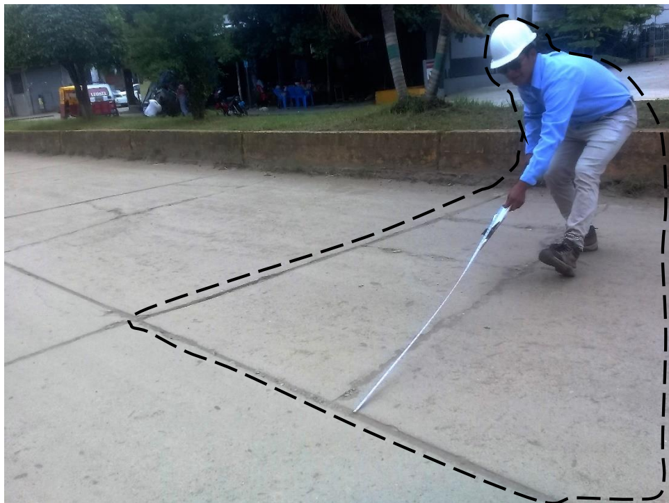
Figura 236: Patología de losa dividida de severidad media.
