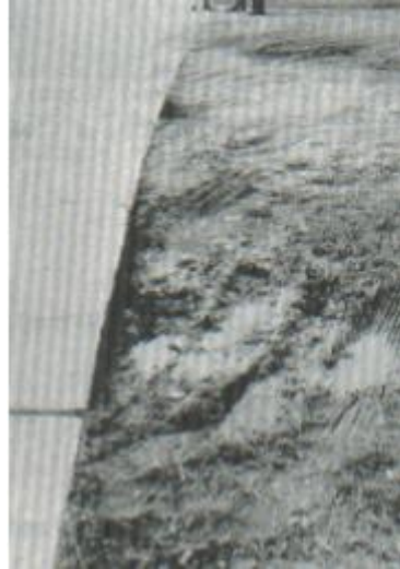
Figura 27: Desnivel carril / berma de severidad media.
