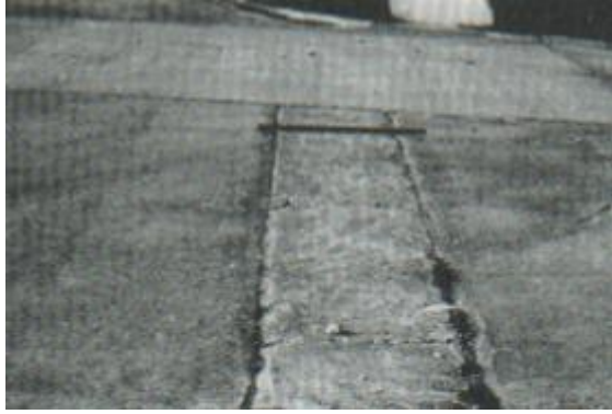
Figura 33: Parche grande y acometida de servicios públicos de severidad media.
