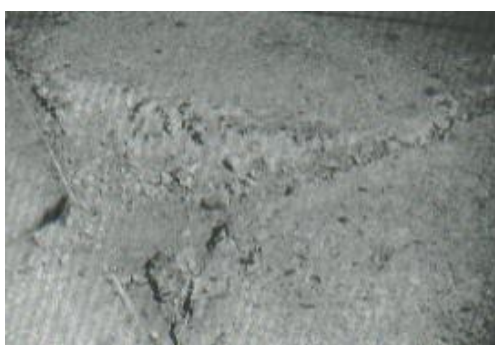
Figura 54: Descascaramiento de esquina de alta severidad.
