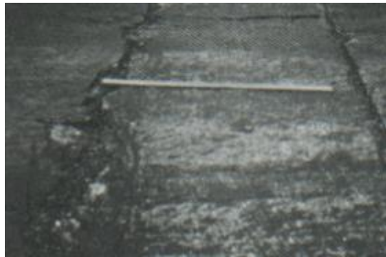
Figura 34: Parche grande y acometidas de servicios públicos de alta severidad.
