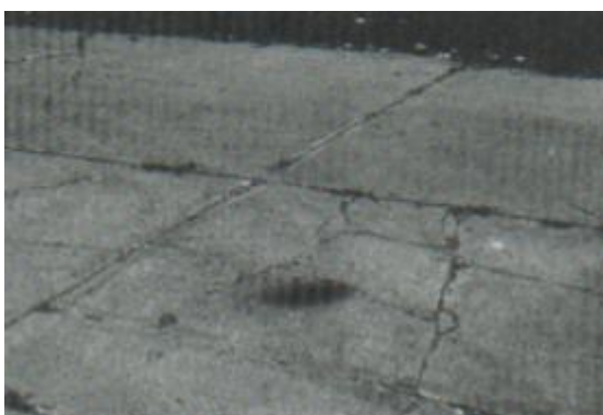
Figura 16: losa dividida de alta severidad.
