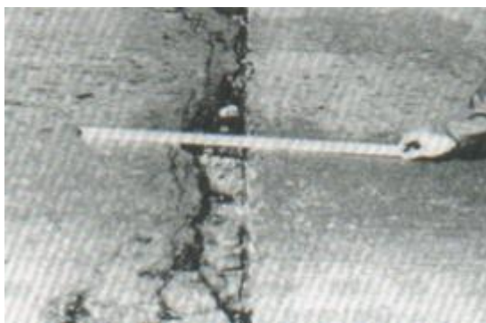
Figura 57: Descascaramiento de junta de alta severidad
