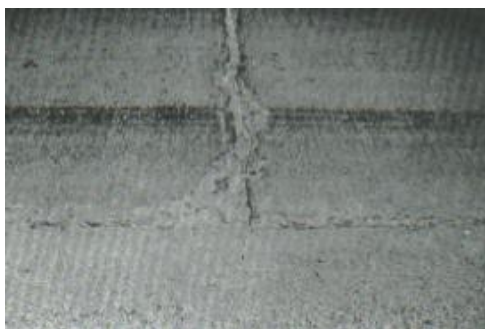
Figura 53: Descascaramiento de esquina de severidad media
