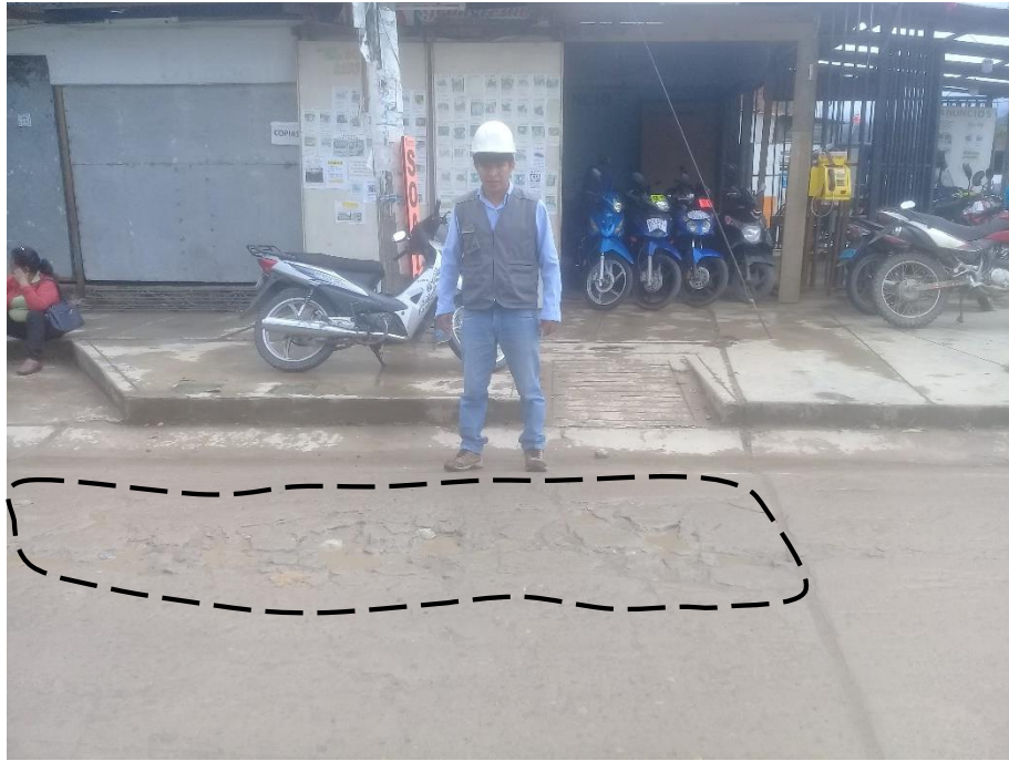
Figura247: Patología de punzonamiento de severidad alta.
