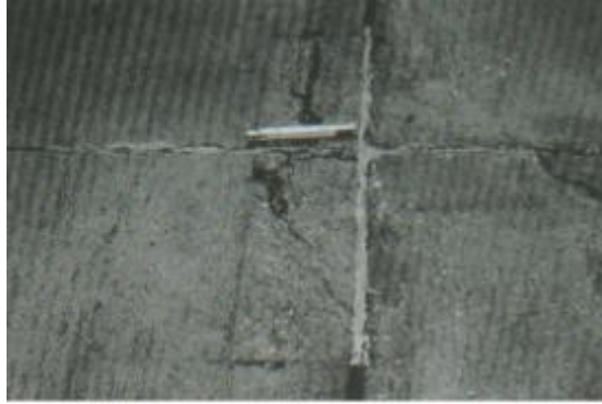
Figura 37: Parche pequeño de alta severidad.
