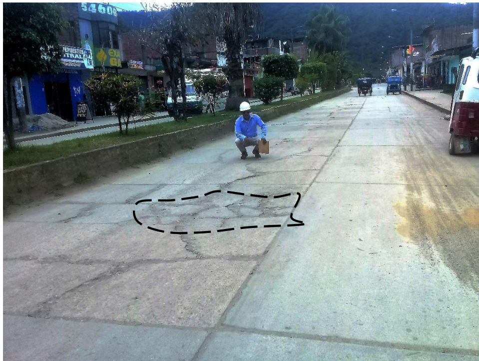
Figura248: Patología de punzonamiento de severidad alta.
