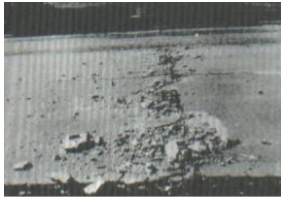
figura 09: Blowup / Buckling de baja severidad.
