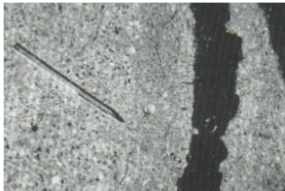
Figura 17: Grieta de durabilidad de baja severidad
