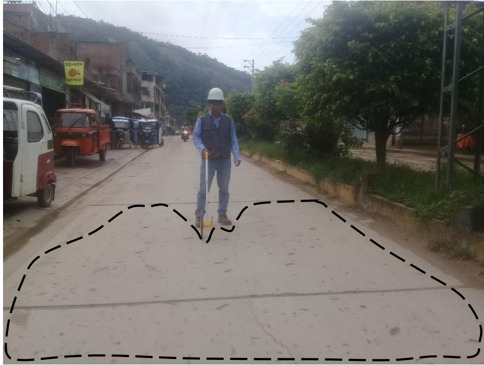
Figura 245: patología de Popouts.
