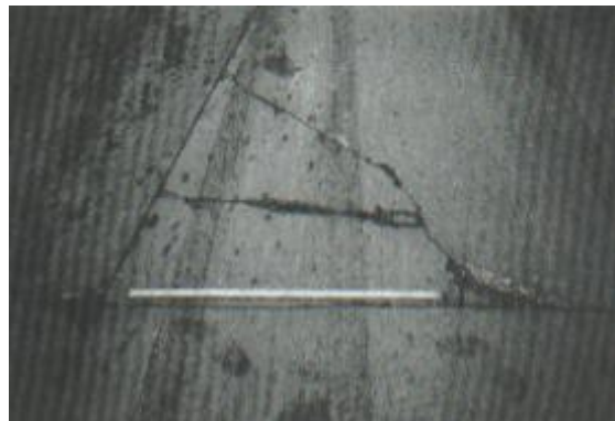
Figura 12: Grieta de esquina de severidad media.
