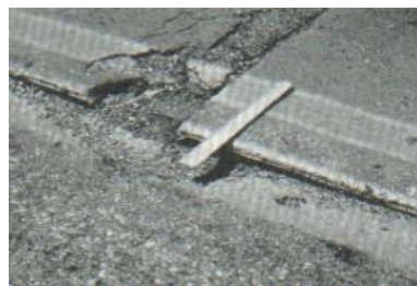
Figura 26: Desnivel carril / berma de baja severidad.
