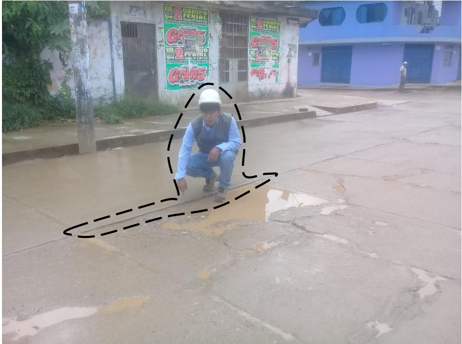
Figura238: Patología de escala de severidad media.
