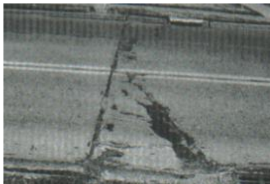
Figura 43: Punzonamiento de severidad media.
