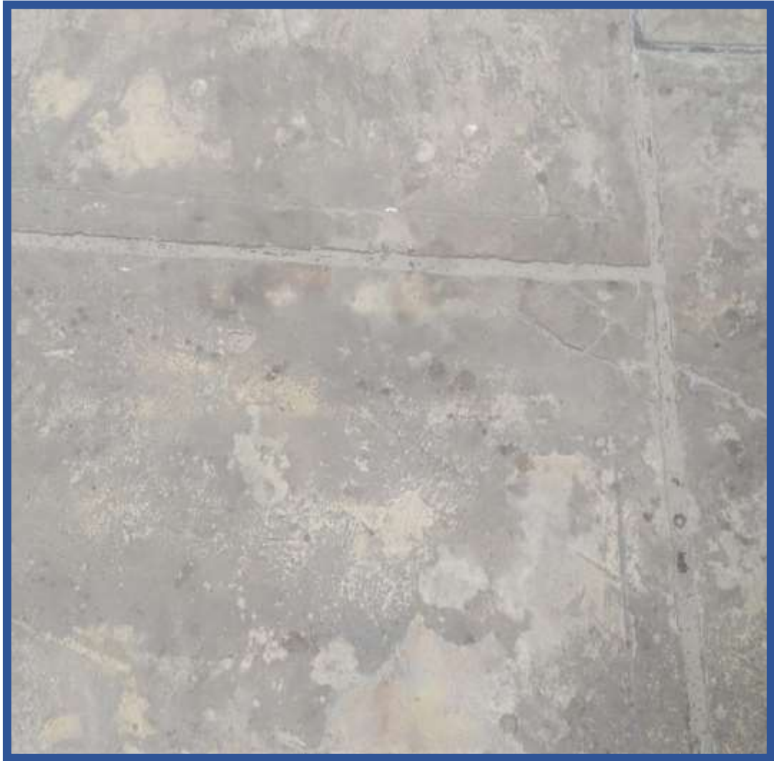
Figura 40 Grieta de Esquina MEDIA UM-05
