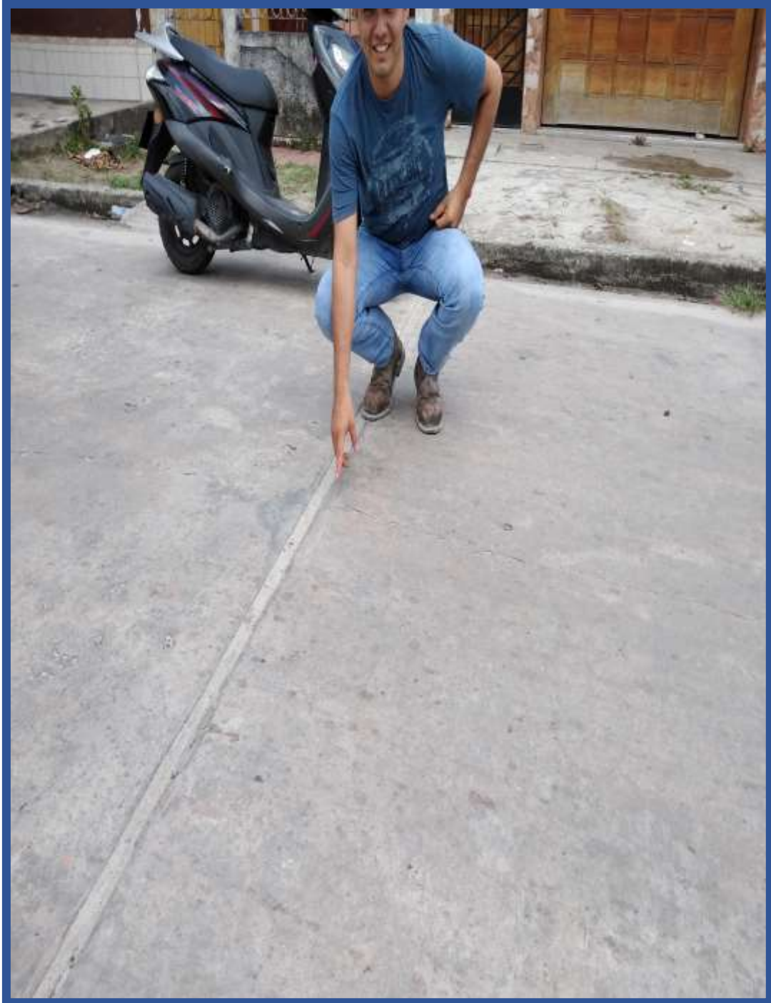
Figura 41 Grieta lineal BAJO UM-01
