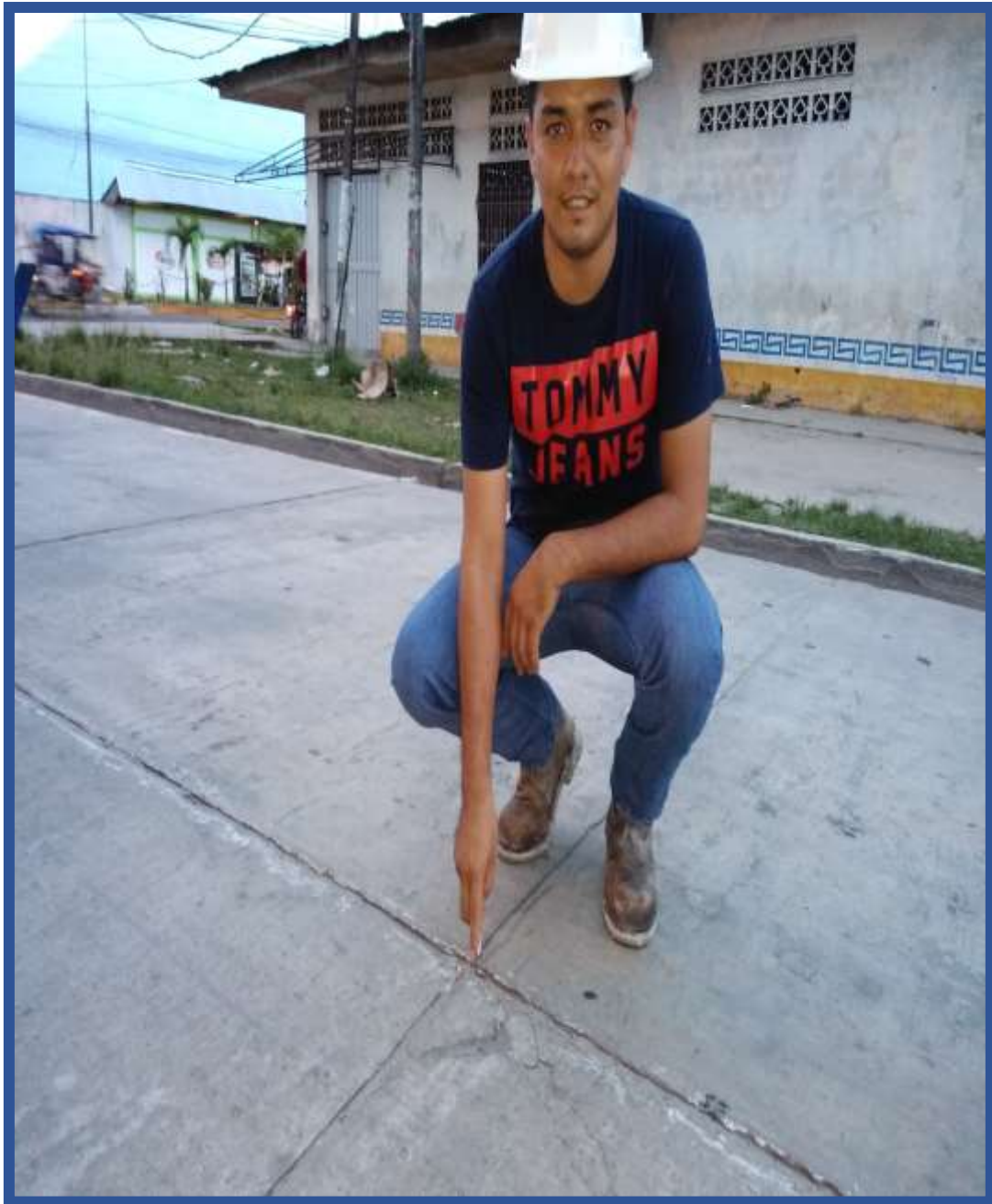
Figura 39 Grieta de Esquina BAJO UM-02
