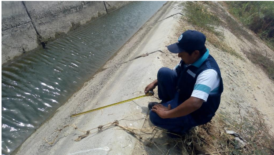
Gráfico 10: Fisura en losa lateral del canal.
