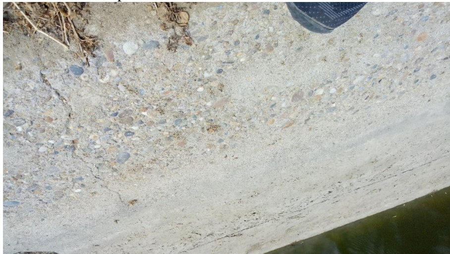
Gráfico 9: Desprendimiento en concreto en losa lateral de canal.
