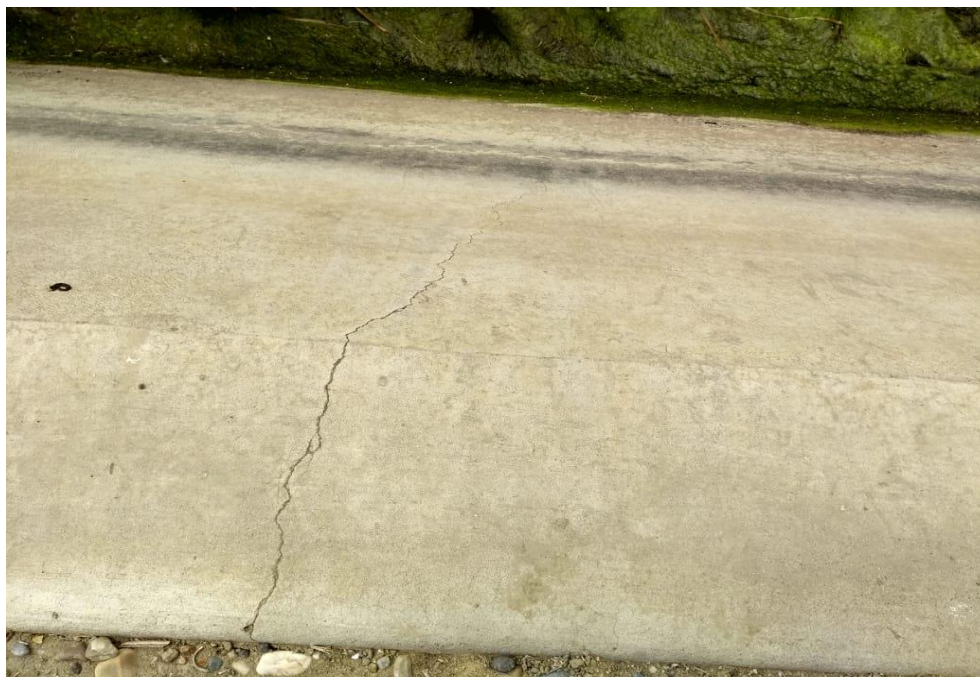
Gráfico 71: Fisuración en corona del canal
