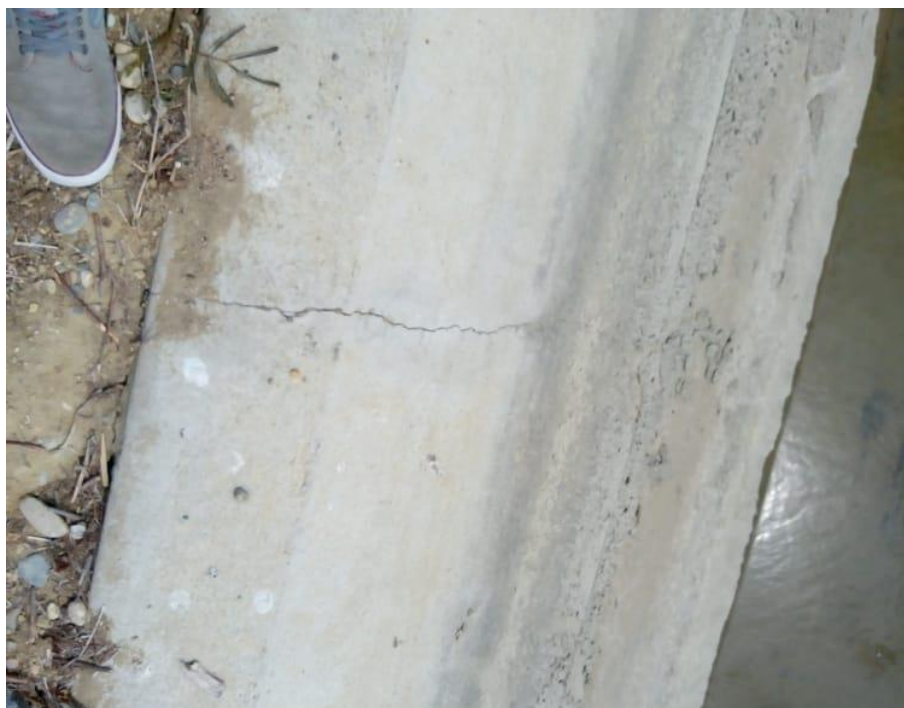
Gráfico 70: Fisuración de losa lateral del canal
