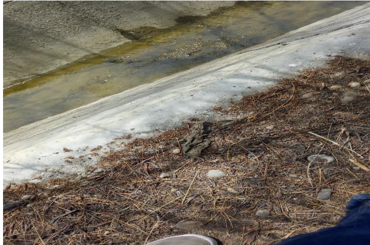
Gráfico 8: Erosión en losa lateral del canal de concreto.
