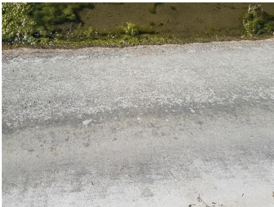
Gráfico 69: Erosión del concreto en el canal.
