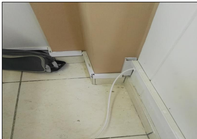
Foto N° 04. Cableado Informal detectado en oficinas
