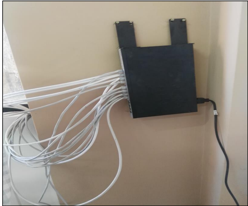
Foto N° 03: Cableado Informal detectado en oficinas
