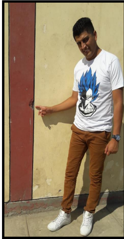
Fotografía 07. Se muestra la erosión por golpe o impacto de 3 mm de profundidad, ubicada en la unidad muestral 10.
