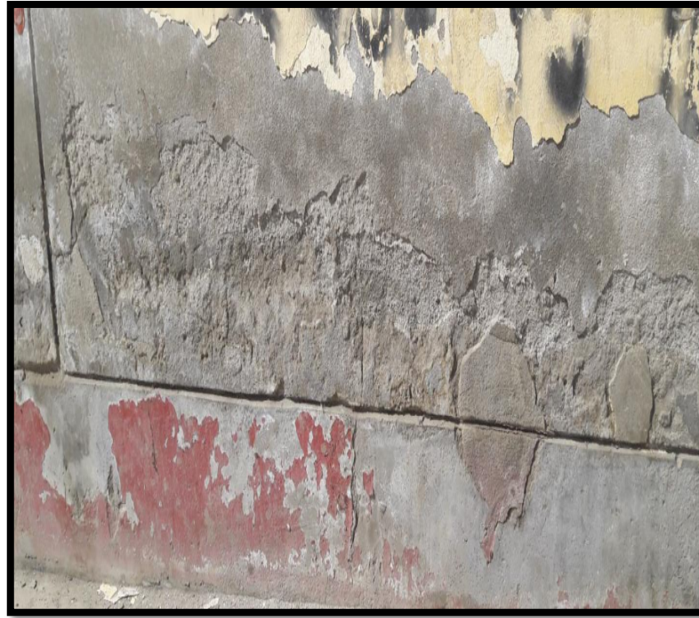
Fotografía 12. Se muestra la presencia de disgregación en la parte inferior del muro, ubicada en la unidad muestral 13.
