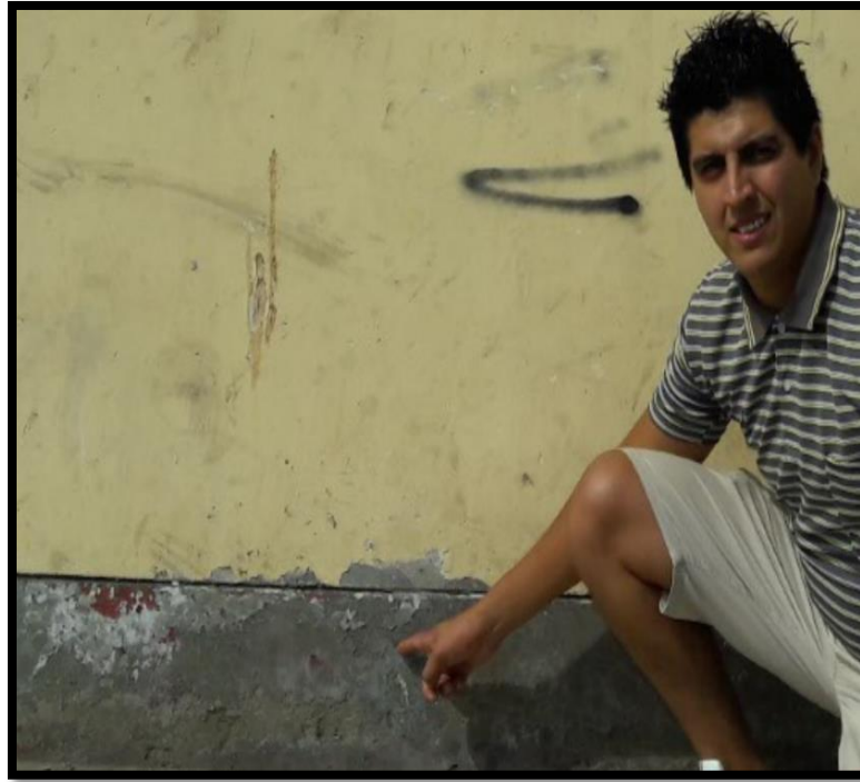
Fotografía 10. Se muestra la presencia de eflorescencia en el sobrecimiento, ubicada en la unidad muestral 14.
