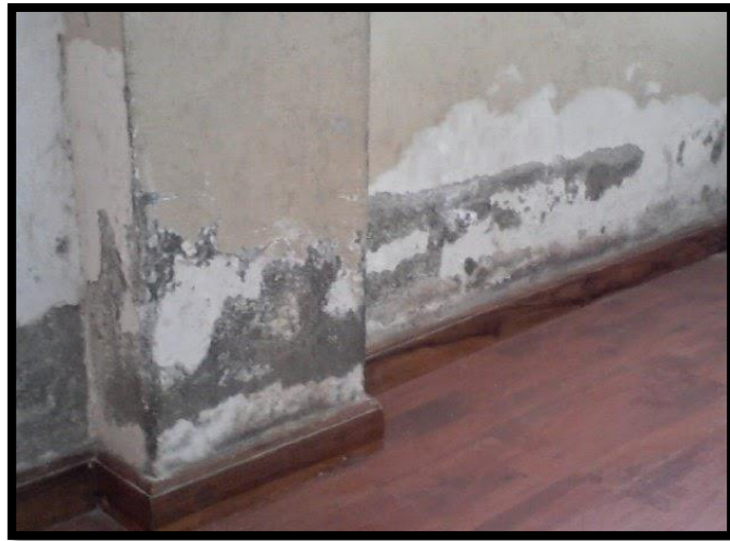
Figura 16. Presencia de eflorescencia en columna y muros.
