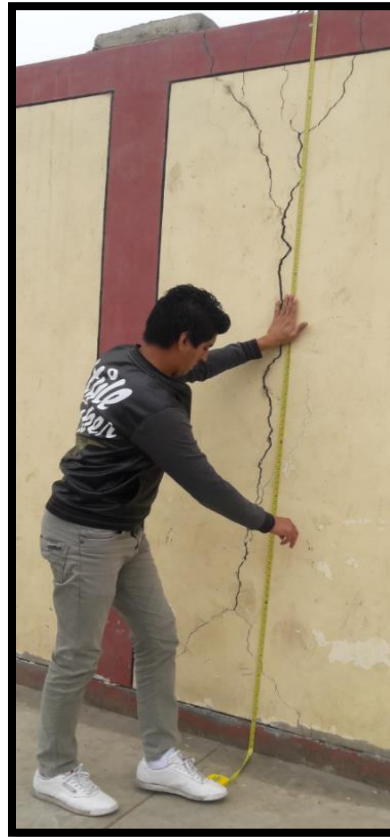
Fotografía 05. Presencia de grietas de 10 mm de ancho de abertura, ubicadas en la unidad muestral 10.
