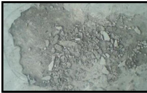
Figura 20. Presencia de delaminación en el concreto.
