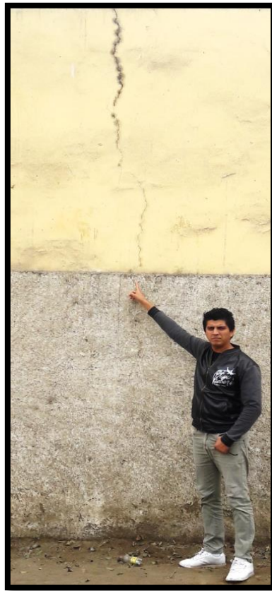
Fotografía 06. Presencia de grieta de 7 mm de ancho de abertura, ubicada en la unidad muestral 5.
