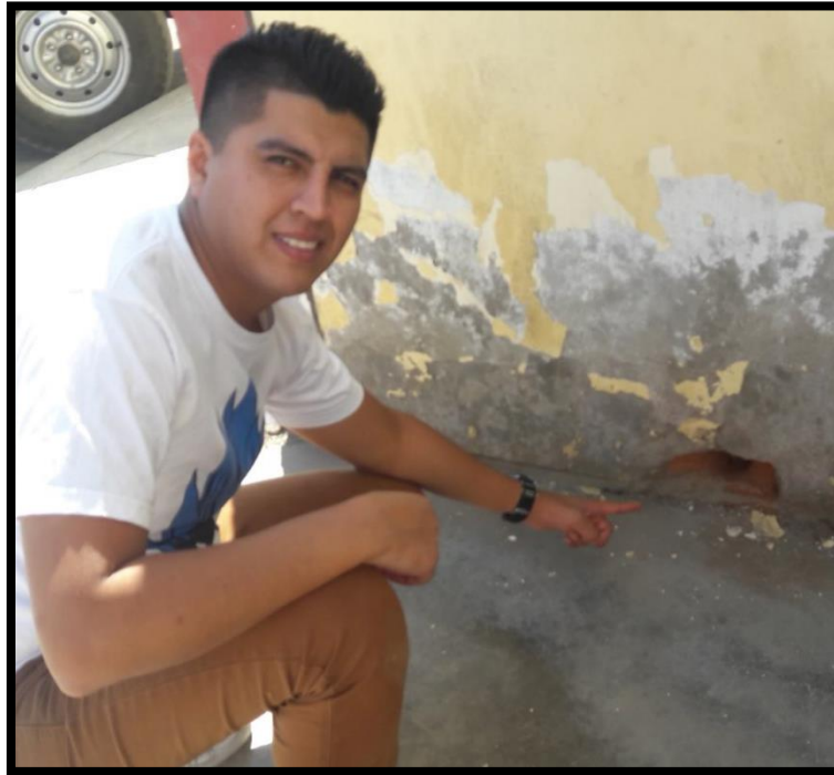
Fotografía 08. Se muestra la erosión por golpe o impacto de 150 mm de profundidad, ubicada en la unidad muestral 8.
