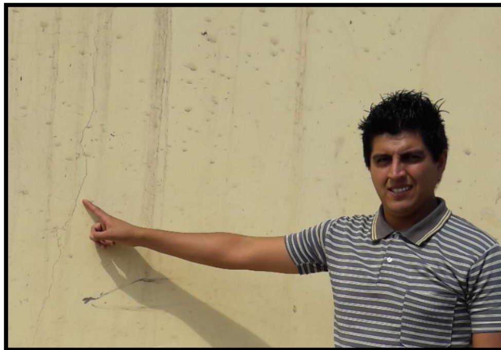
Fotografía 03. Se observa una fisura de 1 mm de ancho de abertura, la cual esta ubicada en la unidad muestral 15.
