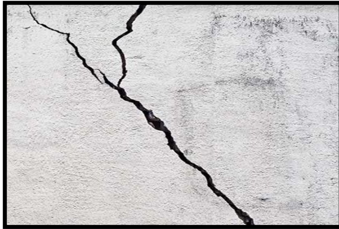
Figura 14. Presencia de grietas en muro. Fuente: Umacon (2019).
