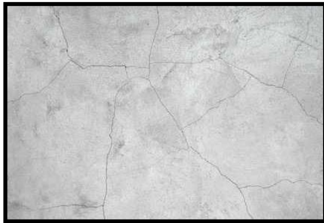
Figura 13. Presencia de fisuras en muro. Fuente: Mundo Ark (2019).
