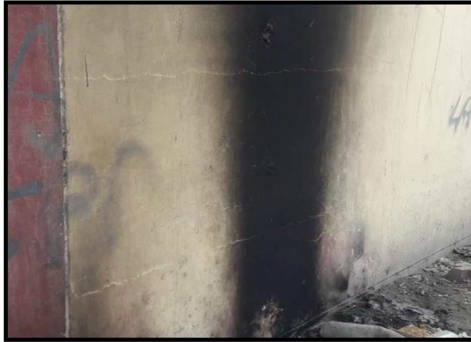
Fotografía 04. Se observa fisuras de 1 mm de ancho de abertura, la cual esta ubicada en la unidad muestral 1.
