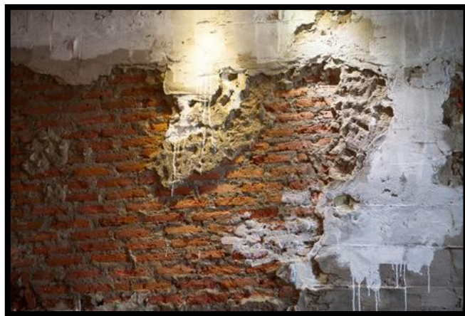
Figura 19. Presencia de desintegración en muro. Fuente: Marín (2013).
