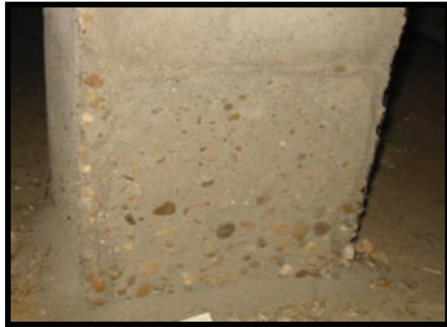
Figura 17. Presencia de disgregación en columna.
