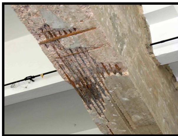
Figura 18. Presencia de corrosión en viga. Fuente: Marín (2013).
