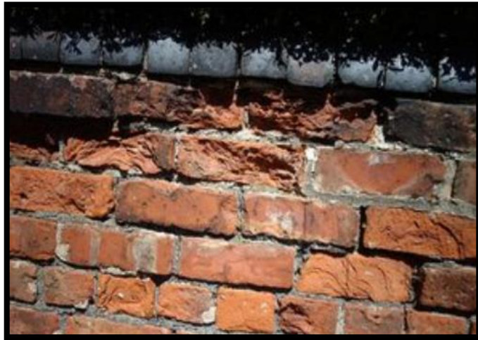
Figura 15. Presencia de erosión en muro.
