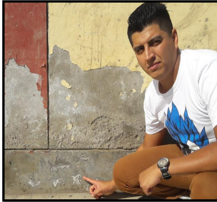
Fotografía 09. Se muestra la presencia de eflorescencia en el sobrecimiento, muro y columna, ubicada en la unidad muestral 14.
