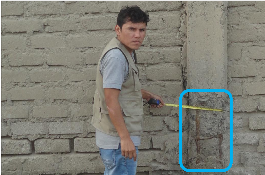
Imagen 13. Notamos la evaluación de la columna de la unidad de muestra 07 encontrando a la patología, corrosión con un área afectada de 0.13 \text{ m}^2 .
