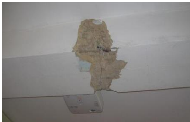
Figura 1. Grieta en viga encontrado en el colegio evangélico interamericano. Fuente: Velasco (2014).
