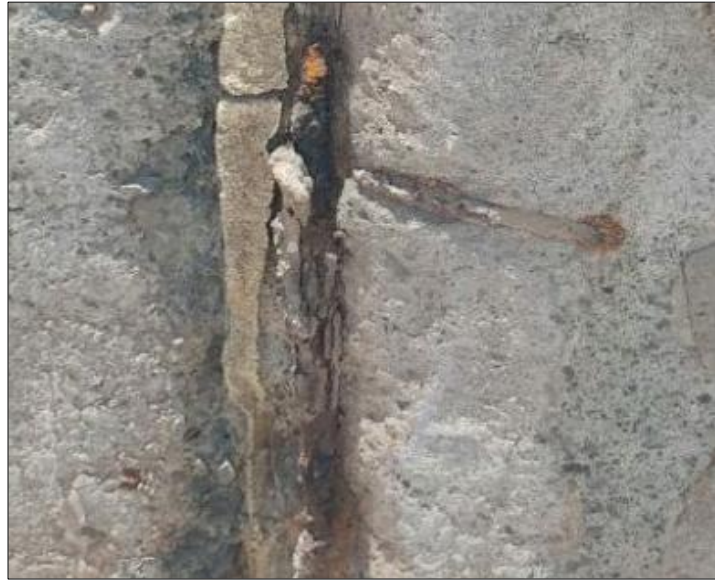
Figura 22. Corrosión en acero de columnas del cerco perimétrico del centro de producción en el pueblo joven Villa María, Chimbote – Perú. Fuente: Gonzales (2016)
