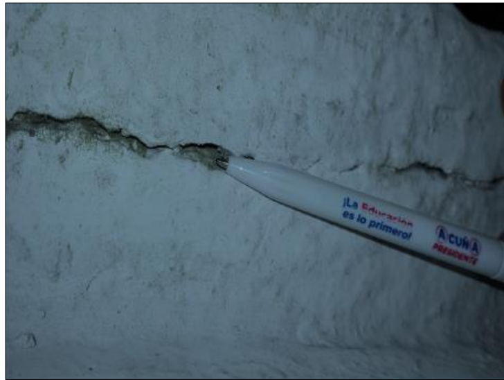
Figura 18. Grieta en columna de cerco perimétrico de la Pesquera Bethel S.A. Chimbote – Perú. Fuente: León (2016).
