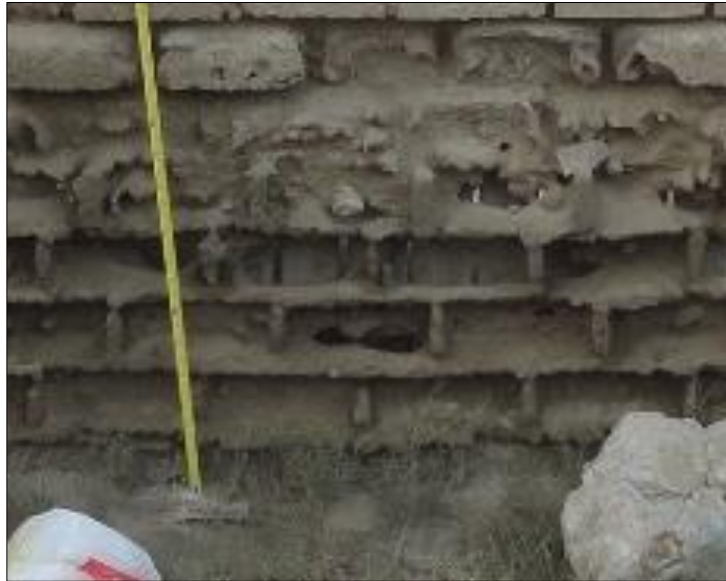
Figura 23. Erosión química en el muro de albañilería. Fuente: Investigación propia (2019).
