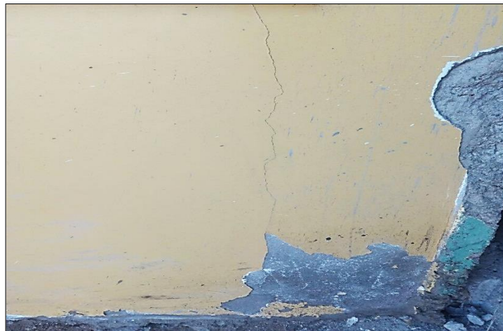
Figura 19. Fisura en muro de albañilería, hospicio Santiago Apóstol, Chimbote – Perú. Fuente: Cornelio (2016)
