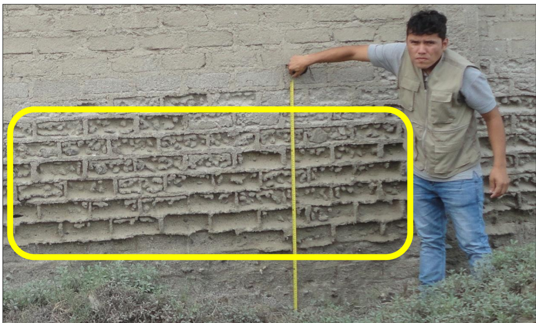
Imagen 5. Apreciamos la evaluación de la patología erosión, de la unidad de muestra 02.
