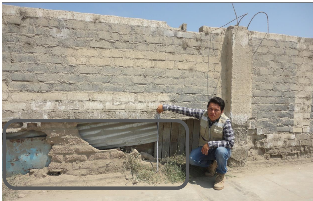
Imagen 9. Observamos la evaluación del muro de la unidad de muestra 13 encontrando a la patología desintegración con un área afectada de 3.06 \text{ m}^2 .
