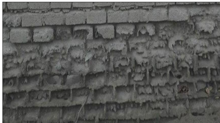
Figura 16. Erosión en muro de albañilería producido por agentes físicos. Fuente: Beltrán (2015)
