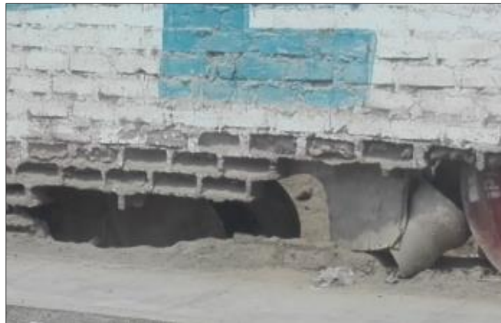
Figura 17. Desintegración del muro de albañilería. Fuente: Investigación propia (2019).
