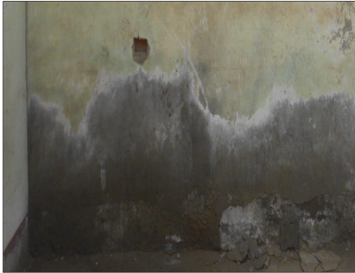
Figura 21. eflorescencia en muros del cerco perimétrico del ex local comercial los 6 hermanos, Chimbote – Perú. Fuente: Herrera (2016)
