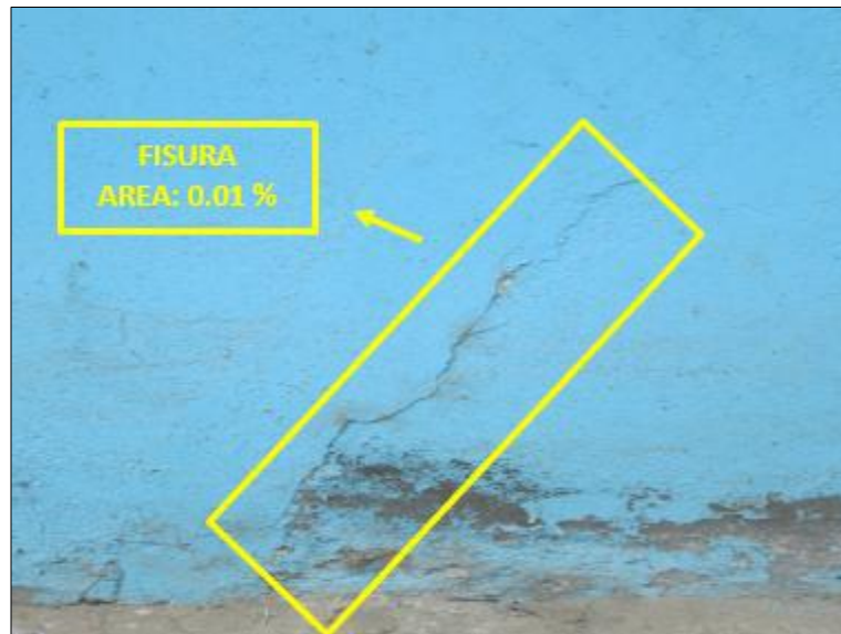
Figura 3. Fisura encontrada en la unidad de muestra 3 de la I.E. Inmaculada la merced, Chimbote – Perú. Fuente: Beltrán (2015).
