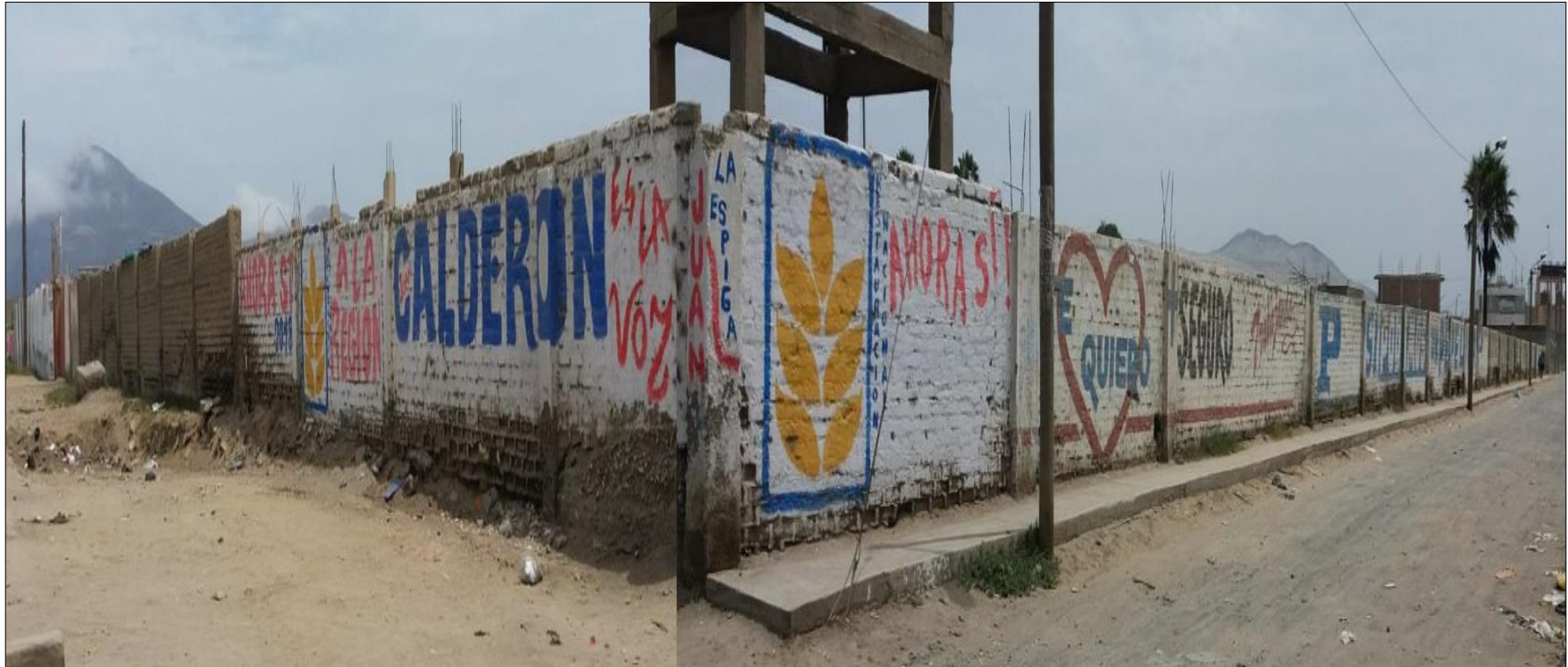
Imagen 1: En la vista del cerco perimétrico de la ferretería Faroni en el pueblo joven Dos de Mayo distrito de Chimbote, provincia del Santa, región Áncash, podemos observar las diferentes patologías que existen en dicho cerco.
