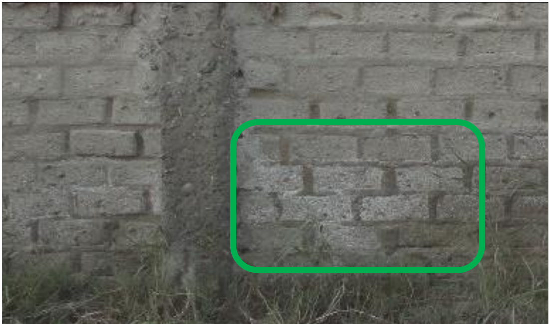
Imagen 7. Se puede apreciar a la eflorescencia como patología predominante en este muro de la unidad de muestra 06.
