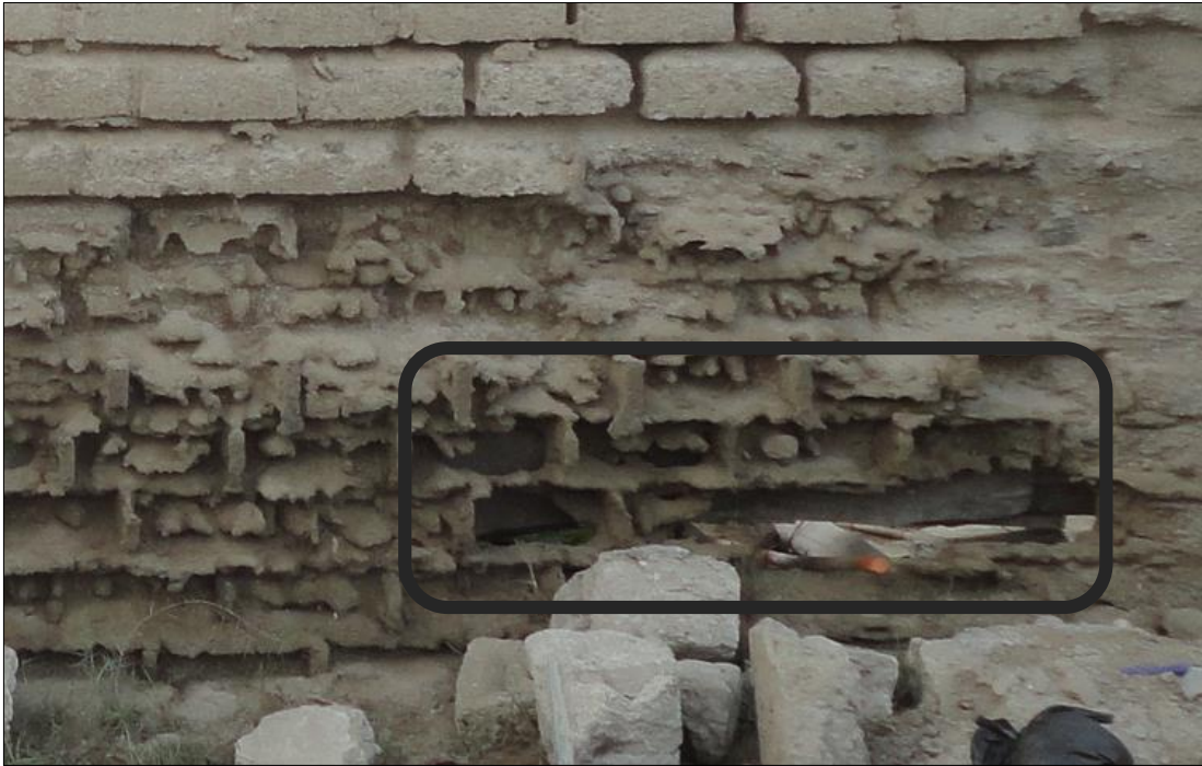
Imagen 10. En esta vista podemos notar a la patología desintegración en la unidad de muestra 07.
