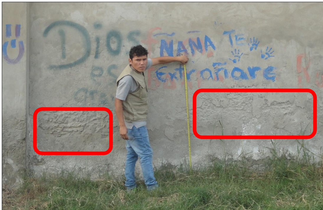
Imagen 8. Se visualiza la evaluación del muro de la unidad de muestra 03, encontrando a la patología sobresaliente, desprendimiento con un área afectada de 3.60 \text{ m}^2 .
