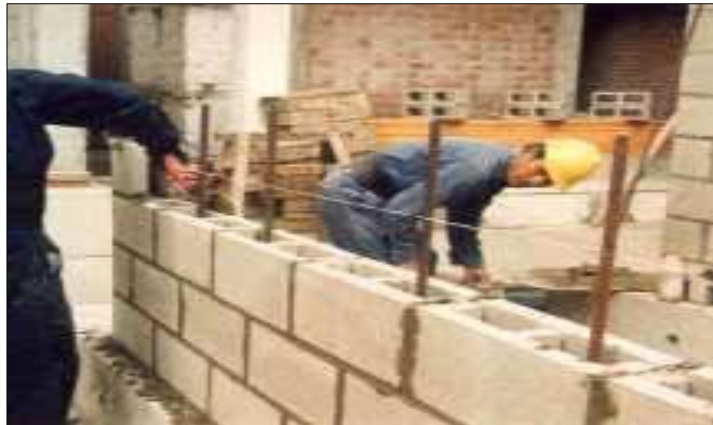
Figura 6. Proceso constructivo de un muro de albañilería armada. Lima – Perú. Fuente: San Bartolomé (2008)
