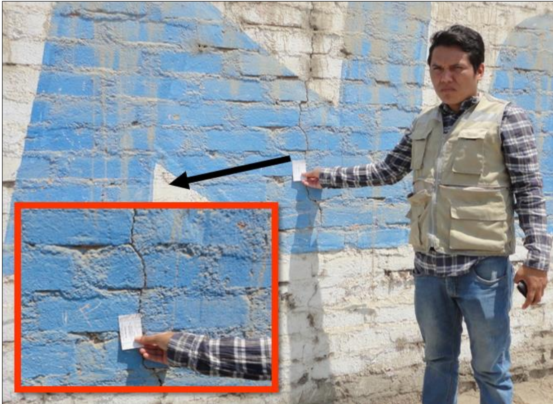
Imagen 15. En la imagen observamos la evaluación de la unidad de muestra 13 encontrando a la patología grieta con una abertura de 4 mm y un área de afectación de 0.23 \text{ m}^2 .
