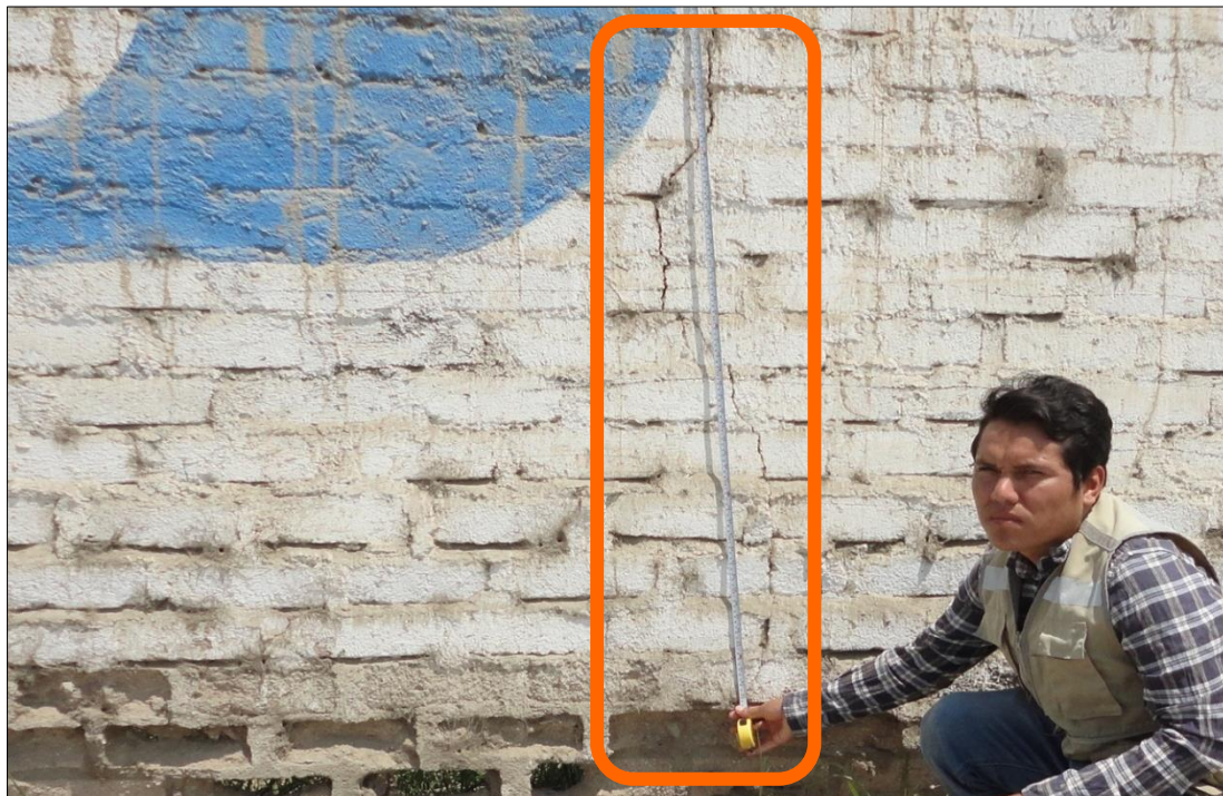
Imagen 16. En la imagen observamos la evaluación de la unidad de muestra 13 encontrando a la patología grieta con una abertura de 4 mm y un área de afectación de 0.23 \text{ m}^2 .
