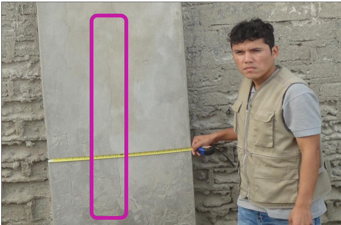
Imagen 11. Podemos observar la evaluación de la patología fisura con un área afectada de 0.30 \text{ m}^2 en la unidad de muestra 01.
