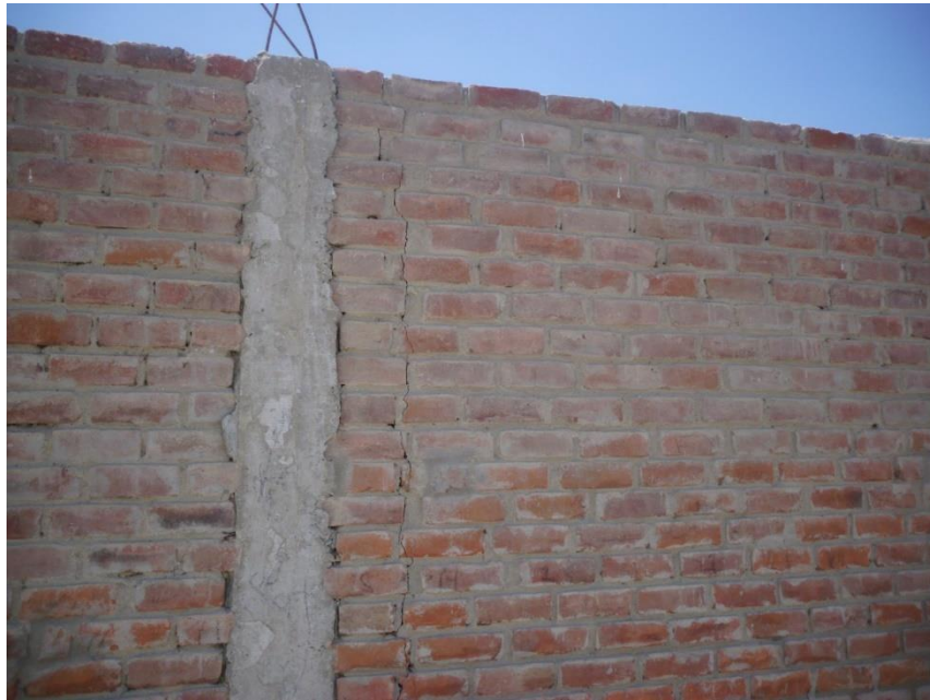
Gráfico 127: Grieta en muro y eflorescencia en muro del paño 02 de la Unidad de Muestra 18
