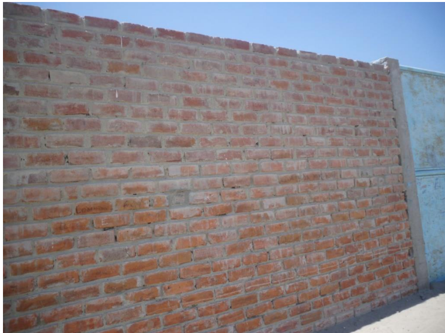
Gráfico 128: Eflorescencia en muro del paño 03 de la Unidad de Muestra 19
