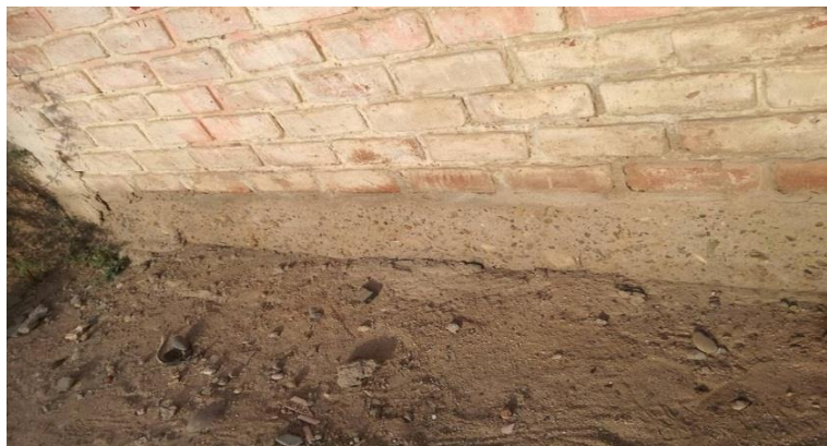
Gráfico 12: Erosión física en sobrecimiento.
