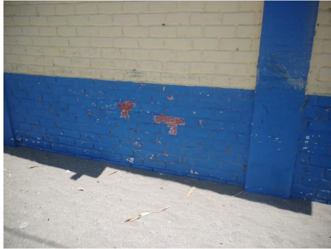
Gráfico 17: Daño por descascaramiento en muro.
