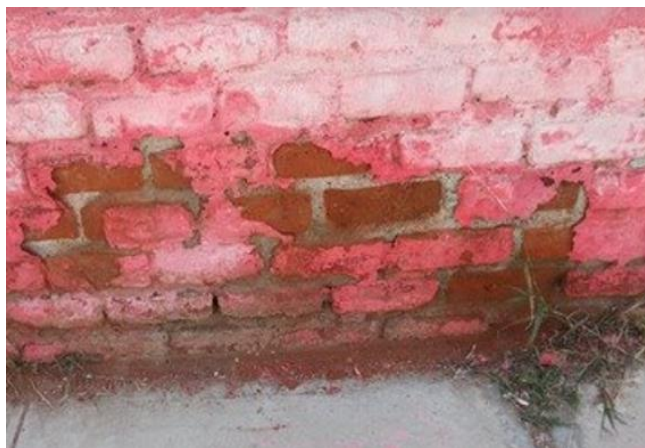
Gráfico 10: Humedad en muro de albañilería.
