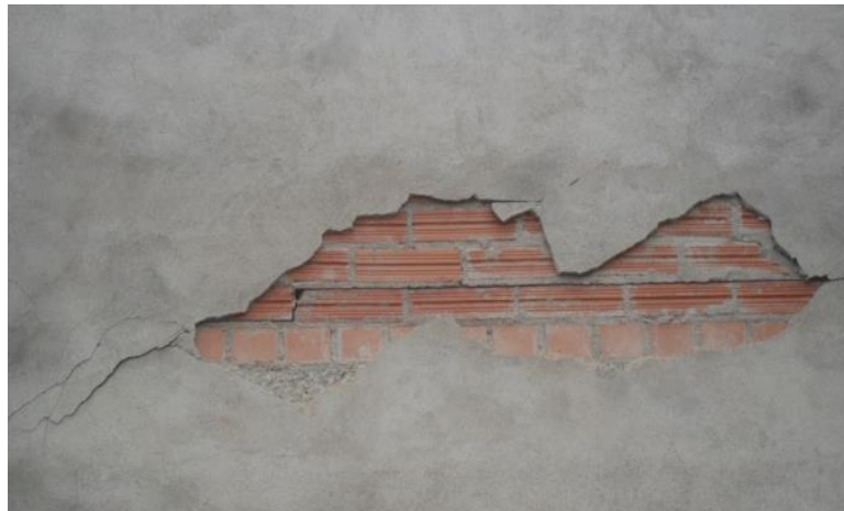
Gráfico 16: Desprendimiento de acabado en muro de albañilería
