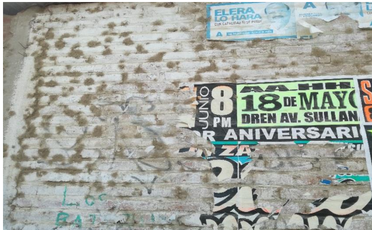
Gráfico 11: Suciedad en muro de albañilería.
