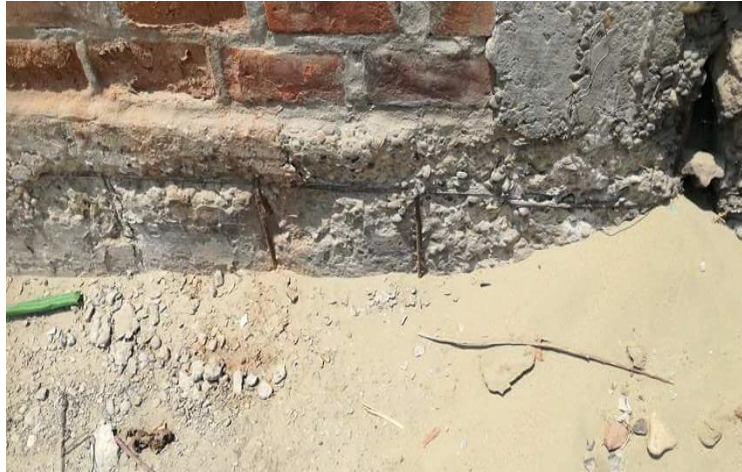
Gráfico 19: Corrosión del acero de refuerzo.
