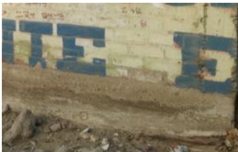
Gráfico 18: Eflorescencia en sobrecimiento
