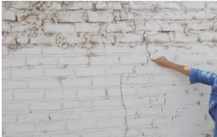
Gráfico 14: Grieta en muro de albañilería.
