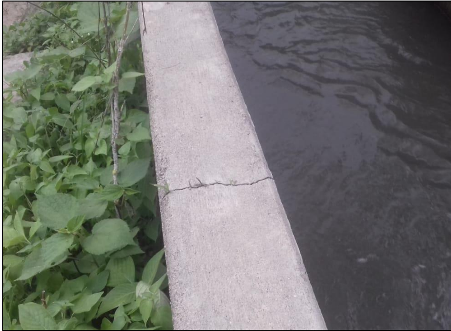
Gráfico 46: Fisuración vertical en losa lateral del canal
