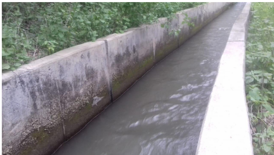
Gráfico 10: Presencia de musgos en losa lateral de canal.
