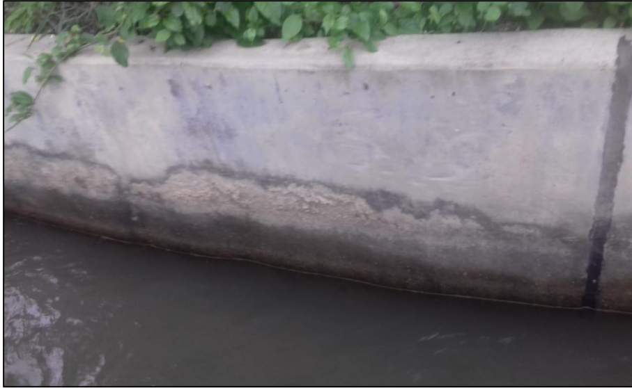
Gráfico 7: Erosión en losa lateral del canal de concreto.
