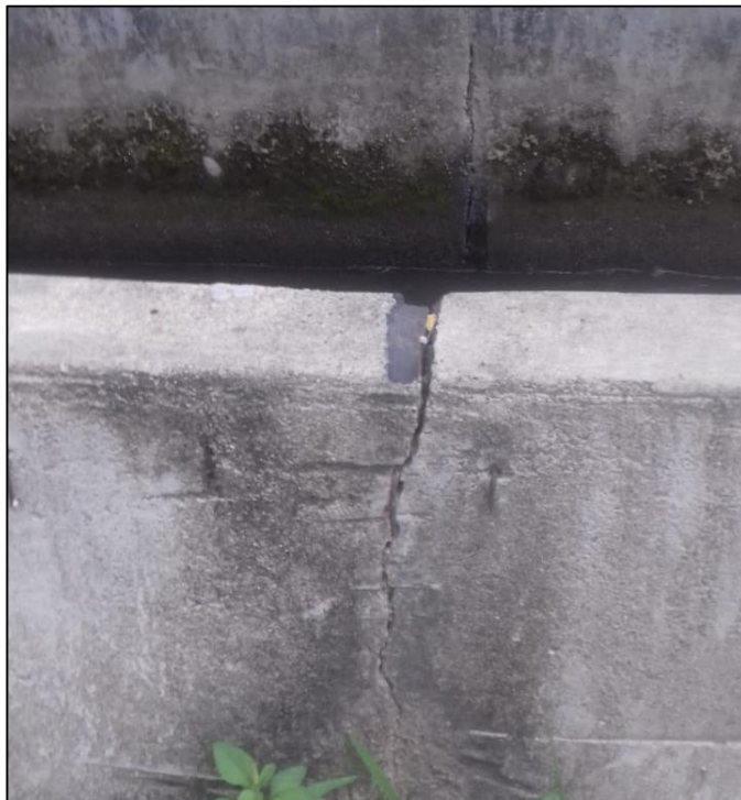
Gráfico 45: Fisuración de losa lateral del canal
