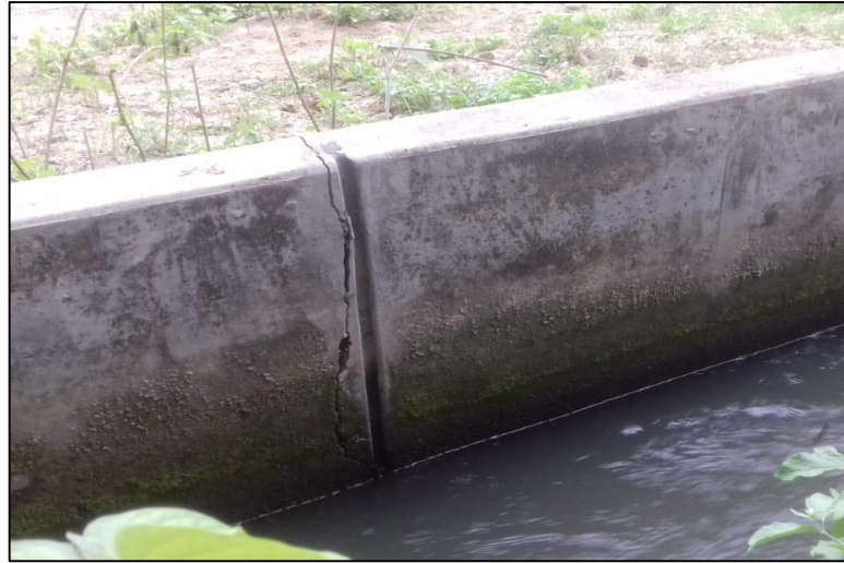
Gráfico 9: Grieta en muro lateral de canal
