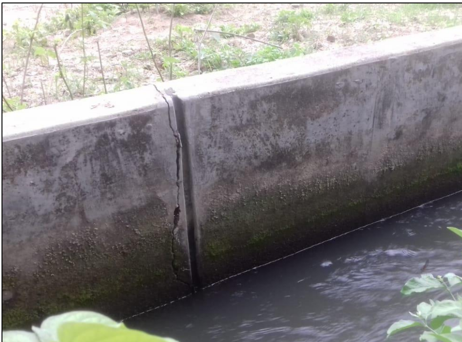
Gráfico 43: Agrietamiento vertical en losa lateral del canal
