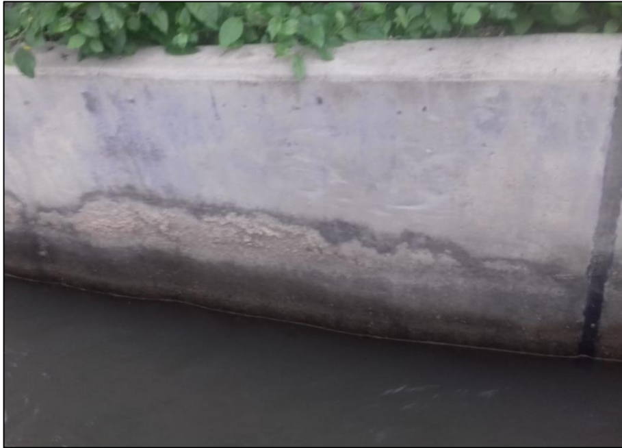
Gráfico 42: Erosión en losa lateral del canal.
