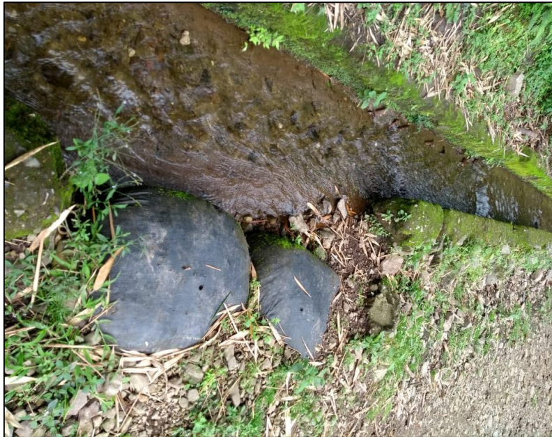
Gráfico 8: Desprendimiento en concreto.
