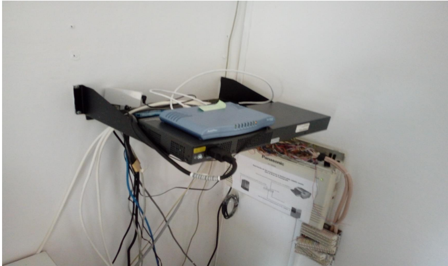
Gráfico N°: 13 Cableado del Ambiente de Tomografía
