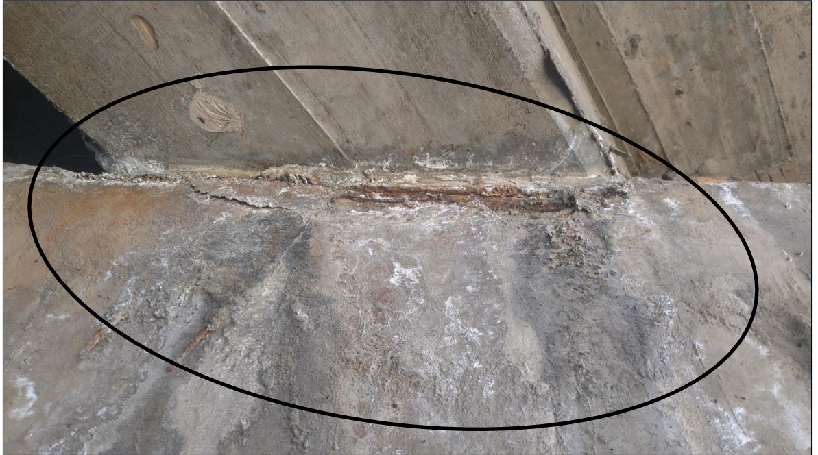
Fig 18. Corrosión y eflorescencia en puntos de apoyo
