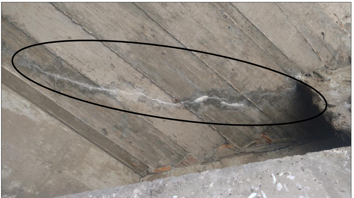
Fig 15. Grietas en la plataforma (interior)
