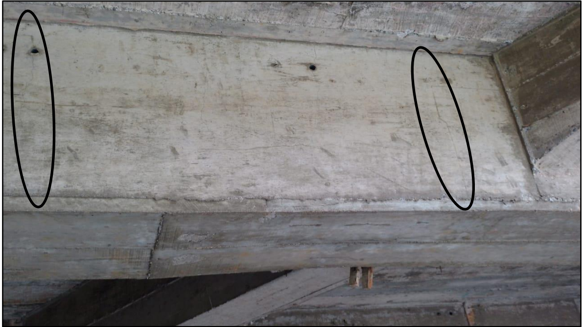
Fig.20. Grietas vivas en Vigas principales.
