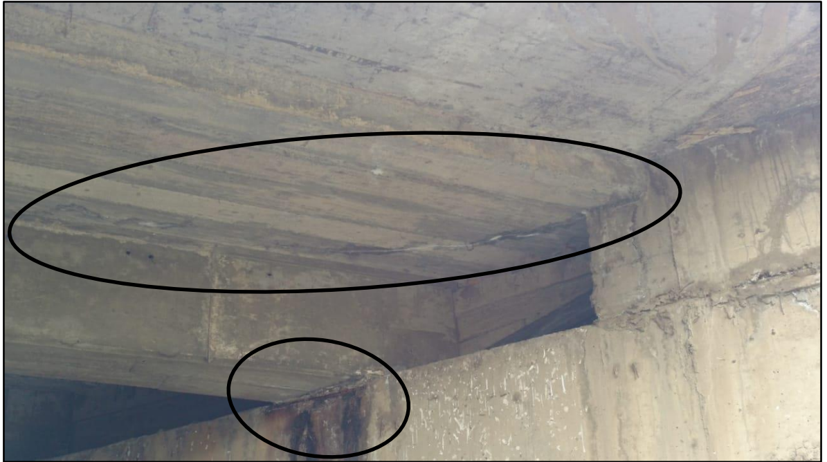
Fig. 16. Oxidación - grietas en Tablero y Apoyo
