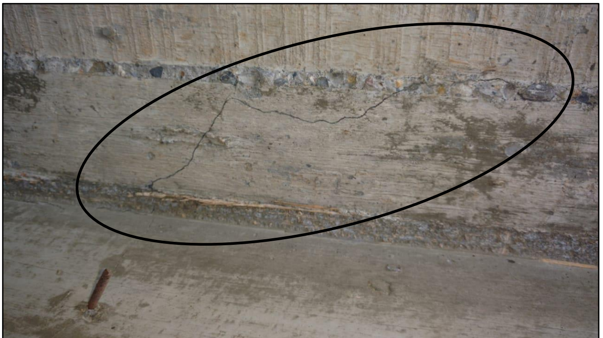
Fig.17. Grietas en Tablero
