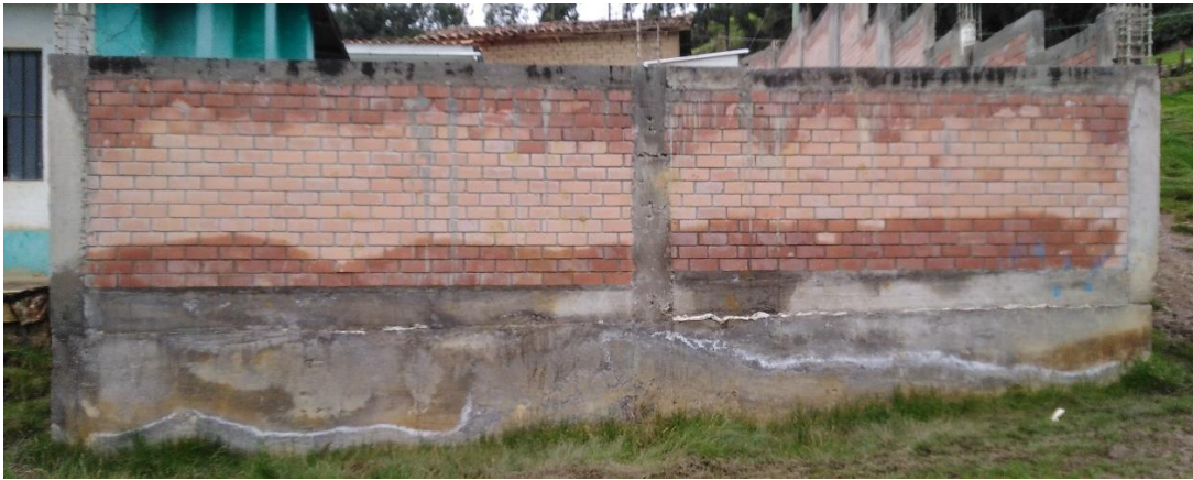
Fotografía 18: Eflorescencia en sobrecimiento de la unidad de muestra 14.
