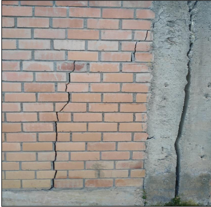
Fotografía 12: Grieta en muro de la unidad de muestra 3.
