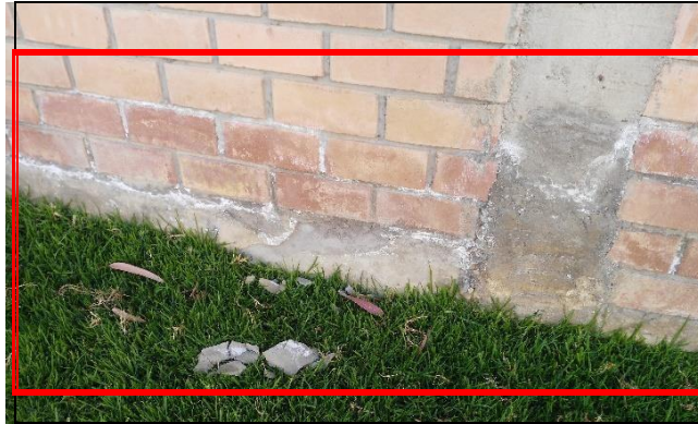
Figura 16. Eflorescencia en muro y columna de albañilería confina.
