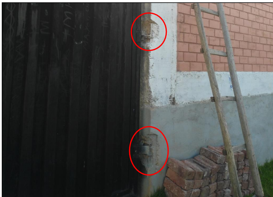
Fotografía 16: Erosión mecánica en columna de la unidad de muestra 6.
