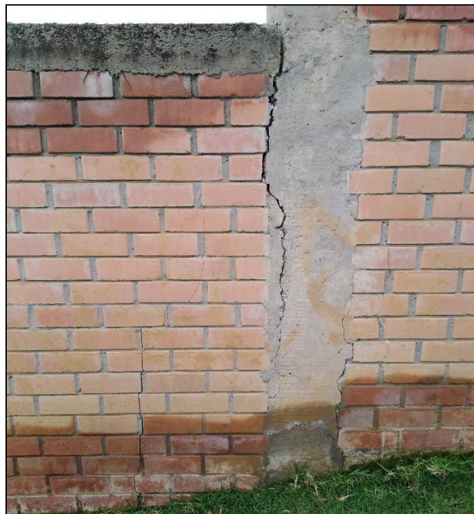
Fotografía 13: Grieta entre muro y columna de la unidad de muestra 16
