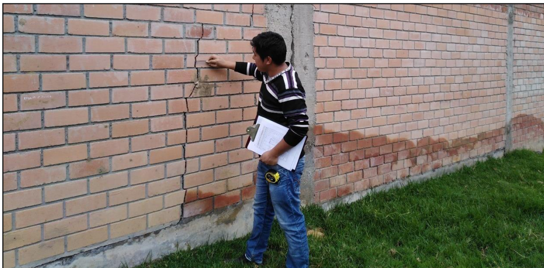
Fotografía 22: Midiendo la grieta en la unidad de muestra 3.
