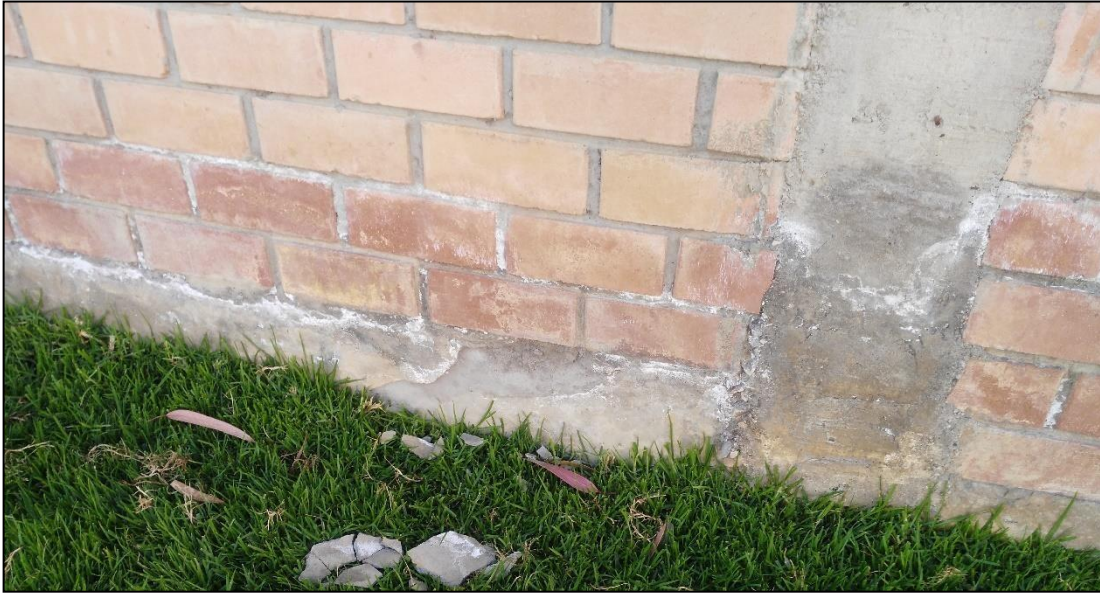
Fotografía 17: Eflorescencia en muro y columna de la unidad de muestra 2.
