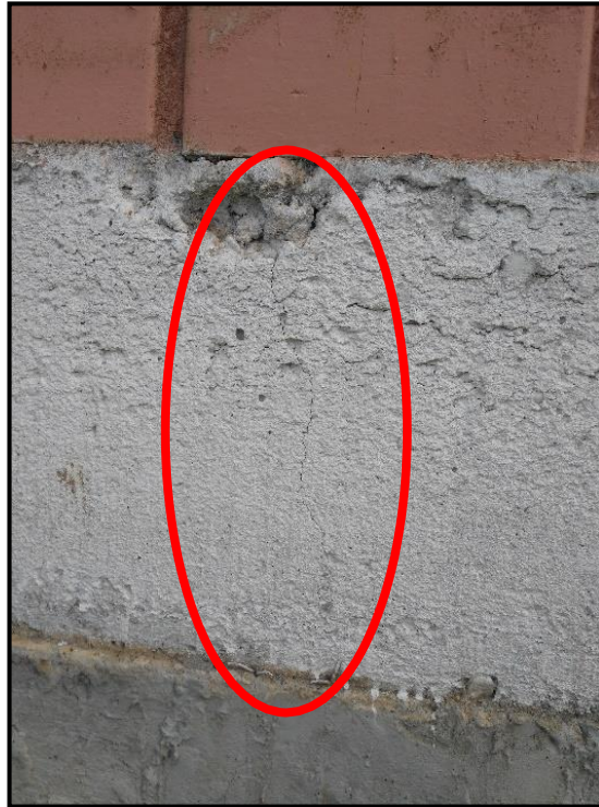
Figura 11. Fisura en sobrecimiento
