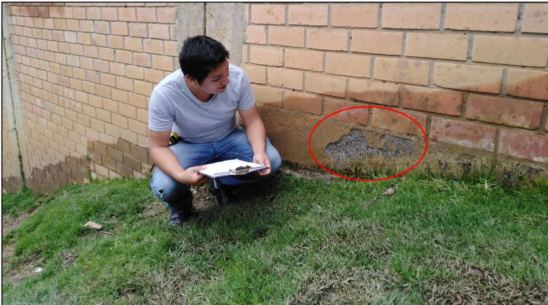
Fotografía 20: Observando la erosión en sobrecimiento unidad de muestra 16.
