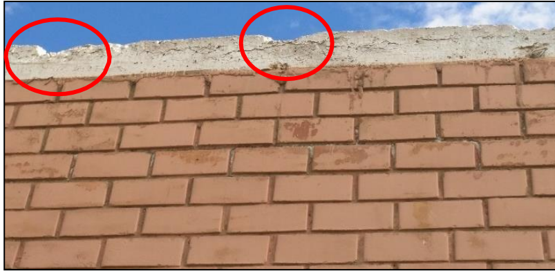
Figura 14. Erosión en viga de albañilería confinada
