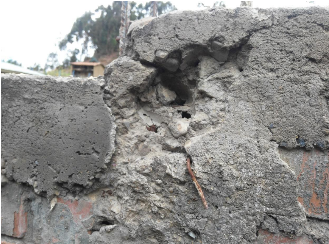
Fotografía 14: Erosión en viga de la unidad de muestra 10.
