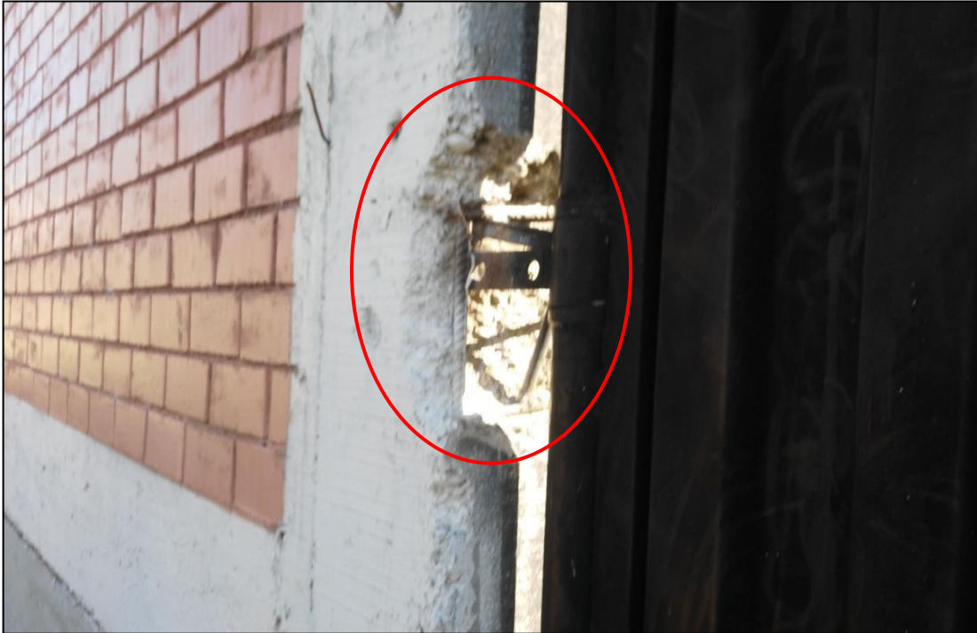
Fotografía 15: Erosión mecánica en columna de la unidad de muestra 5.
