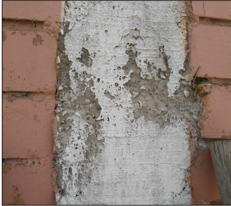
Fotografía 14: Erosión en columna de la unidad de muestra 8.
