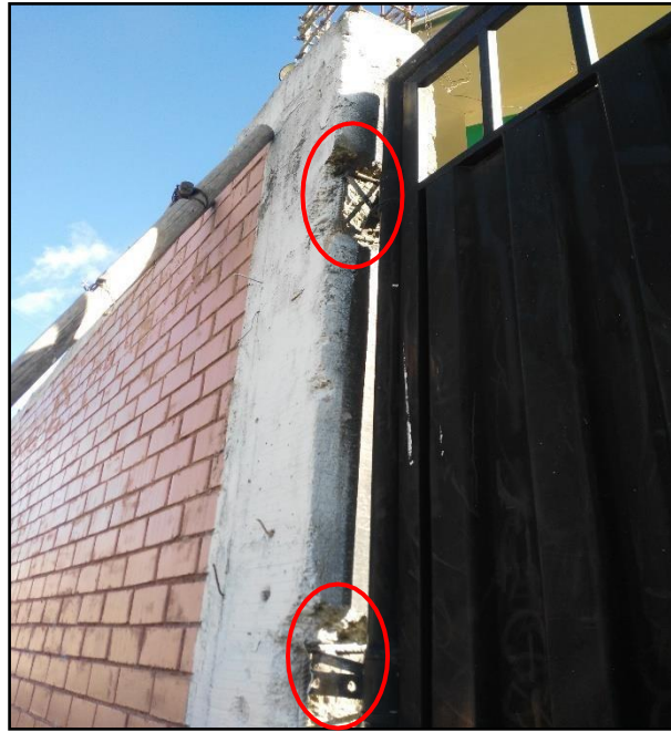
Figura 15. Erosión mecánica en columna de albañilería confina.
