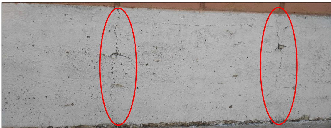
Fotografía 11: Fisura en sobrecimiento de la unidad de muestra 6.
