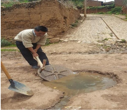
Foto 25. Imagen de buzón emisor, rebosando el desagüe a las calles.
