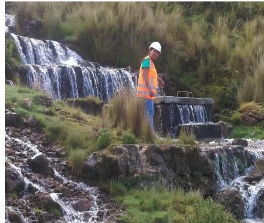
Foto 5. Captación de Lechemayo, en uso, pero con un deterioro muy marcado.
