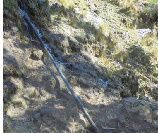
Foto 10. Imagen de la tubería de conducción totalmente expuesta con fugas.
