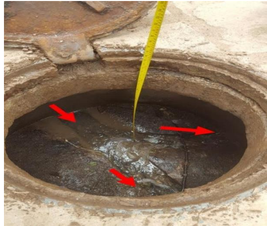
Foto 23. Buzón de alcantarillado colector totalmente colapsado, con sedimentos y residuos sólidos extraños.
