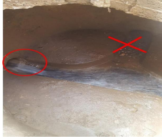
Foto 22. Interior de buzón colector, donde se ve la presencia de sedimentos en una de las entradas.
