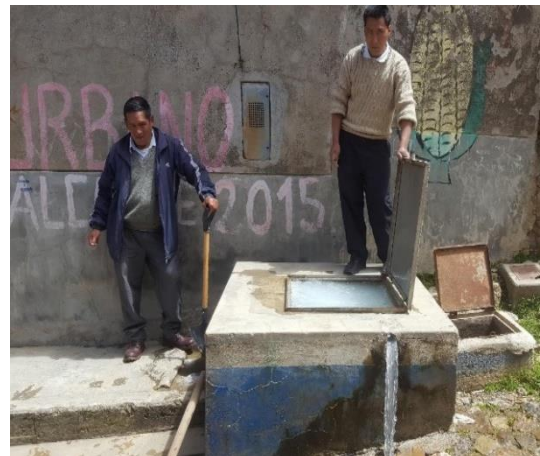
Foto 17. CRP T-7, ubicada en Jr. Huanta, su deterioro y el mal rebose es evidente.
