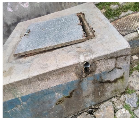
Foto 18. CRP T-7, ubicada en Jr. Tupac Amaru en grave estado de deterioro y tapa sanitaria sin fijar.
