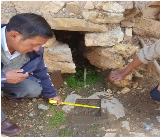
Foto 20. Caja de válvula de paso, de medidas reducidas y tapa malograda.
