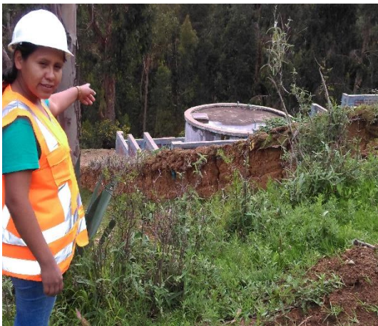
Foto 15. Vista del techo del reservorio, se observa el deterioro y la acumulación de aguas de lluvias.
