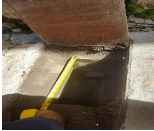
Foto 24. Caja de registro de dimensiones 0.18 x 0.25 m, en mal estado y con tapa sanitaria oxidada.
