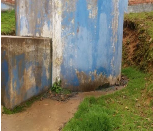
Foto 13. Reservorio actual, con capacidad de 70m 3 , donde se puede apreciar el estado su deterioro.
