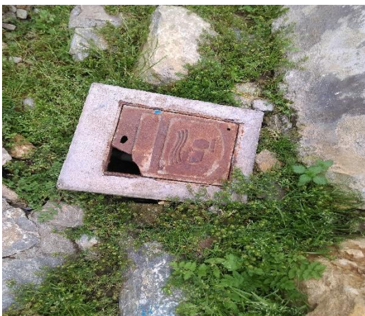
Foto 21. Caja de válvula de paso de agua, tapa oxidada y rota.
