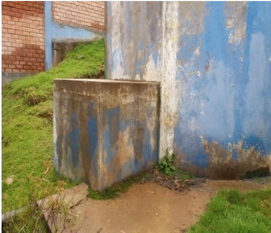
Foto 14. Imagen de la caja de válvulas del reservorio, totalmente deteriorada.
