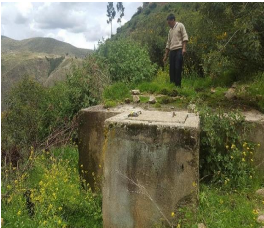
Foto 26. Pozos sépticos, totalmente colapsado y en desuso, el agua residual retorna al ambiente sin tratamiento.
