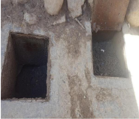
Foto 19. Cajas de registro de desagüe colmatadas con agua residual, e incluso sin tapa sanitaria.
