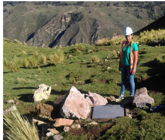
Foto 11. Cámara Rompe Presión T-6 en la línea de conducción, deteriorada y con tapa sin fijar.
