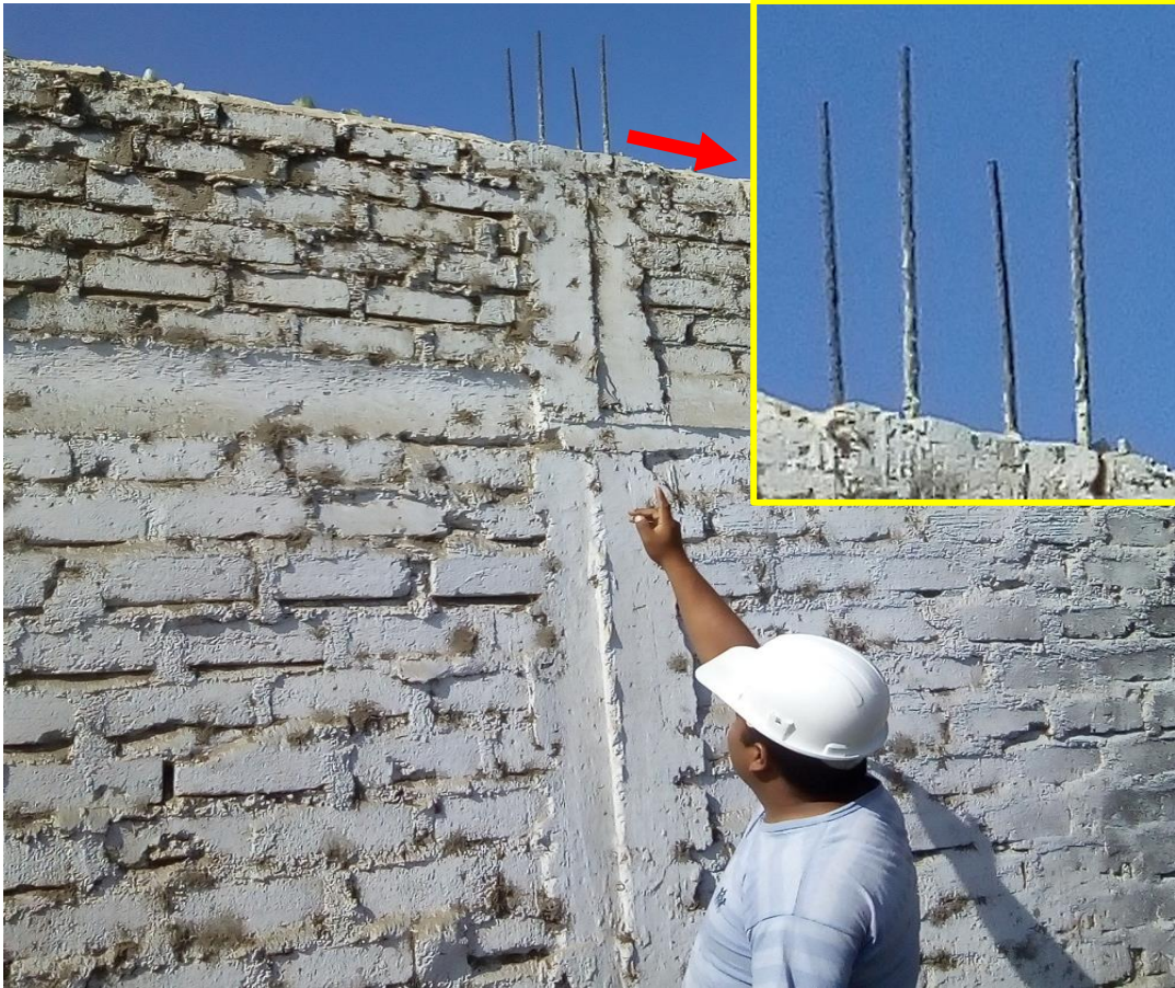
Figura 19: Se aprecia la patología corrosión
