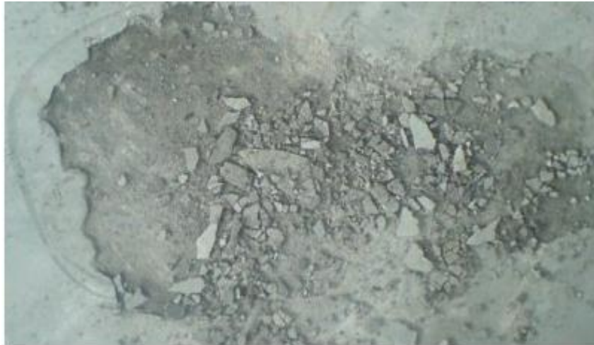
Figura 12: imagen de delaminación
