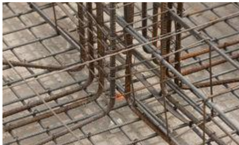
Figura 14: imagen de oxidación en el acero
