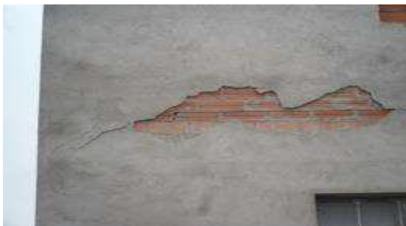
Figura 11: imagen de desintegración en el muro de tarrajeo
