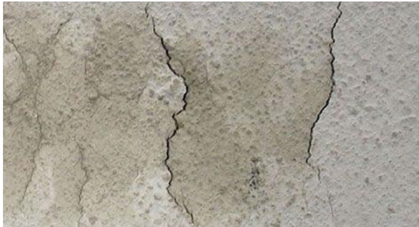
Figura 09: imagen de fisuras en muros
