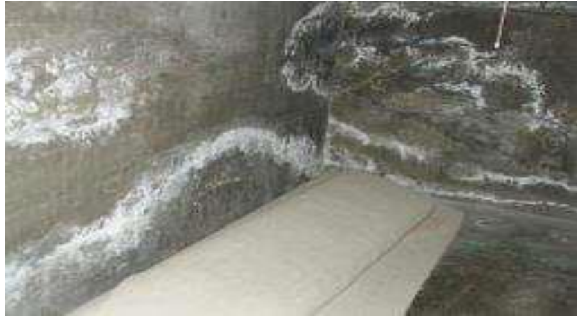
Figura 10: imagen de eflorescencia en muros.
