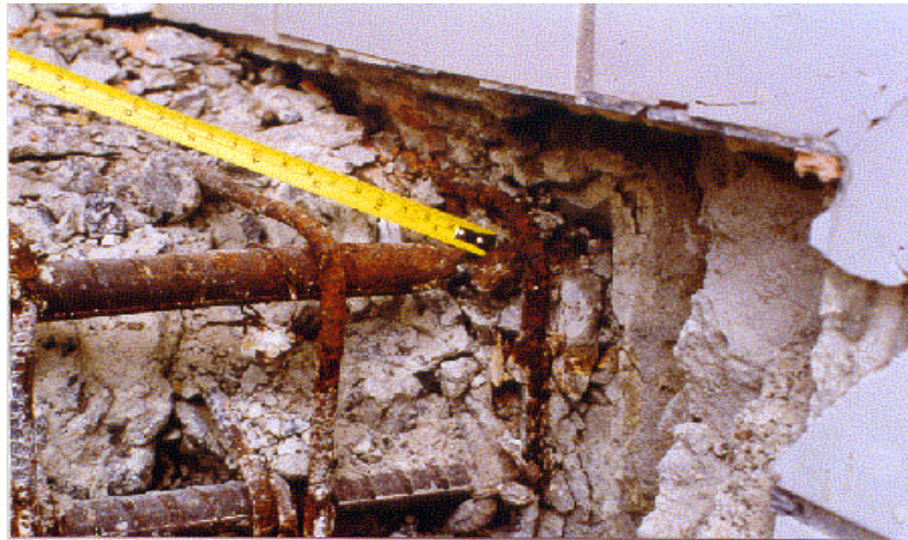
Figura 13: imagen de corrosión en el acero
