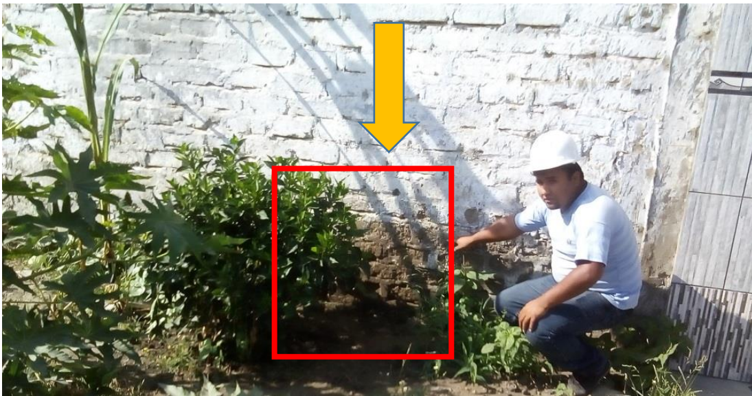
Figura 18: Se aprecia la patología de EFLORESCENCIA y presencia orgánica, en la unidad de muestra 14.
