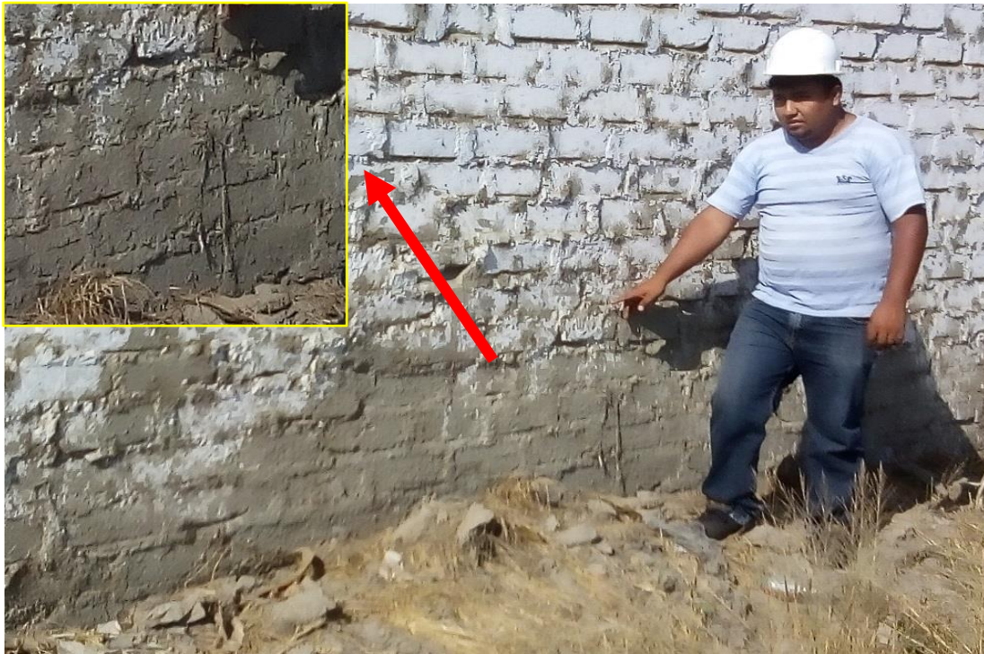
Figura 20: Se aprecia la patología delaminación
