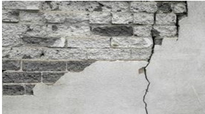
Figura 08: imagen de grieta en muro.
