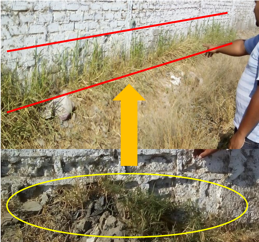
Figura 21: Se aprecia la patología por eflorescencia
