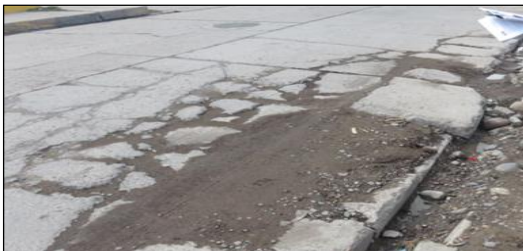
Imagen N° 10: Daño por punzonamiento.
