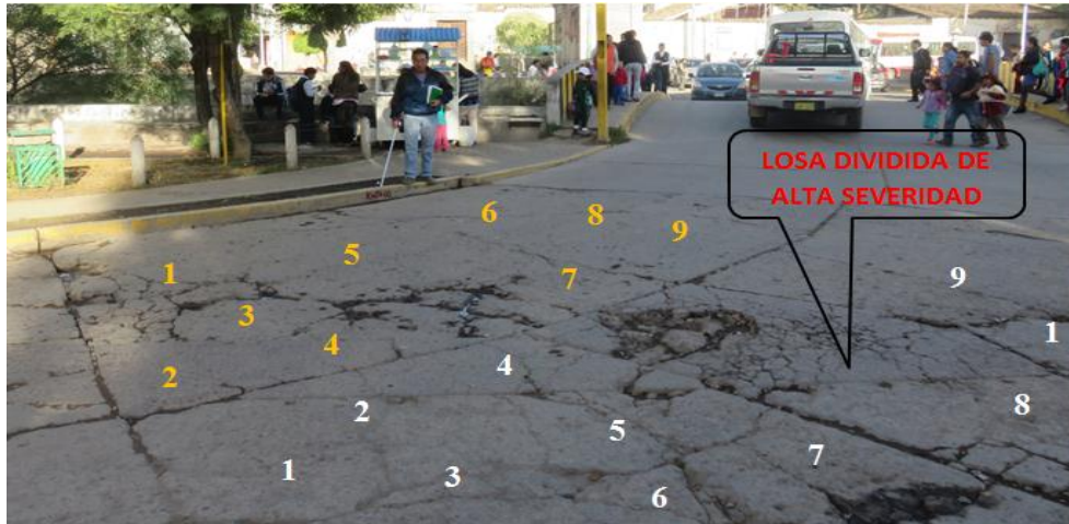
Identificación de la losa dividida de alta severidad
