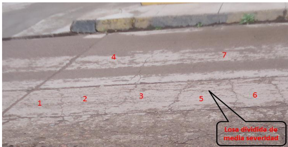
Identificación de losa dividida de media severidad
