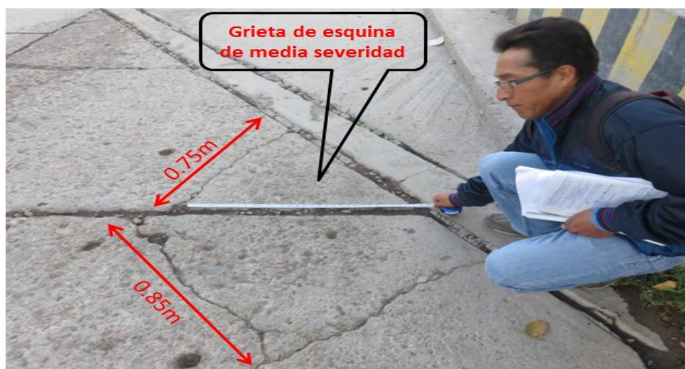
Identificación de grieta de esquina de media severidad
