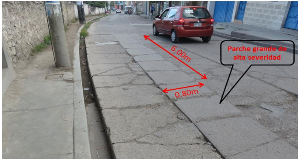
Identificación de parche grande de alta severidad
