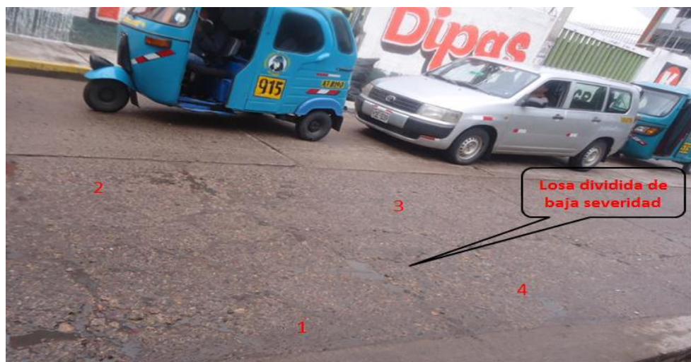
Identificación de losa dividida de baja severidad
