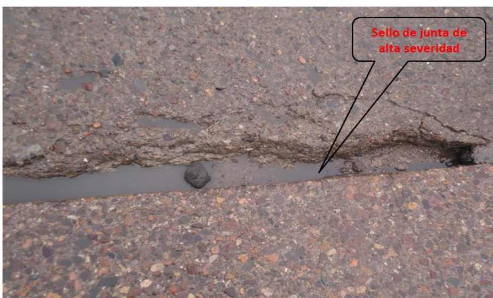
Identificación de sello de junta de alta severidad
