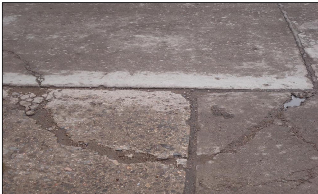
Imagen N° 01: Daño de grieta de esquina.
