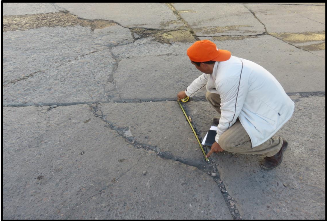
Medición de grietas de esquina en la av. Mariscal Cáceres cuadra 1
