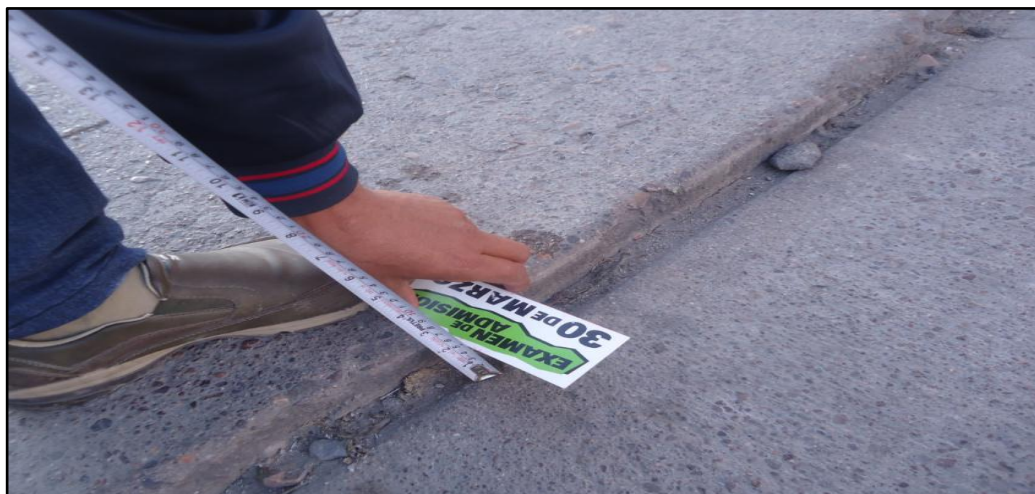
Imagen N° 03: Daño de escala
