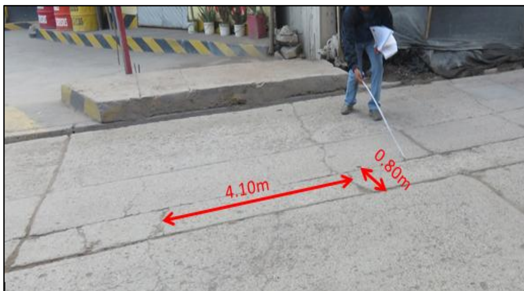
Imagen N° 06: Daño por parche grande.
