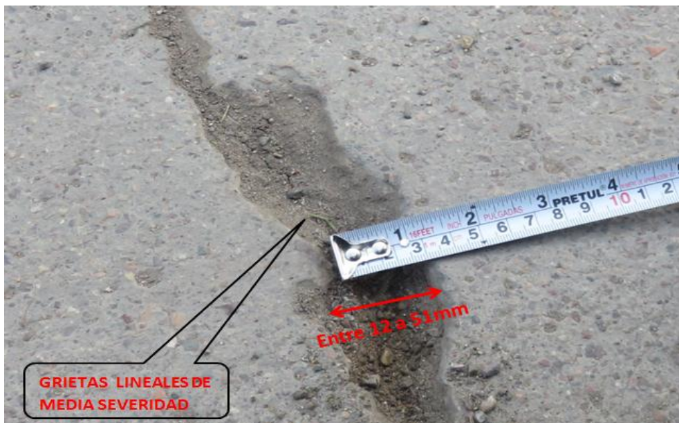
Identificación de grieta lineal de mediana severidad
