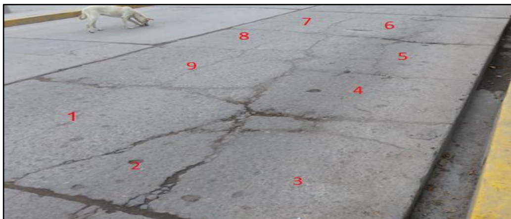
Imagen N° 02: Daño de losa dividida
