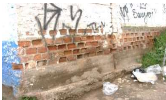
Figura 22. Erosión de tipo químico en ladrillos.
