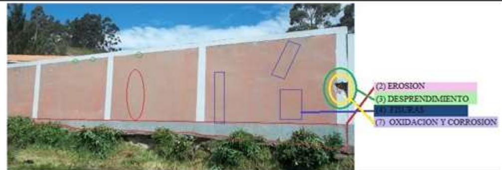
FOTOGRAFIA DE LAS PATOLOGIAS EN LOS EJES
