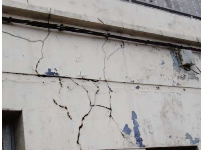
Figura 17. Fisurara en pared de vivienda.
