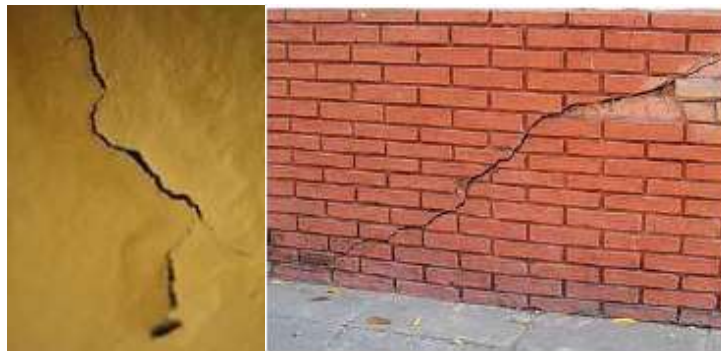
Figura 16. Grieta en las construcciones debido a acciones mecánicas.
