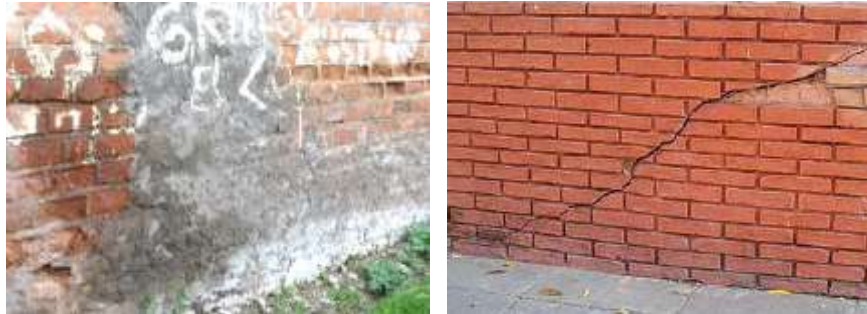
Figura 23. Patología en muros de albañilería.
