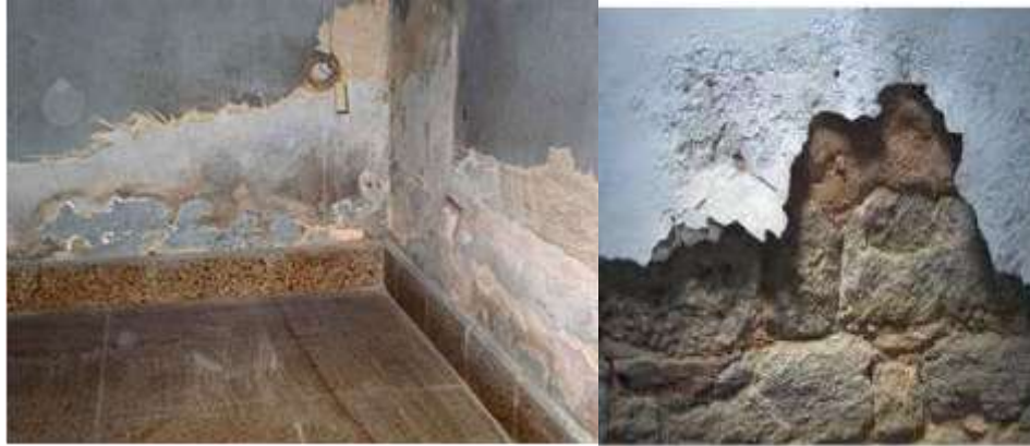
Figura 14. Ataque erosivo a la construcción.
