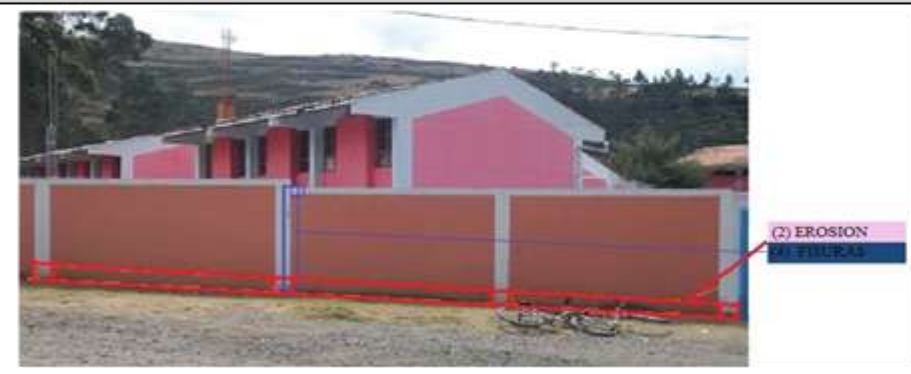
FOTOGRAFIA DE LAS PATOLOGIAS EN LOS EJES
