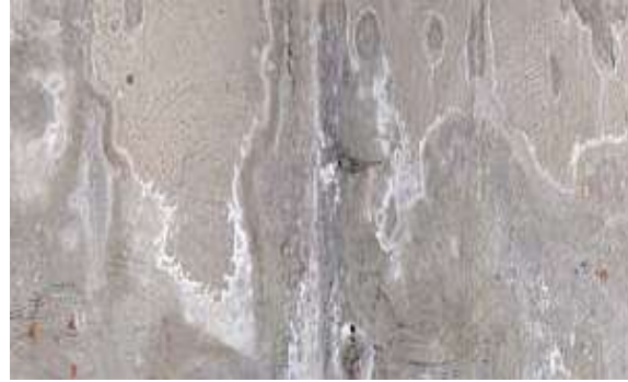
Figura 20. Eflorescencia debido a la humedad por capilaridad.
