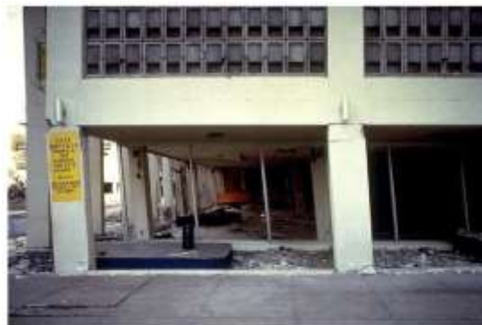
Figura 15. Deformación de estructuras debido a las acciones mecánicas.
