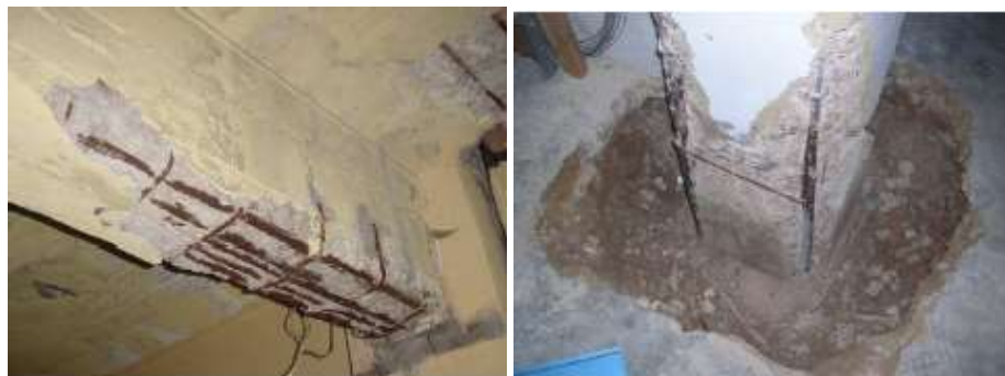
Figura 21. Típico oxidación y corrosión en estructuras.
