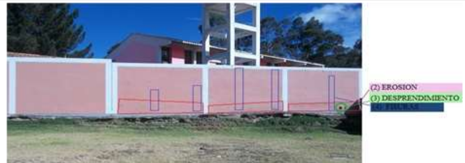
FOTOGRAFIA DE LAS PATOLOGIAS EN LOS EJES
