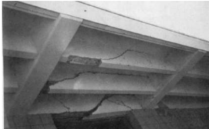
Figura 18. Desprendimiento de restos de concreto de la estructura.
