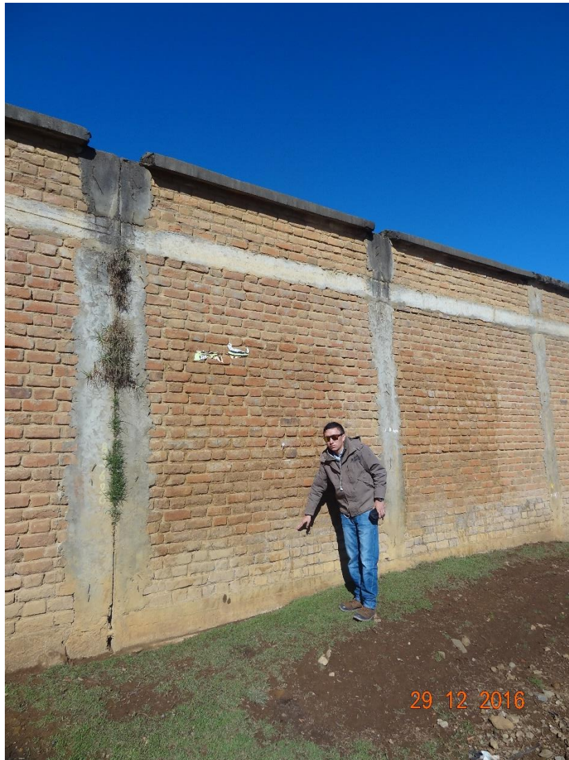
Imagen 9 : Humedad en Muros - Unidad de Muestra 10
