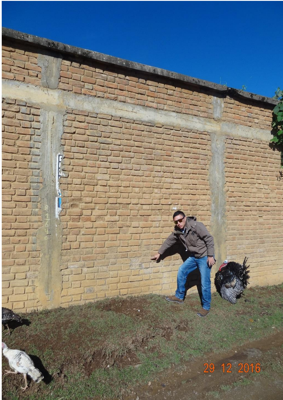
Imagen 6 : Eflorescencia en muros de la unidad de muestra 07
