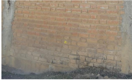
Imagen 1: Humedad en Muros y Columnas de Albañilería Confinada
