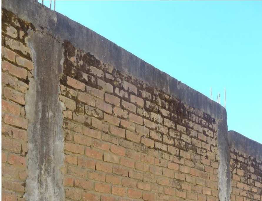
Imagen 3 : Suciedad en muros.
