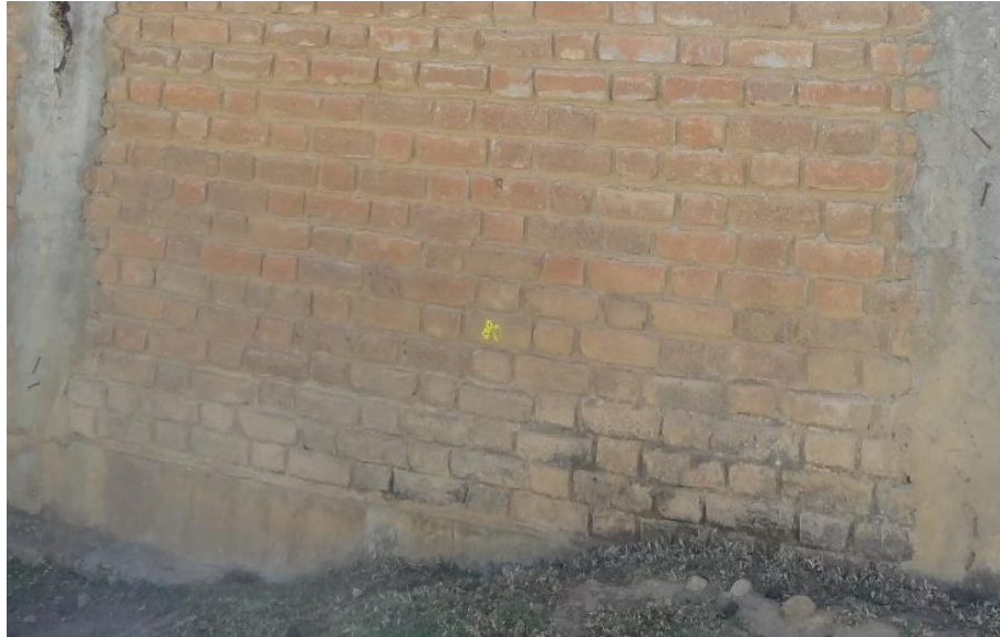
Imagen 2 : Eflorescencia en muros.
