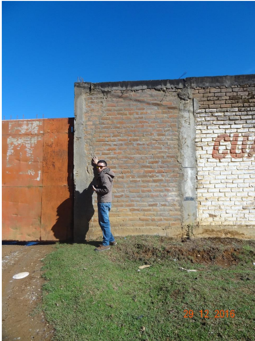
Imagen 10 : Erosión en Muros - Unidad de Muestra 01
