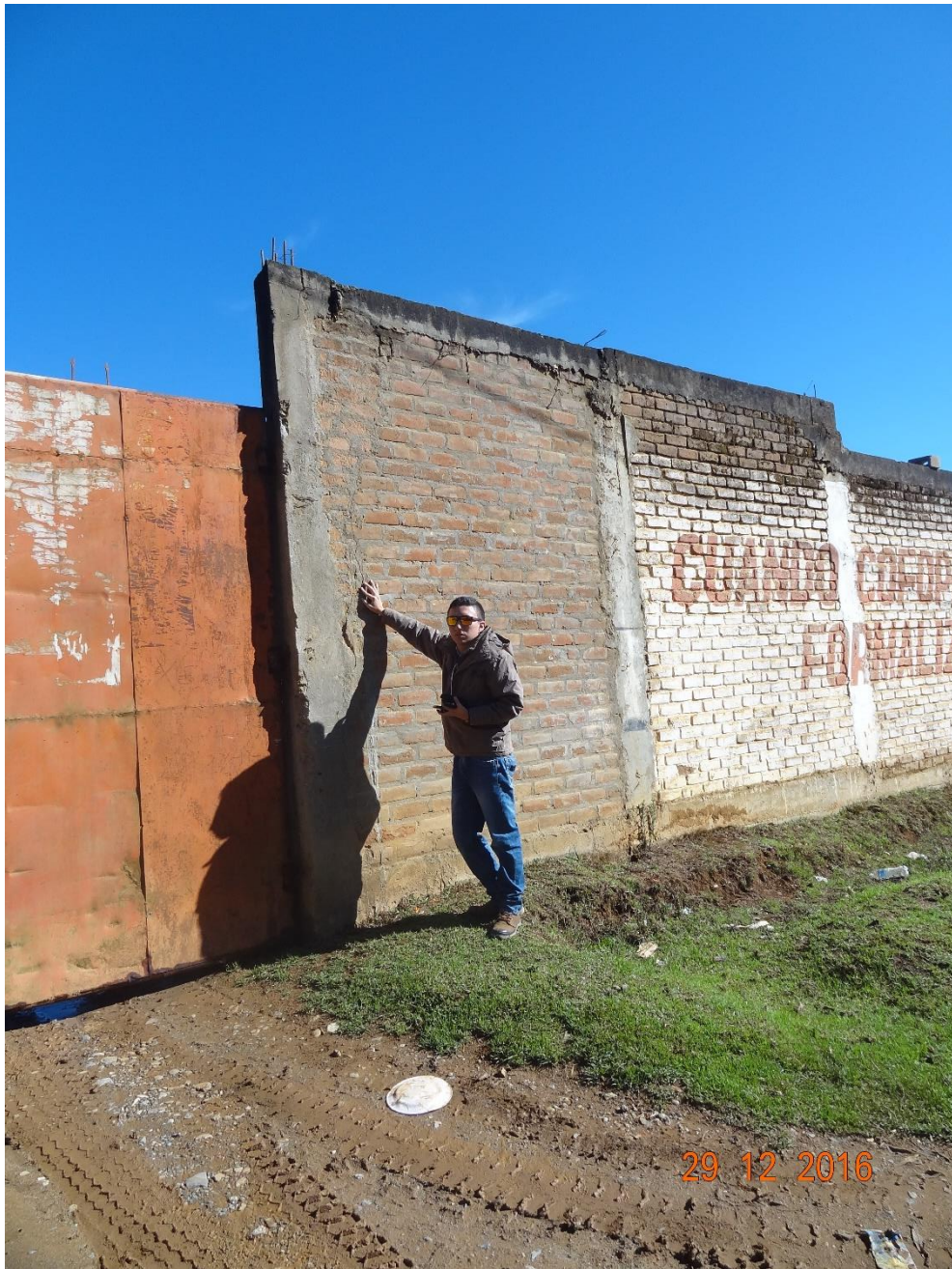
Imagen 8 : Presencia de Grietas en Muros - Unidad de Muestra 01
