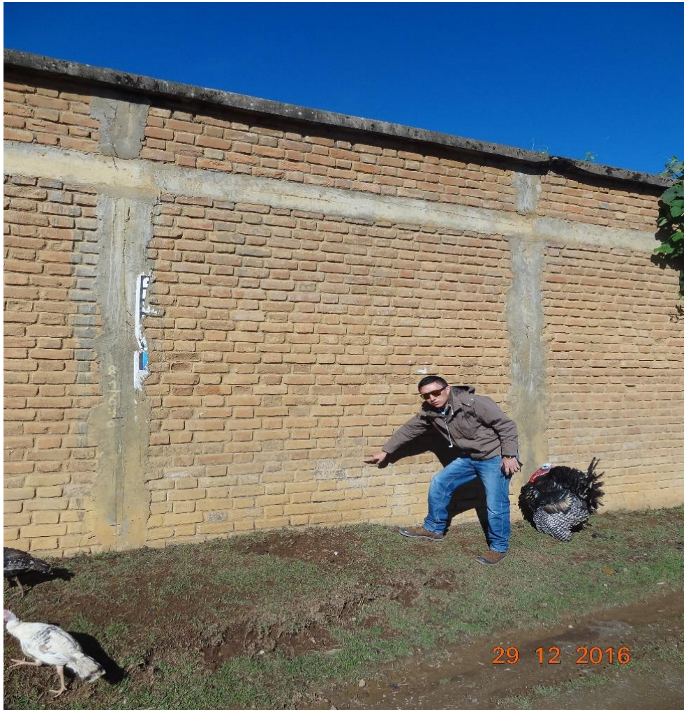
Imagen 11 : Presencia de Eflorescencia en Muros
