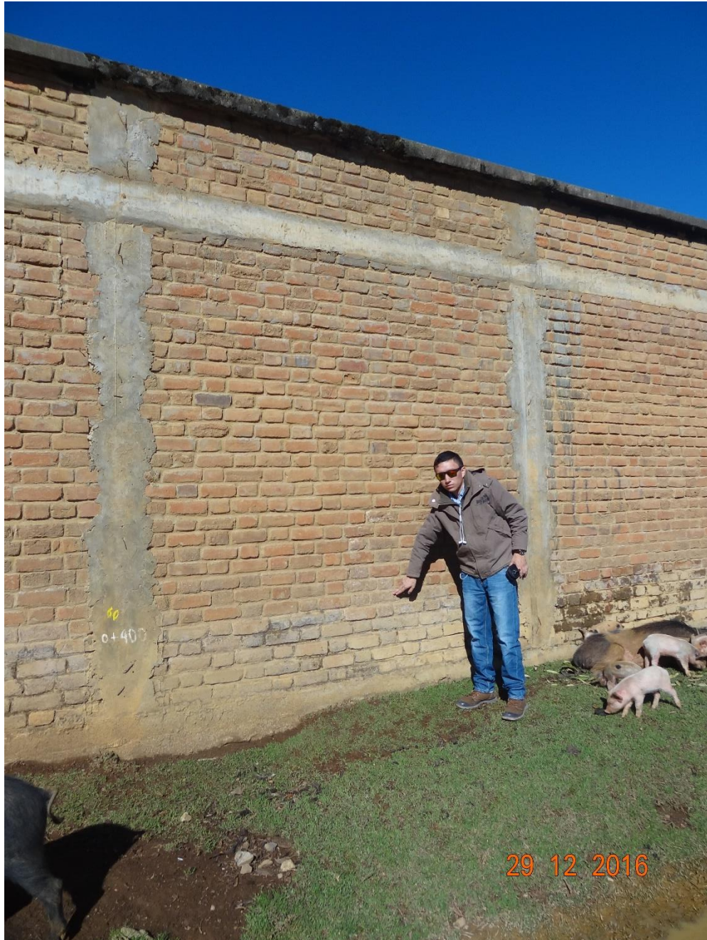
Imagen 5 : Eflorescencia en muros y columna unidad de muestra 09
