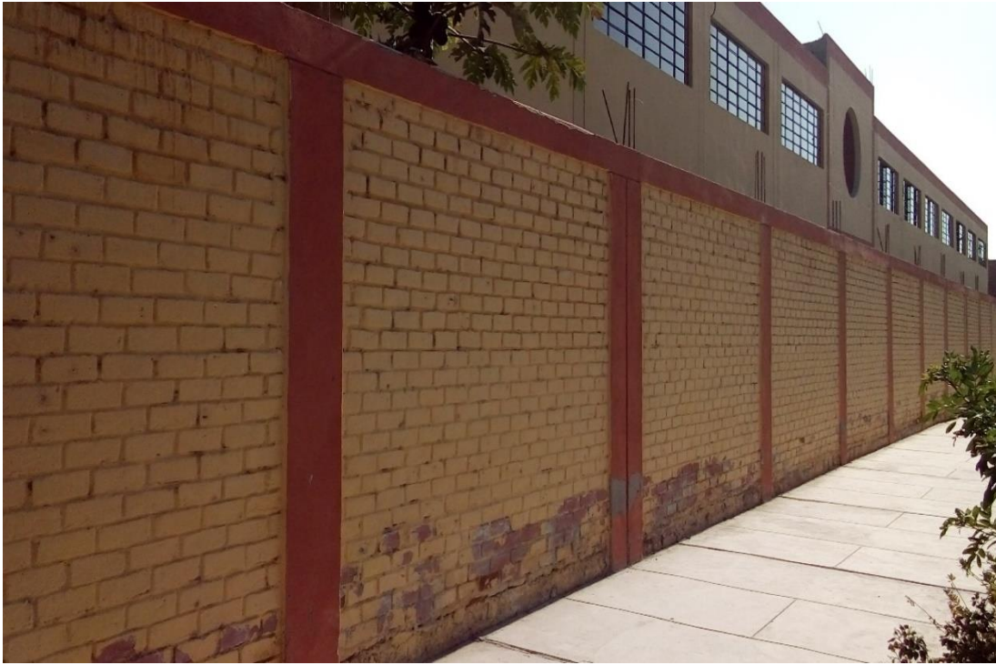
Imagen 16: Eflorescencia ubicada en la av. Independencia unidad de muestra 07.
