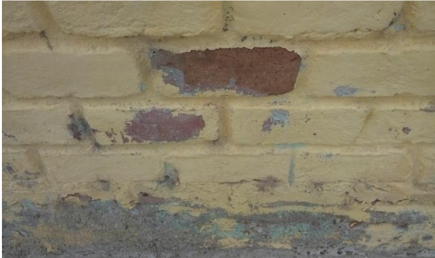
Imagen 10: Picadura en ladrillo.
