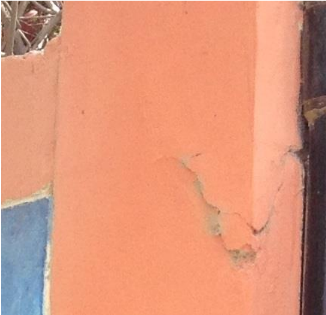
Imagen 18: Fisuras ubicadas en la calle s/n unidad de muestra 12.
