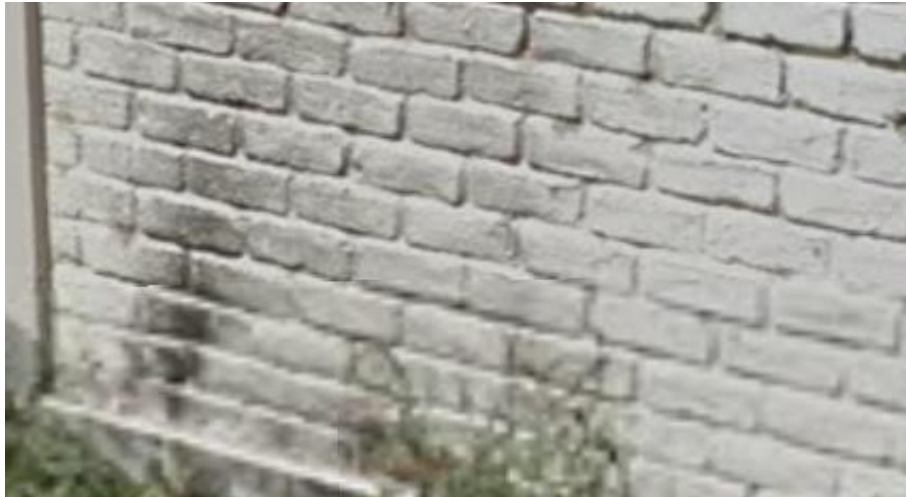
Imagen 4: Suciedad en muros.
