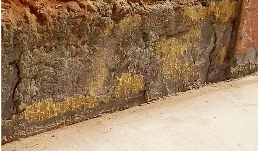
Imagen 3: Desprendimientos de concreto.
