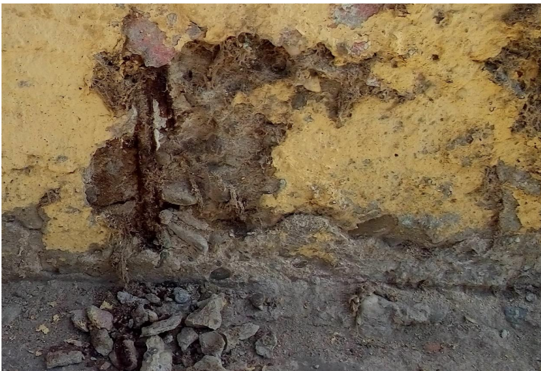
Imagen 15: Corrosión ubicada en la av. Independencia unidad de muestra 05.
