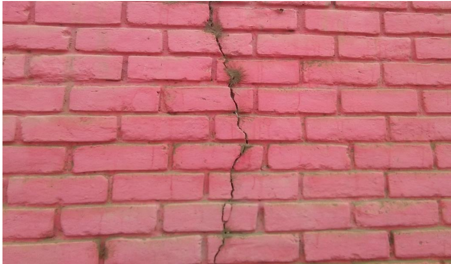
Imagen 8: Grietas en muros.
