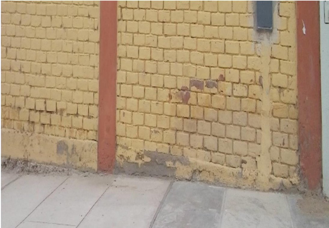
Imagen 14: Humedad ubicada en la av. Independencia unidad de muestra 01.
