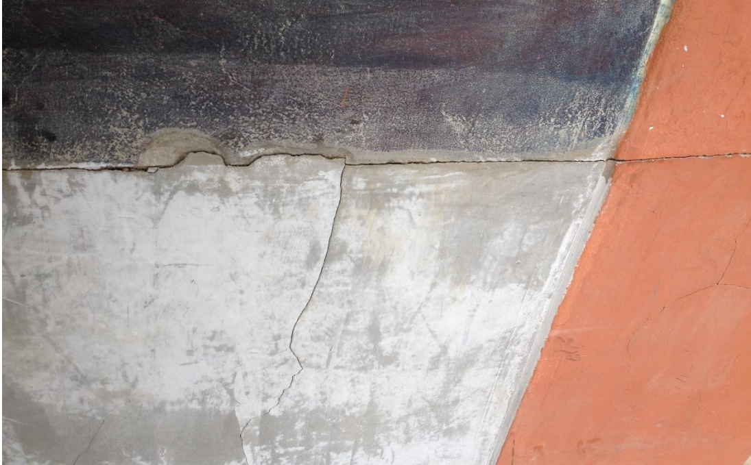
Imagen 27: Reparación de Fisuras
