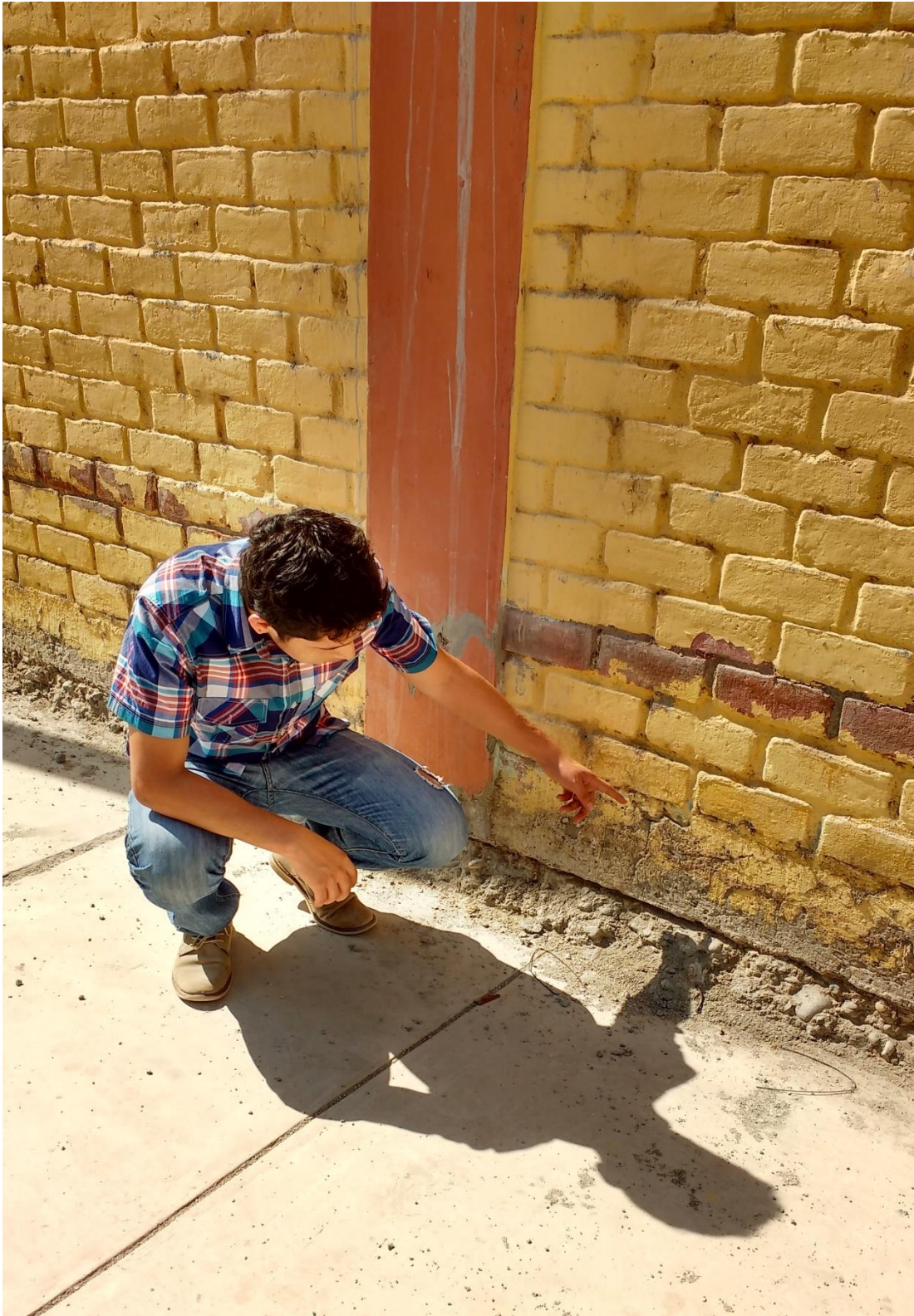
Imagen 13: Desprendimientos ubicada en la av. Independencia unidad de muestra 04.
