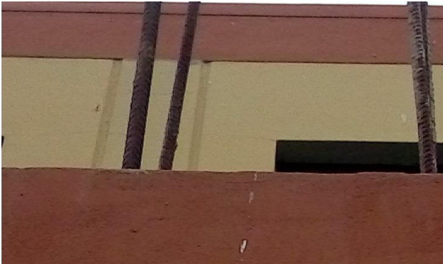
Imagen 9: oxidación de acero.
