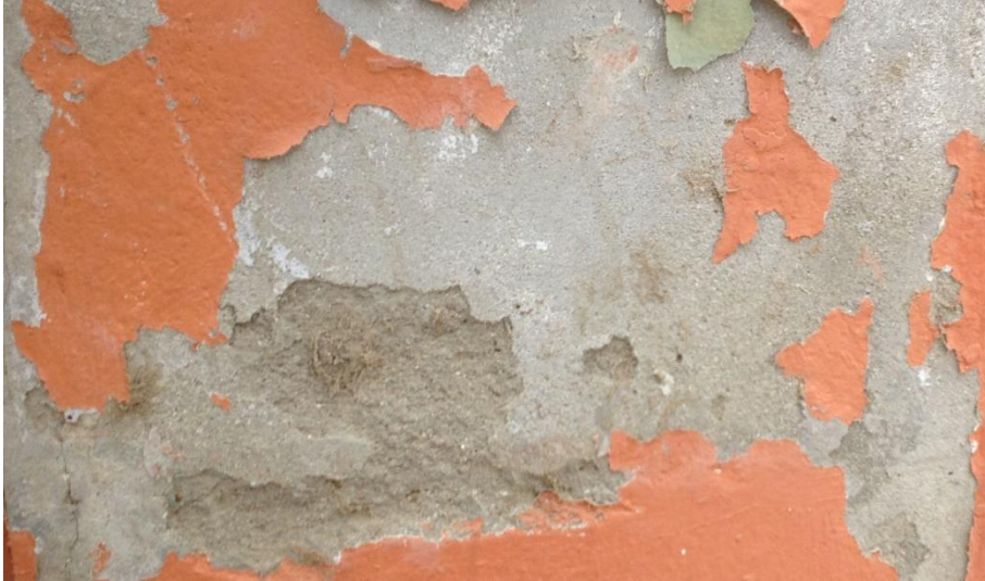
Imagen 6: Erosión en muros.
