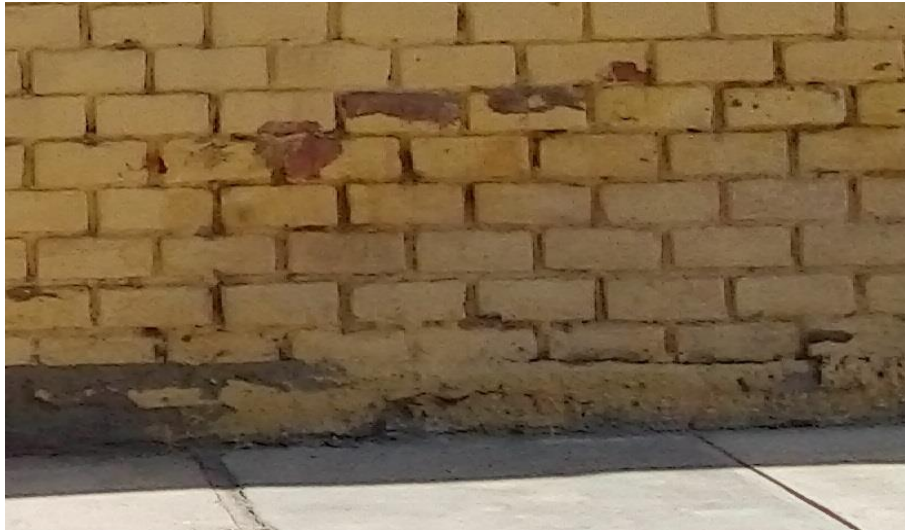
Imagen 5: Humedad en muros.
