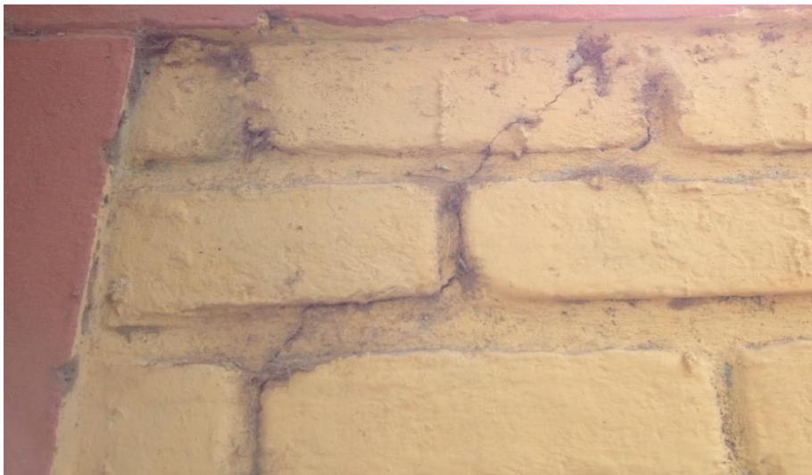
Imagen 7: Fisuras en muro.
