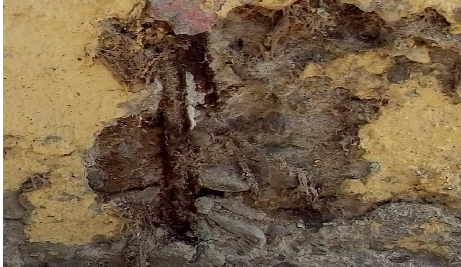
Imagen 2: Corrosión de acero.
