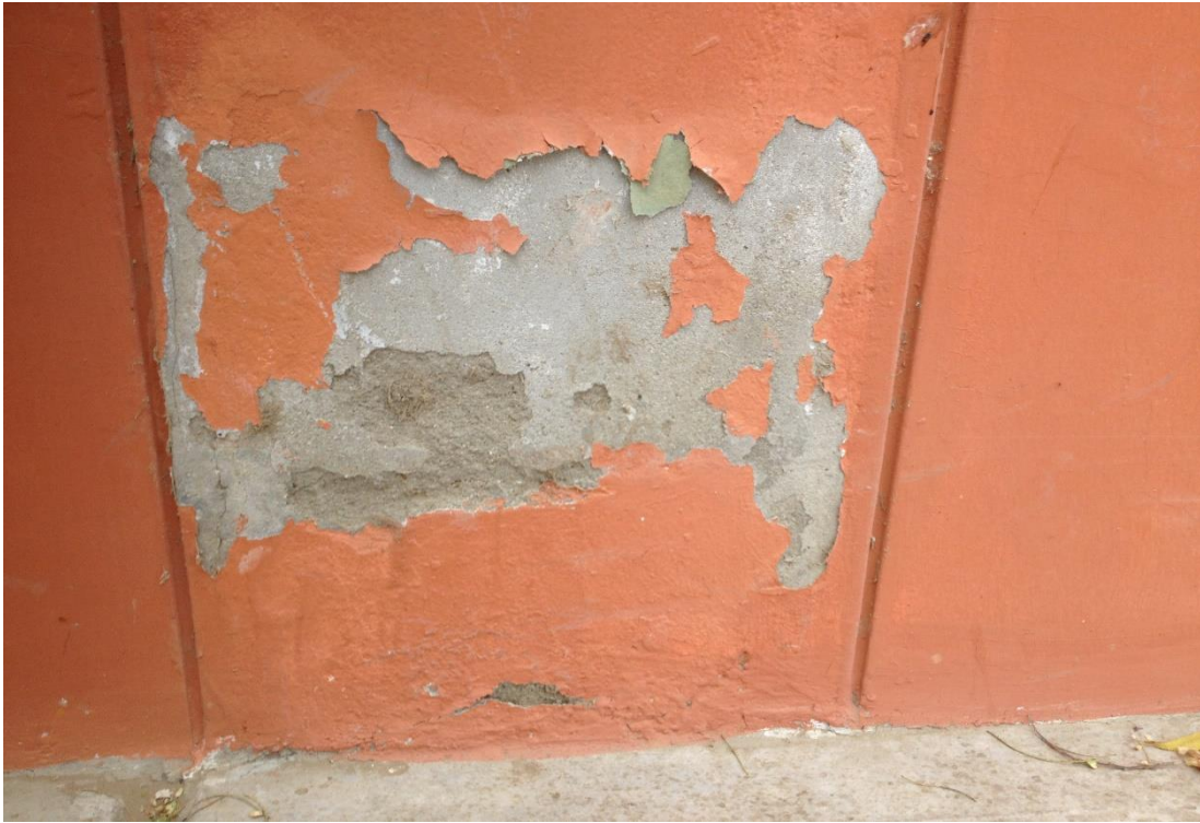
Imagen 19: Erosión y eflorescencia ubicada en la av. Independencia unidad de muestra 14.
