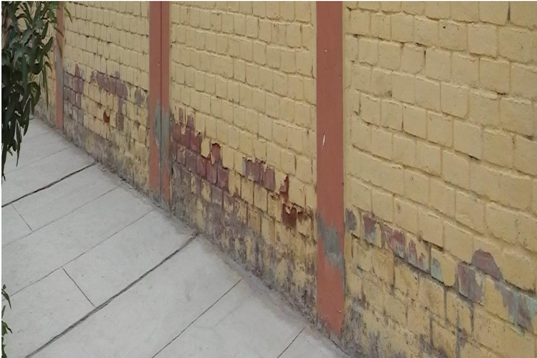
Imagen 23: Reparación de Eflorescencias.
