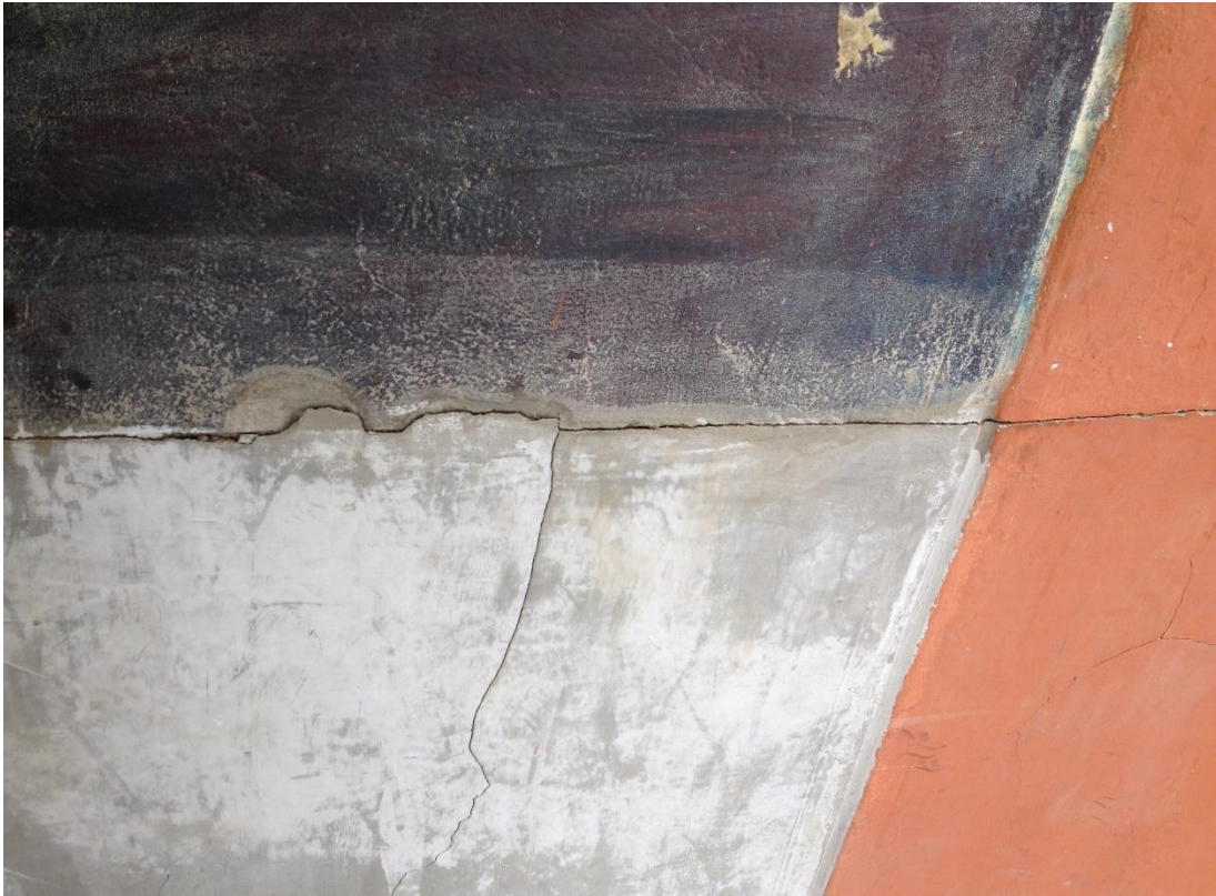
Imagen 21: Fisuras en los acabados ubicadas en la calle s/n unidad de muestra 13.
