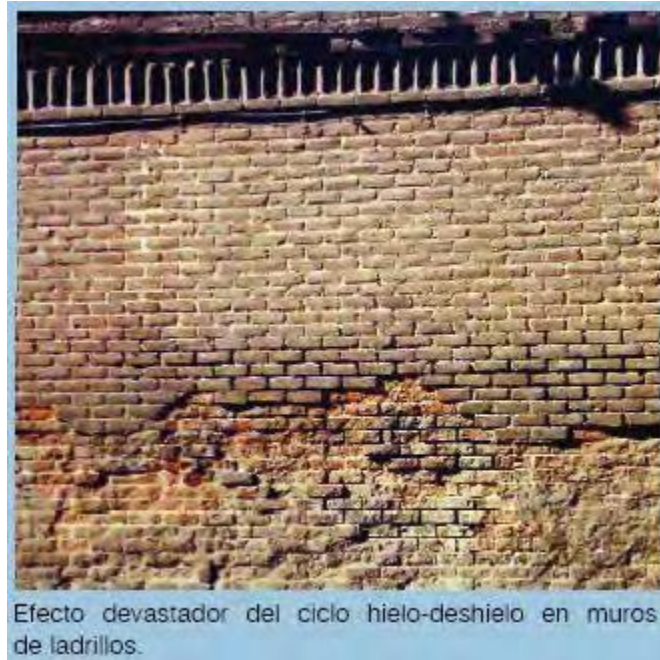
Imagen N°9: Efecto devastador del ciclo hielo-deshielo en muros de ladrillo..
