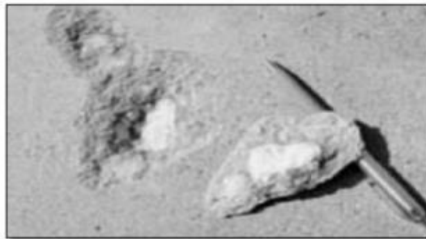
Imagen N°17: Popouts O Cráteres en el concreto.
