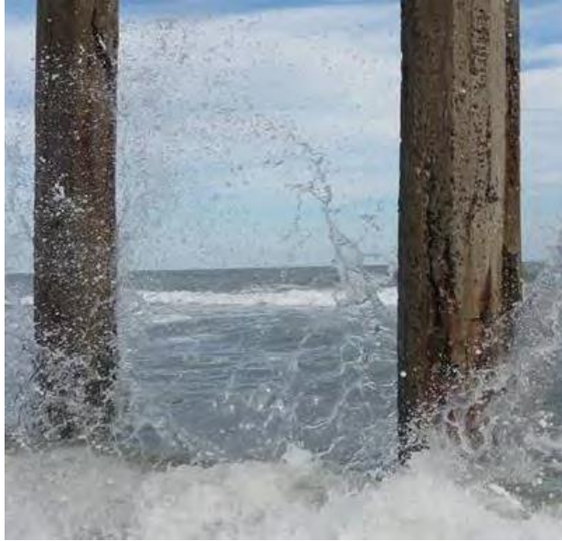
Imagen N° 2: Ataque químico por agua de mar a estructuras de C°A°.
