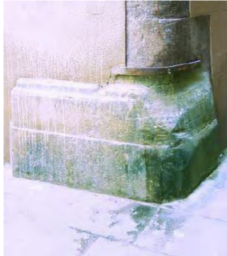
Imagen N°11: Ataque biológico a estructura de concreto por biocapas.
