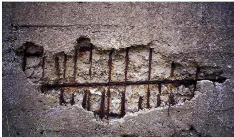
Imagen N°6: Ataque por Corrosión a elementos de Concreto Armado.
