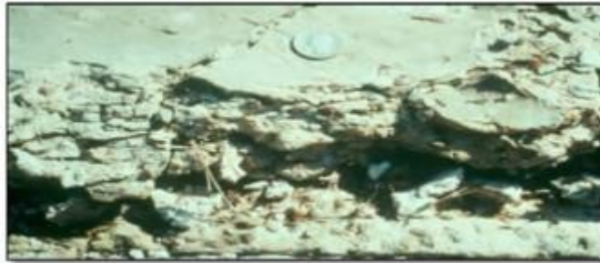
Imagen N°88: Desintegración de una estructura de concreto.
