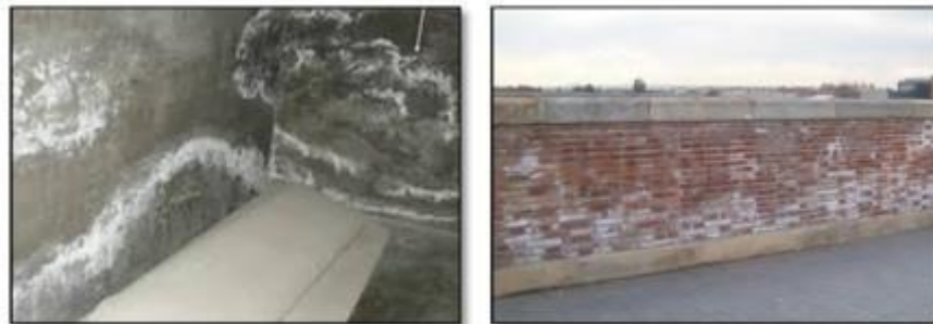
Imagen N°15: Presencia de Eflorescencia (sales) en concreto y muros de albañilería.
