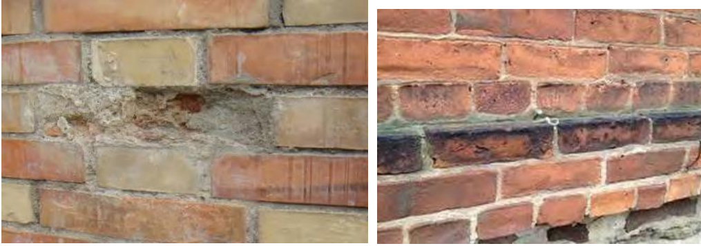
Imagen N°12: Patologías presentadas en muros de albañilería.
