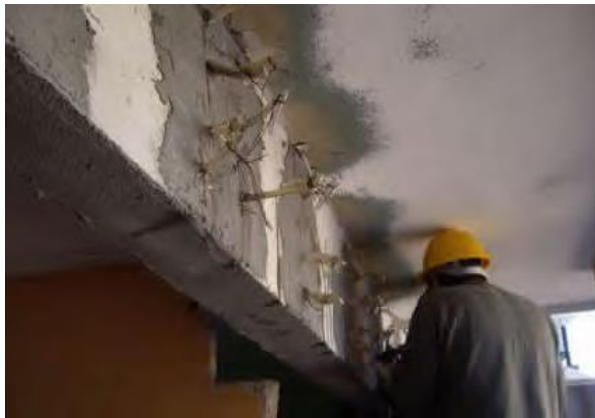
Imagen N°5: Ataque por Ácidos Inorgánicos a estructuras de C°A°.
