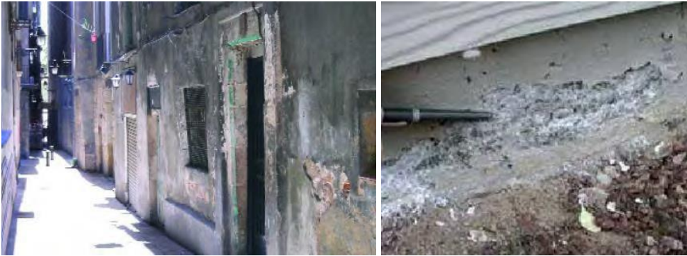
Imagen N°7: Ataque por Físico a edificación por Humedad de Infiltración.
