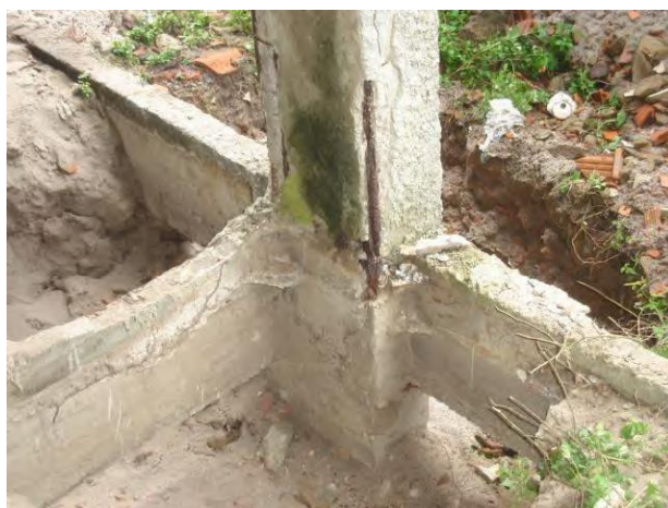
Imagen N°4: Ataque por Ácidos Orgánicos a estructuras de C°A°.
