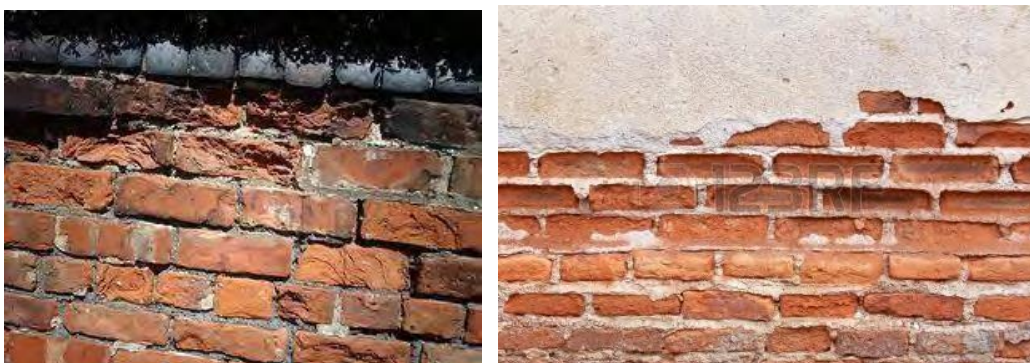
Imagen N°13: Erosión en muros de albañilería.
