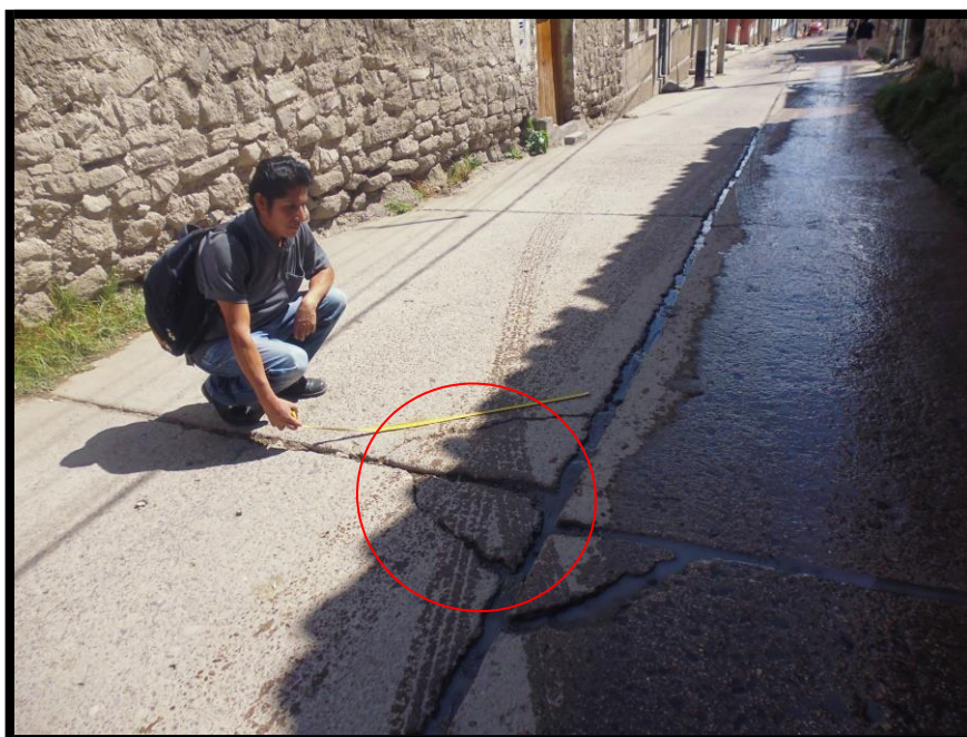
Fotografía A.12: se observa la existencia grietas diagonales con un grado de severidad Alta en la Avenida Perú (tercera cuadra) del distrito de Carmen Alto, provincia de Huamanga, departamento de Ayacucho.
