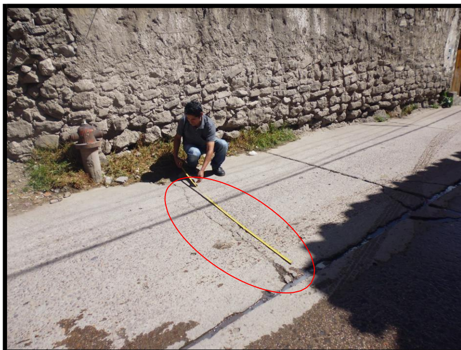
Fotografía A.10: se observa la existencia grietas lineales con un grado de severidad Baja en la Avenida Perú (tercera cuadra) del distrito de Carmen Alto, provincia de Huamanga, departamento de Ayacucho.
