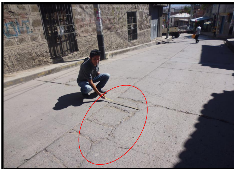
Fotografía A.02: se observa la existencia de losas divididas de severidad Alta ubicada en la Avenida Perú (primera cuadra) del distrito de Carmen Alto, provincia de Huamanga, departamento de Ayacucho.
