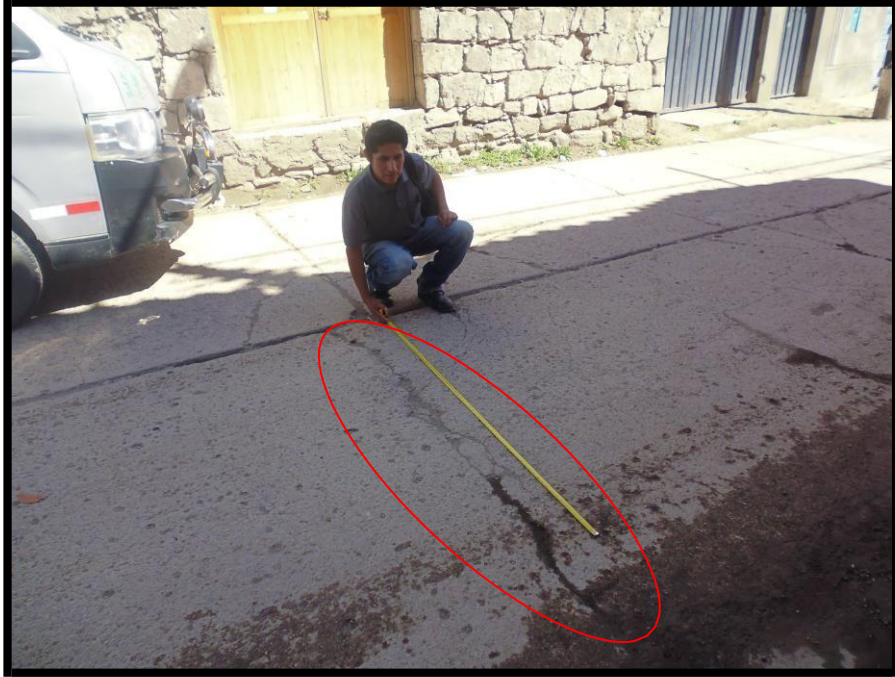
Fotografía A.07: se observa la existencia grietas lineales con un grado de severidad Alta en la Avenida Perú (segunda cuadra) del distrito de Carmen Alto, provincia de Huamanga, departamento de Ayacucho.
