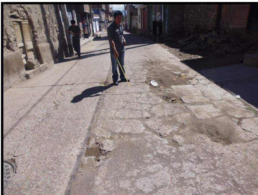
Fotografía A.03: se observa la existencia losas divididas con un grado de severidad Alta en la Avenida Perú (segunda cuadra) del distrito de Carmen Alto, provincia de Huamanga, departamento de Ayacucho.
