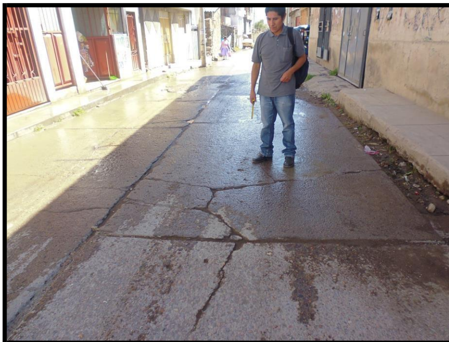
Fotografía A.13: se observa la existencia losas divididas con un grado de severidad Alta en la Avenida Perú (segunda cuadra) del distrito de Carmen Alto, provincia de Huamanga, departamento de Ayacucho.
