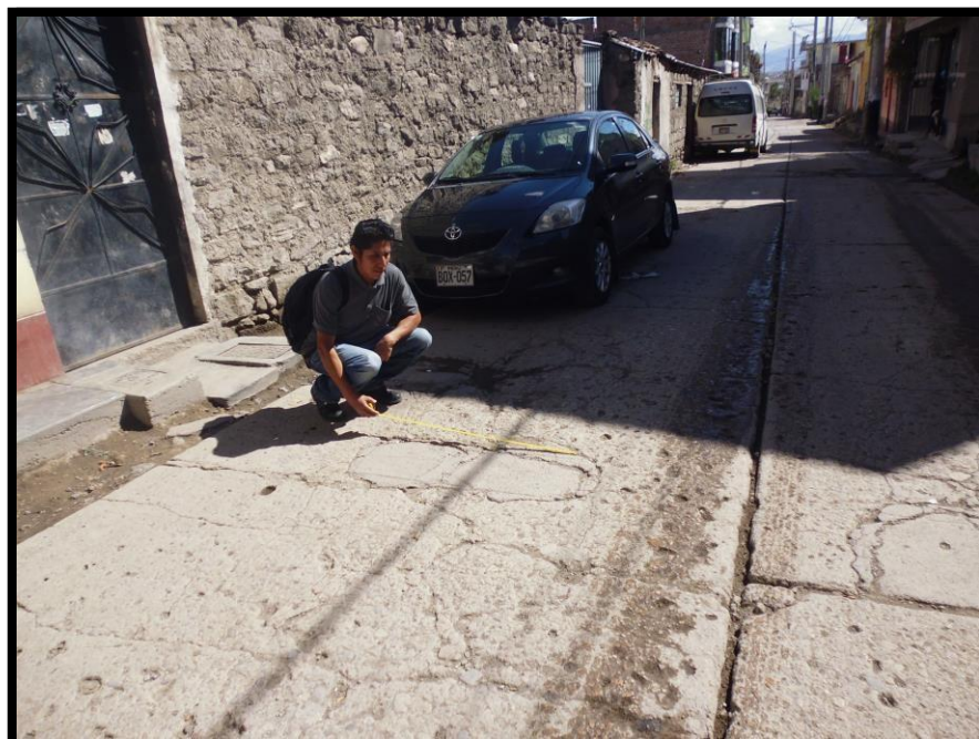
Fotografía A.16: se observa la existencia de parche pequeño con un grado de severidad Alta en la Avenida Perú (segunda cuadra) del distrito de Carmen Alto, provincia de Huamanga, departamento de Ayacucho.
