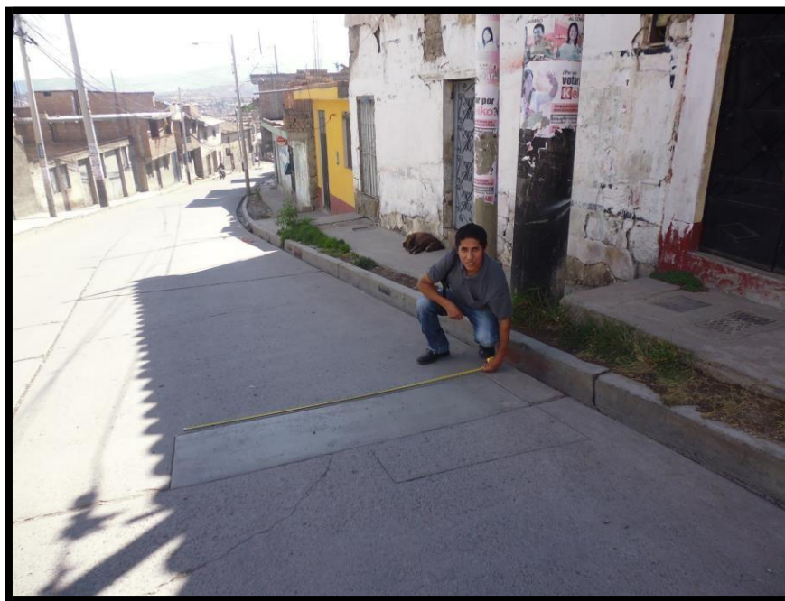
Fotografía A.11: se observa la existencia de parchas grande con un grado de severidad Alta en la Avenida Perú (primera cuadra) del distrito de Carmen Alto, provincia de Huamanga, departamento de Ayacucho.
