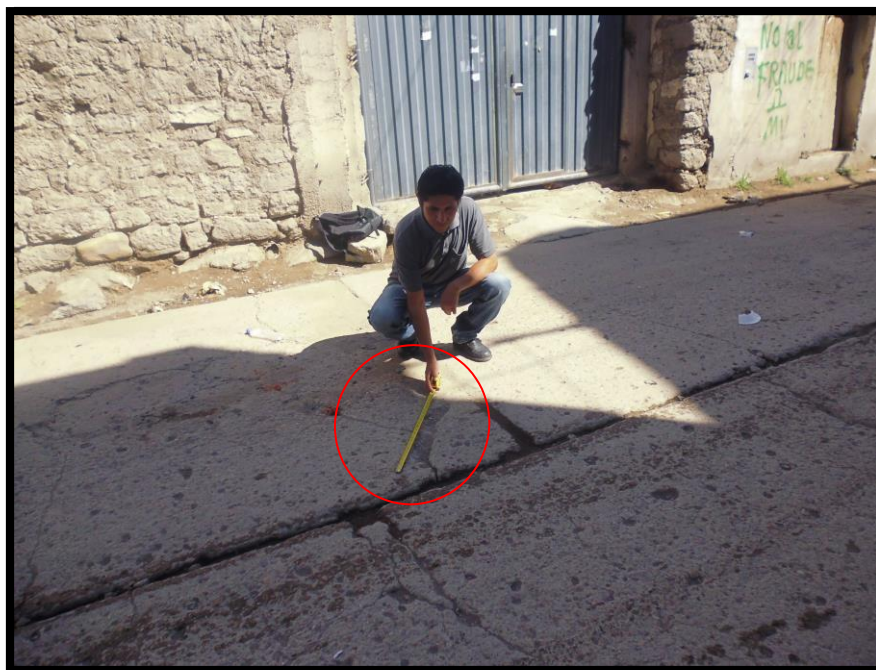
Fotografía A.19: se observa la existencia grietas de esquina con un grado de severidad Alta en la Avenida Perú (cuarta cuadra) del distrito de Carmen Alto, provincia de Huamanga, departamento de Ayacucho.
