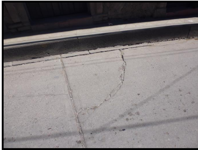
Fotografía N° 2.3: Grieta de esquina
