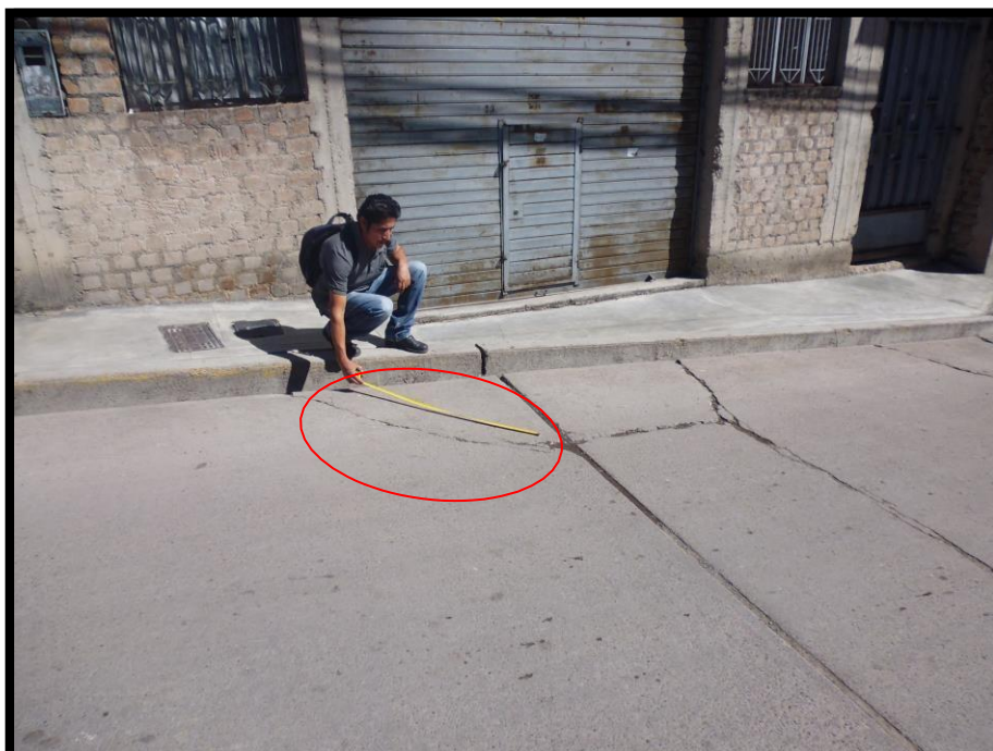
Fotografía A.06: se observa la existencia de grieta de esquina con un grado de severidad Alta en la Avenida Perú (primera cuadra) del distrito de Carmen Alto, provincia de Huamanga, departamento de Ayacucho.
