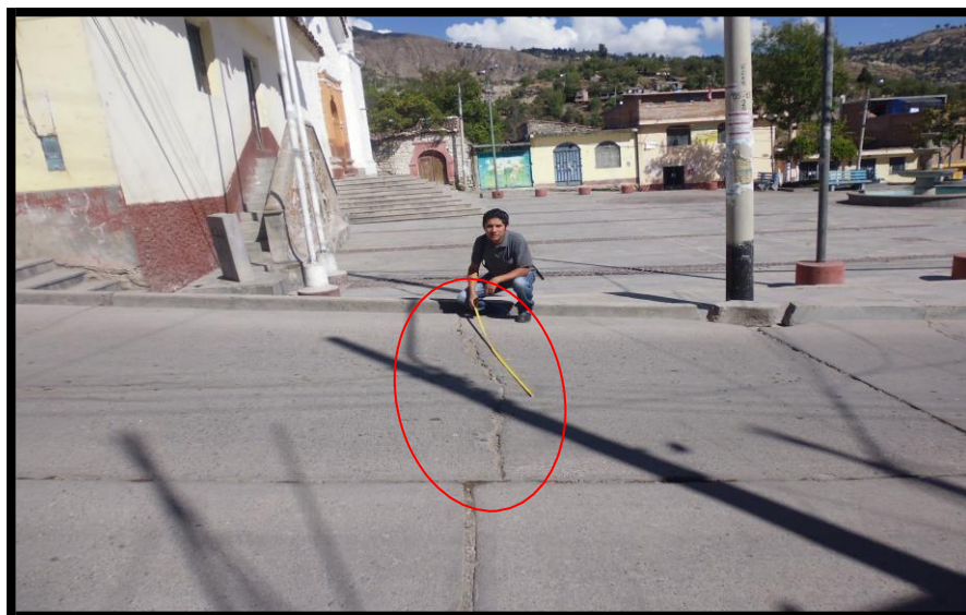
Fotografía A.01: se observa la existencia de una grieta lineal (transversal) con severidad alta a lo largo del paño de la pista ubicado en la Avenida Perú (primera cuadra) del distrito de Carmen Alto, provincia de Huamanga, departamento de Ayacucho.
