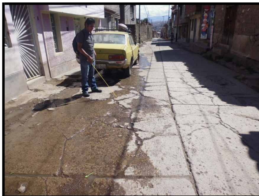
Fotografía A.04: se observa la existencia losas divididas con un grado de severidad Alta en la Avenida Perú (tercera cuadra) del distrito de Carmen Alto, provincia de Huamanga, departamento de Ayacucho.
