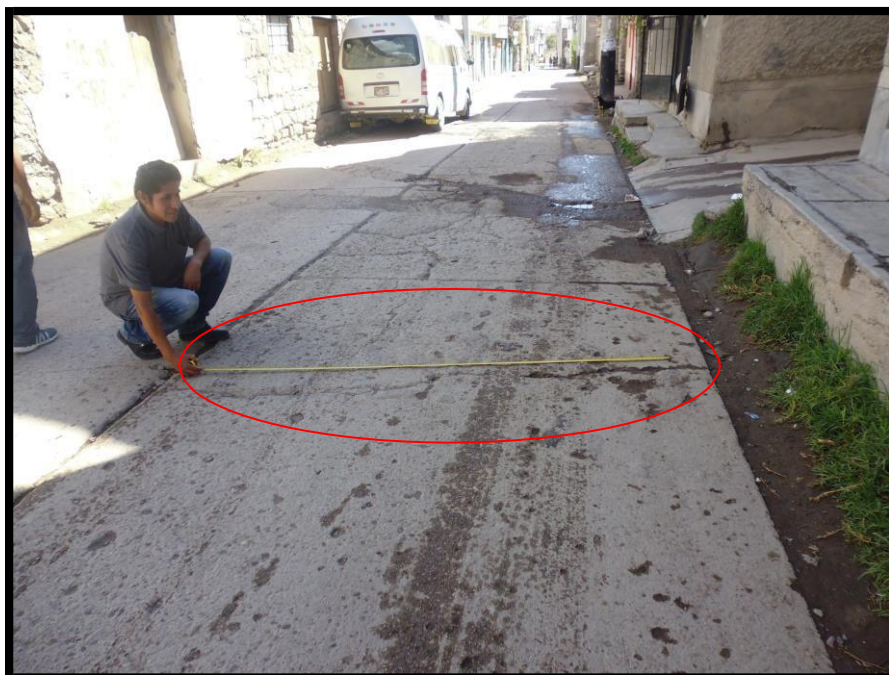
Fotografía A.17: se observa la existencia grietas lineales (transversal) con un grado de severidad Alta en la Avenida Perú (segunda cuadra) del distrito de Carmen Alto, provincia de Huamanga, departamento de Ayacucho.
