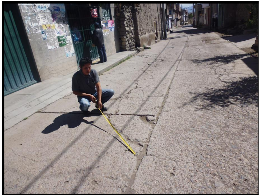
Fotografía A.08: se observa la existencia de grieta de esquina con un grado de severidad Alta en la Avenida Perú (tercera cuadra) del distrito de Carmen alto, provincia de Huamanga, departamento de Ayacucho.
