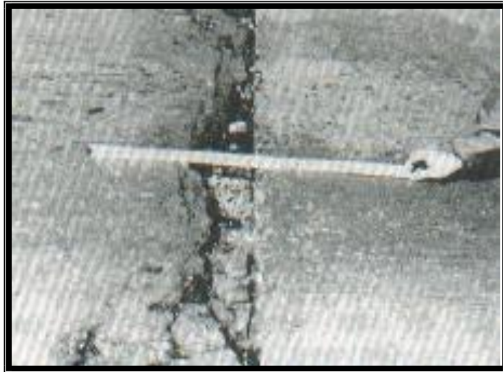
Fotografía N° 2.8: Descascaramiento de juntas
