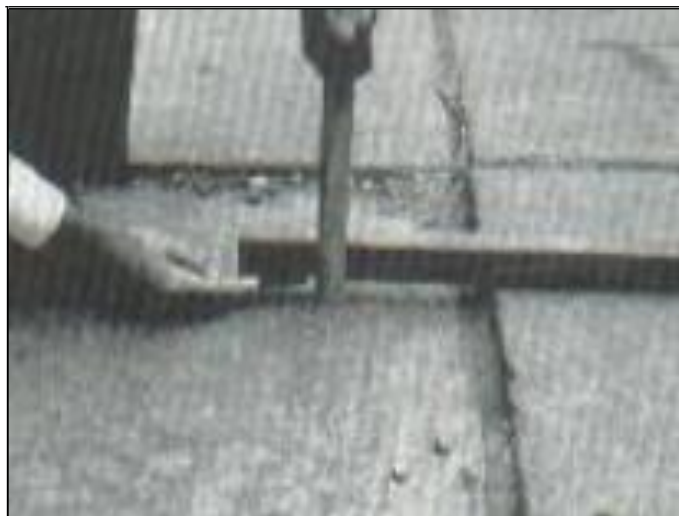
Fotografía N° 2.4: Escala severidad alta
