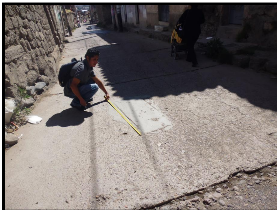
Fotografía A.14: se observa la existencia parche pequeño con un grado de severidad Media en la Avenida Perú (tercera cuadra) del distrito de Carmen Alto, provincia de Huamanga, departamento de Ayacucho.
