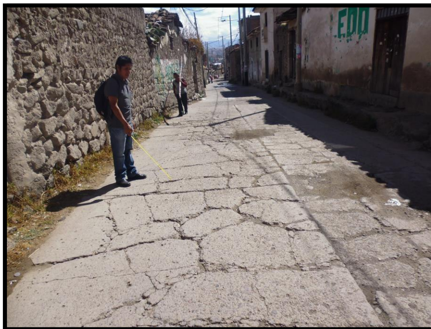
Fotografía A.05: se observa la existencia losas divididas con un grado de severidad Alta en la Avenida Perú (cuarta cuadra) del distrito de Carmen Alto, provincia de Huamanga, departamento de Ayacucho.
