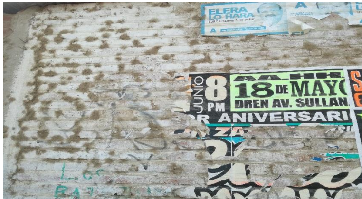
Gráfico 11: Suciedad en muro de albañilería.
