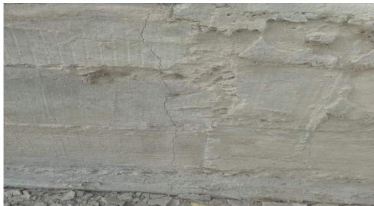
Gráfico 13: Fisura en un sobrecimiento.
