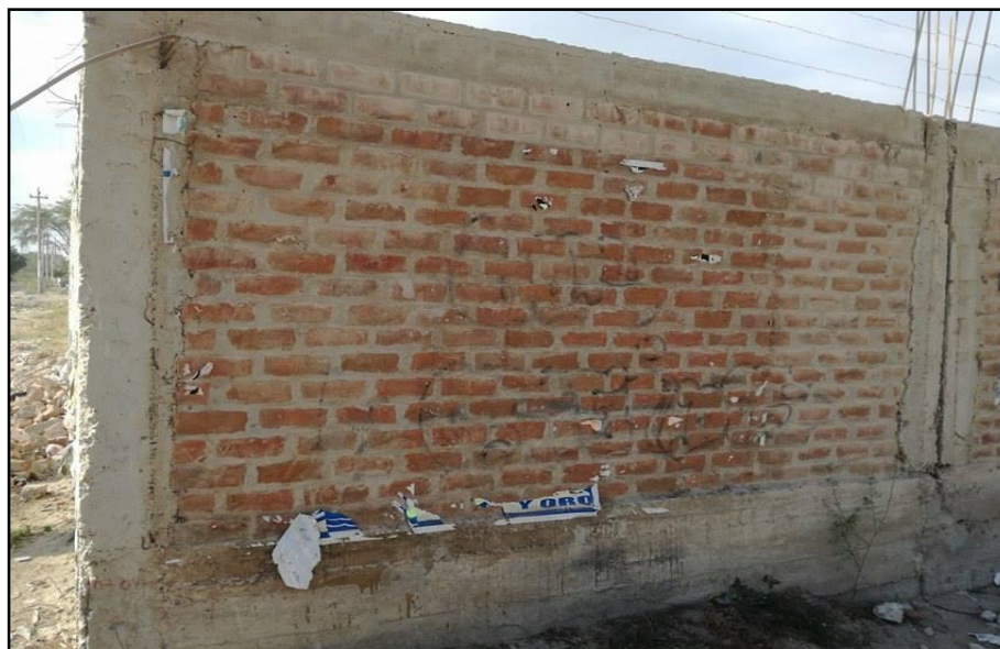
Gráfico 155: Presencia de suciedad en el muro de albañilería confinada perteneciente a la unidad de muestra 9
