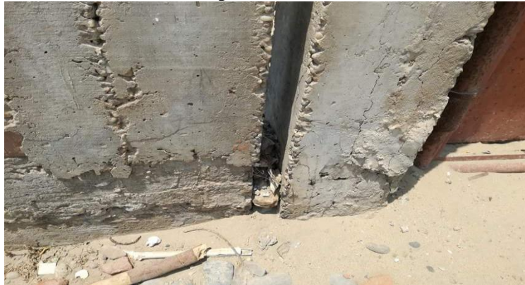
Gráfico 14: Desprendimiento en columna.
