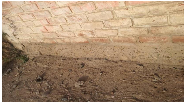
Gráfico 10: Erosión en sobrecimiento.
