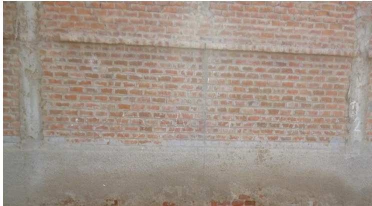
Gráfico 9: Humedad en muro de albañilería.
