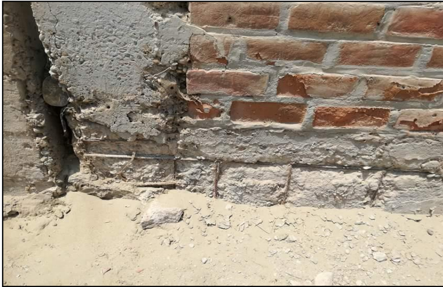
Gráfico 159: Corrosión en el acero del sobrecimiento en el paño comprendido entre el eje 20 y 21 perteneciente a la unidad de muestra 5.
