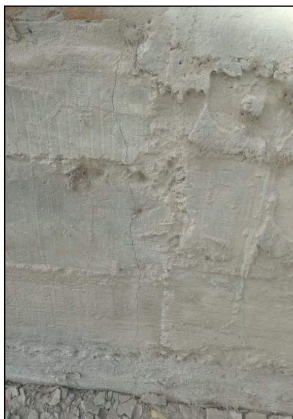
Gráfico 156: Fisura en el sobrecimiento en la unidad de muestra 13.
