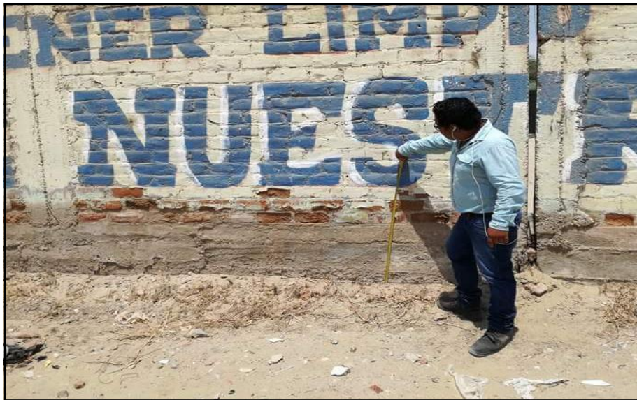
Gráfico 154: Presencia de erosión en el sobrecimiento y parte inferior del muro en la unidad de muestra 13.
