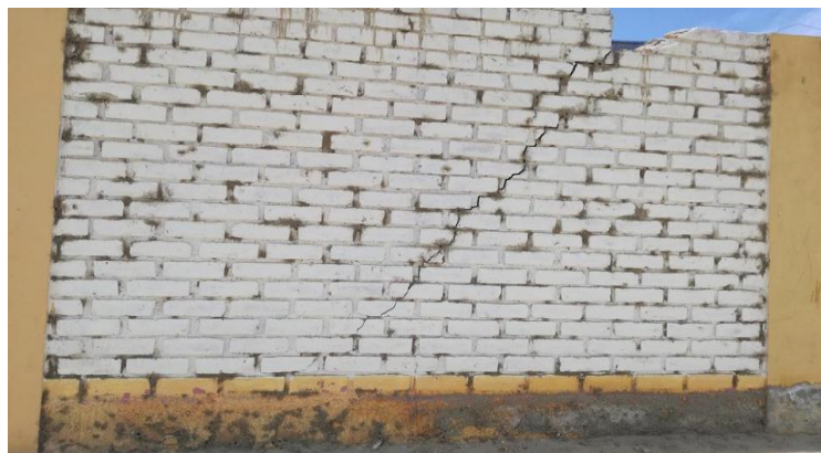
Gráfico 12: Grieta en un muro de albañilería.
