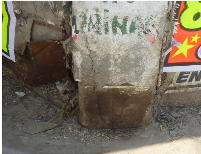
Figura 12. Daño de fisura en columna
