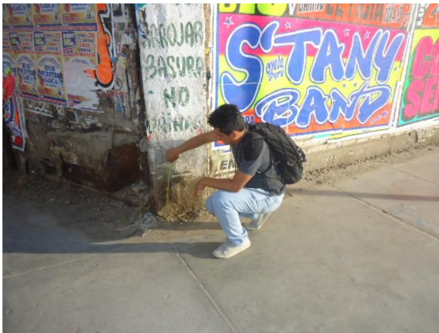
Foto 02: Efectuando medidas en lesiones de patologías en columna
