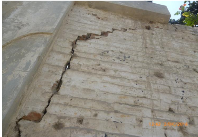
Figura 13. Grieta en muro
