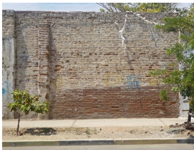
Figura 05. Humedad por capilaridad
