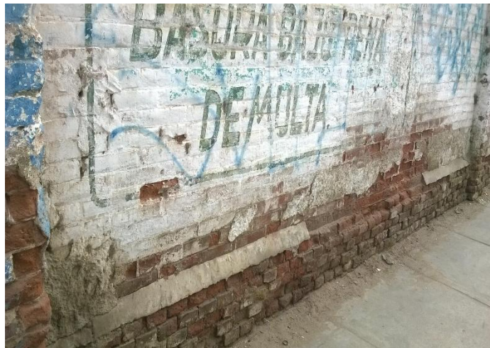
Figura 11. Erosión en muros
