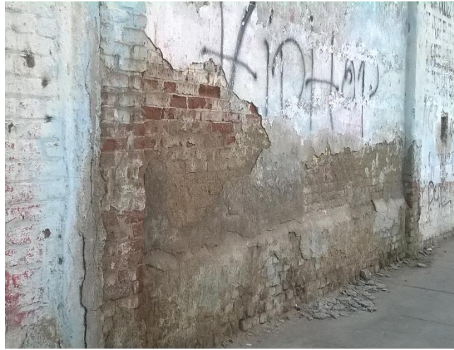
Figura 09. Desprendimiento de tarrajeo en muro
