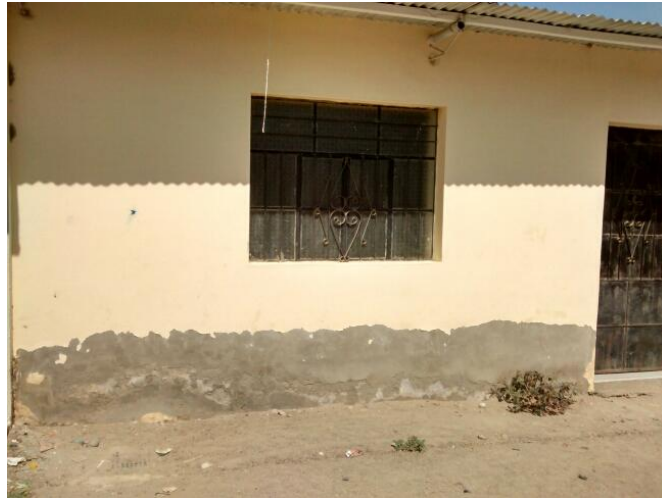
Figura 10. Eflorescencia en muro
