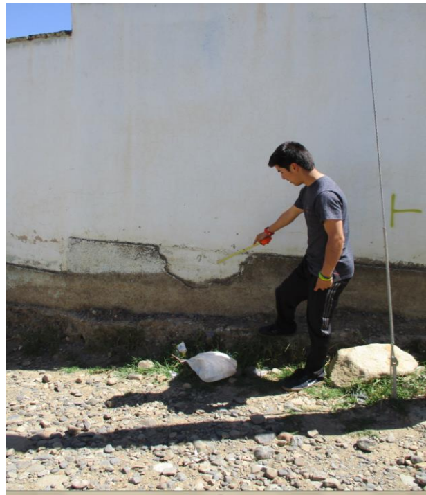
Imagen 17: Patología de Desprendimiento en muro
