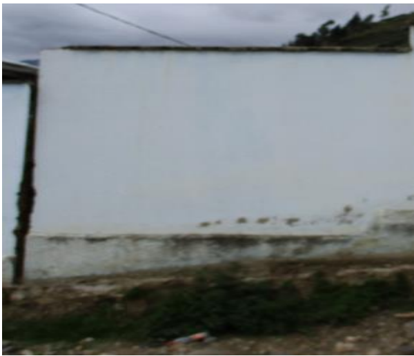
Figura 27: Patología de Moho
