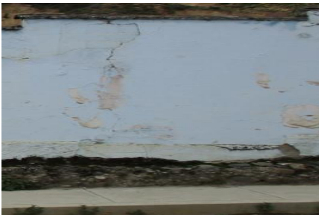
Imagen 25: Patología de desconchamiento
