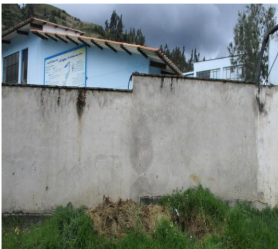
Figura 28: Patología de Moho
