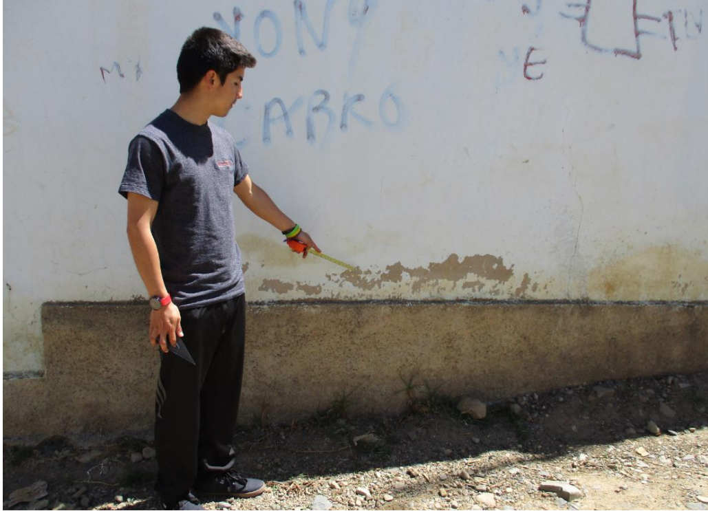
Imagen 22: Patología de eflorescencia en muro
