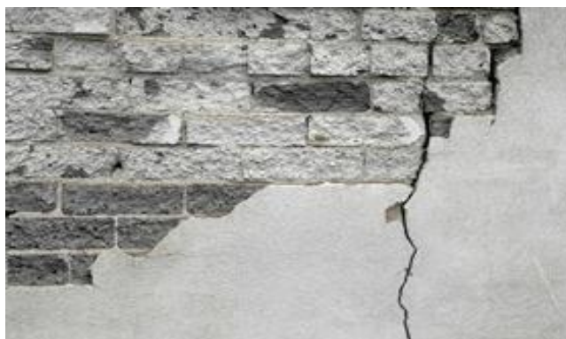
Imagen 14. Grieta de muros
