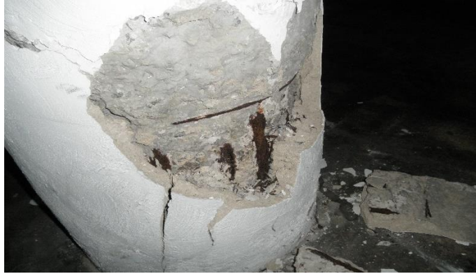
Imagen 07. Oxidación y Corrosión
