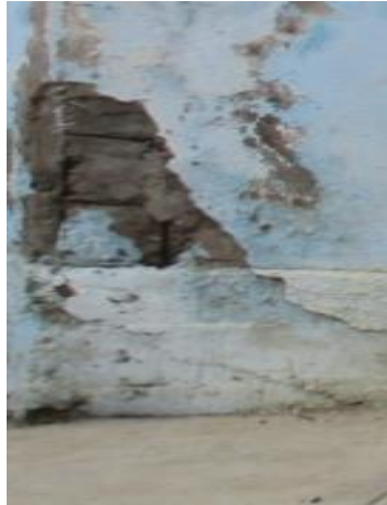
Imagen 23: Patología de Corrosión en muro
