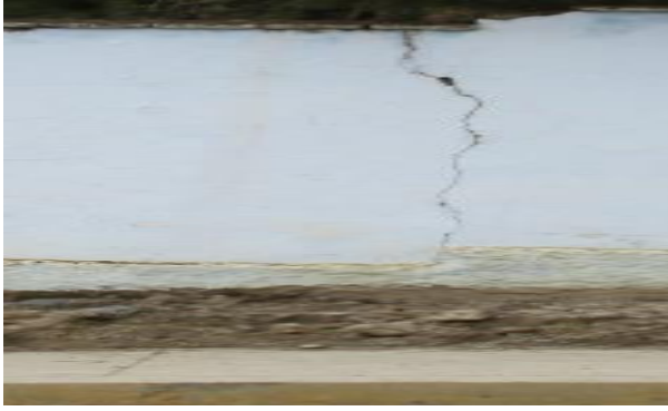
Imagen 26: Patología de Grieta en muro
