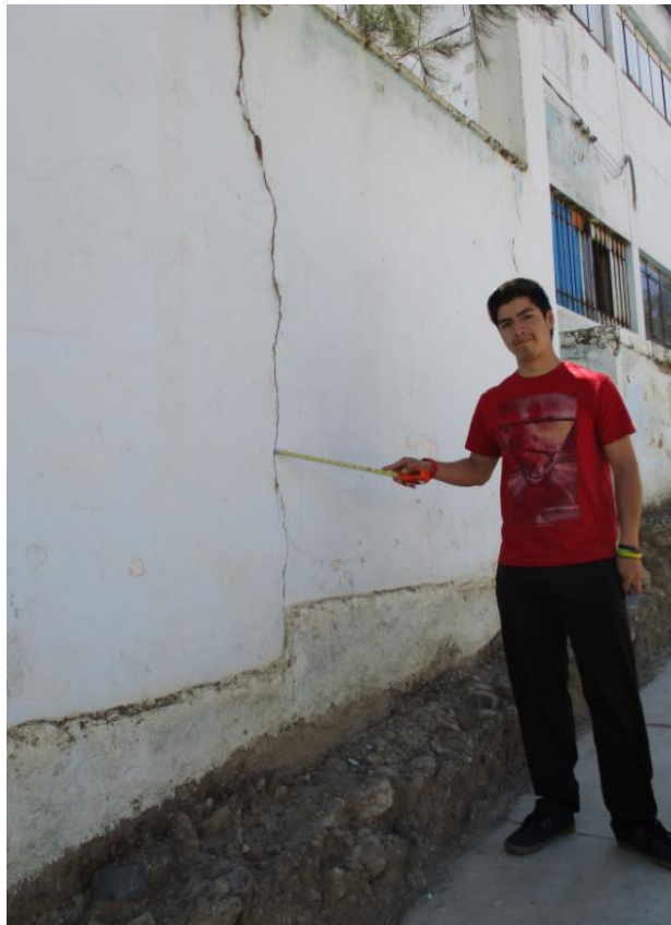
Imagen 19: Patología de grieta en muro
