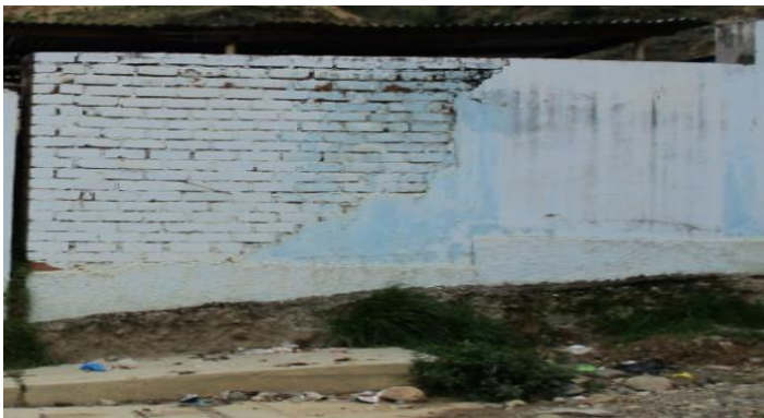
Imagen 24: Patología de Desprendimiento
