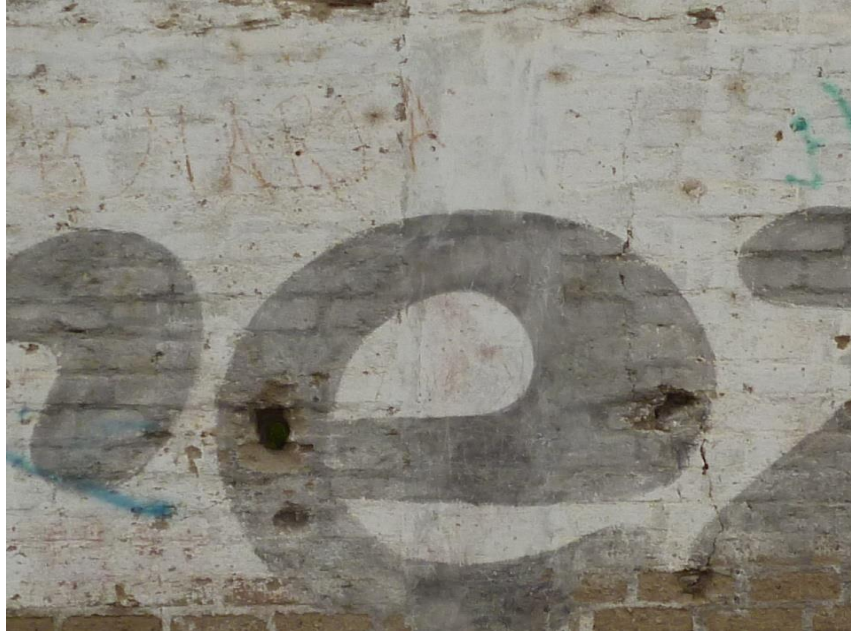
Figura 5. Muro con presencia de huecos ocasionados por golpes o impactos.
