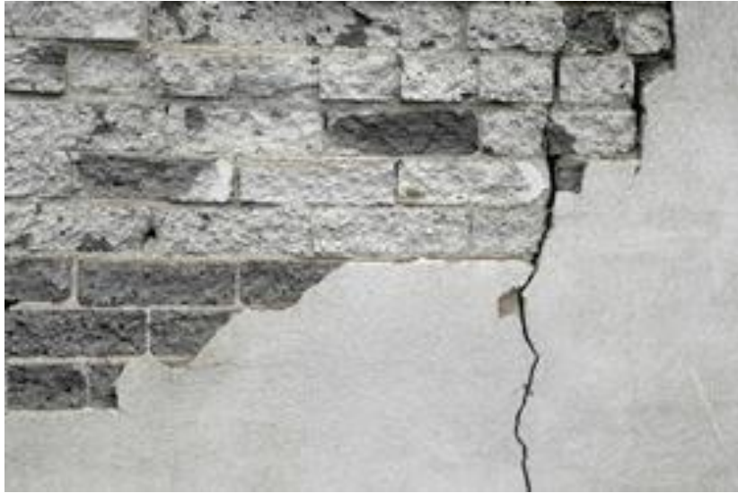
Figura 2. Grieta en muro producto de la deformación del apoyo de su cimiento.
