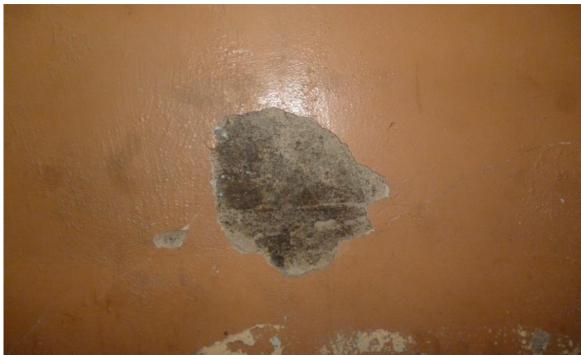
Figura 4. Desprendimiento del tarrajeo por mala adherencia en muros de albañilería
