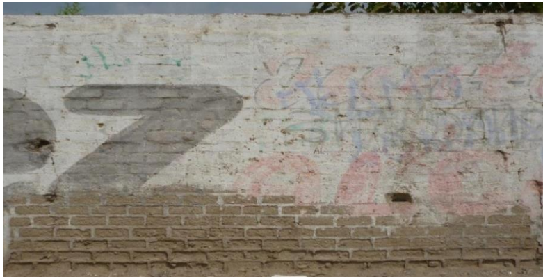
Figura 9. Muro de albañilería afectada por erosión química en la parte inferior producto de un suelo salitroso y húmedo.
