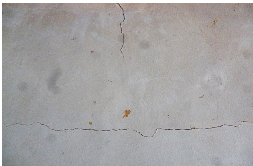
Figura 3. Aparición de fisuras en el tarrrajeo de un muro a consecuencia de acciones mecánicas.
