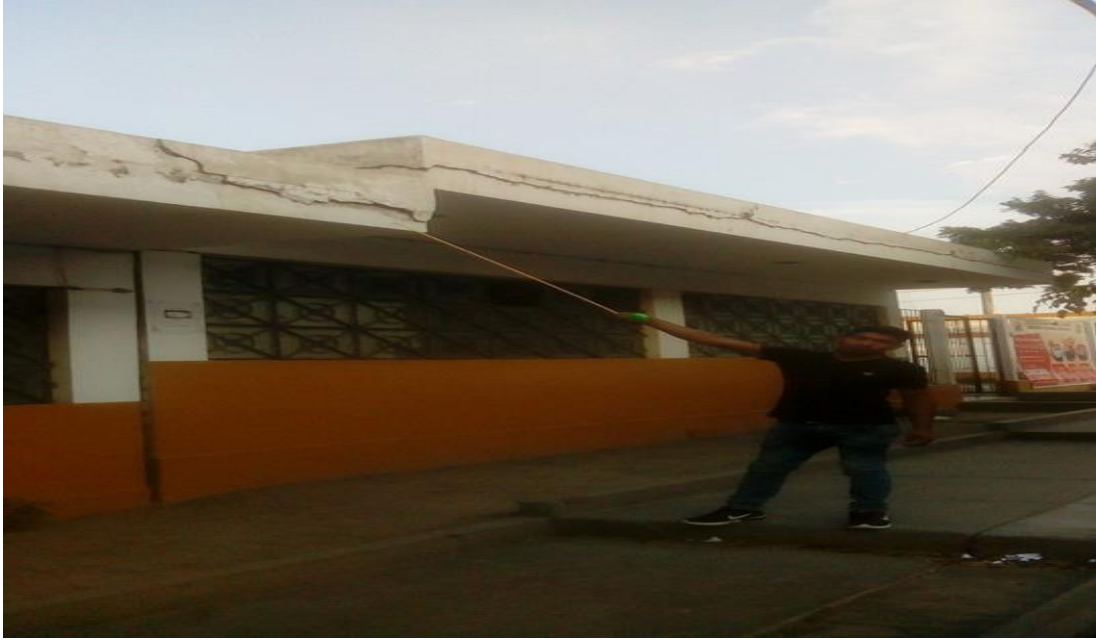
Fotografía N°05: Vista panorámica de la erosión y fisura en el muro de albañilería de la U.M- 8 del cerco perimétrico exterior del CLASS Centro de Salud Santa.
