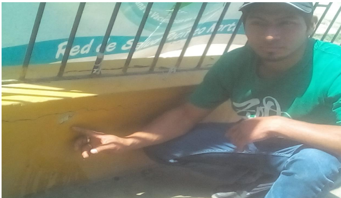
Fotografía N°03: Se visualiza la fisura en el muro de albañilería en la U.M-8 del cerco perimétrico exterior del CLASS Centro de Salud Santa.
