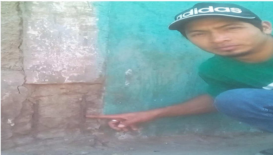
Fotografía N°08: Se visualiza la corrosión en la columna en el muro de albañilería de la U.M-11 del cerco perimétrico exterior del CLASS Centro de Salud Santa.
