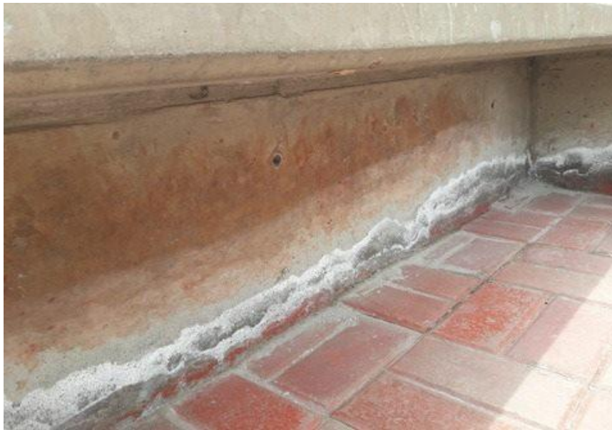
Figura 6. Estructura de concreto con presencia de eflorescencia en la parte inferior.
