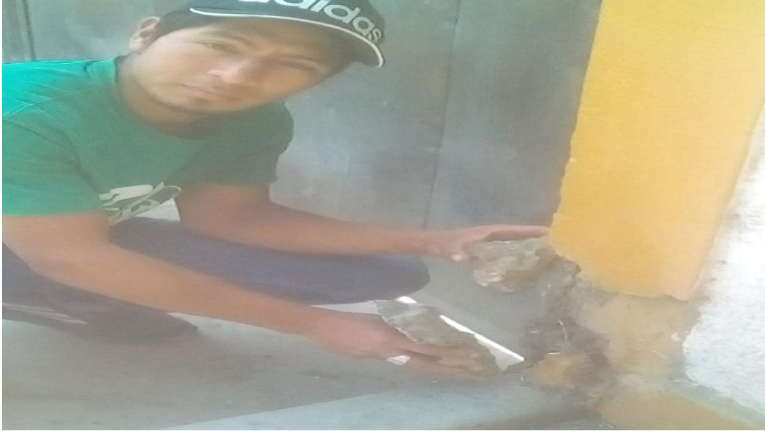
Fotografía N°07: Se observa la corrosión en la columna del paño de la U.M-2 del cerco perimétrico exterior del CLASS Centro de Salud Santa, la cual ha sido mal reparada
