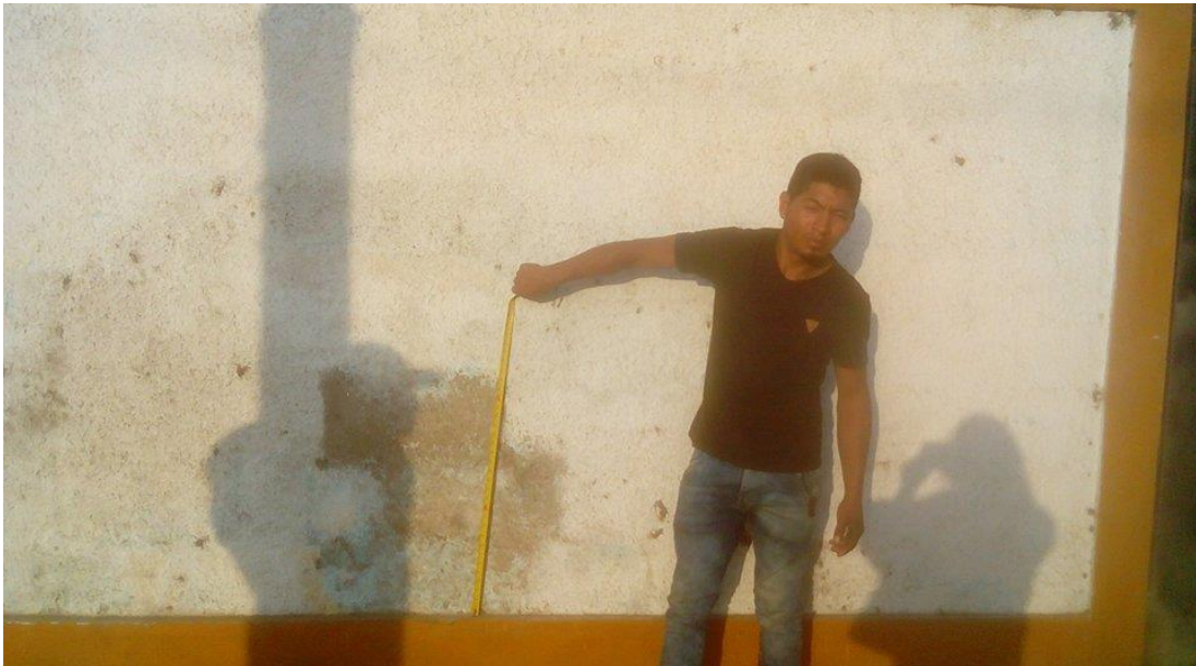
Fotografía N°06: Se visualiza la erosión en el muro de albañilería de la U.M- 2 del cerco perimétrico exterior del CLASS Centro de Salud Santa.
