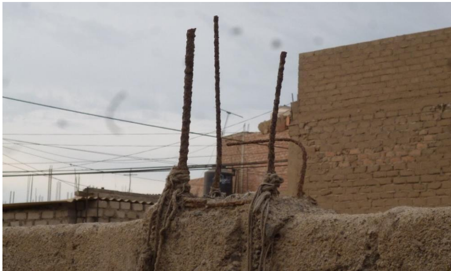
Figura 7. Acero de columna afectada por la corrosión y oxidación provocada por la falta de protección hacia los agentes ambientales. Nota. Fuente: Elaboración propia. (2018).
