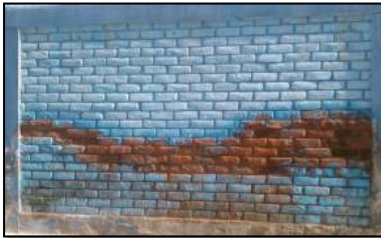
Grafico 11. Erosión en muros de albañilería confinada
