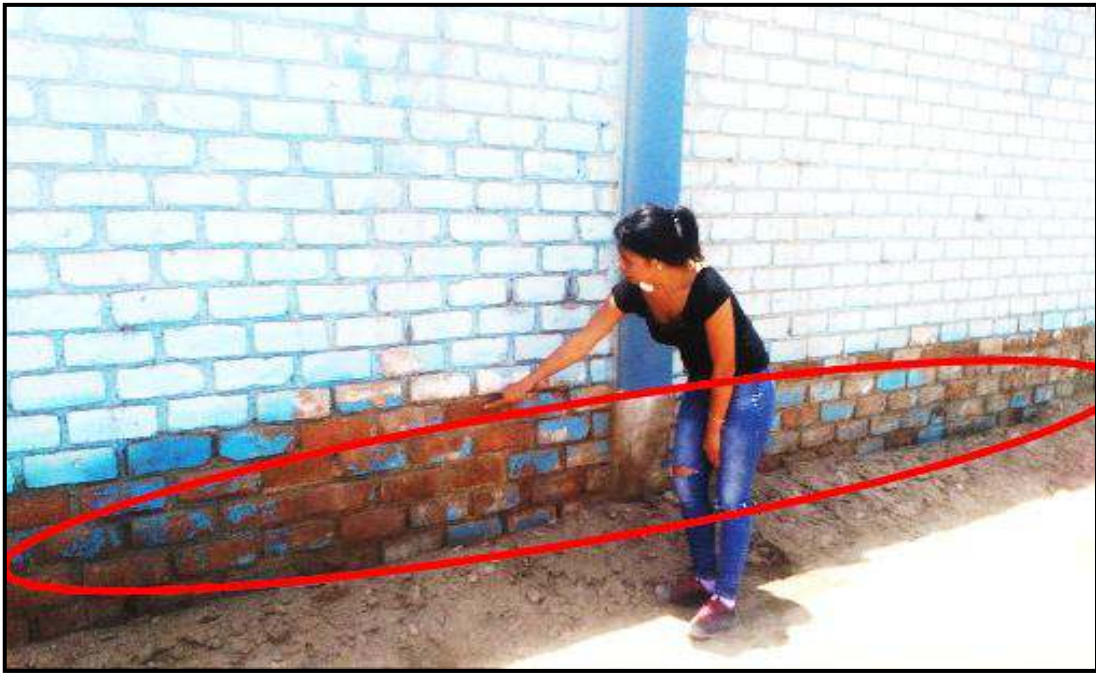
Grafico 92. Foto de Humedad en muros y columnas del cerco perimétrico.
