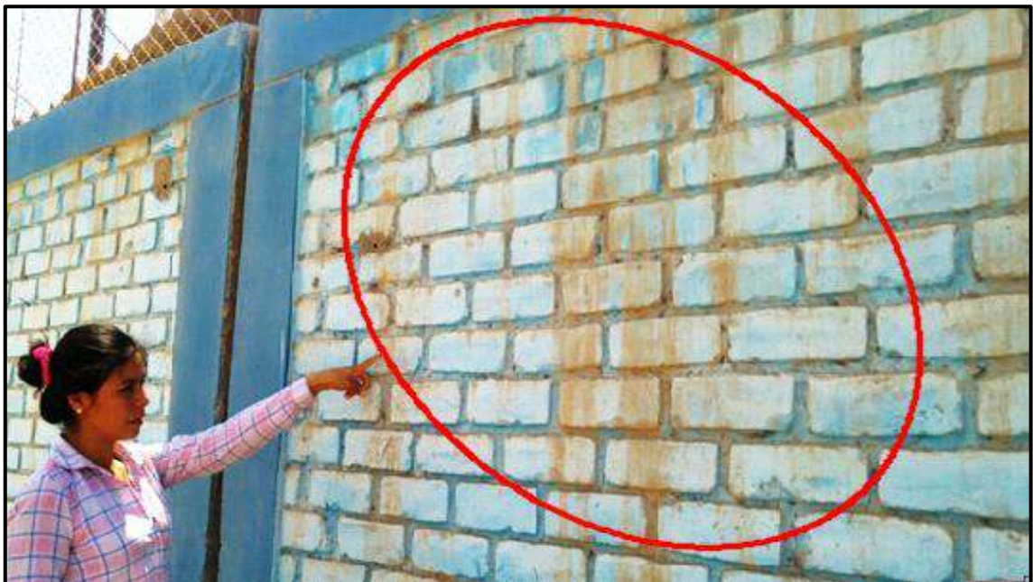
Grafico 89. Foto donde se puede observar la patología de suciedad en los muros
