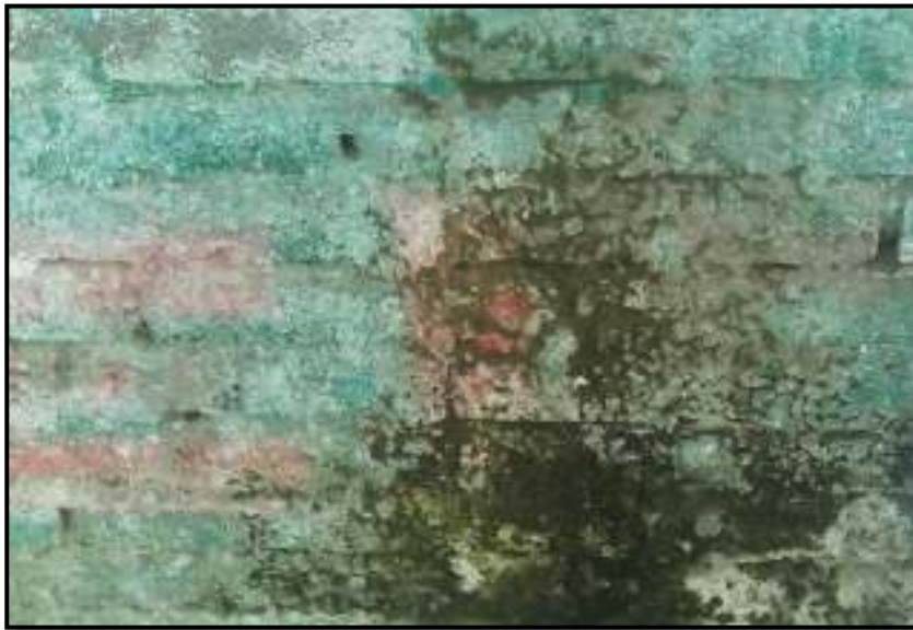
Grafico 12: Humedad en muros
