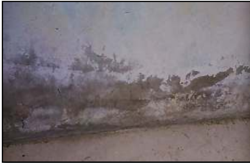
Grafico 15: Eflorescencia en muros
