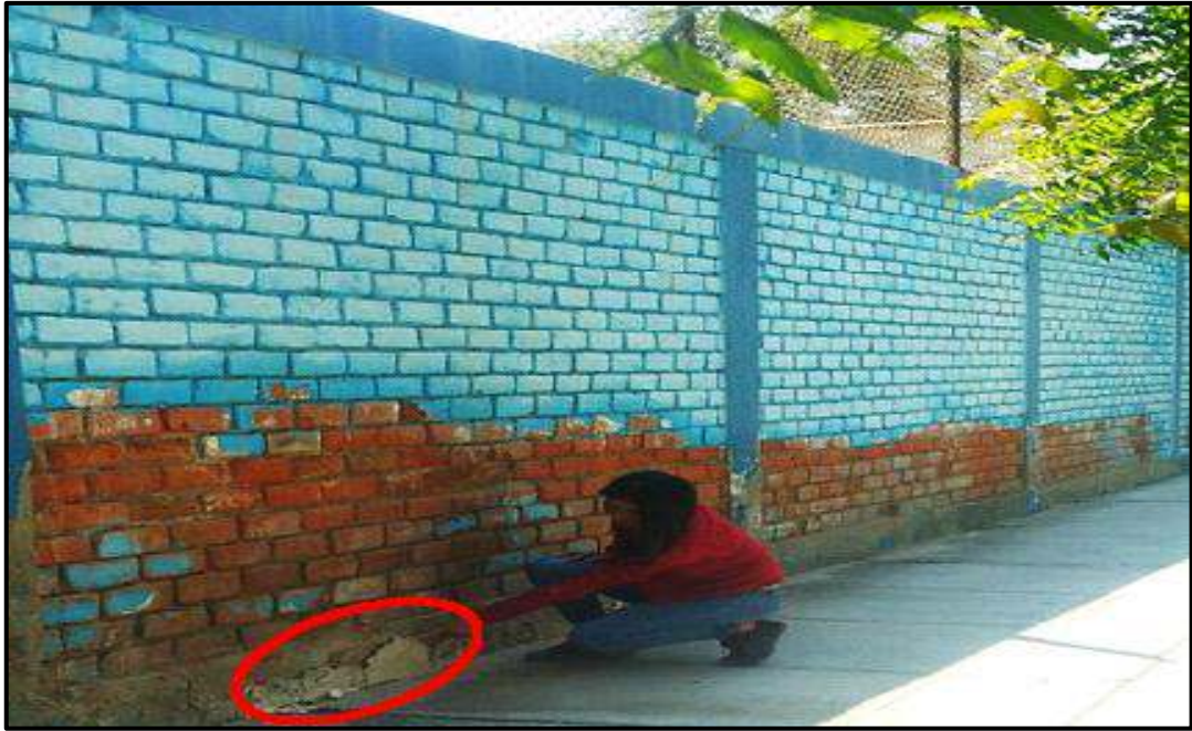
Grafico 96. Foto donde se puede apreciar desprendimiento de concreto en el sobrecimiento del cerco perimétrico.
