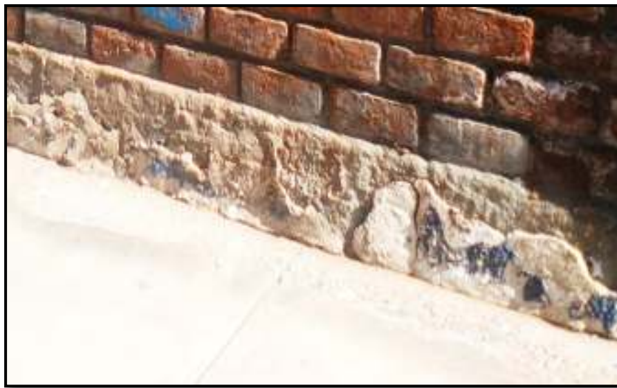
Grafico 13. Desprendimiento de concreto en sobrecimiento
