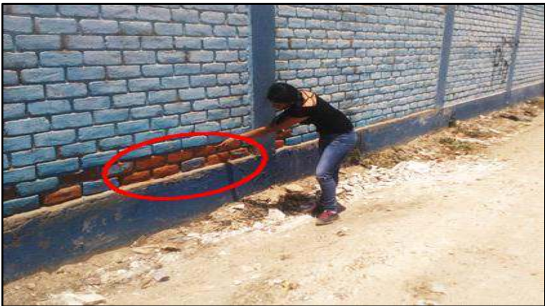
Grafico 95. Foto de Erosión que afecta al muro de ladrillo, como se observa en la imagen el nivel de severidad es moderada.
