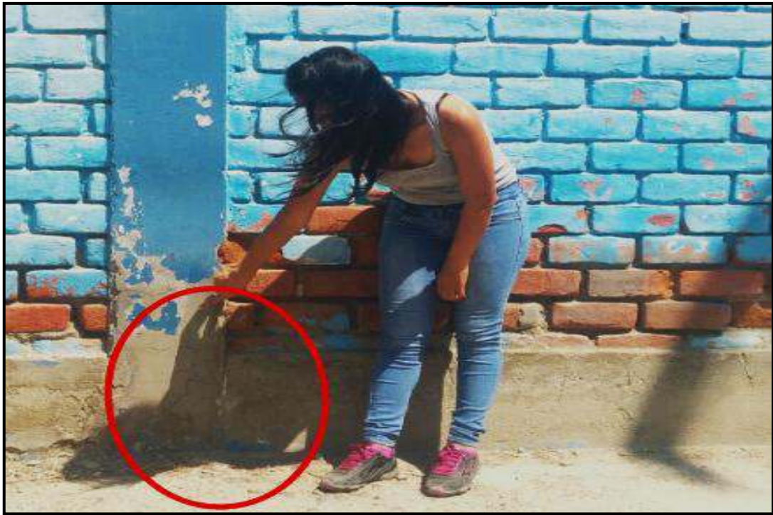
Grafico 94. Foto de Fisura y eflorescencia en columna del cerco perimétrico.
