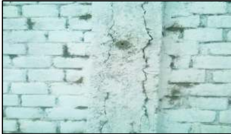
Grafico 08: Grieta en columna – Lesión Mecánica
