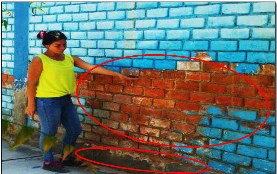
Grafico 91. Foto Erosión en los muros y sobrecimientos.
