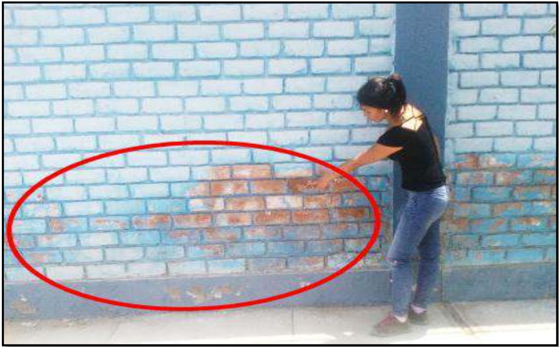
Grafico 88. Foto donde se puede observar la patología de Eflorescencia en muros y sobrecimientos
