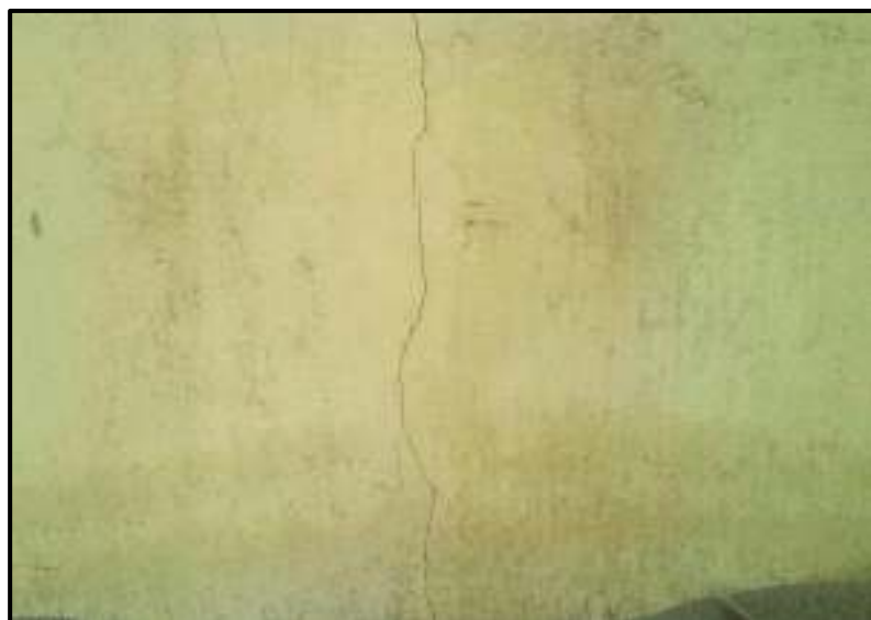
Grafico 16: Fisura en muros
