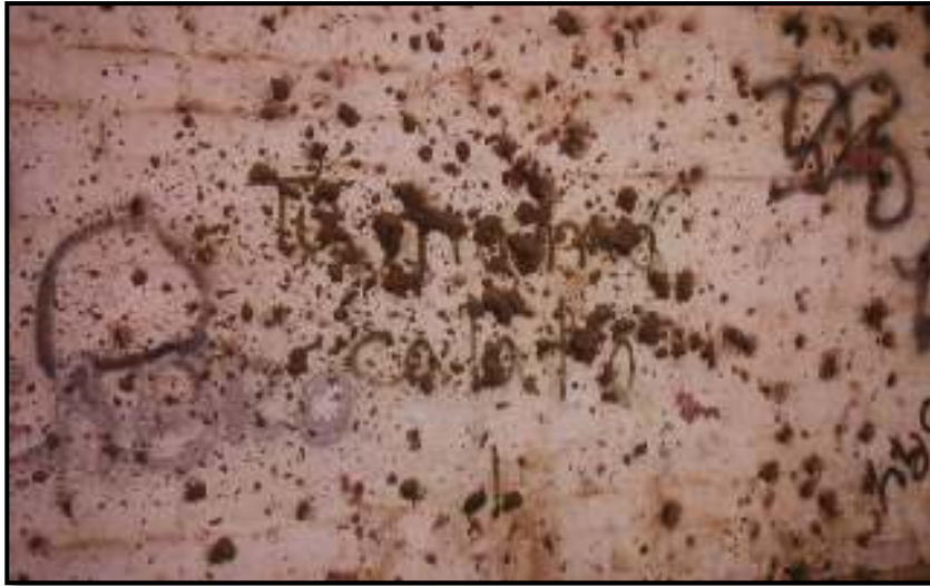
Grafico 14. Suciedad en muros
