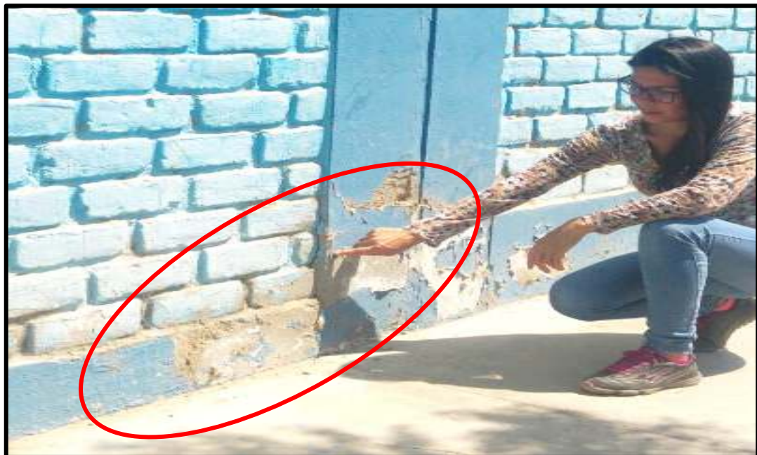
Grafico 97. Foto donde podemos observar eflorescencia en muro, y desprendimiento de concreto en sobrecimiento y columna.
