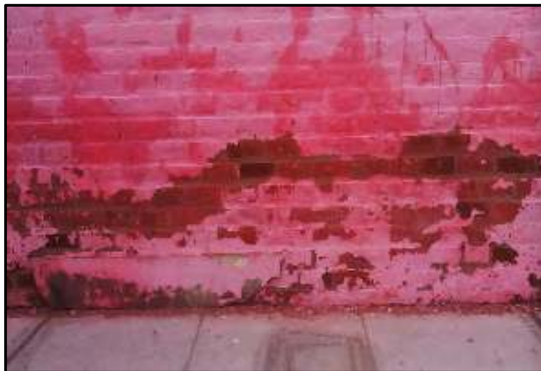
Grafico 07: Humedad en muros – Lesión Física
