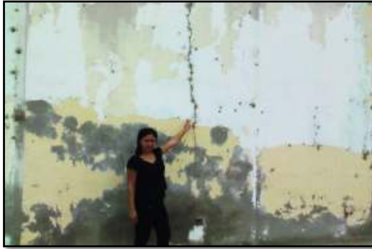
Grafico 10: Patologías en las edificaciones – Grieta en muros
