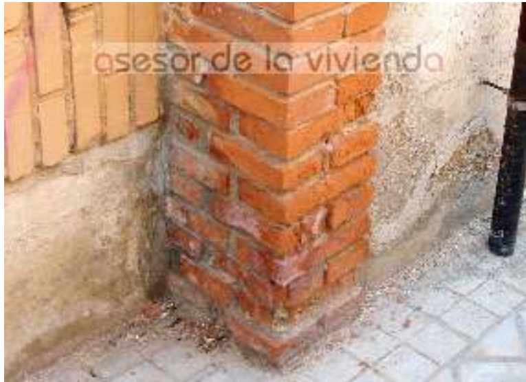
Gráfico 18: Erosión física – Fuente: Asesor de la vivienda
