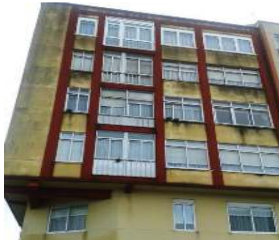
Gráfico 15: Manchas de lluvia – Fuente: Aparejadorencoruna
