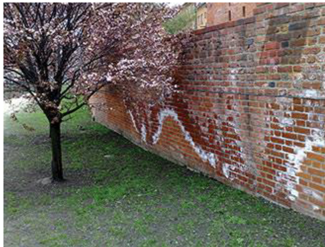
Gráfico 17: Eflorescencia en muro – Fuente: Paternit
