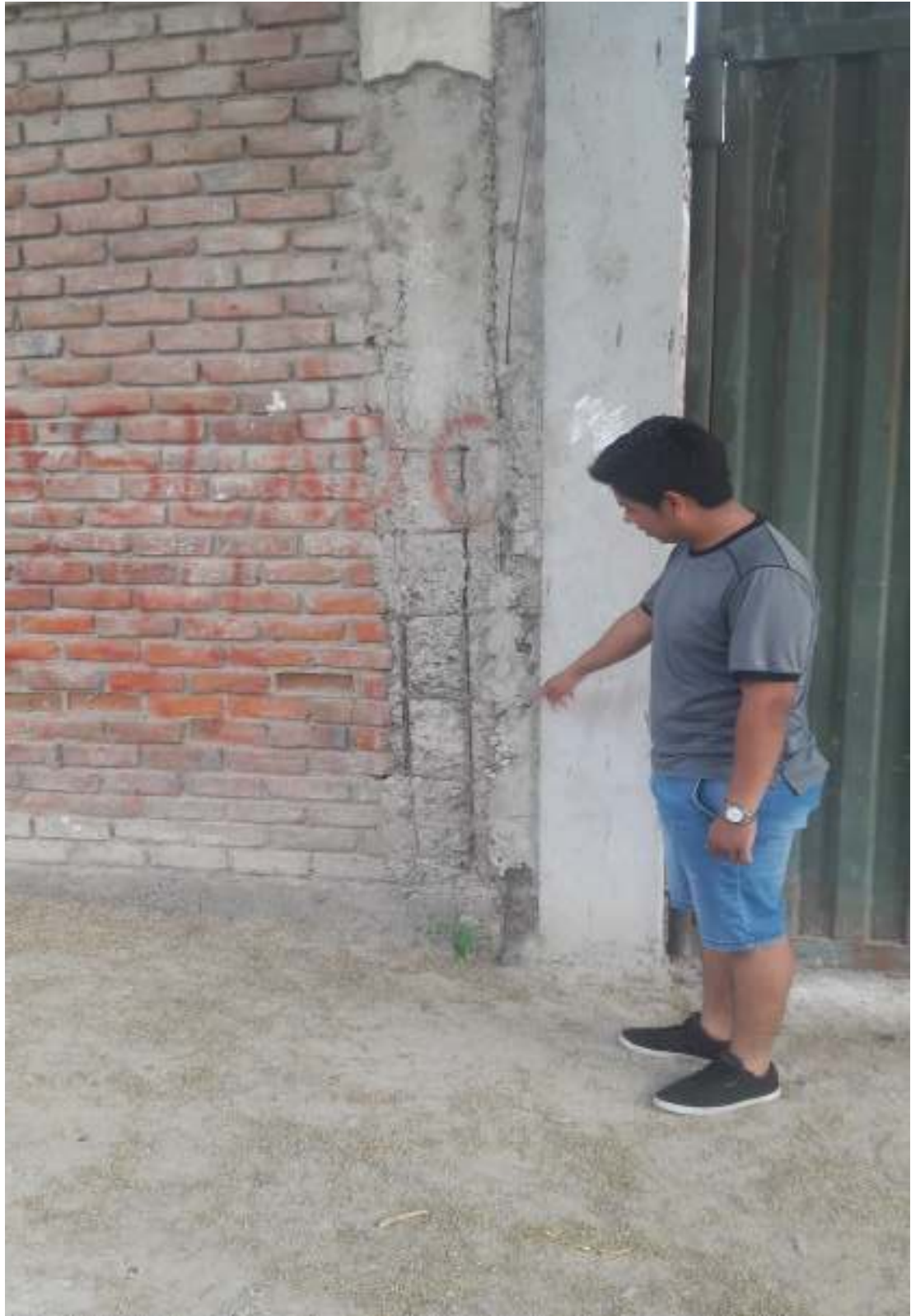
Gráfico 94: Patología Oxidación y Corrosión – Fuente: Elaboración Propia (2016)
