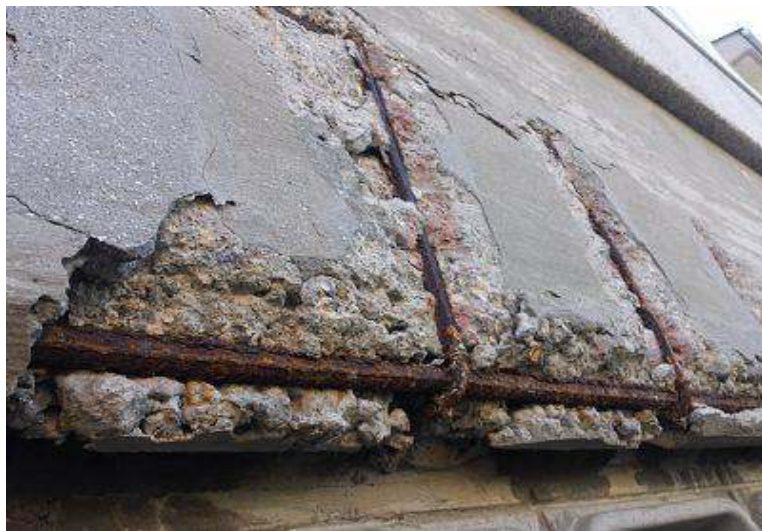
Gráfico 12: Oxidación y Corrosión – Fuente: Humeingenieria
