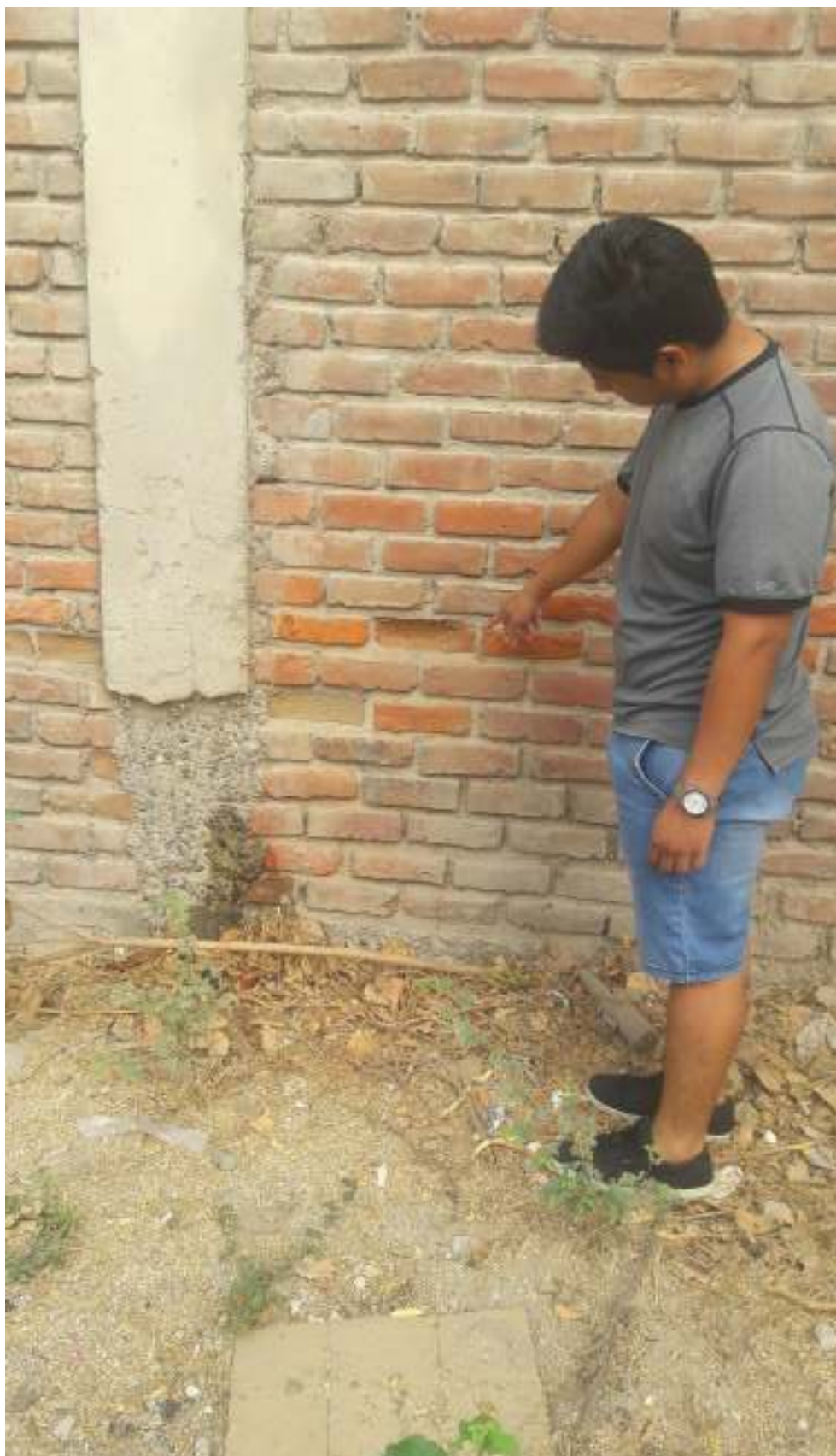
Gráfico 93: Patología Erosión en muro – Fuente: Elaboración Propia (2016)
