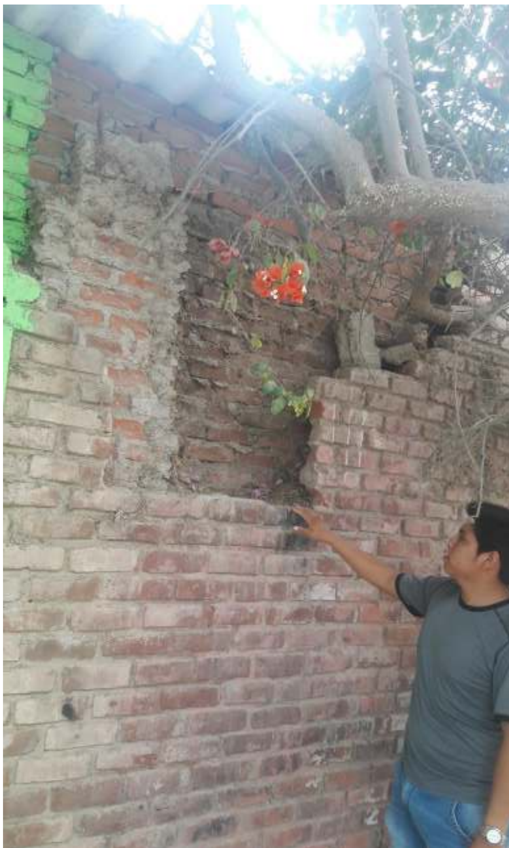
Gráfico 92: Patología Desintegración en muro – Fuente: Elaboración Propia (2016)
