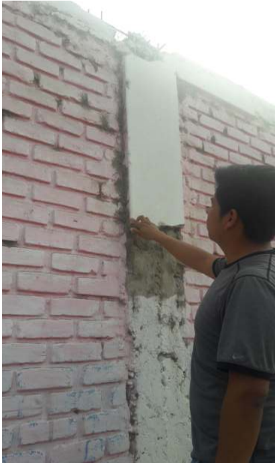
Gráfico 91: Patología Desprendimiento en columna – Fuente: Elaboración Propia (2016)
