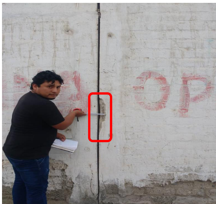
Fotografía 4. Columna afectada por desprendimiento en la Unidad Muestral 2 y 9.
