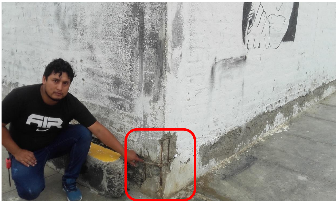
Fotografía 5. Columna afectada por corrosión en la Unidad Muestral 13 y 16.
