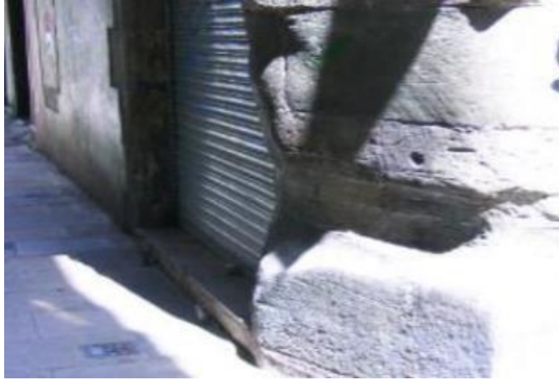
Figura 7. Desgaste superficial en muro ocasionados rozamiento. Nota. Fuente: Contreras, O. (2016).
