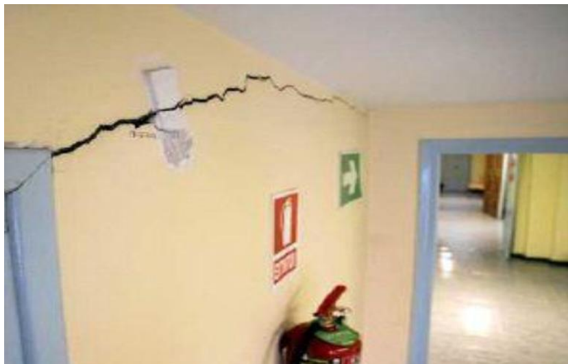
Figura 6. Grieta horizontal en muro causado por movimiento sísmico.
