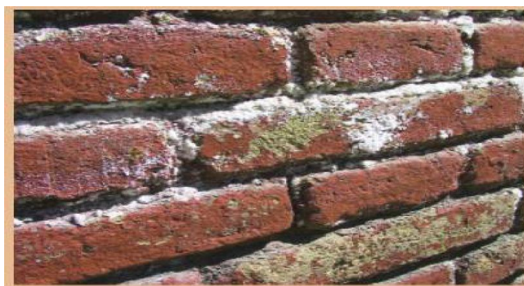
Figura 9. Eflorescencias en ladrillos, con afloramiento de sales solubles en la superficie.
