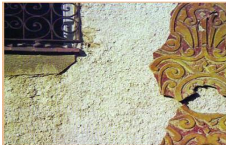
Figura 10. Perdida de la capa exterior del revoco de fachada
