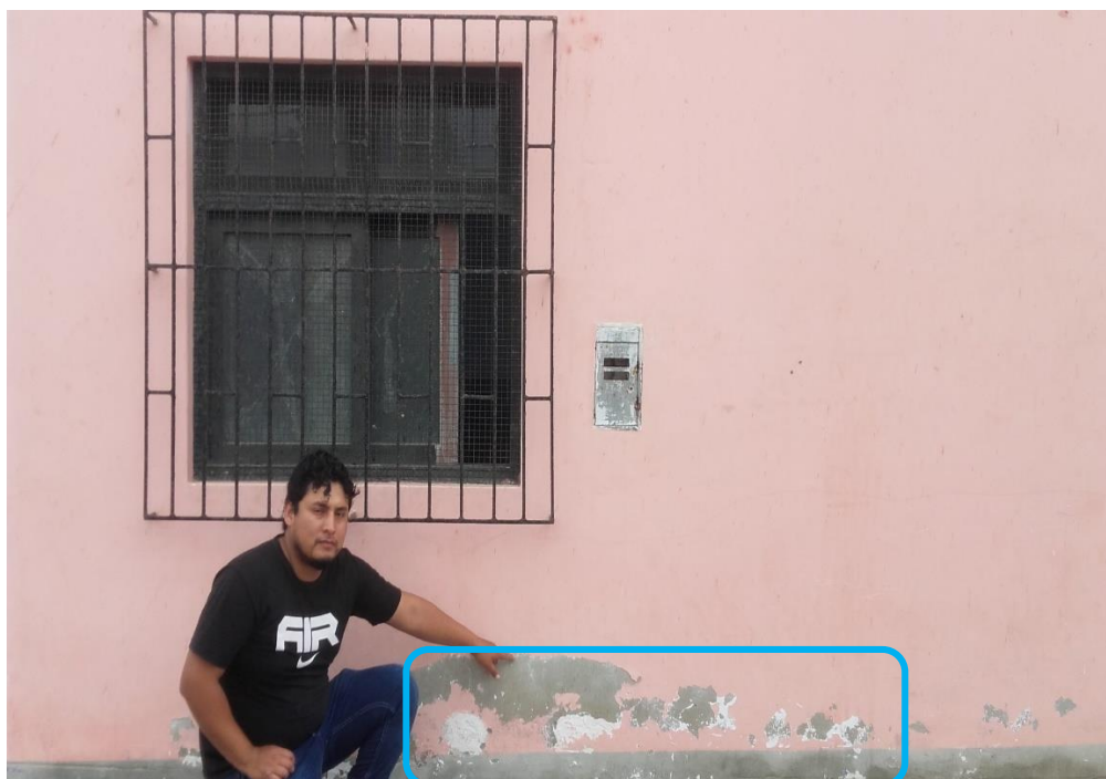
Fotografía 8. Albañilería afectada por eflorescencia en la Unidad Muestral 1 y 18.
