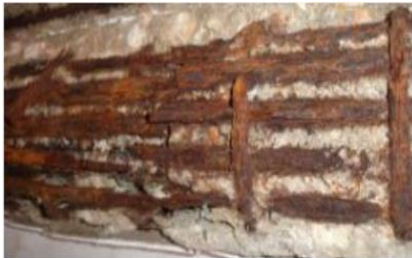
Figura 8. Corrosión en armadura de viga de concreto. Nota. Fuente: Figueira, G. y Yajure, J. (2016).
