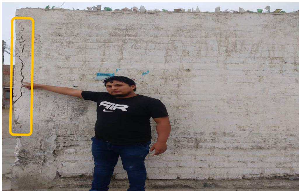
Fotografía 6. Albañilería afectada por grieta vertical en la Unidad Muestral 1 y 13.
