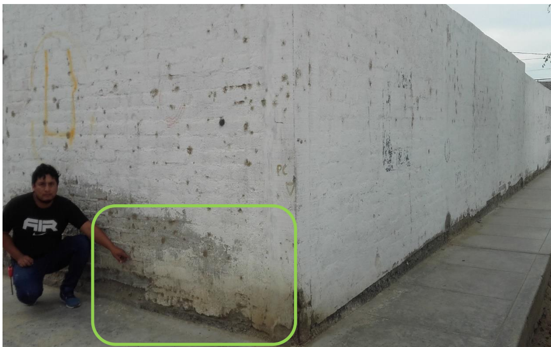
Fotografía 7. Albañilería y sobrecimiento afectados por erosión en la Unidad Muestral 6.y 21.
