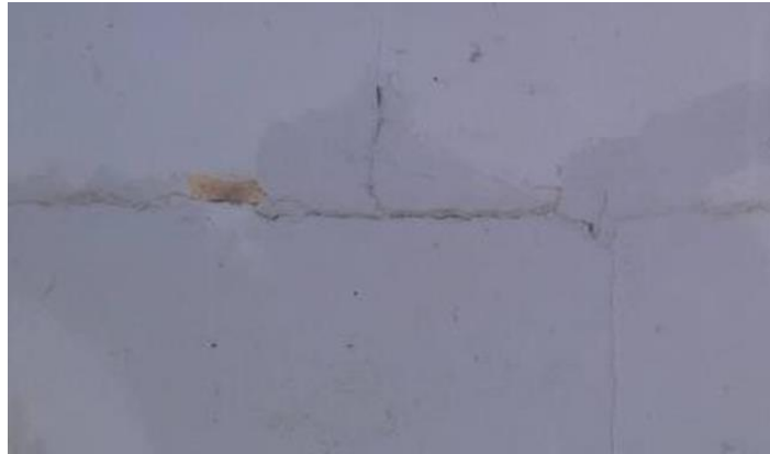
Figura 5. Fisuras sobre el acabado producto de esfuerzos mecánicos.
