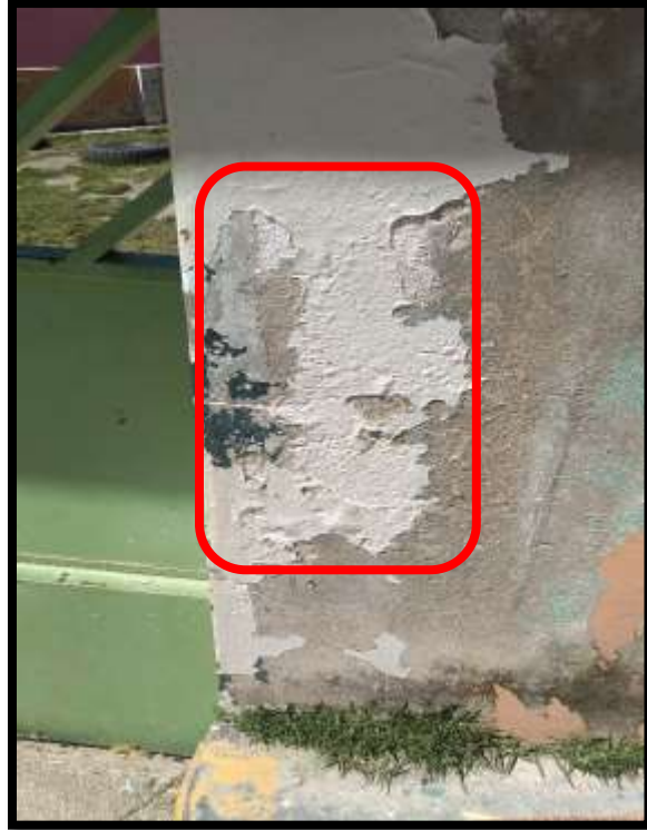
Fotografía 04: Columna afectado por eflorescencias en la unidad de muestra 03.
