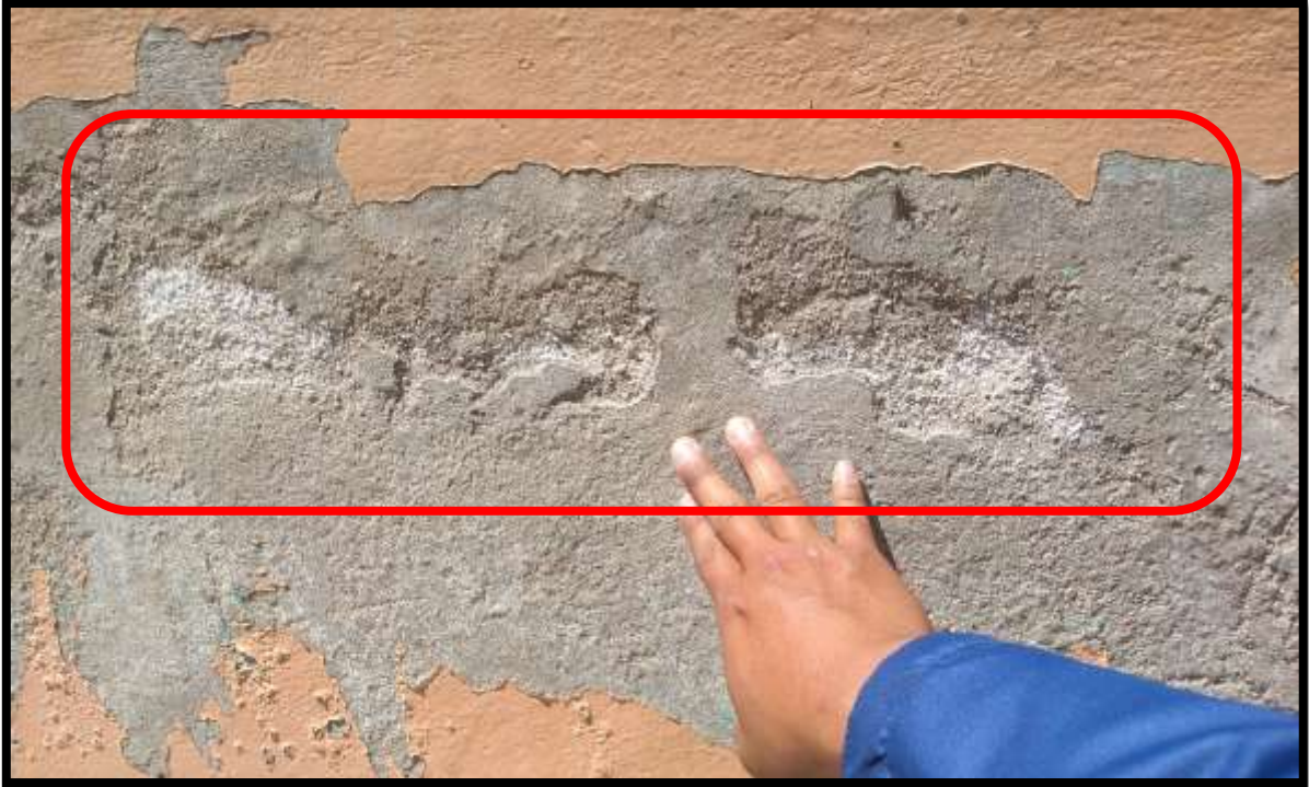
Fotografía 02: Muro de concreto afectado por disgregación en la unidad de muestra 02.
