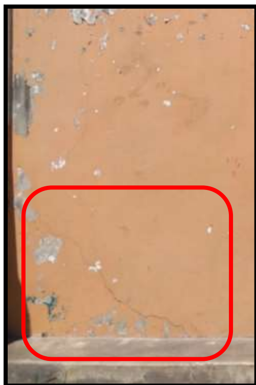
Fotografía 13: Sobre cemento afectado por fisura en la unidad de muestra 17.
