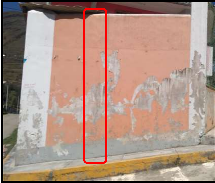
Fotografía 08: Muro de Albañilería afectado por fisura en la unidad de muestra 11.
