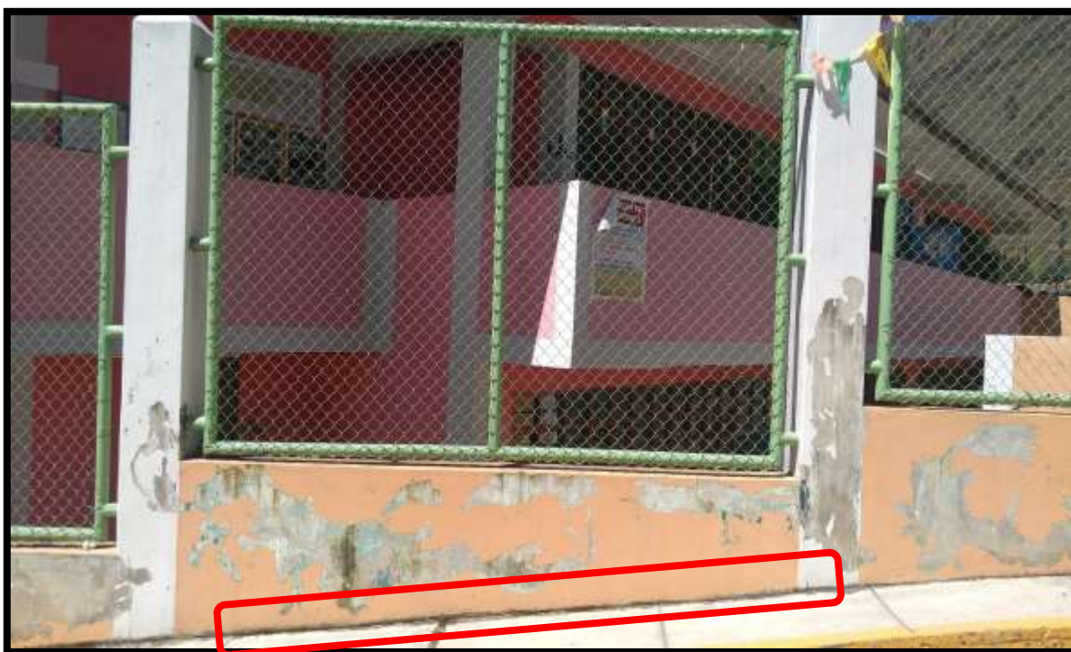
Fotografía 07: Muro afectado por grieta en la unidad de muestra 07.
