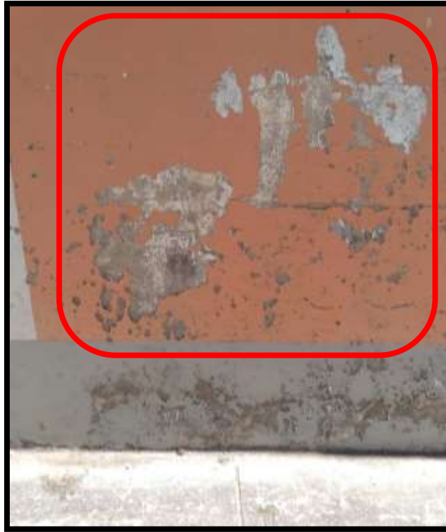
Fotografía 10: Muro afectado por eflorescencia en la unidad de muestra 12.
