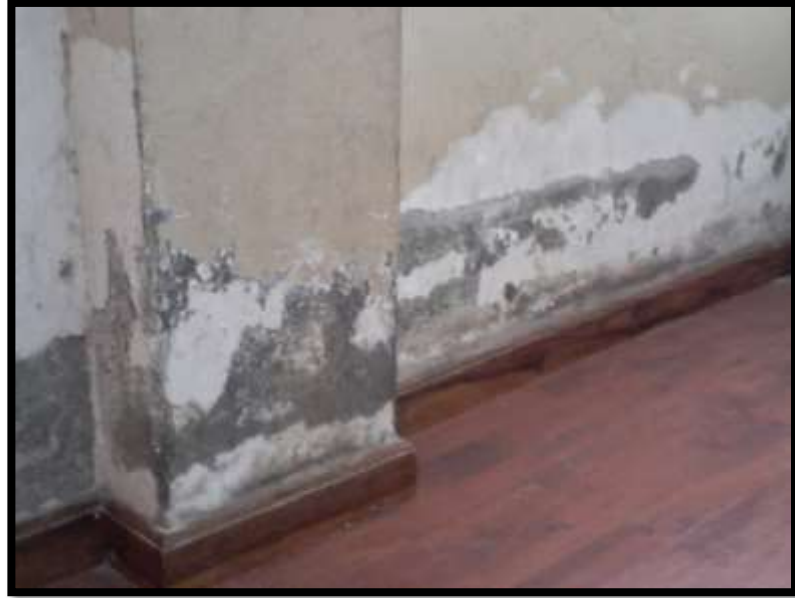
Figura 17: Eflorescencia en muros Fuente: El Maestro de obras Xavier valderas (2012)
