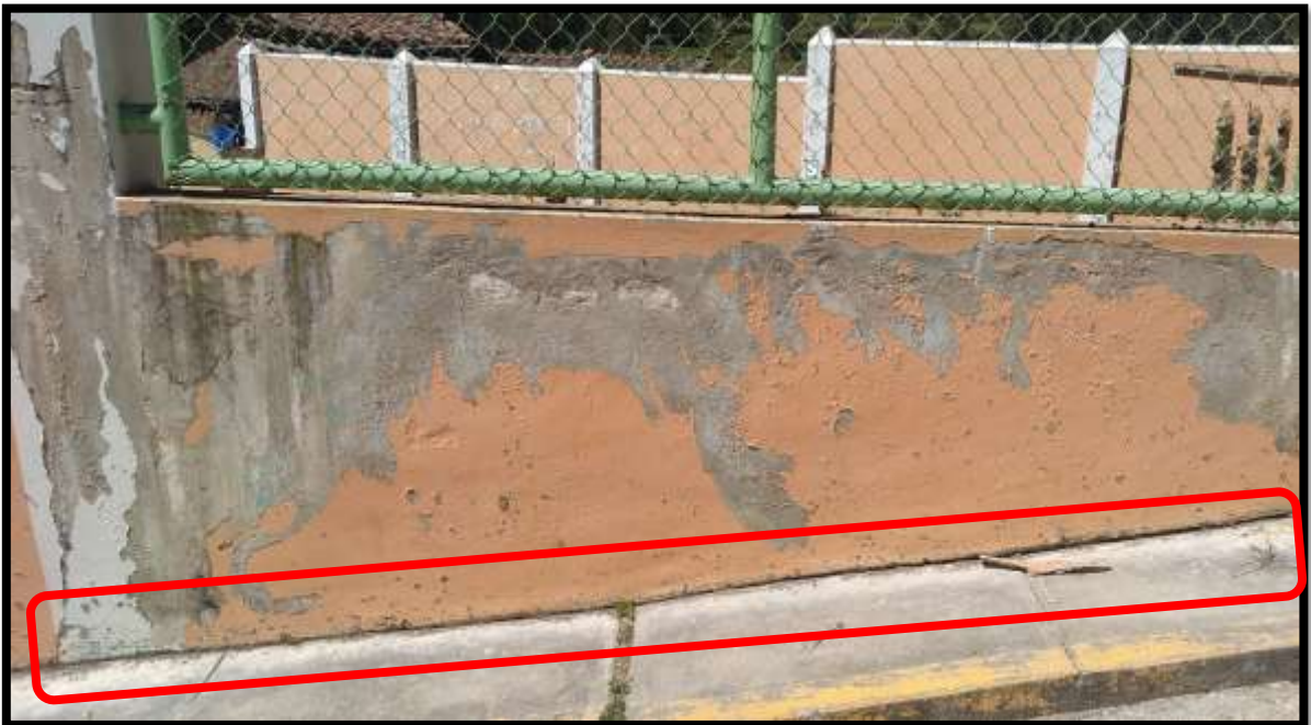
Fotografía 03: Muro de concreto afectado por grieta en la unidad de muestra 02.
