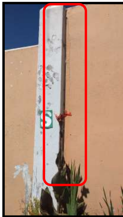
Fotografía 11: Muro afectado por fisura en la unidad de muestra 14.
