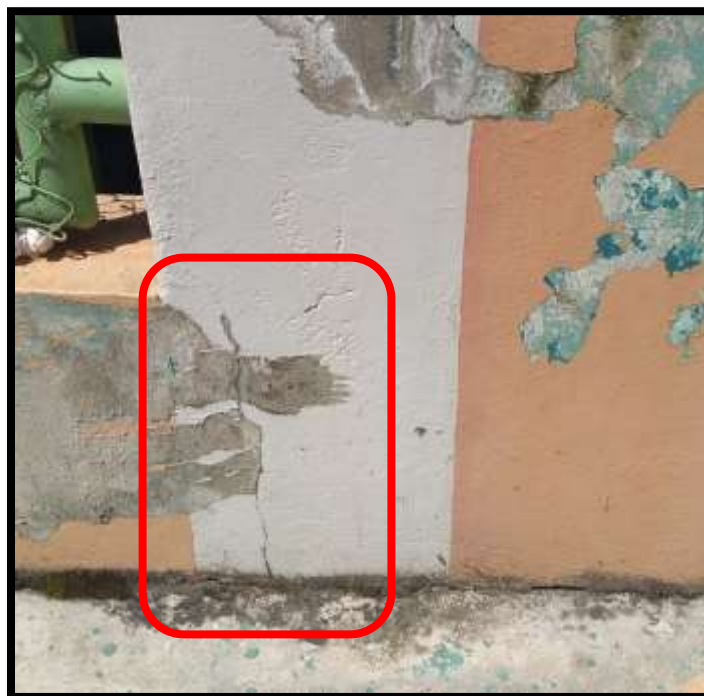
Fotografía 06: Columna afectado por fisura en la unidad de muestra 07.
