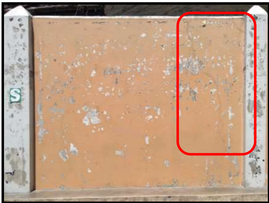
Fotografía 12: Muro afectado por grieta en la unidad de muestra 16.
