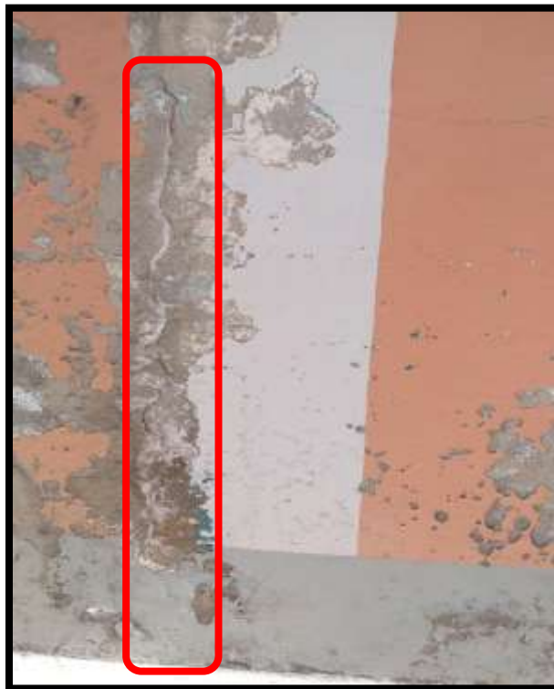
Fotografía 09: Columna afectado por fisura en la unidad de muestra 12.
