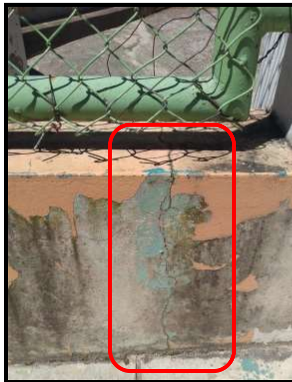
Fotografía 05: Muro afectado por fisura en la unidad de muestra 05.
